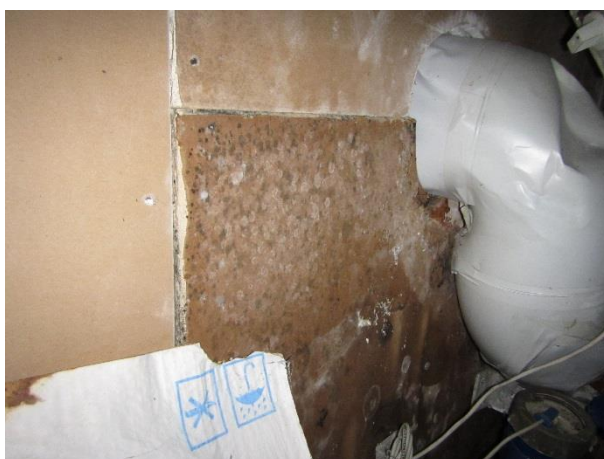
Kuva 1. Kellarissa, lämmönjakohuoneessa on seinissä laajalti mikrobivaurioita nähtävissä.
