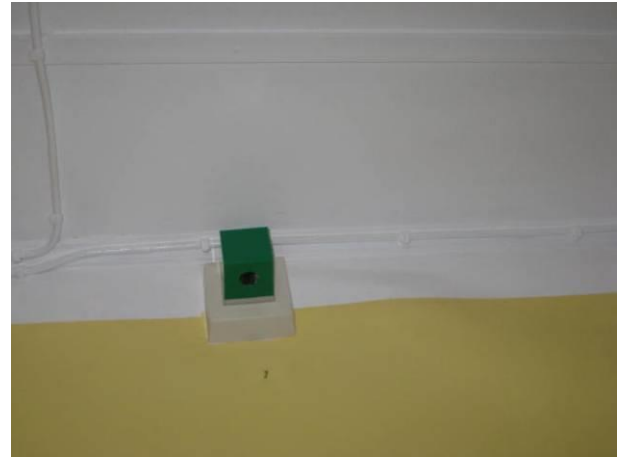
Kuva S6. Palaneita poistumistievalaisimia.
