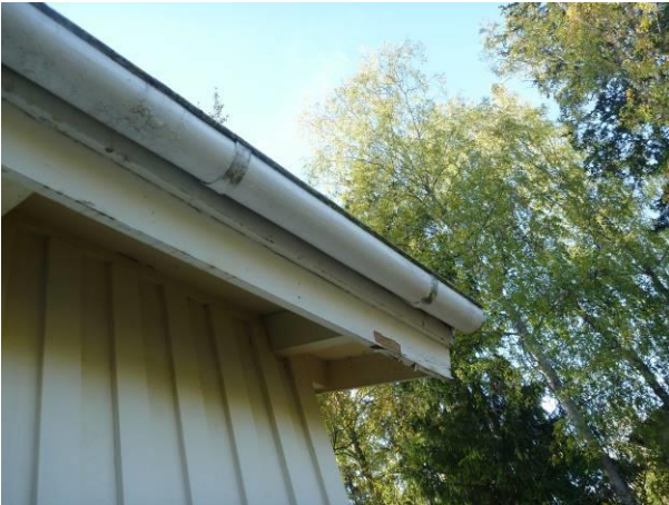
Kuva R12. Lievää lahoa räystäään otsalaudoissa.
