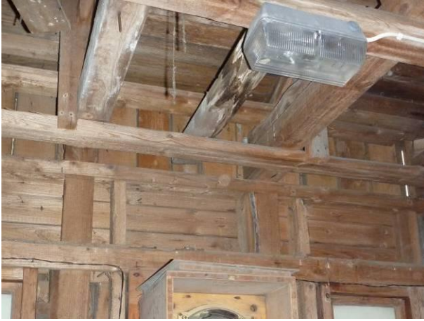
Kuva R18. Kellotapulin katossa on ollut vesivuotoa. Mahdollisesti vanha vesivuoto.
