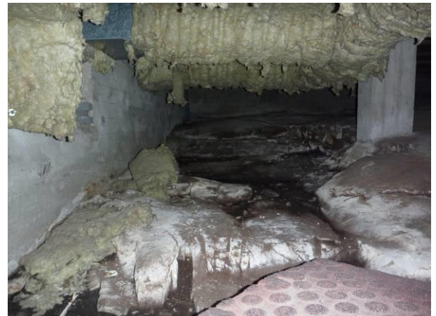
Kuva R4. Alapohjan ryömintätila. Maanpinnalla on kosteutta ja tilassa homeen hajua.
