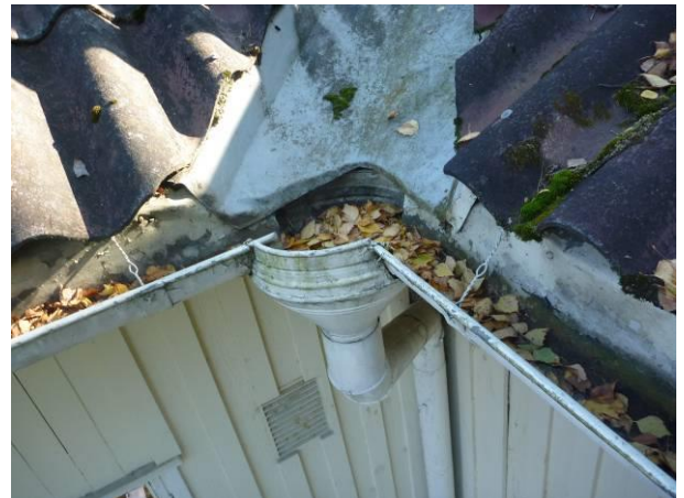
Kuva R16. Vedenkerääjä on tukkeutunut
