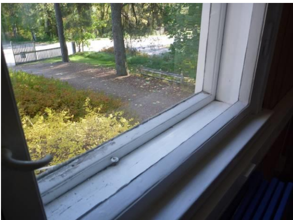
Kuva R7. Ulkopuitteen lasitiiviste vuotaa ja maali hilseillyt.
