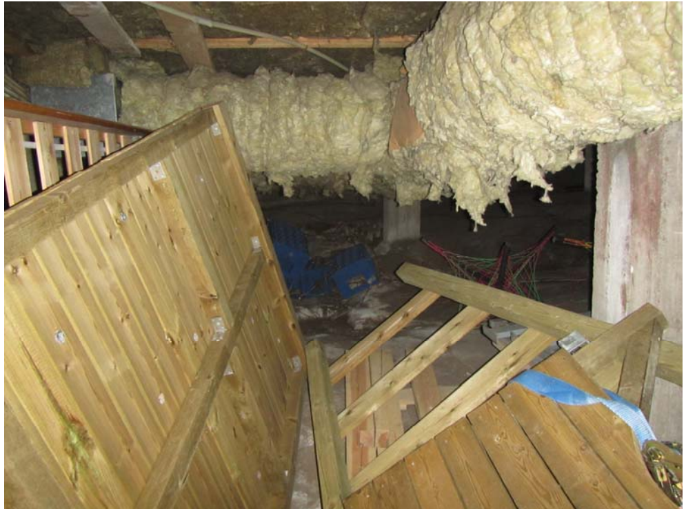
Kuva 2. Ryömintätilassa IV-kanavien ympärillä villaa ja vastaavasti katon alapinnoilla villat ovat esillä. Tila ei suoranaisesti ole sisätilan kanssa kosketuksissa, mutta ovi ryömintätilaan on epätiivis ja mineraalivillat voivat kulkeutua sisäilmaan.
