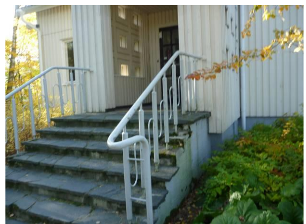
Kuva R11. Portaikon laastipinnoilla on sammalkasvustoa ja kiviä on irtoillut kiinnityksestä.
