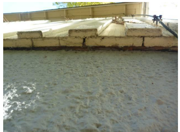
Kuva R5. Puurankaisen rungon ja julkisivun lauta-verhouksen välissä ei ole tuuletusrakoa.
