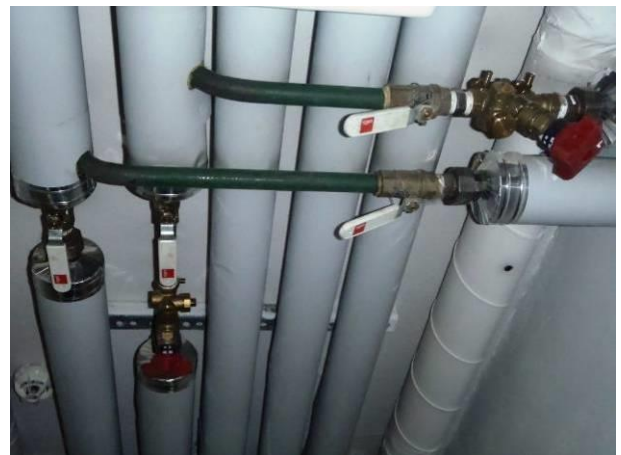
Kuva L3. Lämpöjohtoverkoston venttiilit on asennettu 1980-luvulla.
