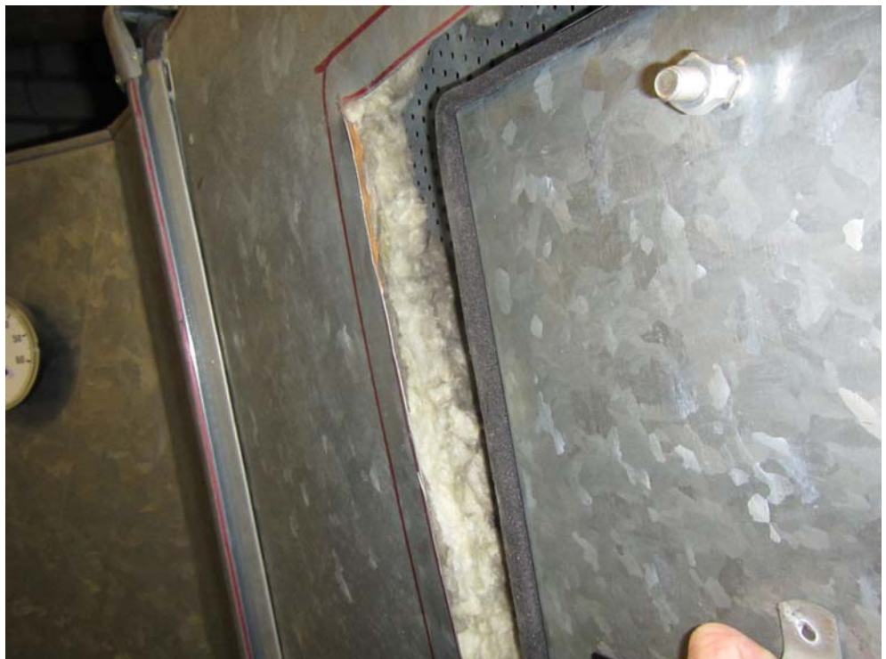
Kuva 3. IV-koneessa on käytetty eristeenä mineraalivillaa.
