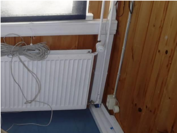
Kuva L4. Patteriventtiilit ja termostaatit on uusittu suurimmaksi osaksi arviolta 2004.
