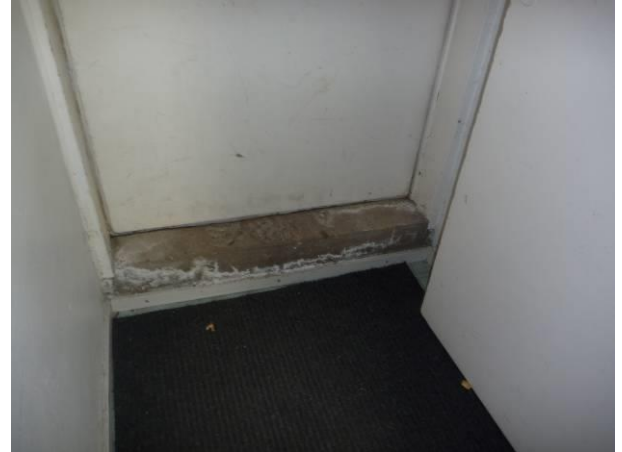
Kuva R3. Kellarin ulko-oven sokkelipinnalla kosteusjälkiä.
