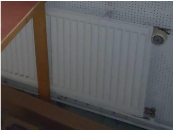
Kuva L5. Myös muutamia vanhempia patteriventtiilejä on yhä jäljellä.
