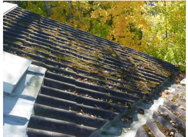
Kuva R15. Vesikatteen pinnalle on kertynyt samalta ja roskaa.
