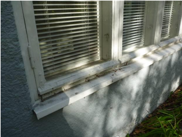
Kuva R6. kellarin ikkunapelti taittunut vesi lamikoituu pellille.
