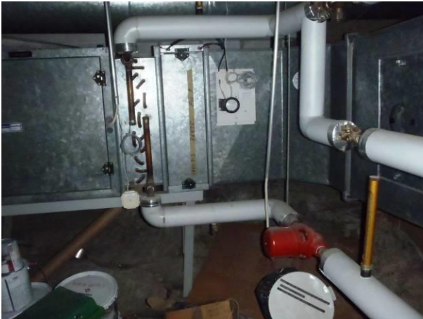
Kuva L10. Kappelisalin tuloilmakone sijaitsee kellarin lämmönjakuhuoneessa.
