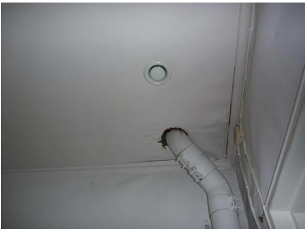
Kuva R20. Viemärin tuuletusputken läpivienti ei ole tiivis, ja rakenne mahdollisesti ajoittain kastunut.
