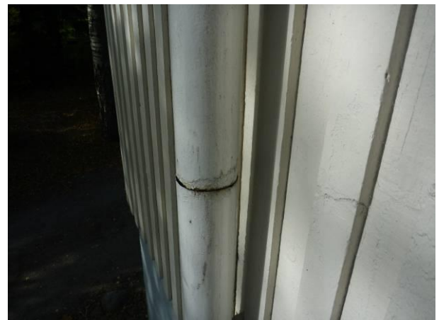
Kuva R10. Syöksytorven saumassa ruostetta.
