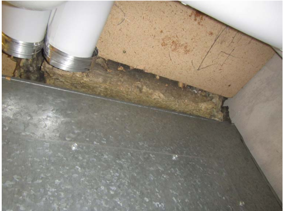
Kuva 4. IV-konehuoneen katossa on mineraalivillaa vapaana.
