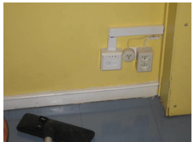
Kuva S8. Nykyisiä tele- ja pinta-asennuksia.
