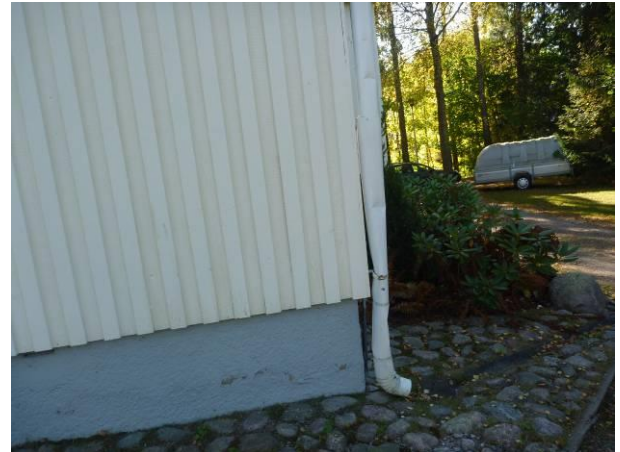
Kuva R9. Syöksytorvet ovat paikoin rikkoontuneet.
