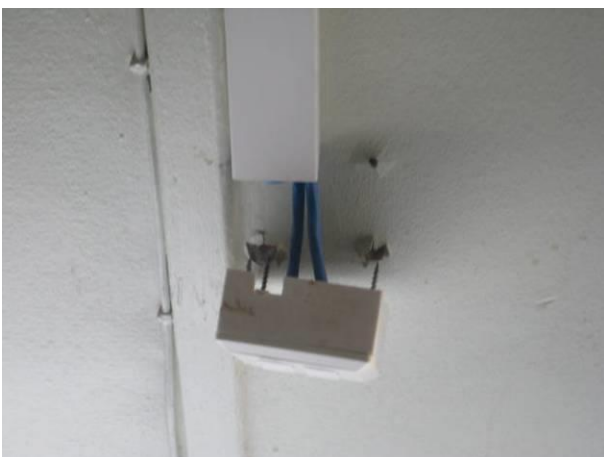
Kuva S5. Keittiön ATK-pistorasia on irti.
