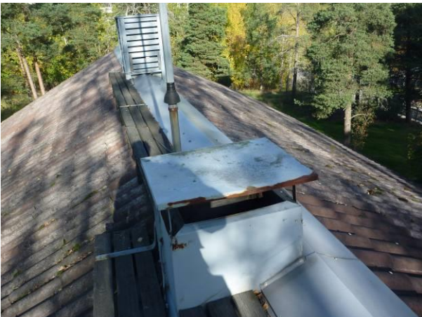
Kuva R13. Vesikatolla pellityksissä on pintaruostetta.
