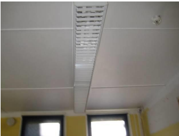
Kuva S4. Sisällä olevia loistevalaisimia.
