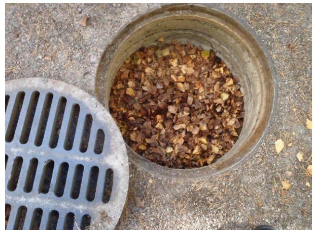
Kuva L9. Piha-alueen sadevesikaivo on täynnä lehtiroskaa.
