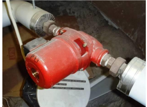
Kuva L2. Ilmastoinnin lämmitysverkoston kierto-pumppu on vanhempi laite.
