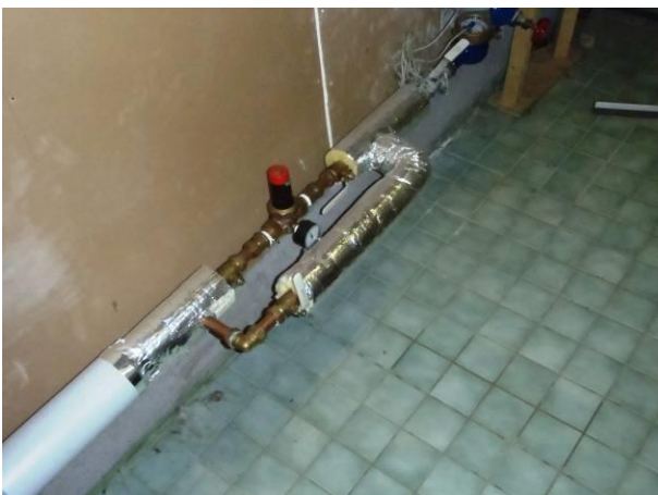
Kuva L6. Vesijohtoverkosto on varustettu paineenalennusventtiilillä.
