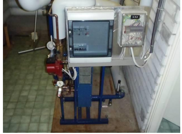
Kuva L1. Lämmönjakokeskus siirtimiseen on uusittu vuonna 2004.
