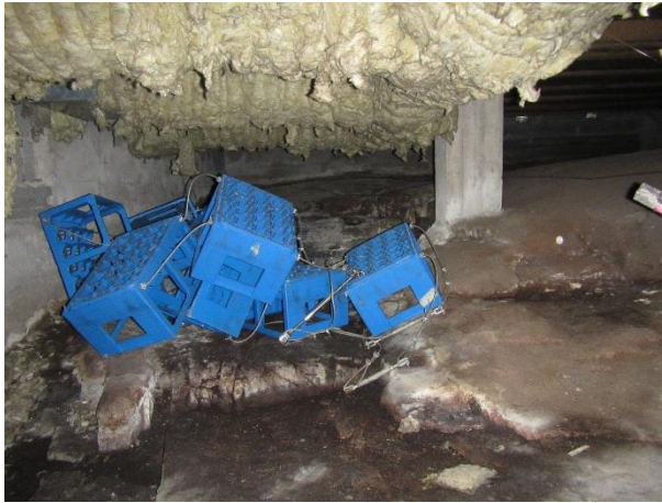
Kuva 4. Ryömintätila rajoittuu kallioon ja kalliopinnoilla on havaittavissa kosteutta.
