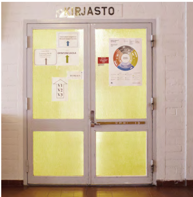
Välisan käytävän palo-ovi ensimmäisen rakennusosan aulasta päin nähtynä.
