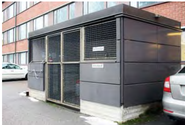
Suuren sisäpihan kaasupullovarasto ja uusittu seinämateriaali.
