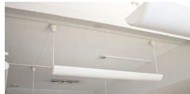
Ylöspäin suunnattuja loisteputkivalaisimia tietokonehuokassa.
