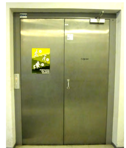
II rakennusvaiheen siiven hissi (7).
