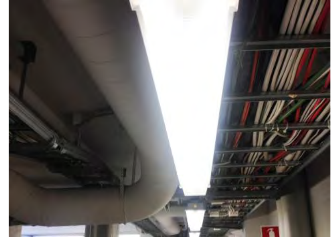
Pajan yleisvalaisimet ovat loisteputkia.
