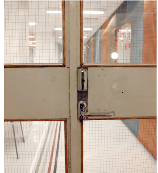
Keskikäytävälle johtava turvalasi-metalliväliovi.
