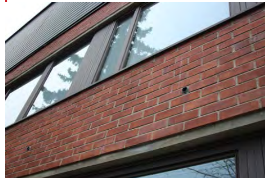
Julkisivussa on havaittavissa säännöllisin välein reikiä, joita ei näy piirroksissa.
