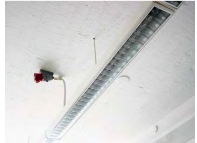
Kerroksien kaikki valaisimet ovat loisteputkivalaisimia, alakatolisissa tiloissa valaisimet ovat upotettuja, muissa tiloissa ne on kiinnitetty suoraan välipohjaan.
