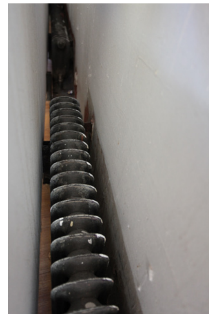
Koteloitu lämpöpatteri juhlasalin (1.3) seinustalla.
