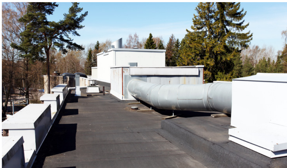
Vanha ilmanvaihtokonehuone näkyy kuvassa etualalla. Vuoden 1999 IV-konehuone kuvassa takana vaaleampana.
