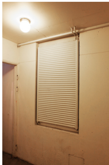
Syvennykseen upotettu levypatteri kellarin käytävällä.
