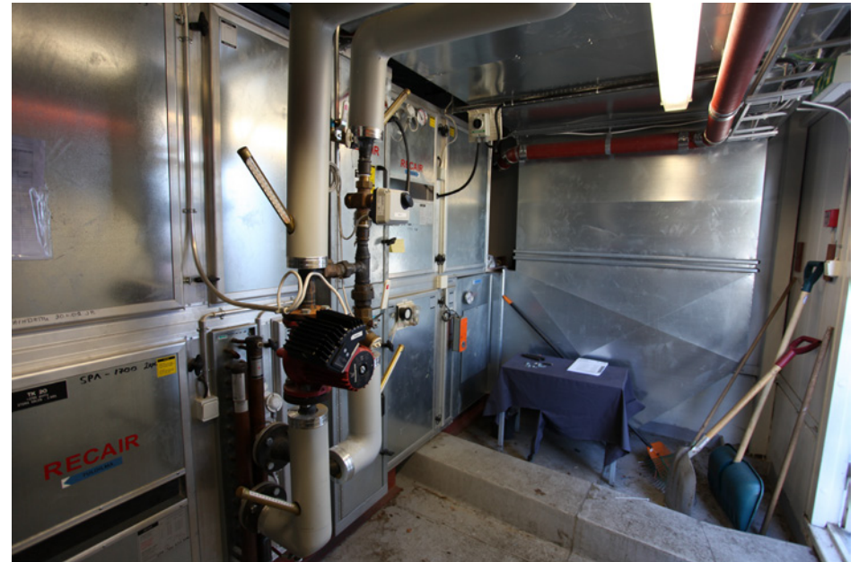
Uuden ilmanvaihtokoneen sisätila.
