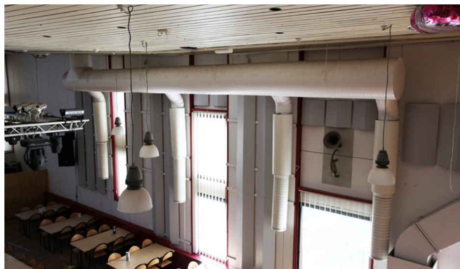
Vuonna 1999 ilmanvaihtoremontin yhteydessä tehdyt putket näkyvät erityisen hyvin juhlasalin (1.3) eteläseinustalla.
