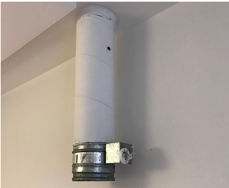
Kuva 5.4. Huone 142 Liesituuletin poistettu, mutta iv-poisto jätetty muuttamatta.
