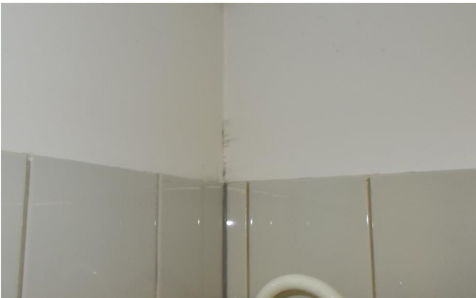
Kuva 4.10. Ilmavuotoa huoneen nurkassa h 123.
