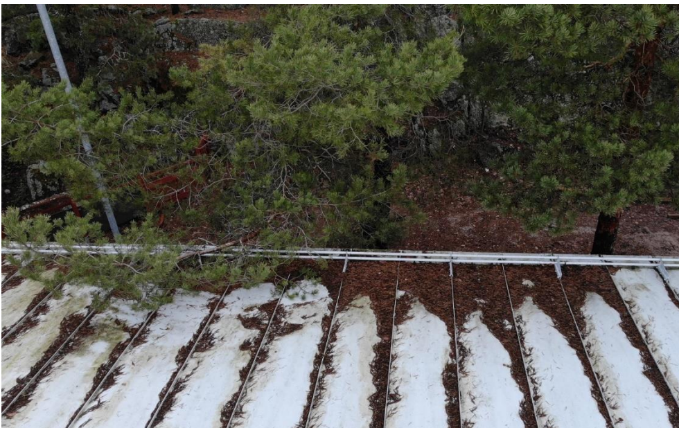
Kuva 4.2. Vesikatto ja sadevesikouru ovat puhdistamatta.
