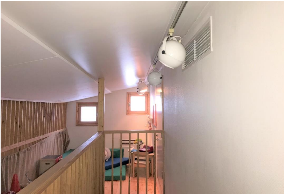
Kuva 5.3. Liikuntasalissa tuloilma ei pääse huuhtelemaan koko liikuntasalin tilaa parvella olevan verhon sekä rimojen takia.
