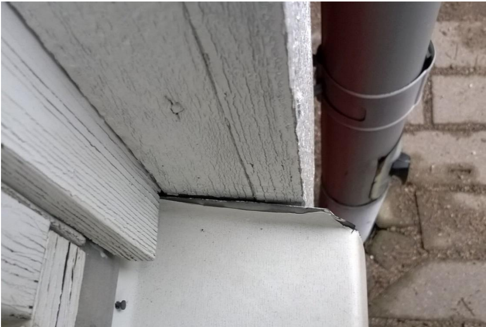
Kuva 4.7. Ikkunapellityksen nosto ei ole tiivis.
