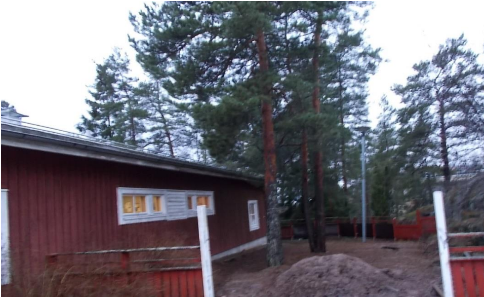
Kuva 4.1. Puiden oksat ylettyvät vesikatolle.
