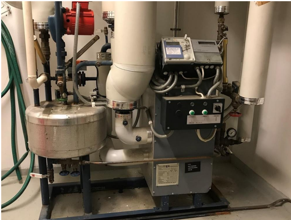
Kuva 6.4. Lämmönvaihdinpaketti ikäisekseen siisti.
