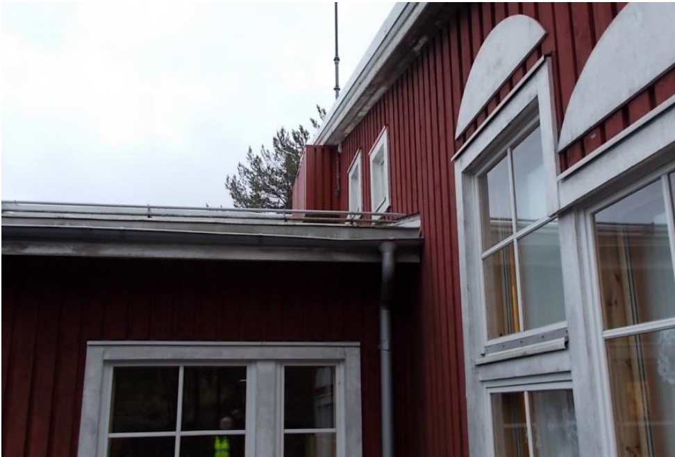
Kuva 4.5. Sadevesikouru on notkollaan. Matalan katon sadevesi tullut kourun yli kastellen korkeaa pystyseiniä.
