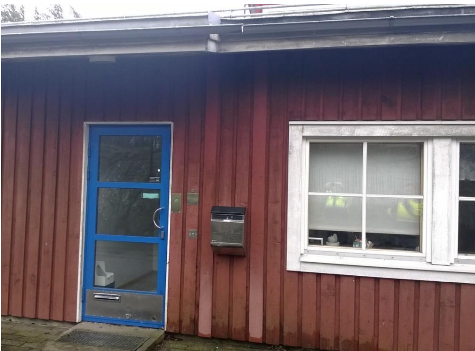
Kuva 4.4. Sisäänkäynnin lipan sadevedet kastelevat sokkelin.
