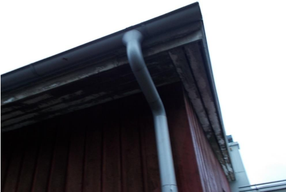
Kuva 4.3. Räystäiden otsa- ja aluslaudoitukset ovat likaisia.
