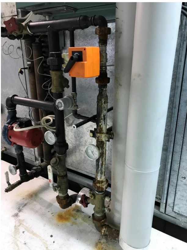
Kuva 5.6. Ilmanvaihdon lämmitysputkisto vuotanut ilmanvaihtokonehuoneessa.
