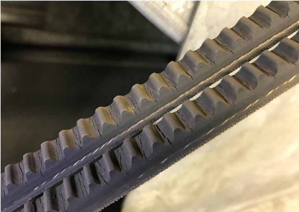
Kuva 5.1. Ilmanvaihtokoneen puhaltimien hihnat kuluneet.
