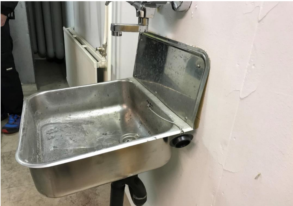
Kuva 5.2. Pesuallas irronnut seinästä iv-konehuoneessa.
