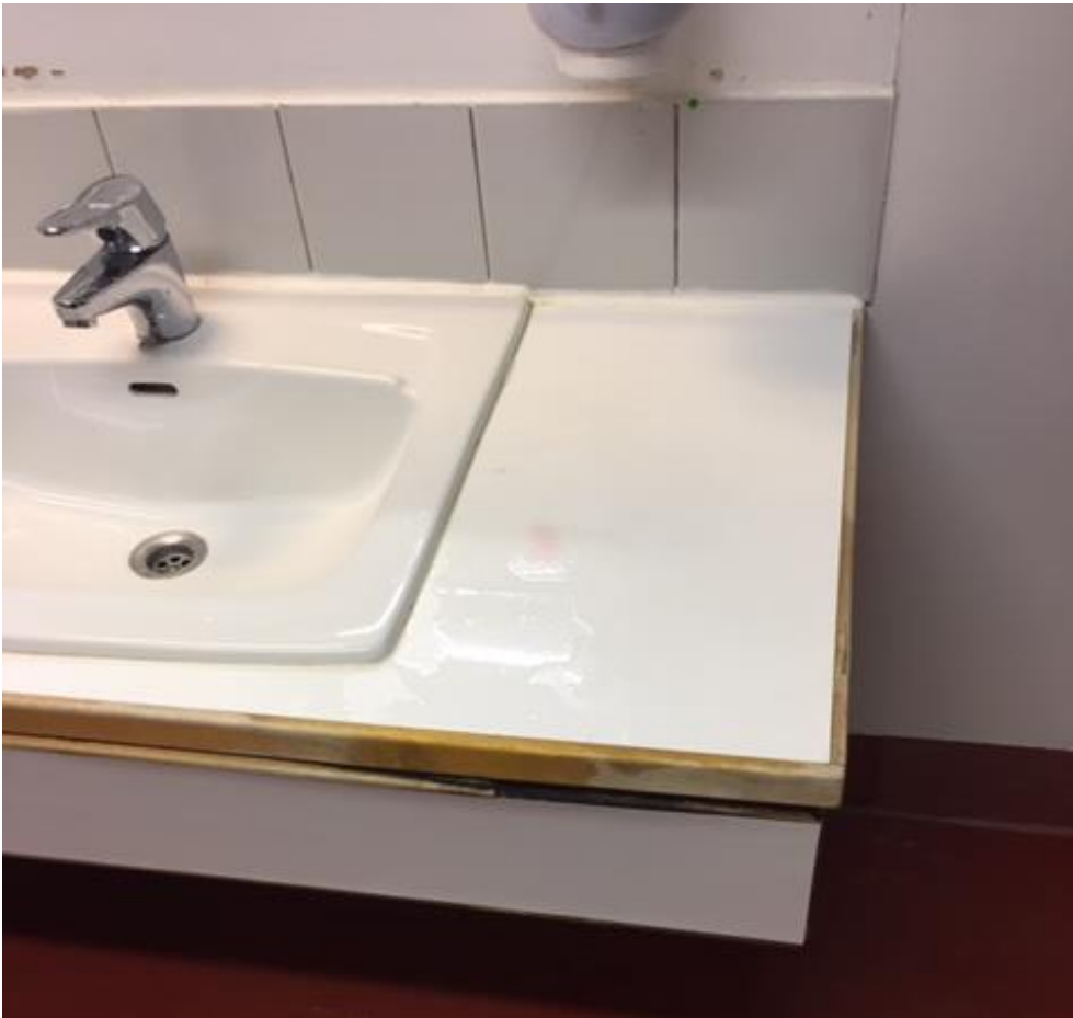
Kuva 4.15. WC 144 Vaurioitunut allastaso.
