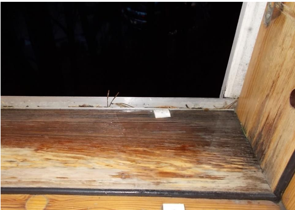
Kuva 4.8. Ikkunakarmi on kosteusvaurioitunut h 103.
