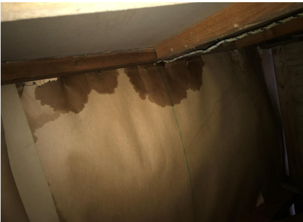
Kuva 4.6. Aluskatteessa ja katon runkorakenteissa on vesivuotojälkiä.
