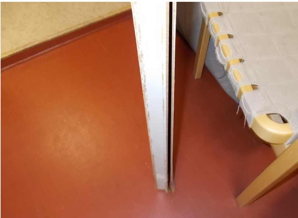
Kuva 4.14. Huonokuntoinen väliovi h 112.
