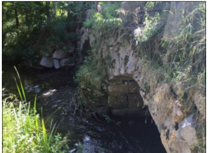
Glimsinjoen ylittää kaksiaukkoinen kiviholvisilta. Kasvillisuus on vallannut siltaa voimakkaasti peittäen myös näkyvyyttä. (Sini Moilanen/Espoon kaupunki)
