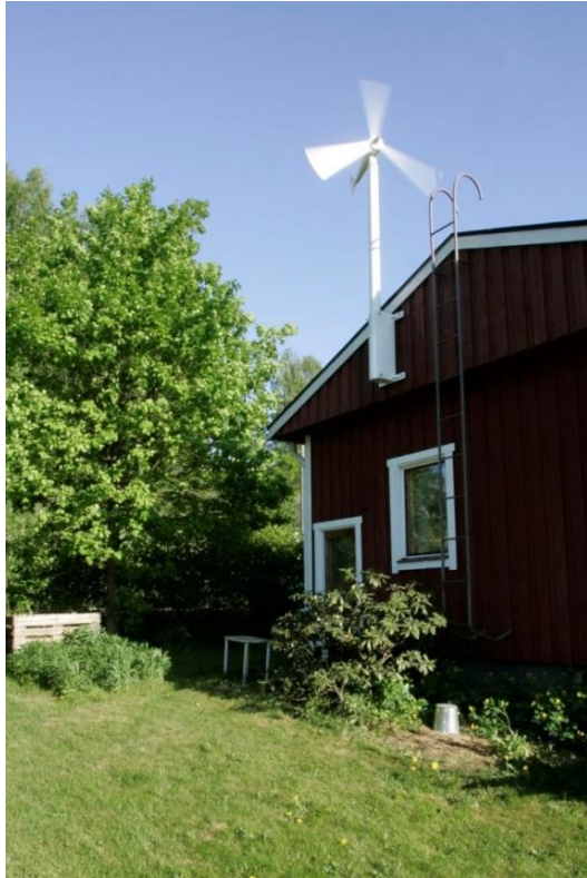
Kuva 18. Rakennuksen seinään asennettu pientuulivoimala (Janne Käpylehto / www.pienenergia.com ).
