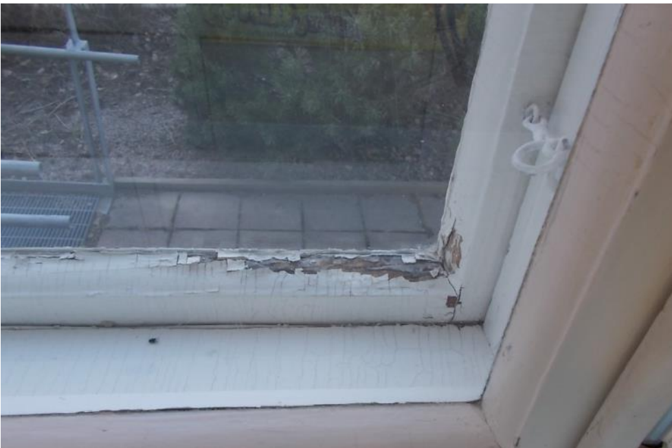
Kuva 4.5. Ikkuna on kunnostusta vailla.
