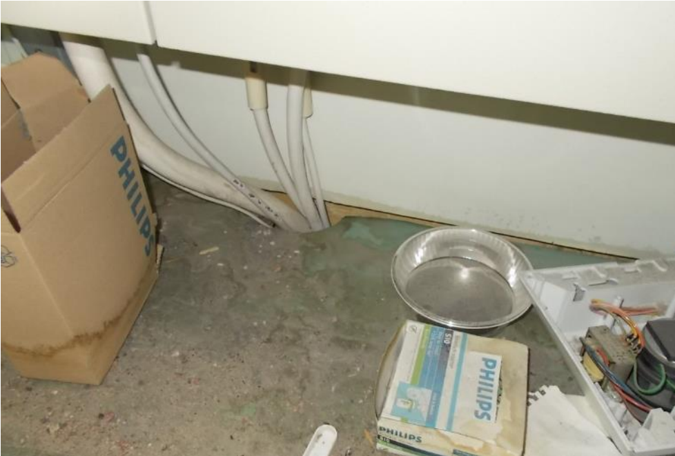
Kuva 4.8. Sähkökeskus RK 1.5 1.kerroksessa tila R117.
