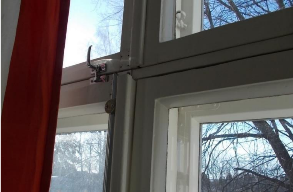
Kuva 4.6. Ikkuna ei sulkeudu.
