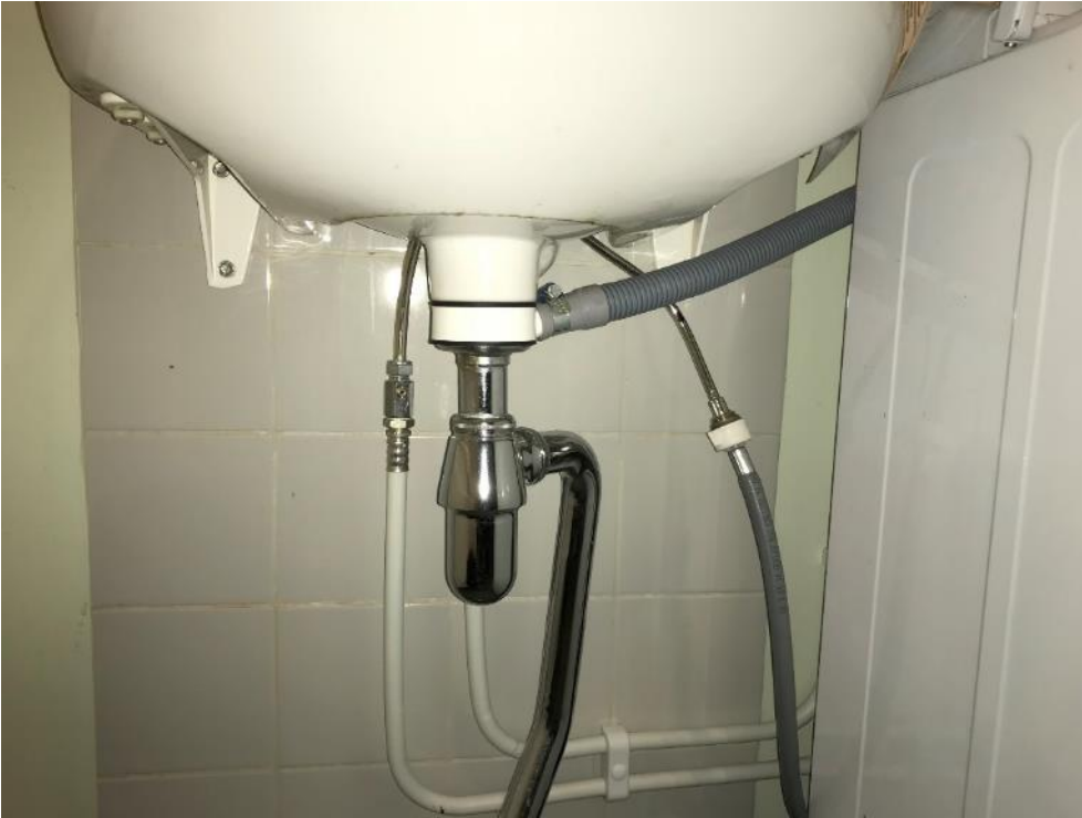
Kuva 5.4 Pesukoneen liitos on kannakoimatta.
