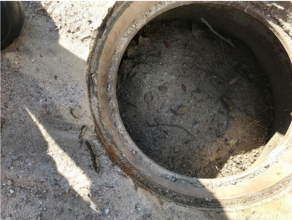
Kuva 5.5. Pihan sadevesikaivoissa on hiekkaa.
