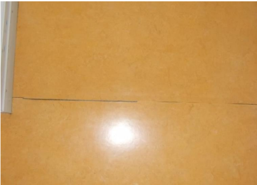
Kuva 4.7. Lattiamaton sauma on auki 2.kerroksessa.
