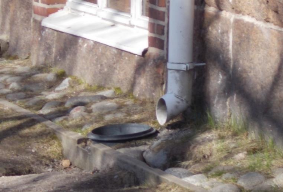
Kuva 4.4. Sadevedet menevät osin rännikaivon ohi.
