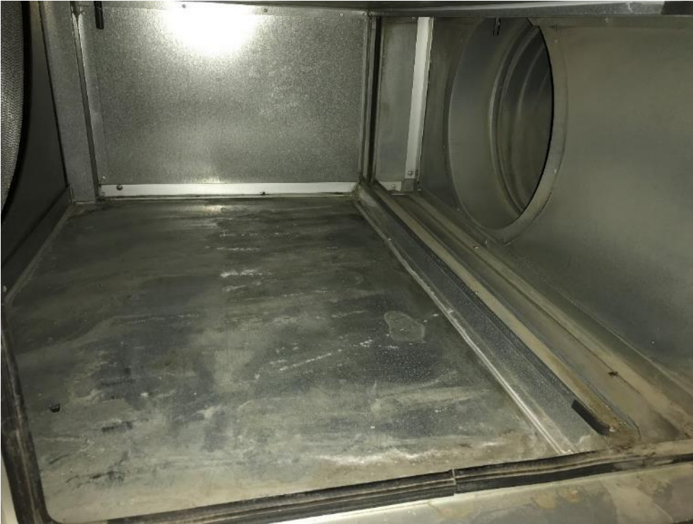
Kuva 5.2. Raitisilmakammion viemäröinti puuttuu.
