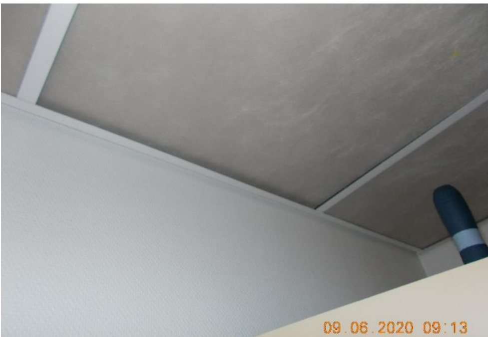
Kuva 4.14. Alakattolevyjä on pois paikaltaan.
