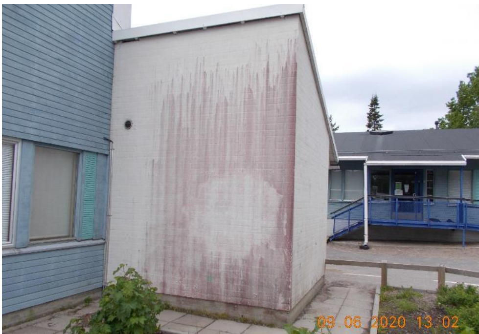
Kuva 4.22. Julkisivumuurauksista puuttuvat tuuletusraot alareunoista, slammauksissa värimuutoksia, halkeamia ym. vaurioita.
