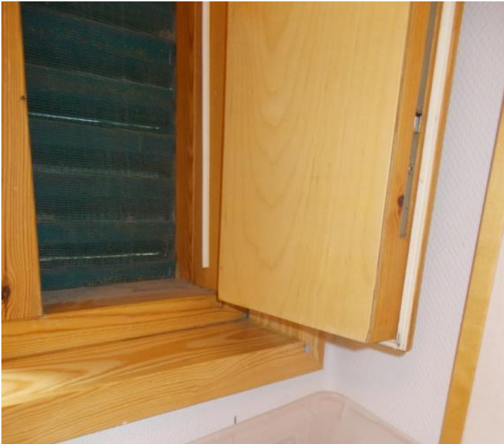
Kuva 4.1. Tuuletusikkunoiden tiivisteissä on puutteita.
