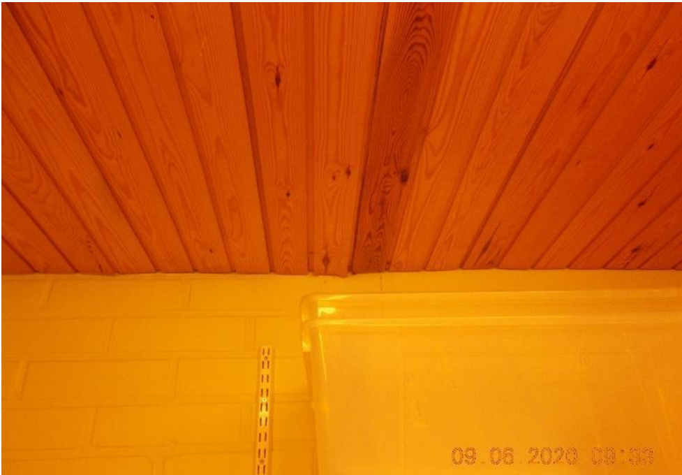
Kuva 4.13. Varaston 7 paneelikatossa on kosteusvaurio.
