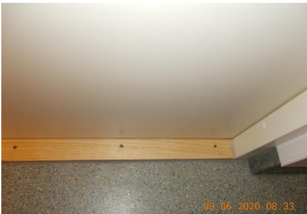
Kuva 5.8. Siivouskomeron ovirako puuttuu.
