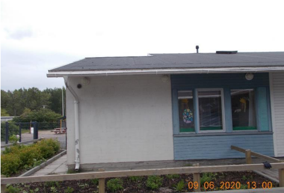
Kuva 4.15. Sadevesikourut ovat useassa kohdassa vääntyneet ja niiden kaadot eivät tämän vuoksi toimi.
