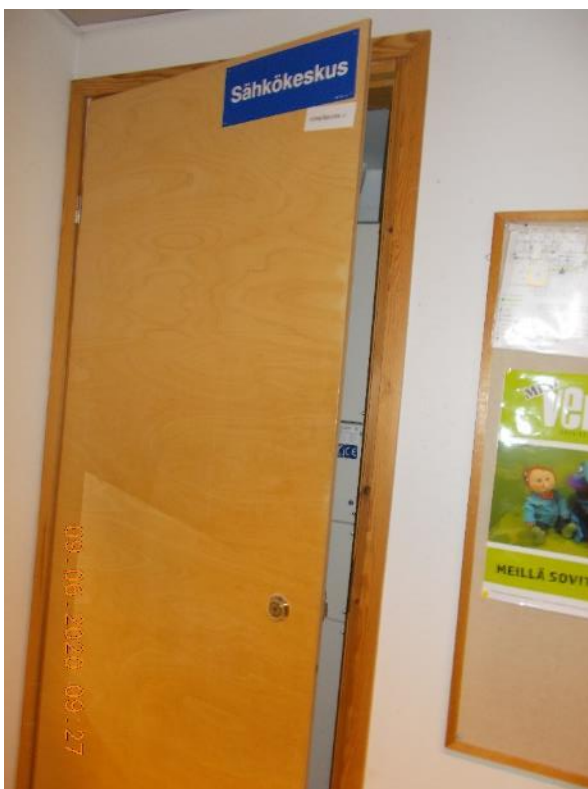
Kuva 4.12. Sähkökeskuksen 11 oven lukko on korjauksen tarpeessa.
