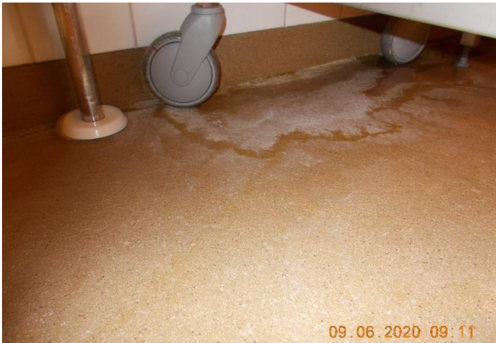
Kuva 4.5. Keittiön 46 lattiat märät ja kaadot eivät toimi.
