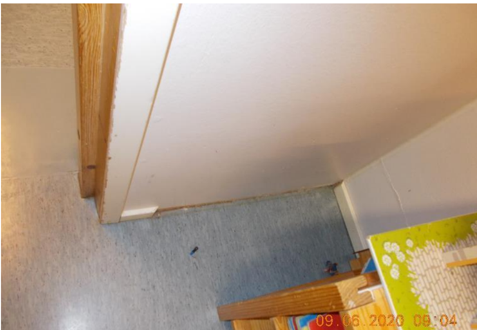
Kuva 4.2. Toimiston 74 oven vierestä puuttuu jalkalista.
