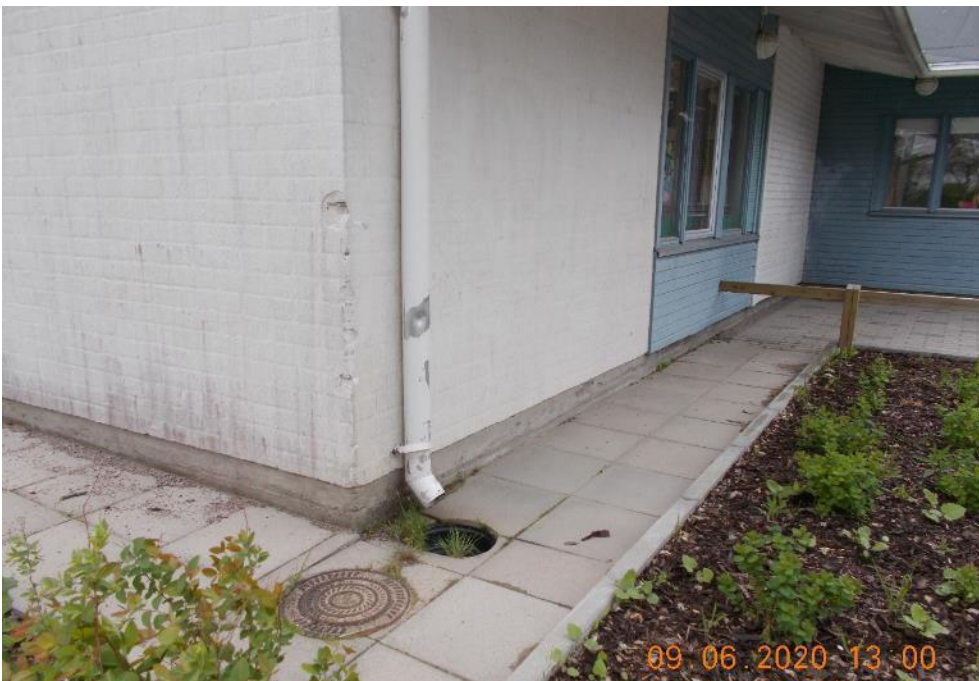
Kuva 4.18. Julkisivumuurauksista puuttuvat tuuletusraot alareunoista, slammauksissa värimuutoksia, halkeamia ym. vaurioita.
