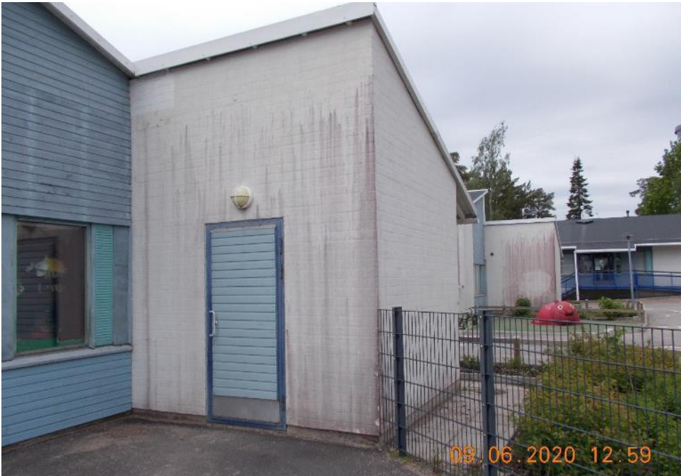
Kuva 4.19. Julkisivumuurauksista puuttuvat tuuletusraot alareunoista, slammauksissa värimuutoksia, halkeamia ym. vaurioita.
