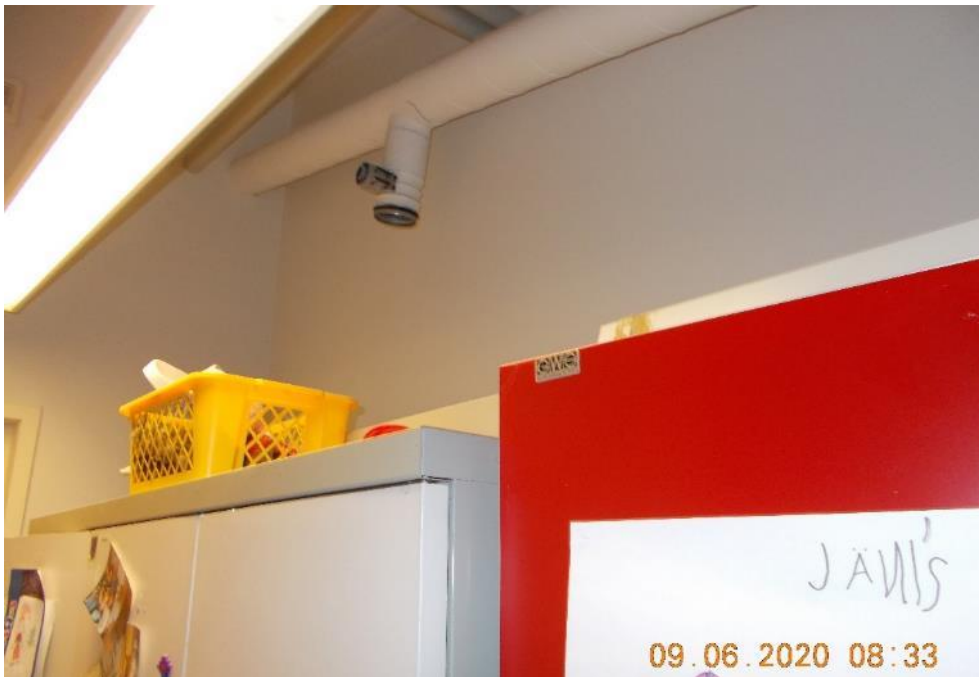
Kuva 5.7. Pukukaappien poistoputket on kytkemättä.
