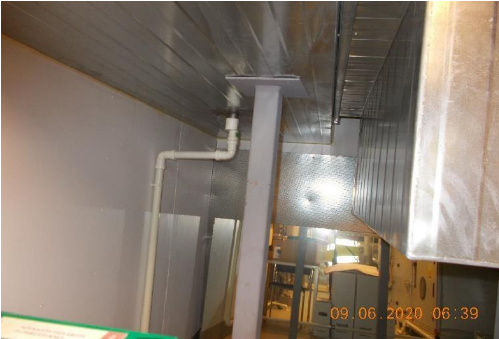
Kuva 5.1. Raitisilmakammioiden viemäröinnistä puuttuu vesilukot.
