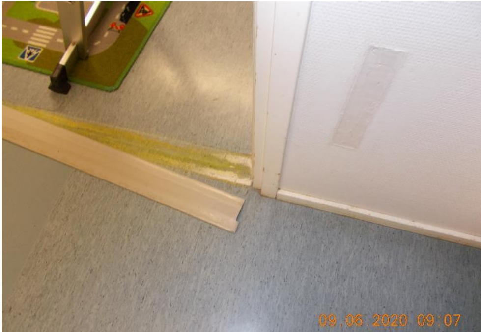
Kuva 4.3. Toimiston 77 oven kynnys irronnut liimauksestaan.
