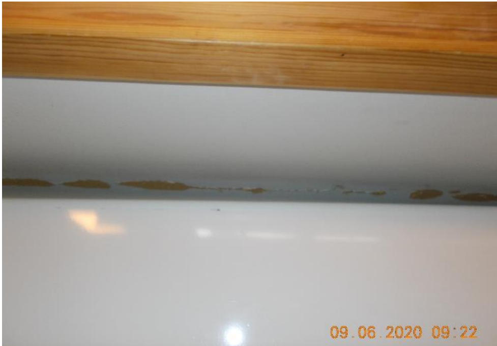
Kuva 4.9. Kodinhoitohuoneen 26 seinä on kärsinyt kuivauskaapin höyryistä.
