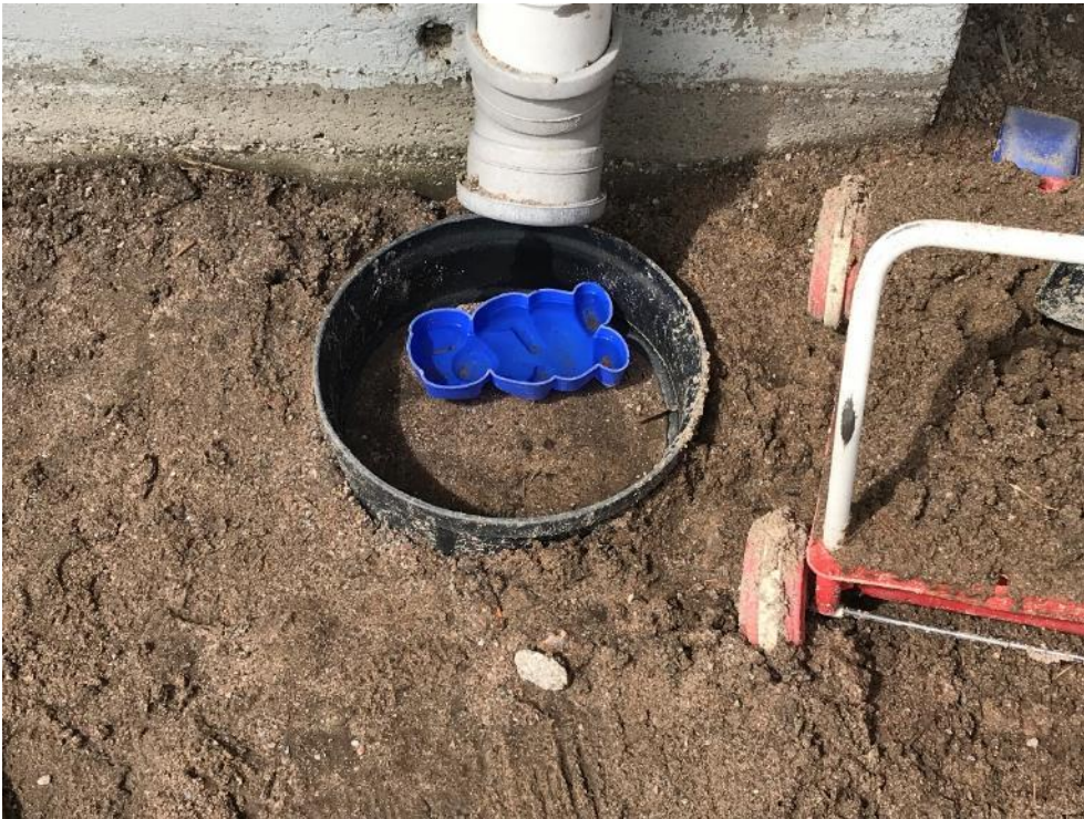
Kuva 5.15. Sisäpihan rännikaivoissa on hiekkaa.
