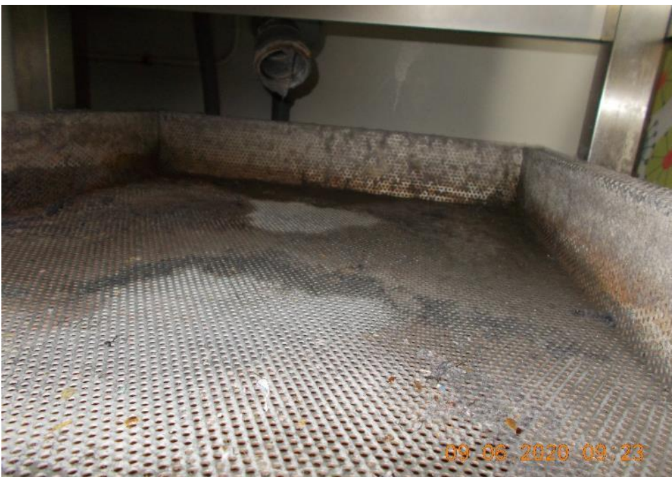
Kuva 4.8. Kodinhoitohuoneen 26 lattiakaivo ja koneet kaipaavat puhdistusta.
