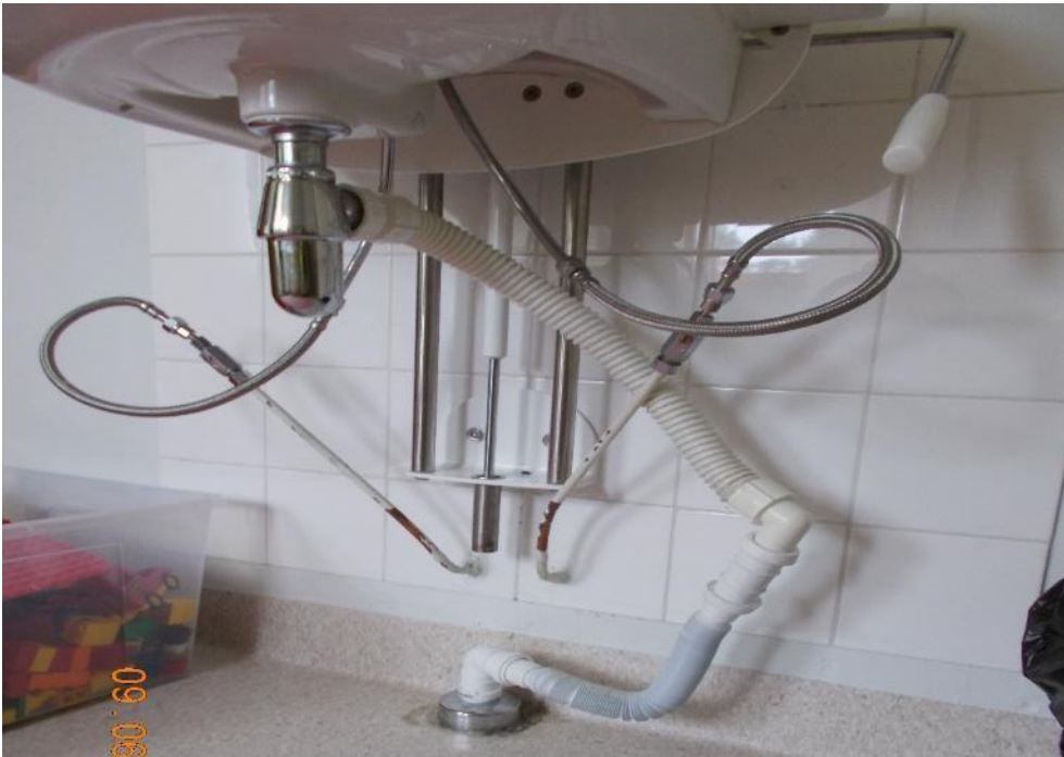
Kuva 5.9. Korkeussäädettävien pesualtaiden putkistojen kannakointi puuttuu.
