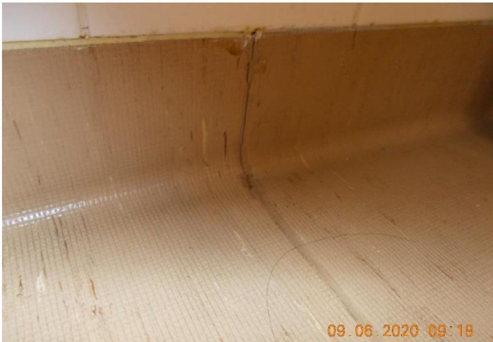
Kuva 4.11. Suihkun 35 lattiamaton seinälle nostossa on selvä rako.
