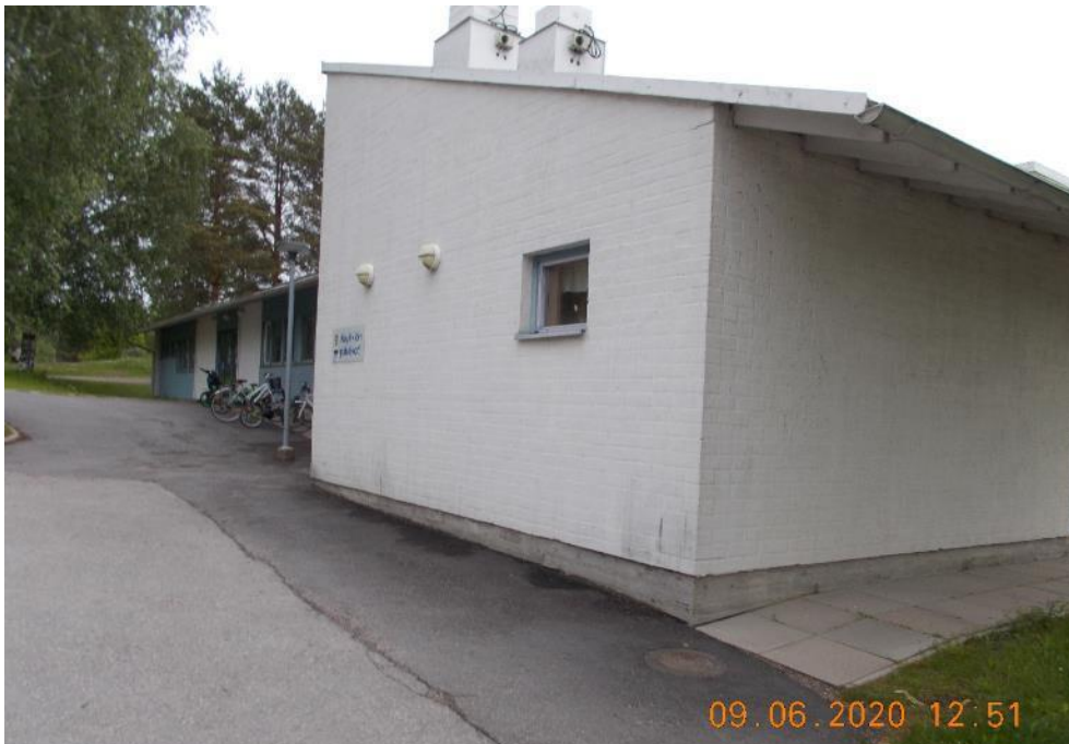
Kuva 4.21. Julkisivumuurauksista puuttuvat tuuletusraot alareunoista, slammauksissa värimuutoksia, halkeamia ym. vaurioita.
