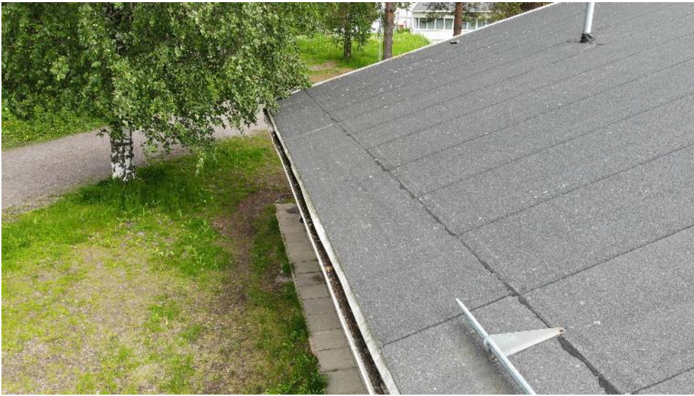
Kuva 4.17. Rakennuksen vieressä olevat puut roskaavat kattoja ja sadevesikouruja.
