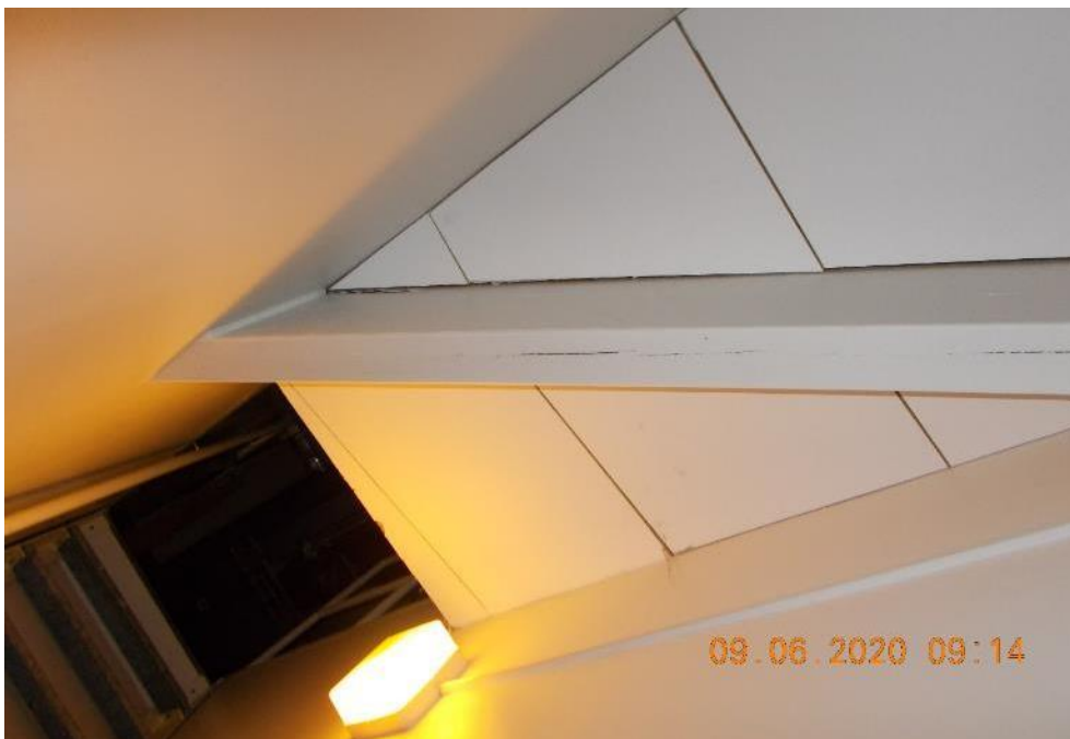
Kuva 4.6. IV-konehuoneen sisäänkäynnin katossa olevassa palkissa halkeamia.
