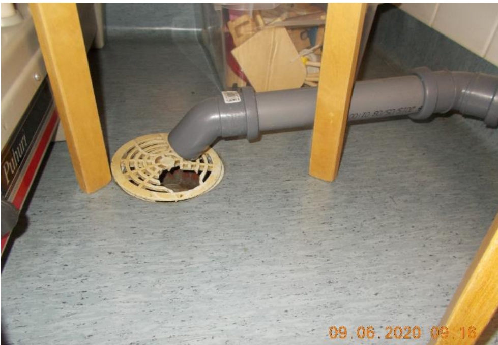
Kuva 5.10. Viemäriputki ei yletä lattiakaivoon asti.
