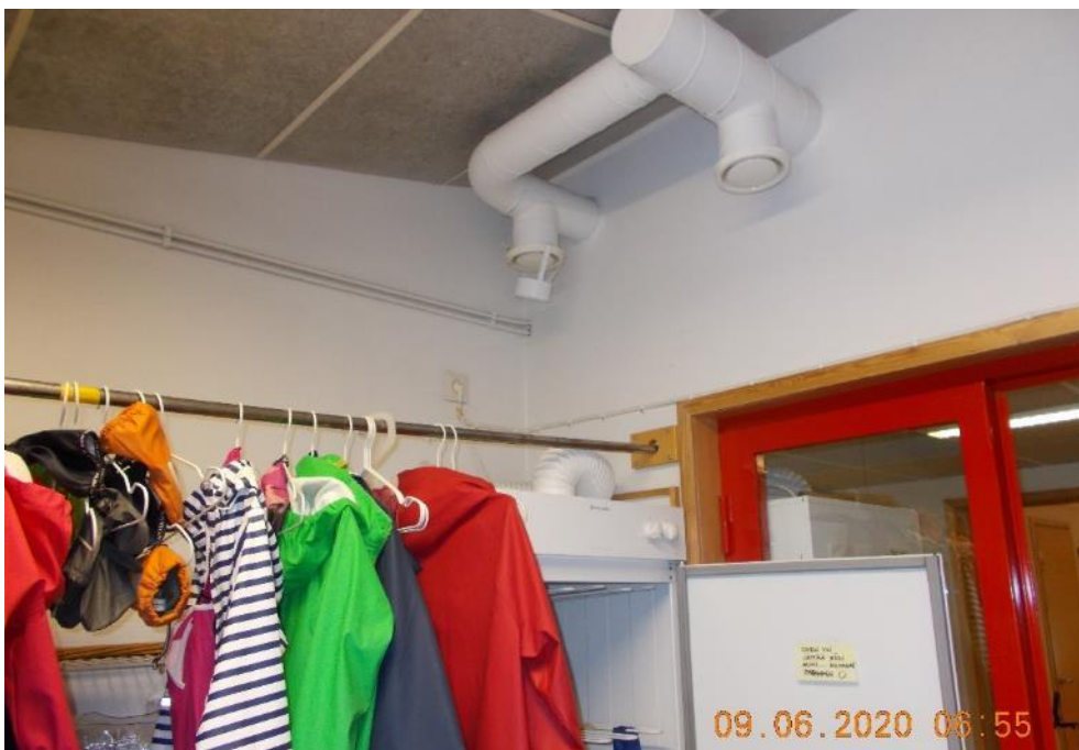
Kuva 5.6. Kuivauskaappien letkut on osin irti.
