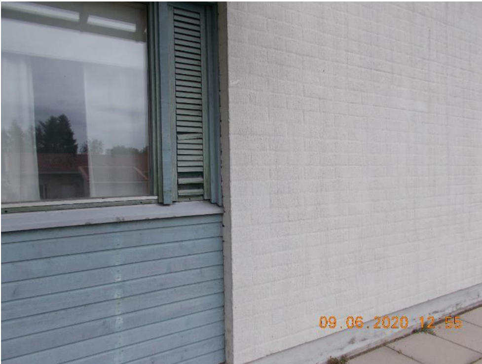
Kuva 4.27. Tuuletusikkunoiden tuuletussäleikköjä on rikottu.
