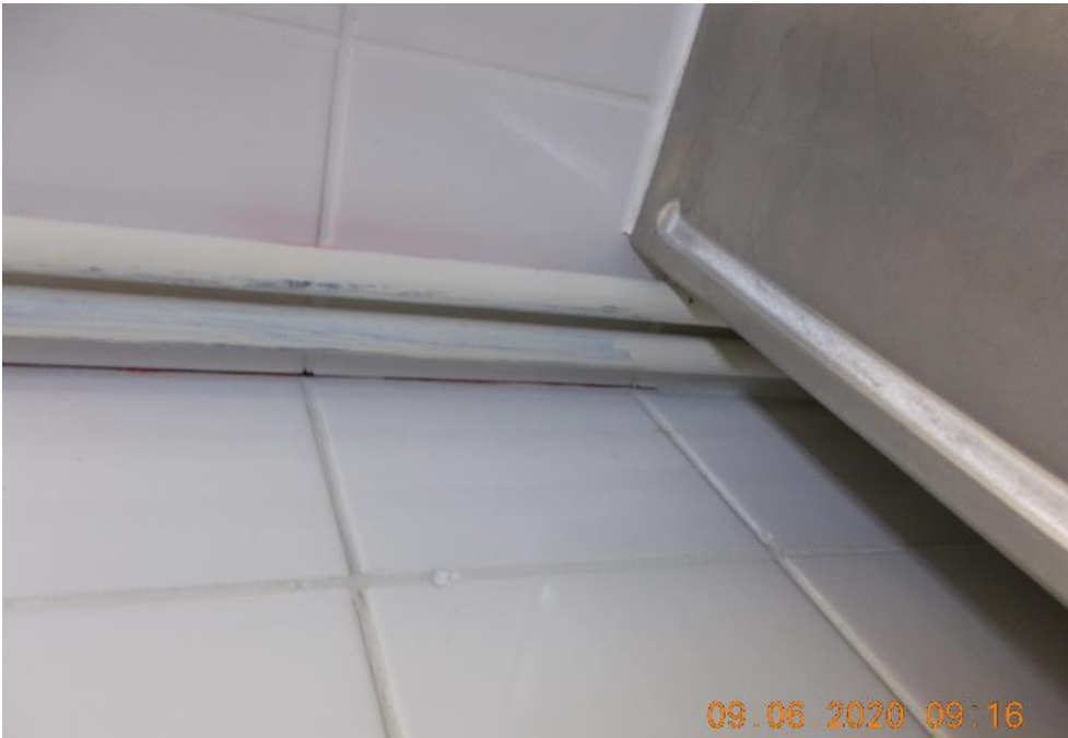
Kuva 4.7. WC:ssä 41 ikkunaseinällä puutuu nurkkasaumasta silikonista.
