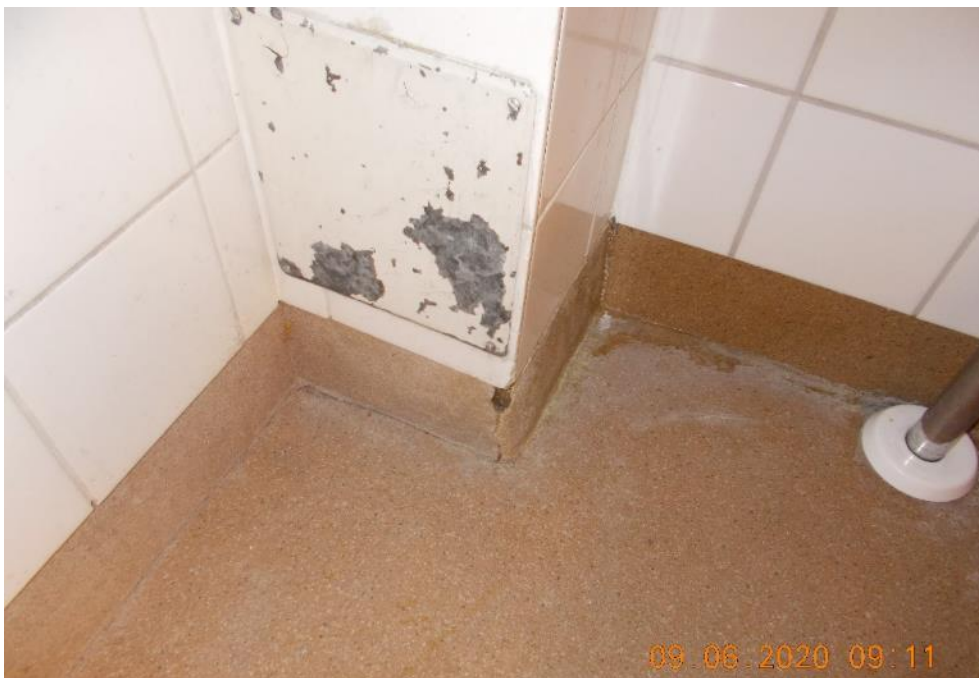
Kuva 4.4. Keittiön 46 lattiat märät ja kaadot eivät toimi.
