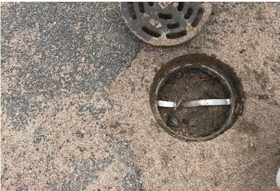
Kuva 5.16. Sadevesikaivoissa on hiekkaa.
