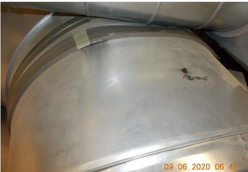
Kuva 5.4. Ilmanvaihtokonehuoneen kanavistossa on vuotoja.
