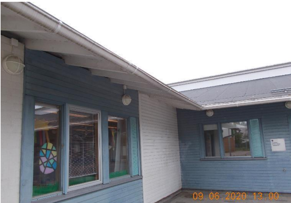
Kuva 4.16. Sadevesikourut ovat useassa kohdassa vääntyneet ja niiden kaadot eivät tämän vuoksi toimi.
