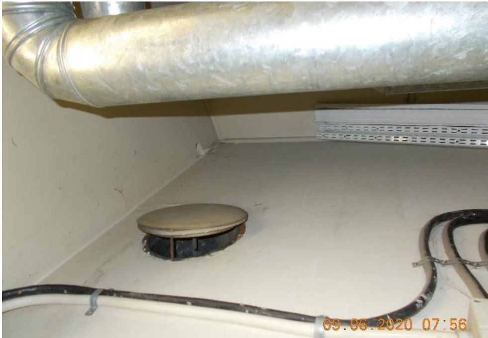
Kuva 5.5. Lämmönjakohuoneen venttiili on irti.
