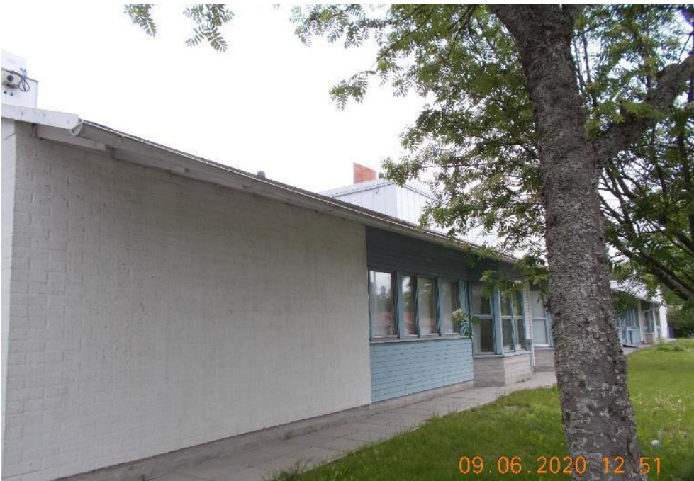
Kuva 4.20. Julkisivumuurauksista puuttuvat tuuletusraot alareunoista, slammauksissa värimuutoksia, halkeamia ym. vaurioita.
