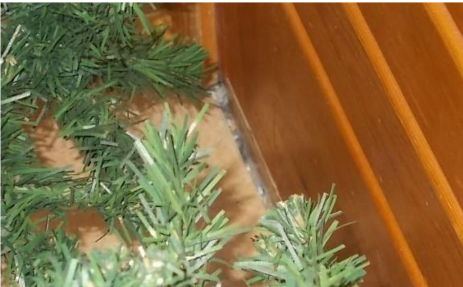
Kuva 4.16. Lattiamatto on vajaa.
