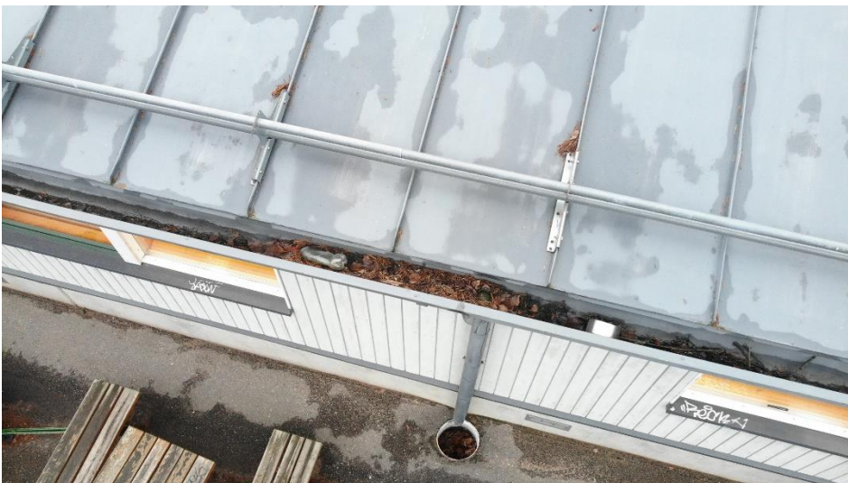
Kuva 4.2. Sadevesikourussa puun lehtiä, irtoroskia ja tennispallo syöksytorven tukkeena.
