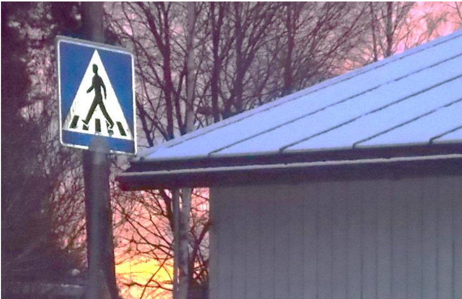
Kuva 4.7. Sadevesikouru on notkollaan.
