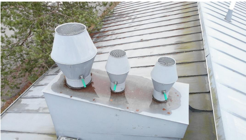
Kuva 4.4. Ilmastoinnin poistoputkien juurella vesi lammikoituu.
