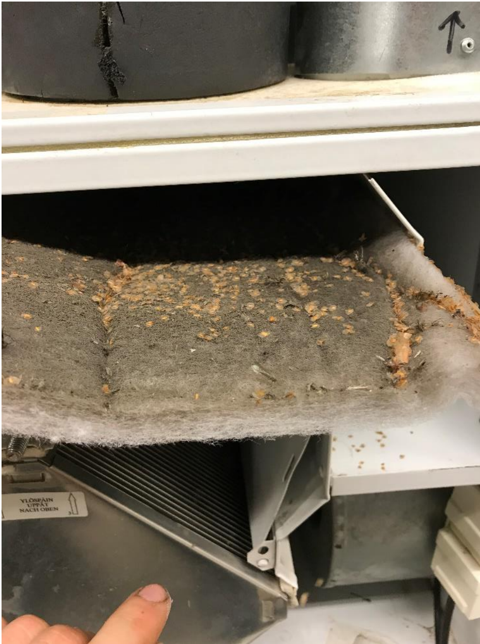
Kuva 5.3. Märkätilojen ilmanvaihtokoneen suodattimet likaiset.
