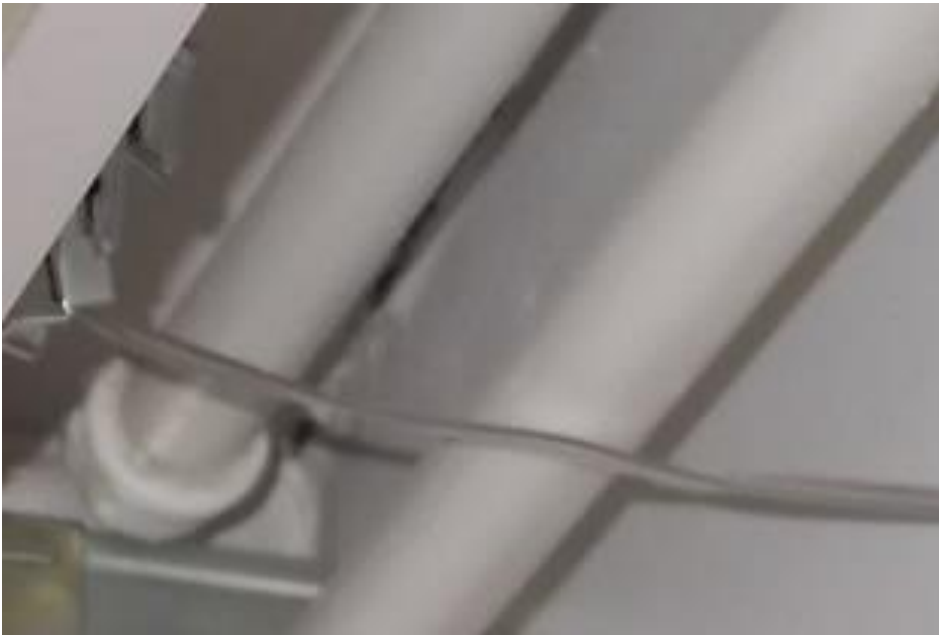
Kuva 4.13. Seinän ja katon tiivistämätön rakenneliitos.
