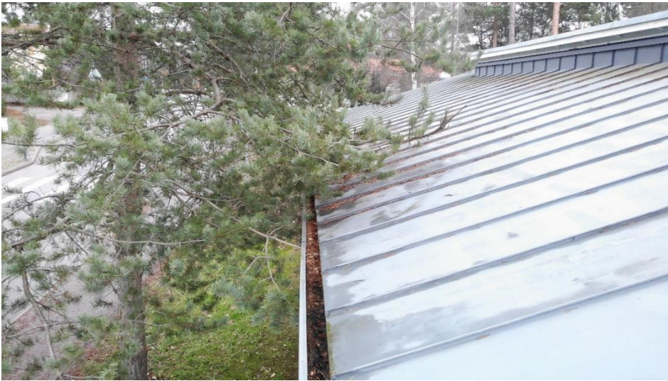
Kuva 4.3. Puun oksat ylettyvät katolle ja sadevesikouru on puhdistamatta.
