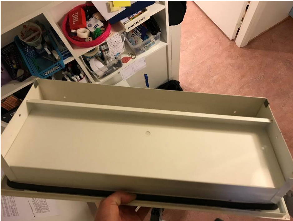
Kuva 5.1. Äänenvaimennuslevyjä puuttuu päätelaitteista.
