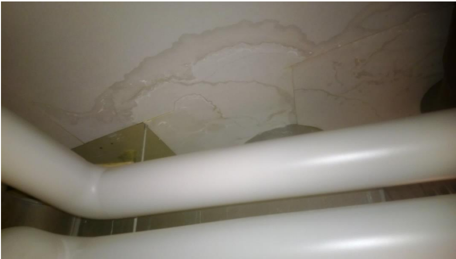
Kuva 4.5. Ilmastoinnin poistoputkien juuresta vesi vuotanut iv-konehuoneeseen.
