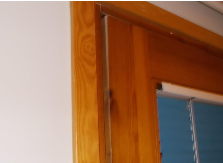
Kuva 4.10. Hätäpoistumistien ovi on kiero.
