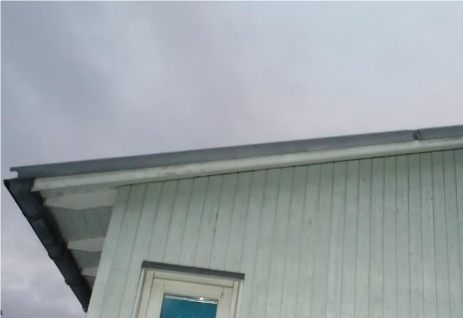
Kuva 4.9. Vesikaton päätypelti on pois paikoiltaan/irti.
