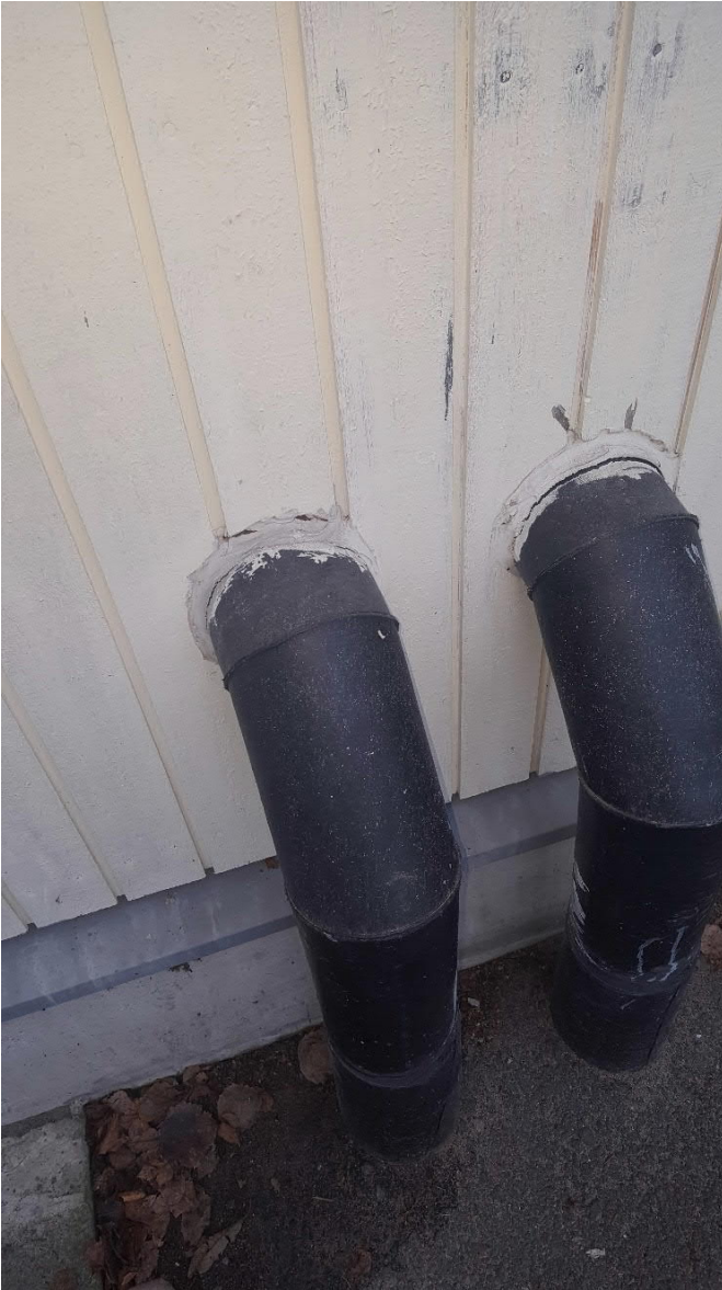
Kuva 12. Lämpöputkien läpiviennit lämmönjakohuoneeseen.
