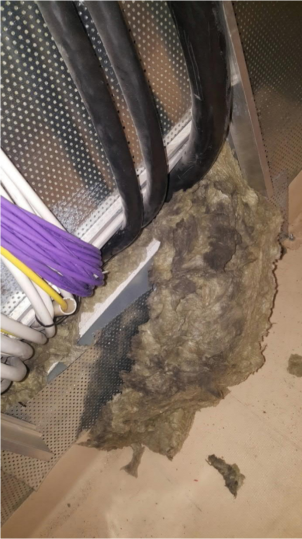
Kuva 3. Läpivienti teknisessä tilassa.
