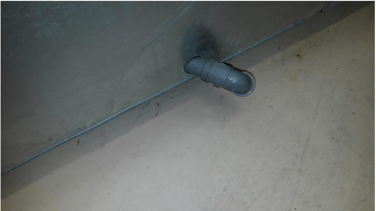
Kuva 13. Raitisilmakammio on ilman vesilukkoa.
