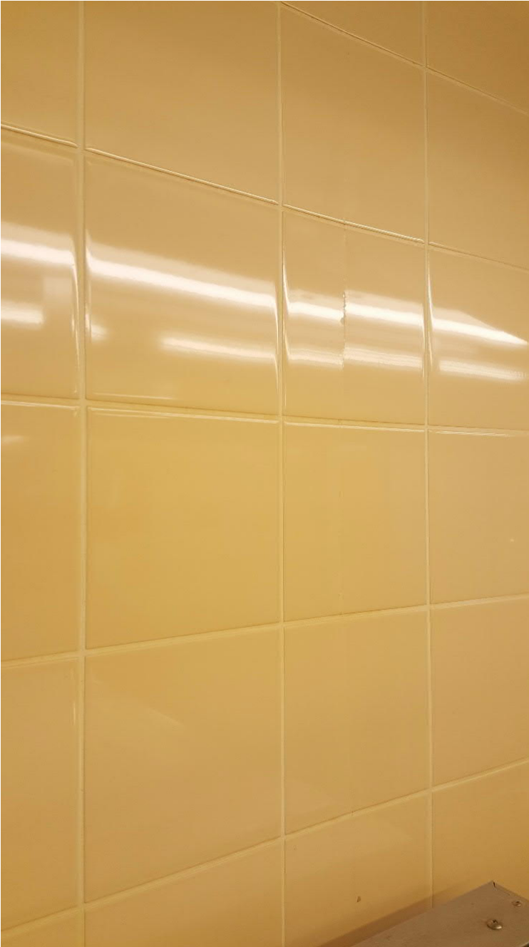
Kuva 6. Laatoitus halki keittiössä.
