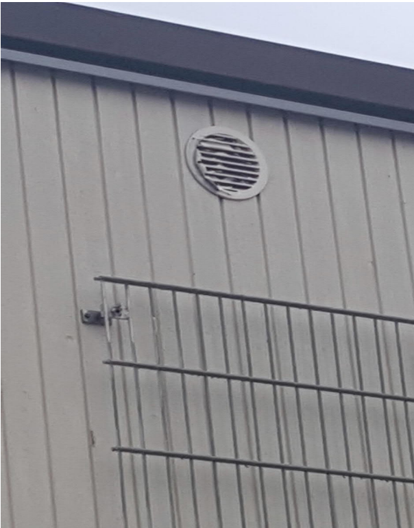
Kuva 10. Ulkosäleikkö on lähes tukossa.
