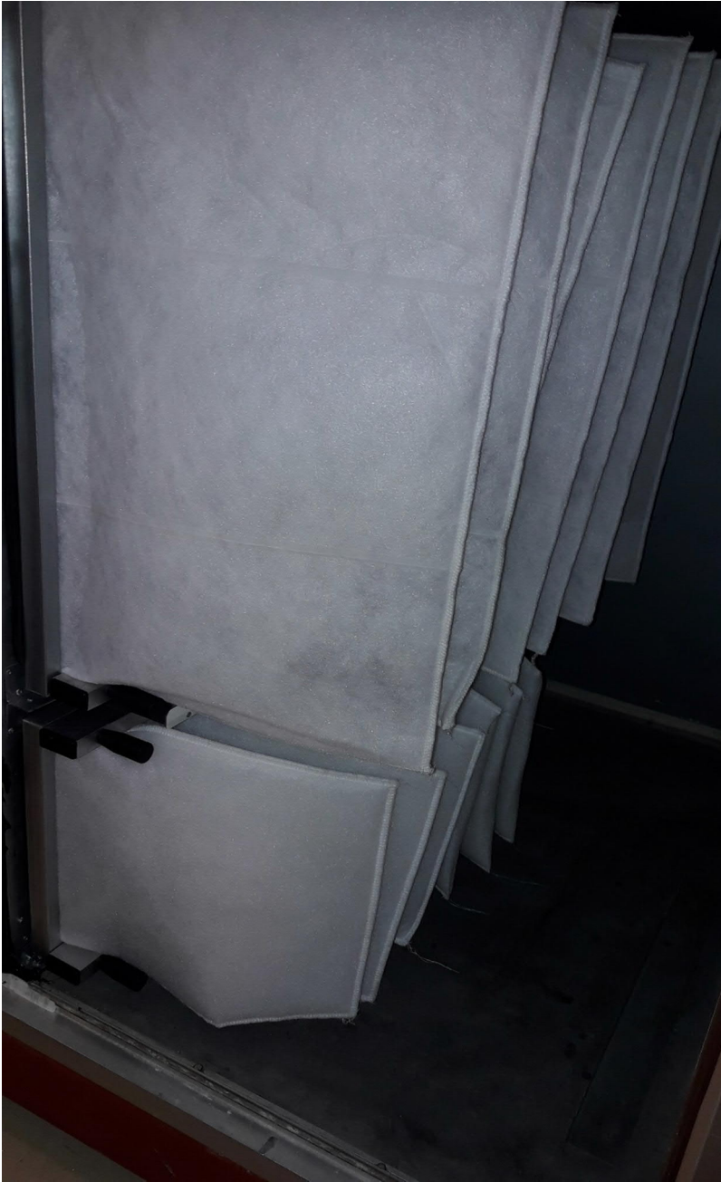
Kuva 15. Tuloilmakoneeseen on asennettu väärät suodattimet nuohoojien toimesta.
