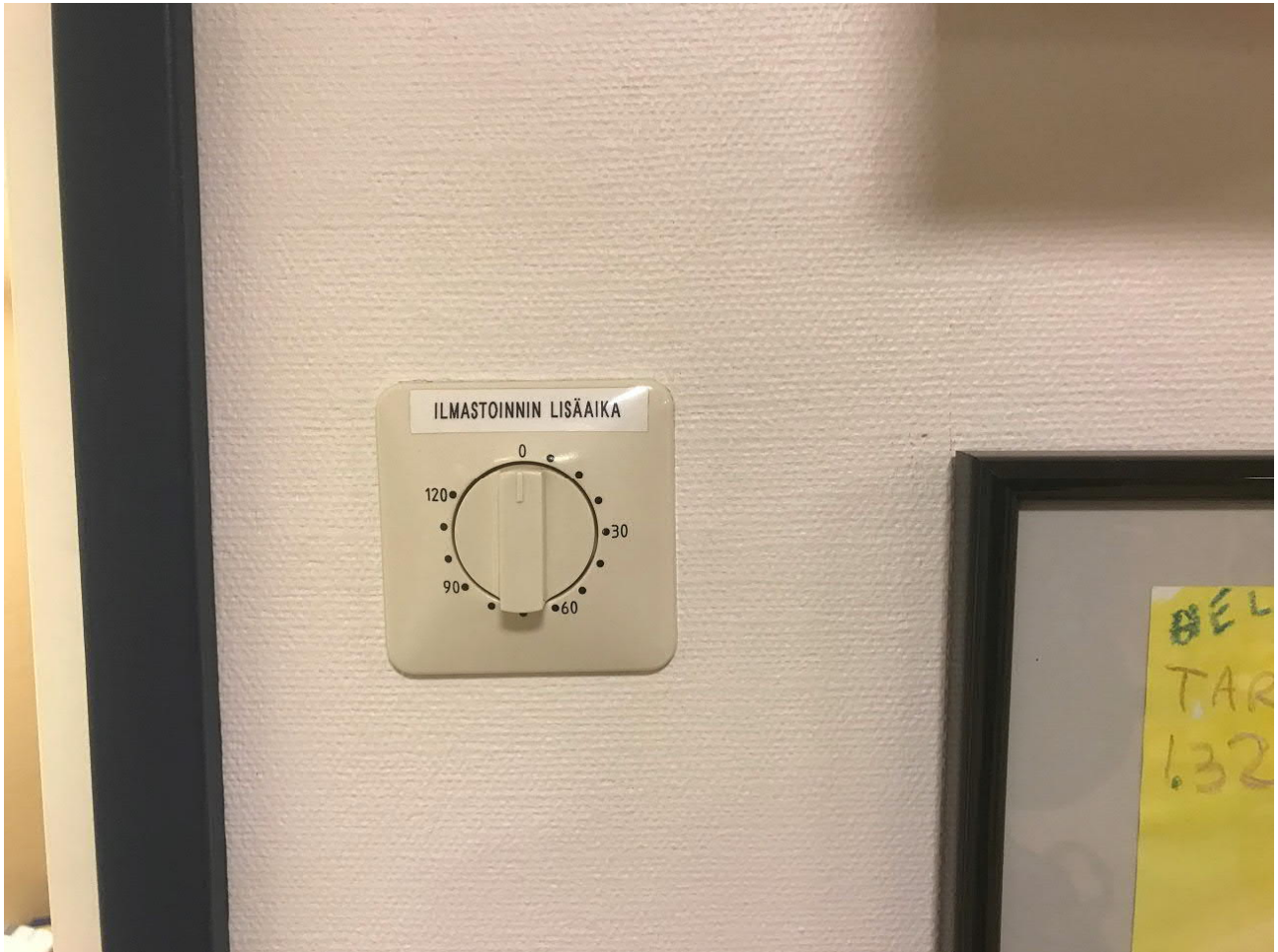
Kuva 16. Keittiön ilmanvaihdon lisäaikakytkin.
