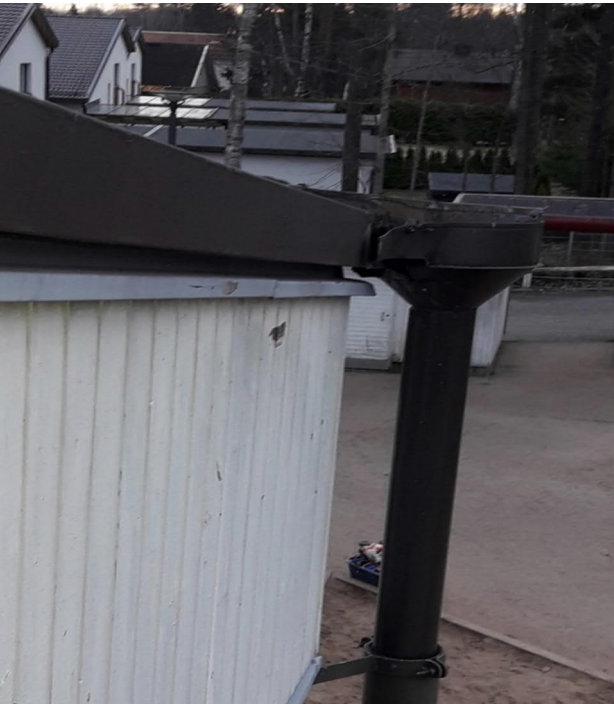
Kuva 11. Sadevesiränni on yläpäästä irti.
