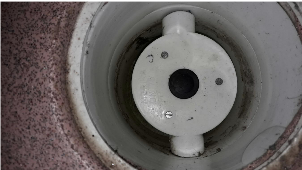
Kuva 14. Henkilökunnan suihkutilan lattiakaivossa ei ole vettä.
