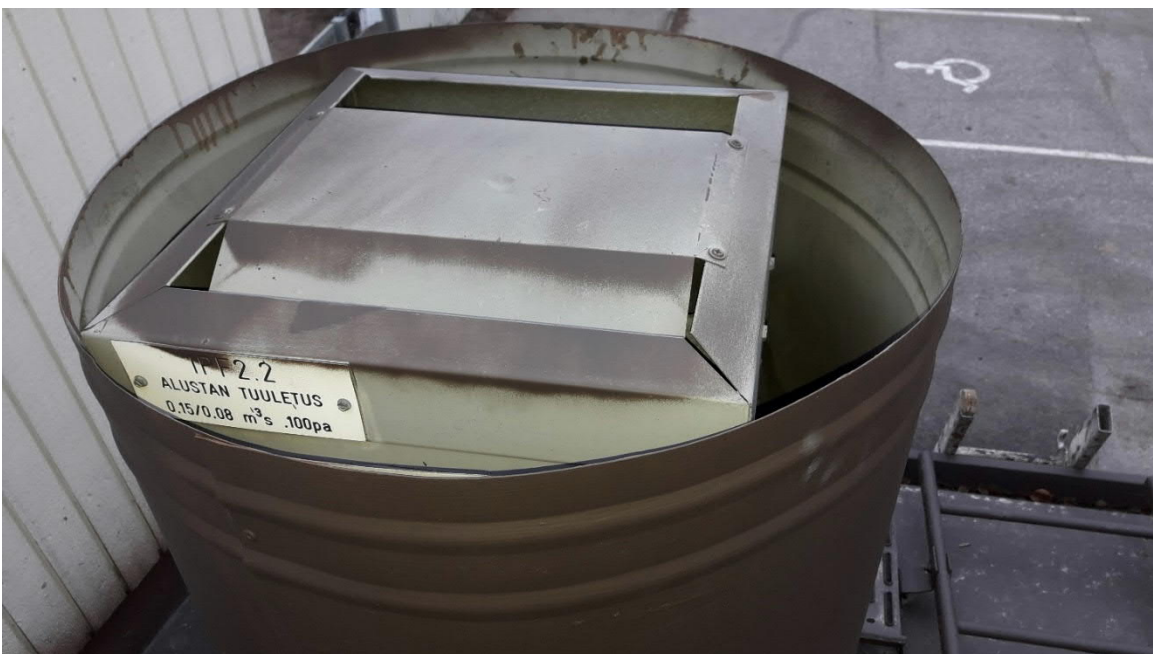
Kuva 20. Alapohjan vanha ilmanvaihdon poistokone.
