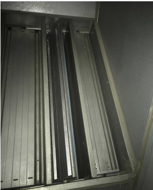
Kuva 18. TK1 LTO pellistä yksi pelti auki.
