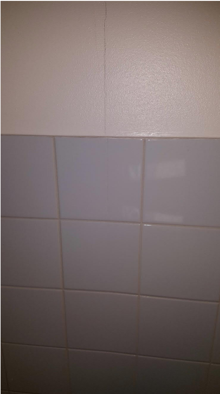
Kuva 5. Seinä ja laatoitus halki wc/pesutilassa.
