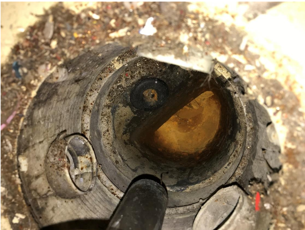
Kuva 5.5. Lämmönjakohuoneen lattiakaivo oli ilman vettä.
