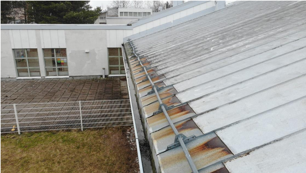
Kuva 4.1. Peltikatto on osin maalauksen tarpeessa.
