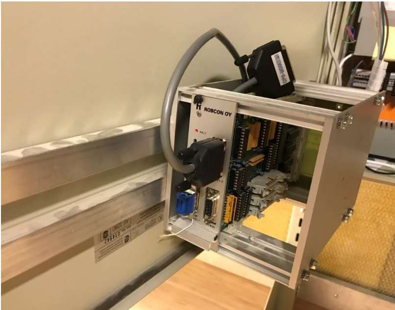
Kuva 6.3. Käytöstä poistettu elektroniikka on purkamatta.
