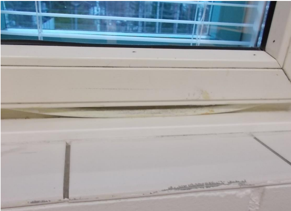
Kuva 4.3. Ikkunan tiiviste on irti.
