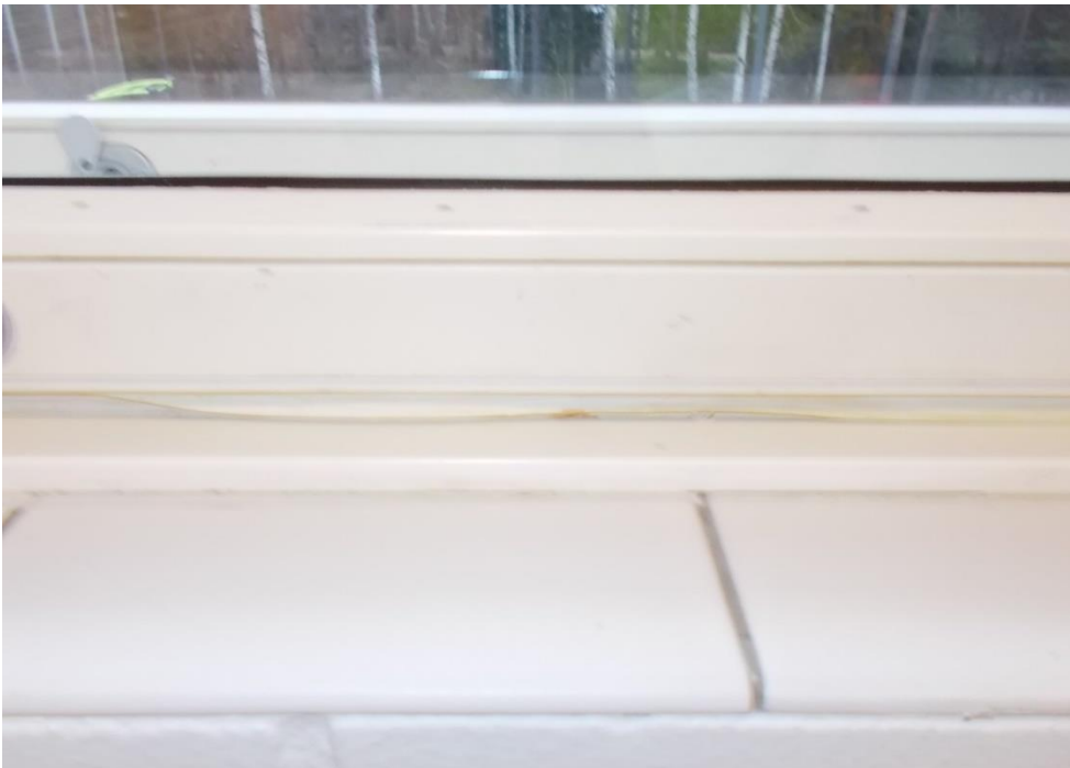
Kuva 4.2. Ikkunan tiiviste on irti.
