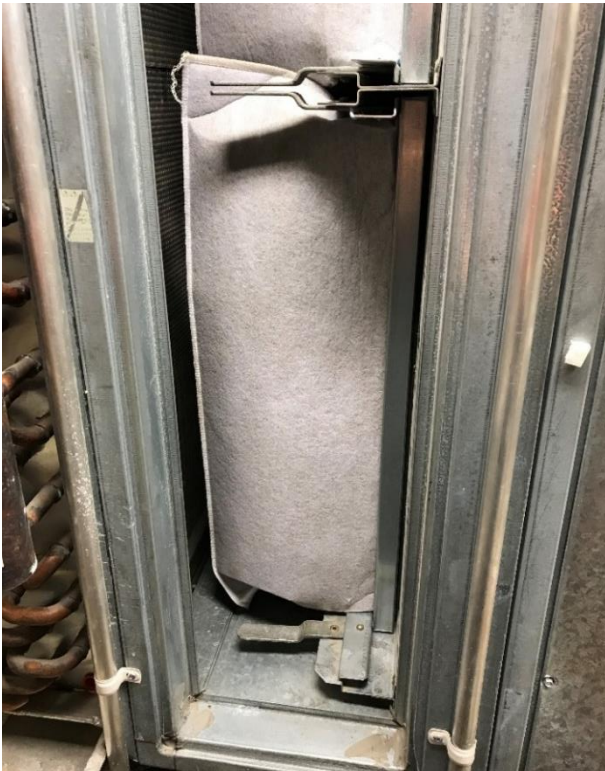
Kuva 5.1. Poistosuodattimien lukitukset eivät olleet kiinni.
