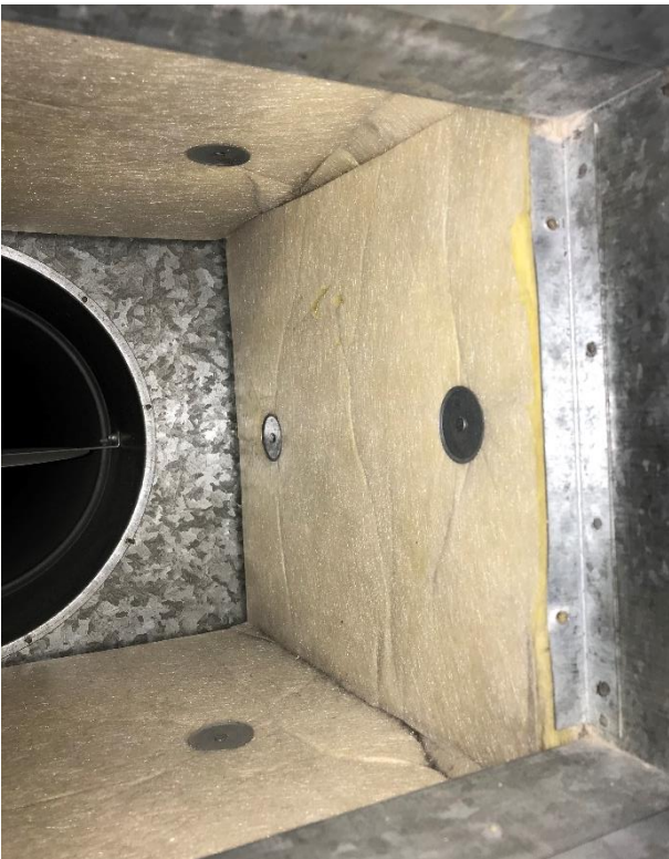
Kuva 5.3. Paineentasauslaatikoiden äänenvamentimet ovat tehty villasta.
