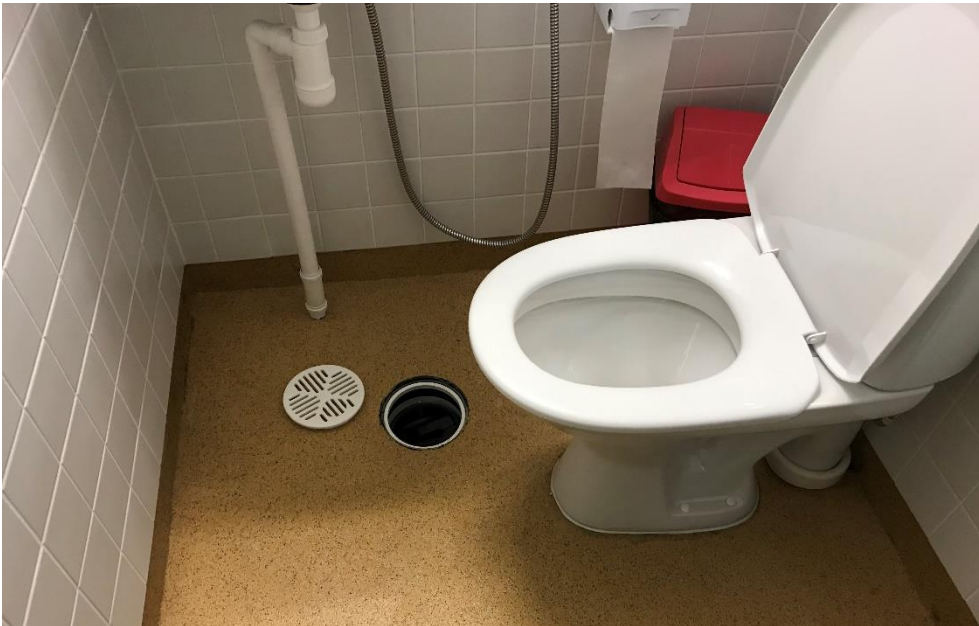
Kuva 5.4. Pukuhuoneen lattiakaivon vesilukko ei ollut paikallaan.
