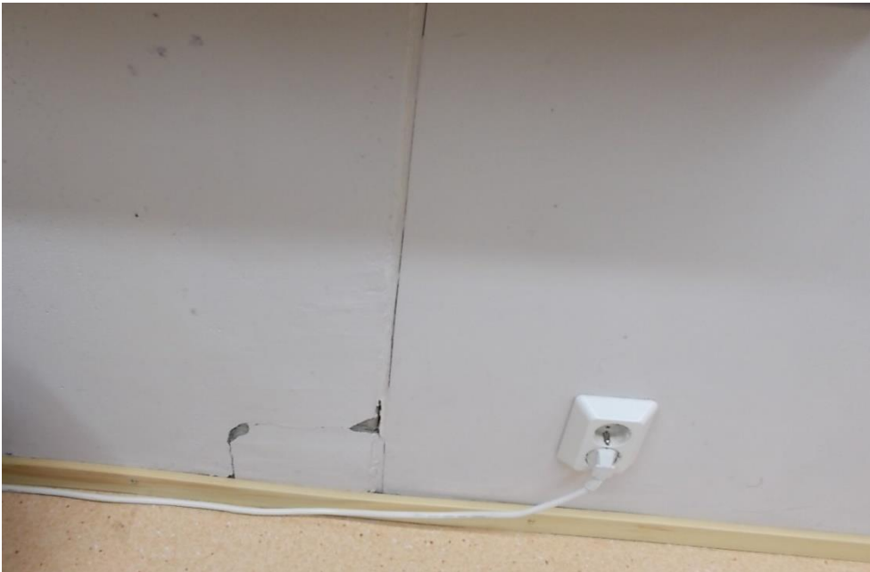
Kuva 4.7. Luokan 215 seinässä on halkeama.
