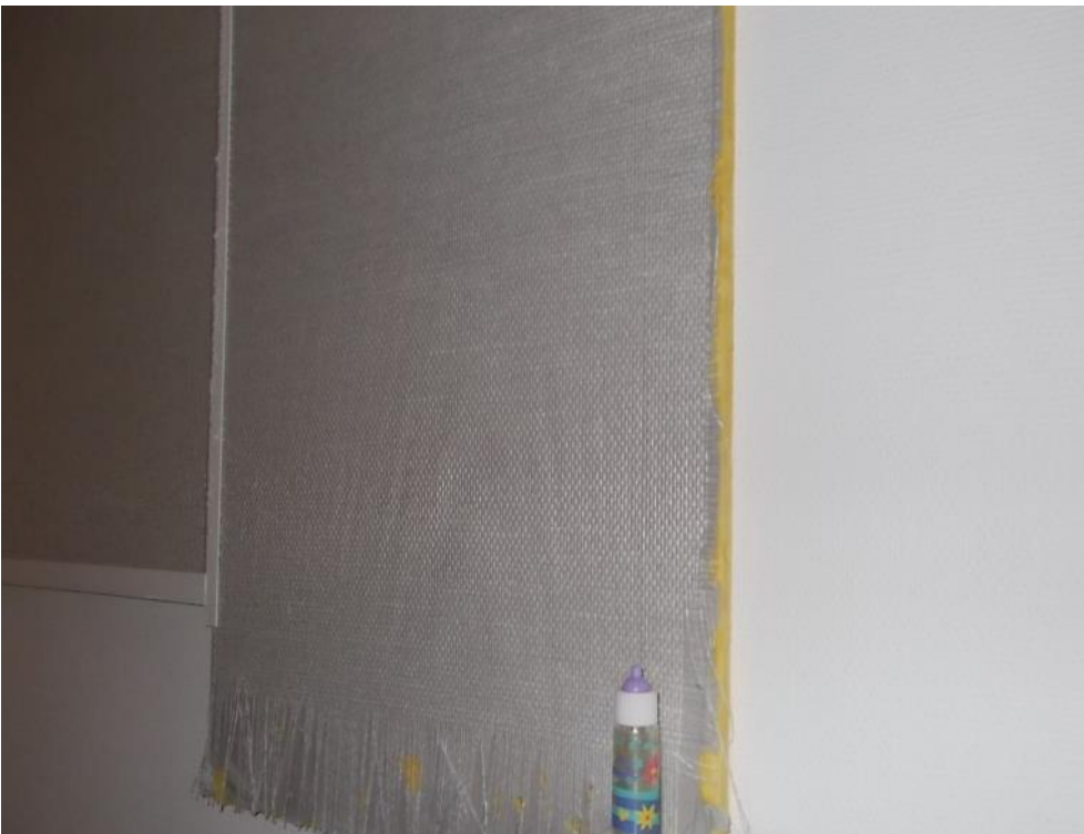
Kuva 4.12. Huonokuntoisia akustiikkalevyjä Monitoimitilassa 131.
