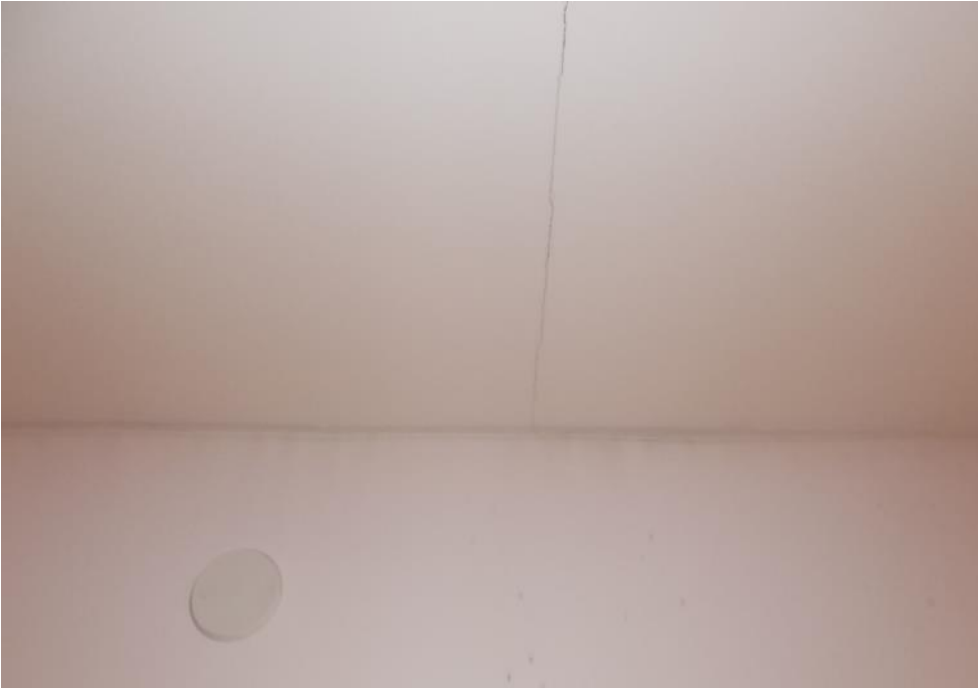
Kuva 4.9. Rakenneliittymästä on ilmavuotoa ja katossa on halkeama Taukotilassa 105.
