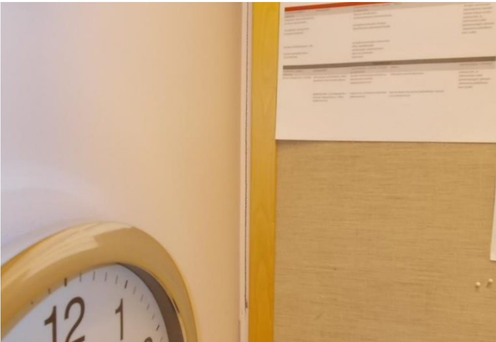
Kuva 4.8. Seinien liittymä on auki Toimistossa 104.
