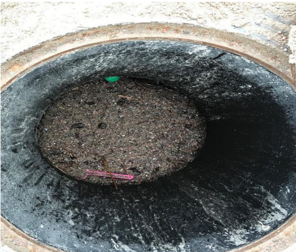
Kuva 5.10. Hiekkaa ja tavaraa sadevesikaivossa.
