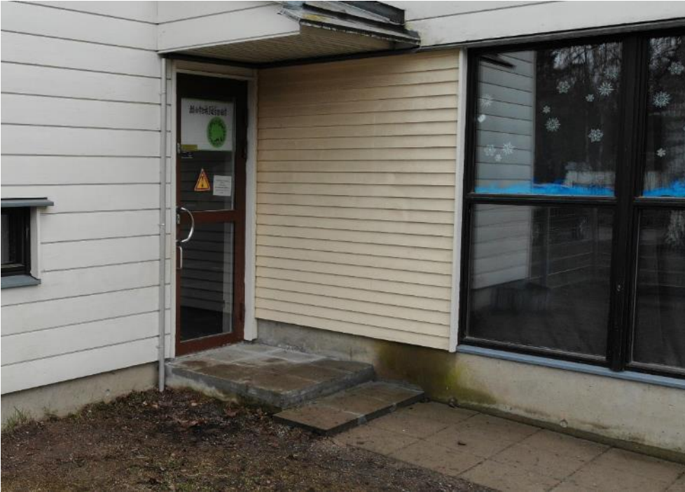
Kuva 4.5. Sisäänkäynnin lipan sadevedet kastelevat sokkelin.
