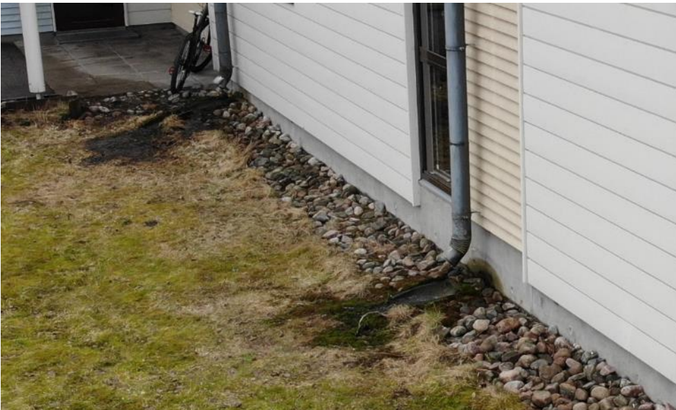
Kuva 4.6. Sadevesien poisjohtaminen on puutteellista.
