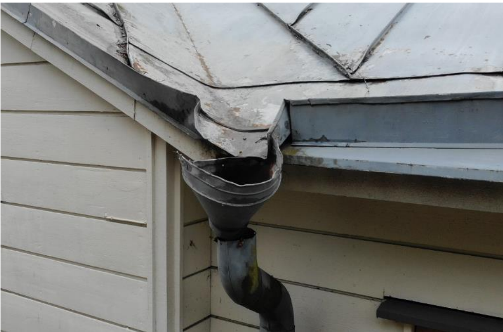
Kuva 4.4. Sadevesisuppilo on irti sadevesisyöksystä.
