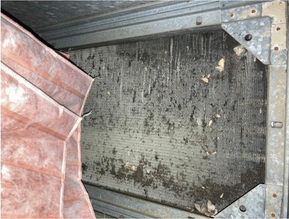
Kuva 5.1. Keittiön tuloilmakoneen lämmityspatterissa on likaa.
