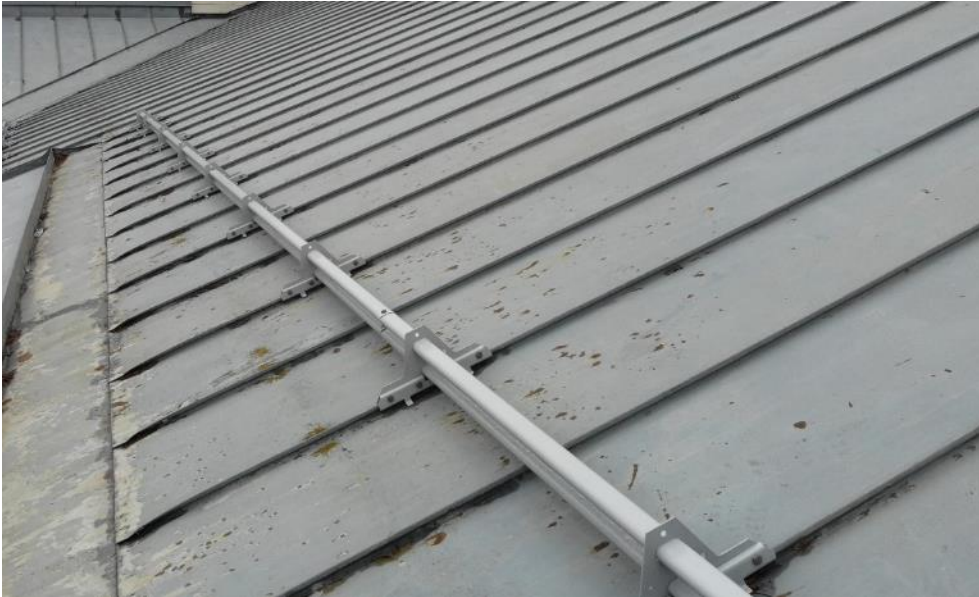
Kuva 4.1. Peltikate on osittain ruosteessa.
