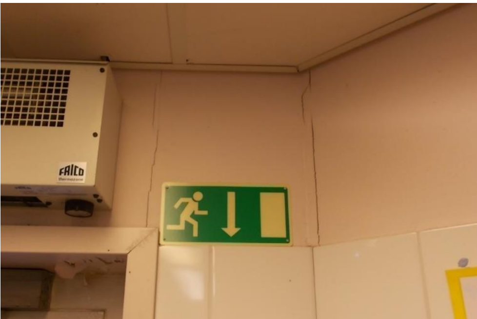
Kuva 4.14. Eteisen 137 seinissä on halkeamia.
