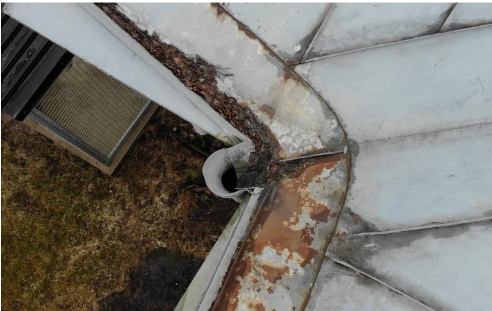
Kuva 4.2. Peltikate on osittain ruosteessa ja puhdistamatta.
