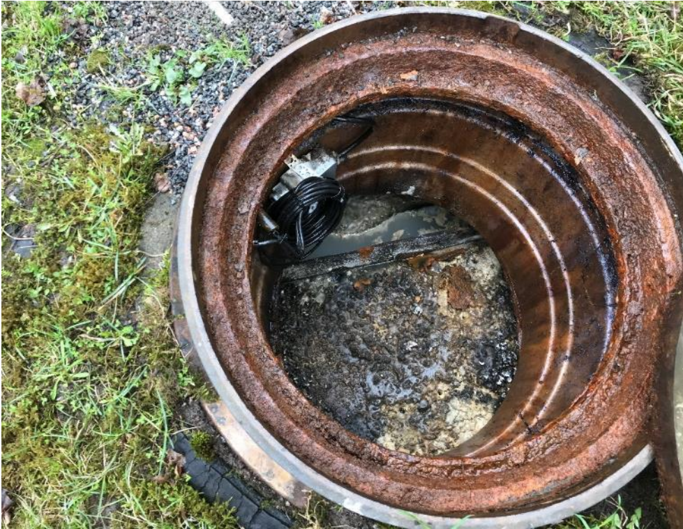
Kuva 5.9. Rasvanerotuskaivo on täynnä.
