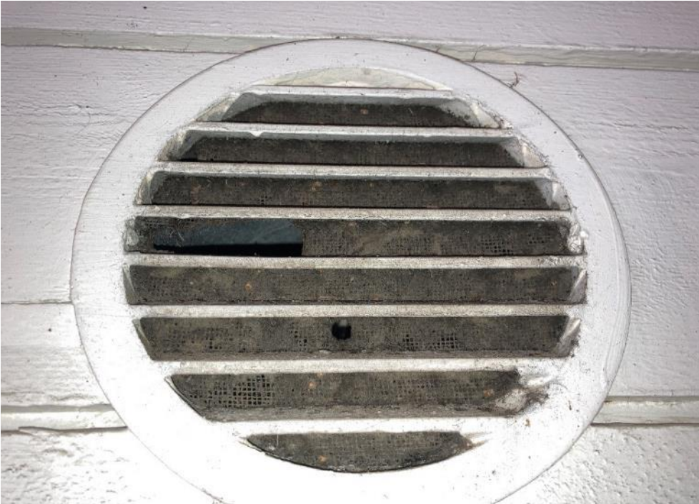
Kuva 5.3. Ulkosäleikön verkko on täynnä epäpuhtauksia.
