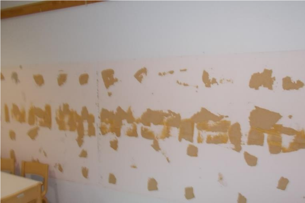
Kuva 4.7. Leikkihuone 103 seinältä on poistettu akustiikkalevyt.
