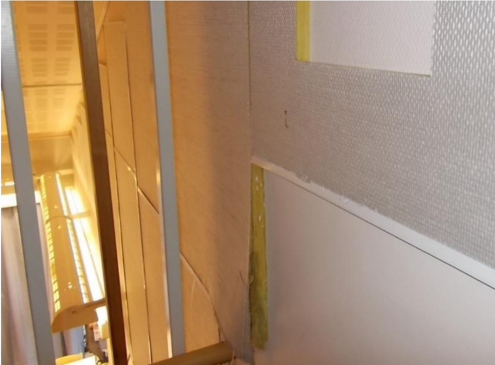
Kuva 4.15. Huonokuntoisia akustiikkalevyjä Parvella 201.
