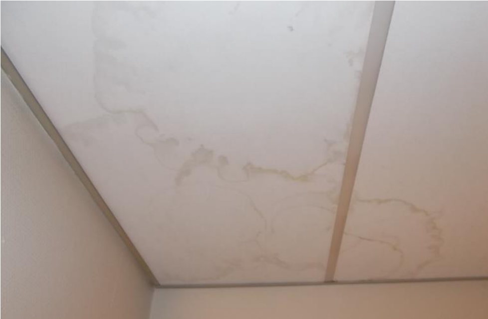
Kuva 4.13. Katossa on vesivuotojälkiä Eteisessä 137.
