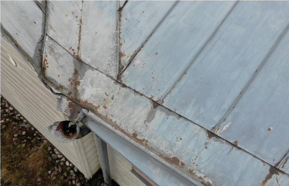
Kuva 4.3. Sadevesisuppilo on rikkoutunut.
