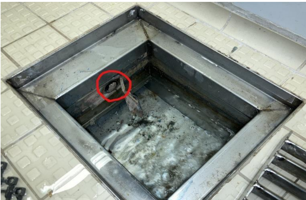
Kuva 5.6. Huoneen 135 lattiakaivon puhdistustulppa väljä.
