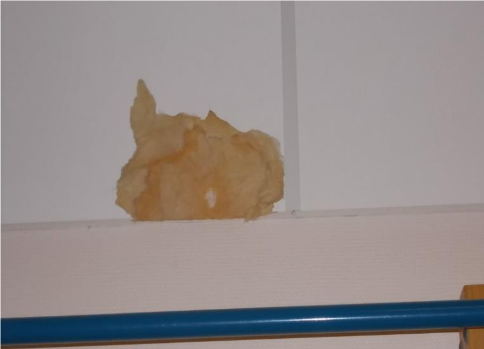
Kuva 4.11. Akustiikkalevy on rikki Monitoimitilassa 131.
