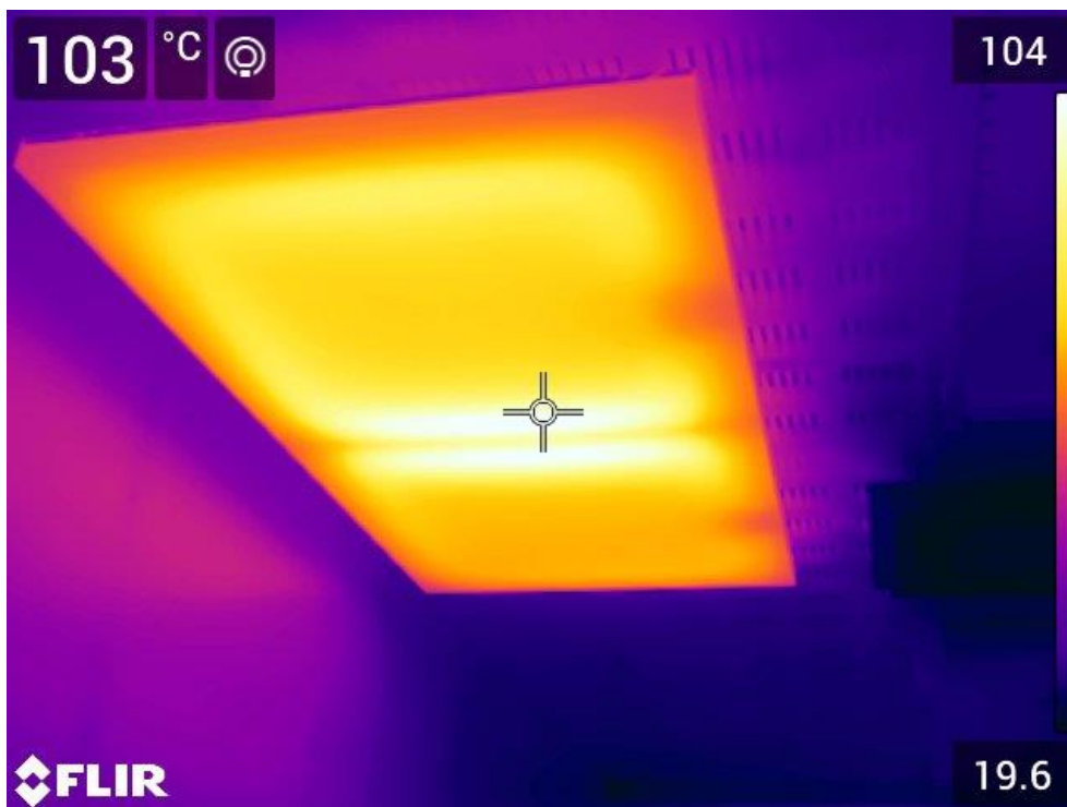
Kuva 5.8. Työtilan 128 kattolämmityselementin lämpötila on 103°C.
