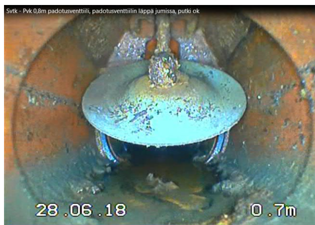
Kuva 42. Padotusventtiilin läppä on jumissa. (Kuva Drainman Oy:n videokuvauksesta)
