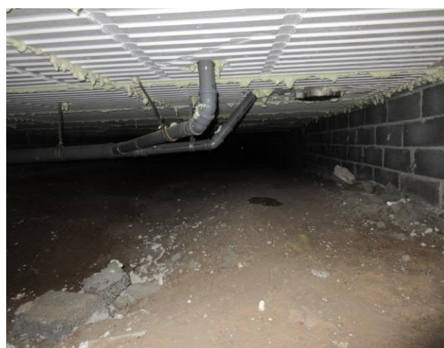
Kuva 15. Vuoto lattiakaivossa/viemäriputkessa. Kohta on Opintien ja Opinkujan puoleisten siipien taitteessa sisäpihan puolella WC-tilojen kohdalla.
