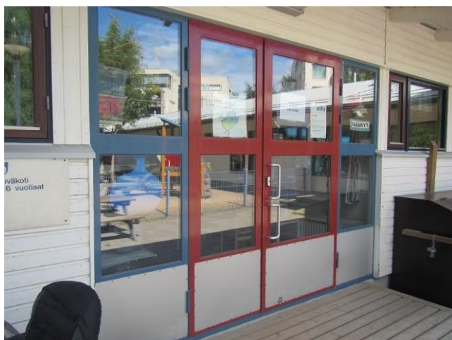
Kuva 29. Ulko-ovissa on käytön ja ikääntymisen aiheuttamaa lievää vaurioitumista.
