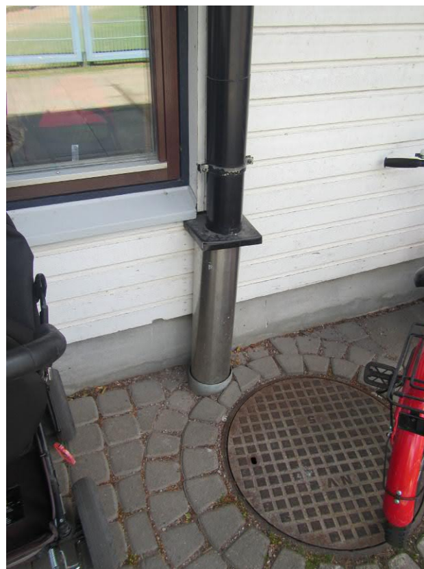
Kuva 39. Syökytorvista vesi ohjautuu maan alle keruujärjestelmään.
