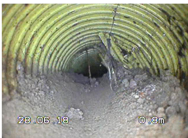
Kuva 41. Salaojaputkissa on vaihteleva määrä hiekkaa. Kuva on otettu kohdasta, jossa salaojaputki on rikkoontunut. (Kuva Drainman Oy:n videokuvauksesta)
