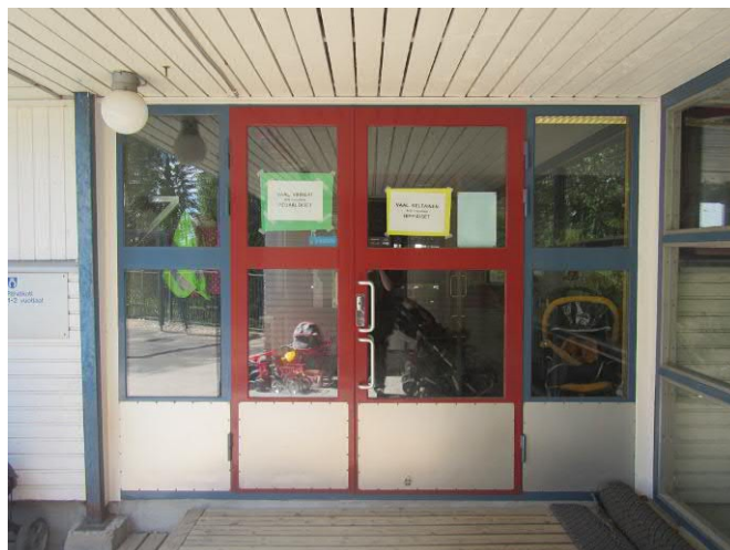
Kuva 9. Ulko-ovien punaisessa pinnoitteesta on sinkkiä ja pilarin sinisessä pinnoitteesta kuparia.
