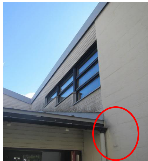
Kuva 35. Nukkumaparven kohdalla julkisivuverhous on likaantunut. Vesikatolta poistuva vesi ohjautuu osin seinäpinnalle.
