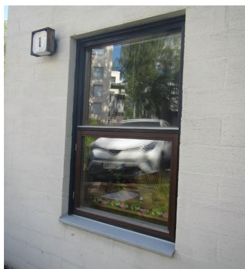
Kuva 28. Muurattujen julkisivujen kohdalla vesipeltien kallistus on puutteellinen.
