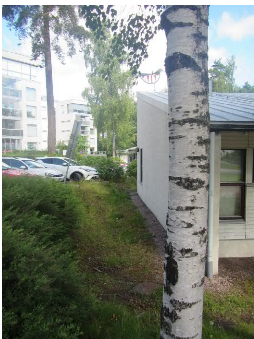
Kuva 32. Etenkin Opinkujan alkupäässä maanpinta kallistuu rakennusta kohti.
