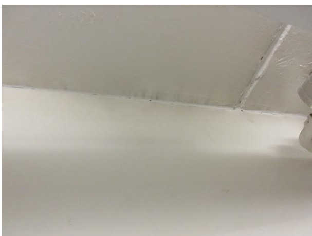
Kuva 21. Pukuhuoneen ulkoseinän ja katon rajassa ilmavuotojälkiä.
