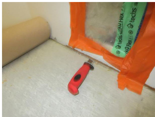
Kuva 20. Seinälevytyksen ja lattian välissä on rako.
