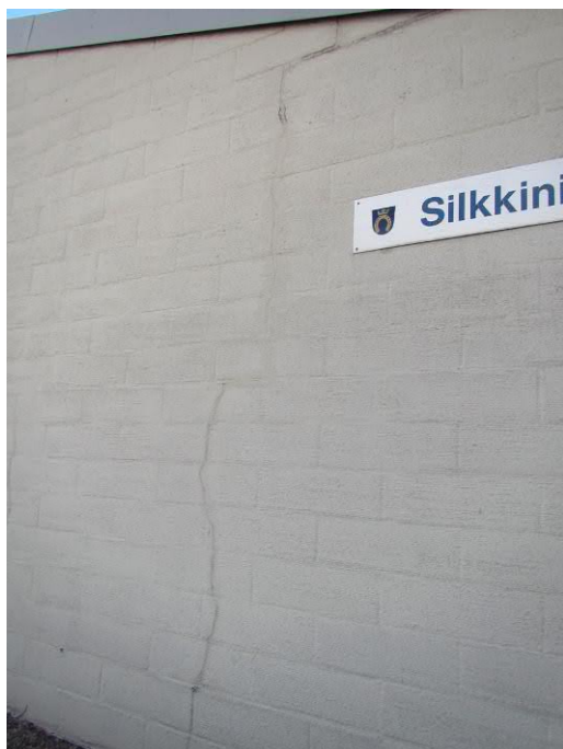
Kuva 22. Muuratuissa julkisivurakenteissa on useita halkeamia.
