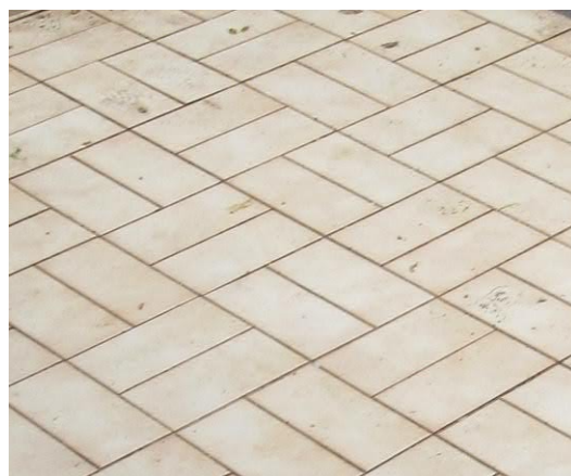
Kuva 7. Ryhmäperhepäiväkodin parvekkeen laatoitus.
