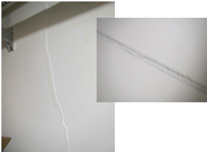
Kuva 16. Kellarin seinän ja välipohjan halkeama.
