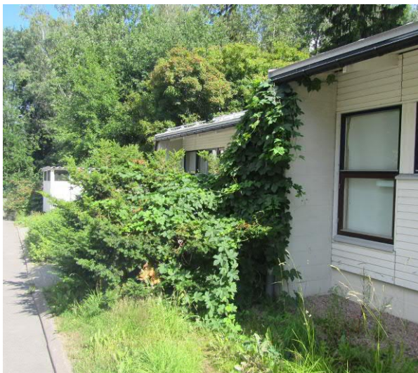
Kuva 34. Rungas kasvillisuus heikentää julkisivurakenteiden tuulettuvuutta ja pitää pinnan helposti kosteana.
