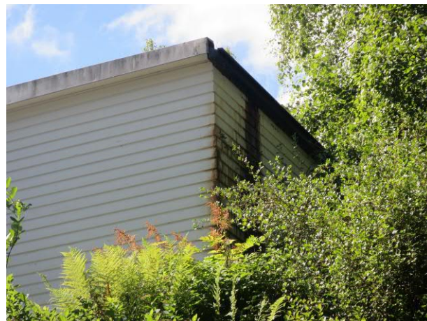
Kuva 25. Varaston syöksytorvi on tukkeentunut ja vesi pääsee kastelemaan seinärakennetta.
