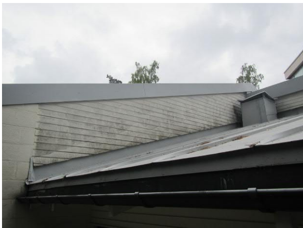
Kuva 24. Varjoisilla ja suojaisilla paikoilla puuverhoukset ovat likaantuneet ja niiden pinnoille on kertynyt lievää orgaanista kasvustoa.
