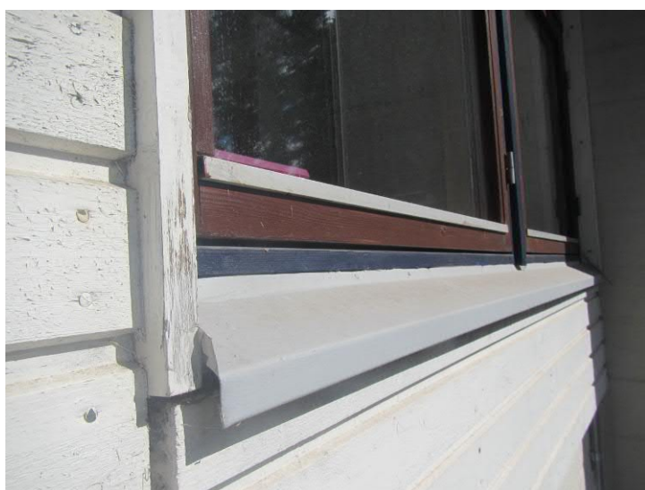
Kuva 27. Ikkunoiden listoissa esiintyy lieviä pinnoitevauriota.
