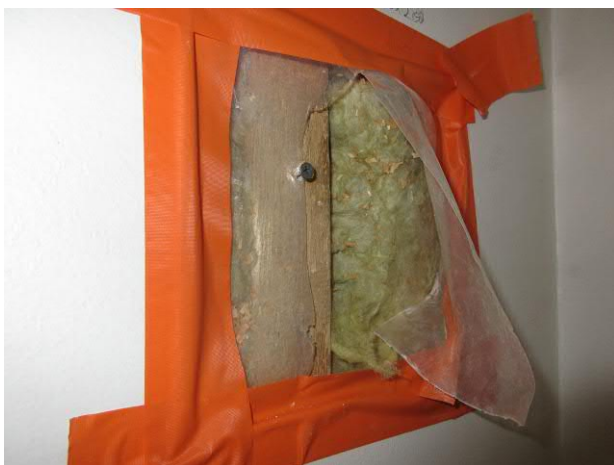
Kuva 19. RAK US2 n. 1 m:n korkeuteen lattiapinnasta. Eristeen joukossa on purua.
