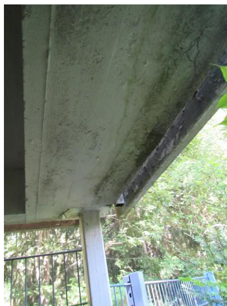
Kuva 31. Parvekelaatan alapinnalla ja kaiteessa on runsaasti orgaanista kasvustoa.
