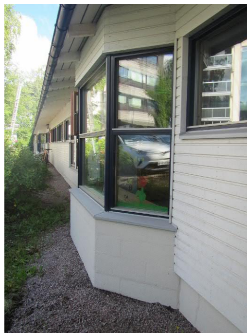
Kuva 23. Erkkereiden kohdalla on useita puutteita, jotka heikentävät seinärakenteen rakennusfysikaalista toimintaa.
