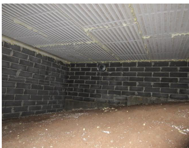
Kuva 14. Yleiskuva ryömintätilasta. Poistopuhallin on Opintien puoleisella sivustalla.
