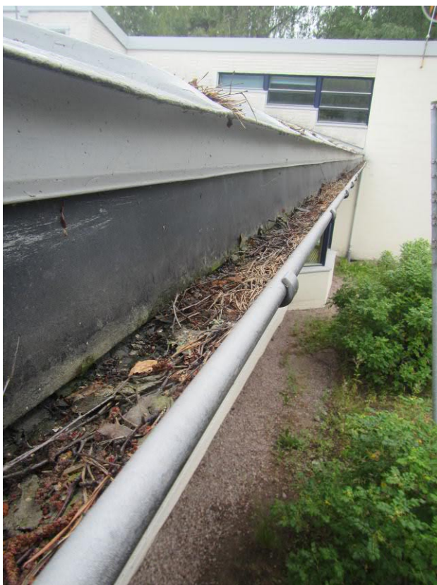
Kuva 38. Opinkujan puolella vesikouru on tukossa.
