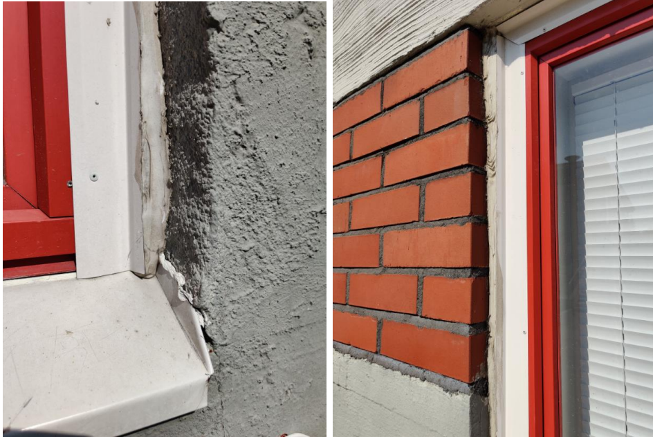
Kuvat 10, 11. Ikkunapellitysten tiivistysten kautta saattaa päästä kosteutta ulkoseinärakenteeseen. Sisäpuolella ei havaittu kosteuden aiheuttamia jälkiä.
