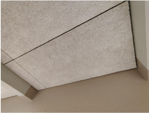
Kuva 5. Oppilashuollon tilojen edustalla olevan käytävän katossa on sementtikuitulevyä. Sementtikuitulevystä saattaa irrota sisäilmaan hiukkasia.
