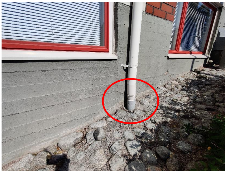
Kuva 9. Ulkopuolella maataytön väärät kallistukset mahdollistavat lumen ja veden kertymisen seinän lähelle, joka lisää seinän kosteusrasitusta. Syöksytorven epätiivis asennus lisää seinän kosteusrasitusta. Sokkelin ulkopuolella ei havaittu vedeneristettä.
