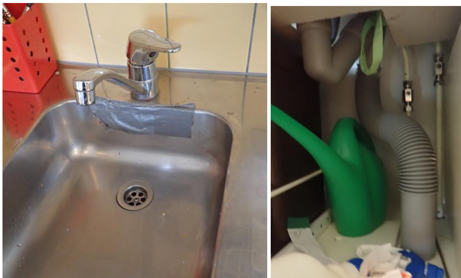
Kuvat 3 ja 2. Ryhmähuoneessa 15 havaittiin sisäilmassa voimakasta viemärin hajua. Haju pääsee todennäköisesti sisäilmaan lavuaarin viemäriiitoksista. Henkilökunta oli teipannut lavuaarin ylivuotoaukon hajun vähentämiseksi.
