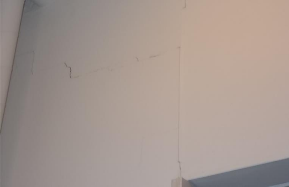
Kuva 4.8. Eteisten 104 ja 118 seinissä on halkeamia.
