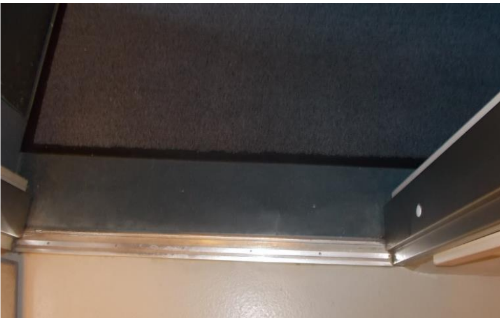
Kuva 4.7. Keittiön A101 ovella on lattiamatto irti alustastaan.
