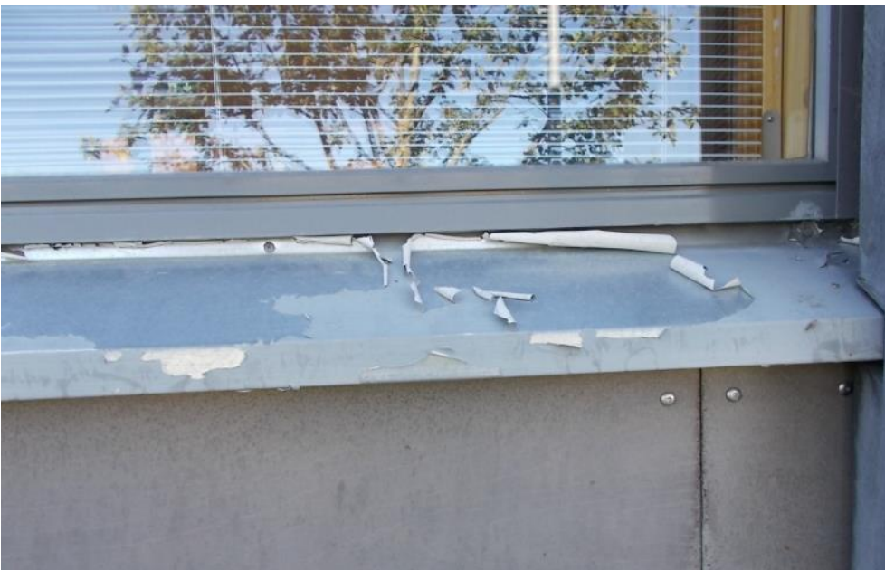
Kuva 4.5. Ikkunoiden vesipelleistä on pinnoite irti.
