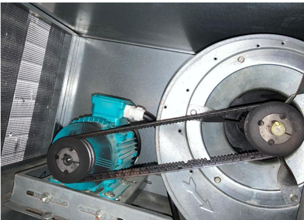
Kuva 5.2. TK4 keittiön ilmanvaihtokoneen kiilahihnat ovat vaihtokunnossa.
