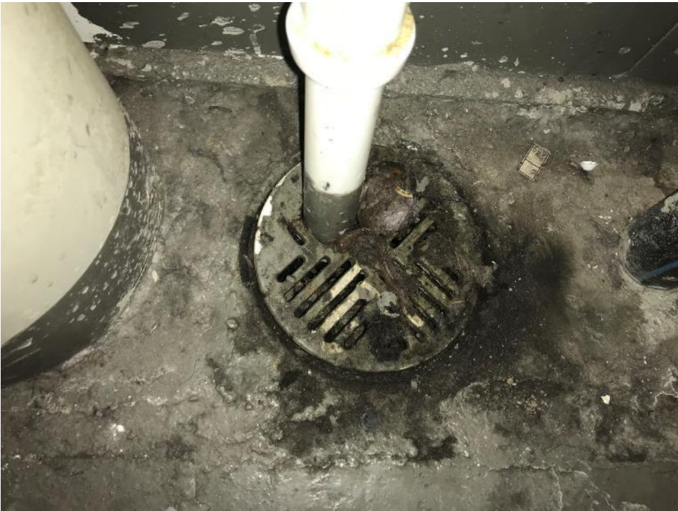
Kuva 5.4. Lämmönjakohuoneen lattiakaivo on tyhjä ja siivouksen tarpeessa.
