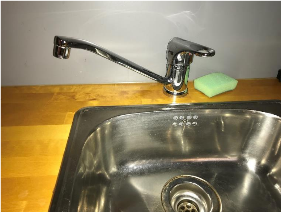
Kuva 5.5. Useista allashanoista puuttuu sivuliikerajoittimet ja vesi pääsee pöydälle.
