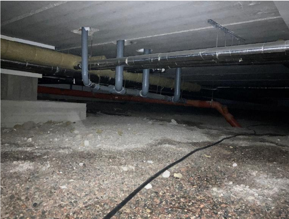
Kuva 5.3. Alapohjan palokatkot puuttuvat.
