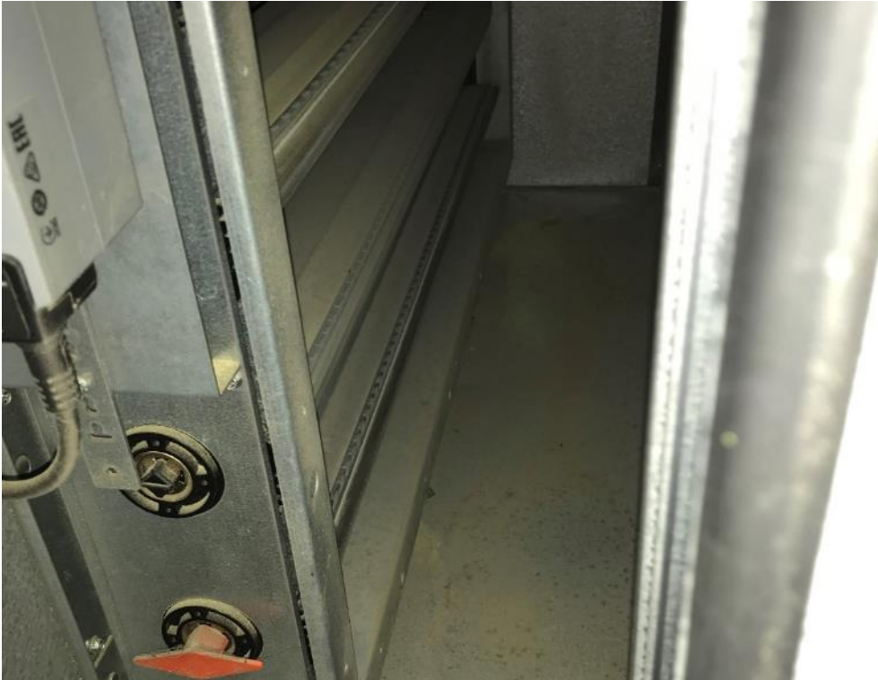
Kuva 5.1. TK3 ilmanvaihtokoneen raitisilmapelti on likainen eikä toimi.
