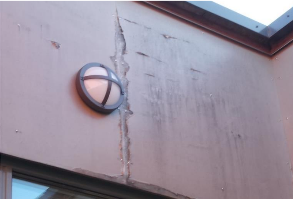
Kuva 4.4. Julkisivulevyissä on pinnoite vaurioita.
