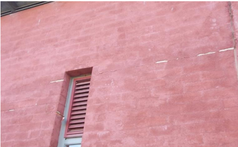
Kuva 4.1. Julkisivuverhouksessa on halkeamia.
