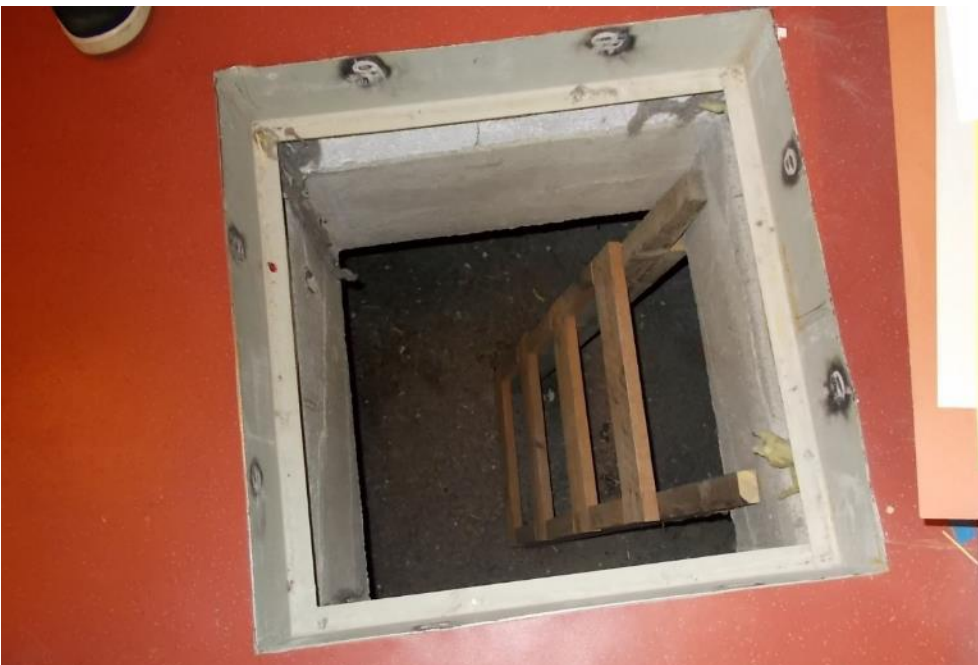
Kuva 4.11. Kulkuluukku alapohjatilaan ei ole tiivis.
