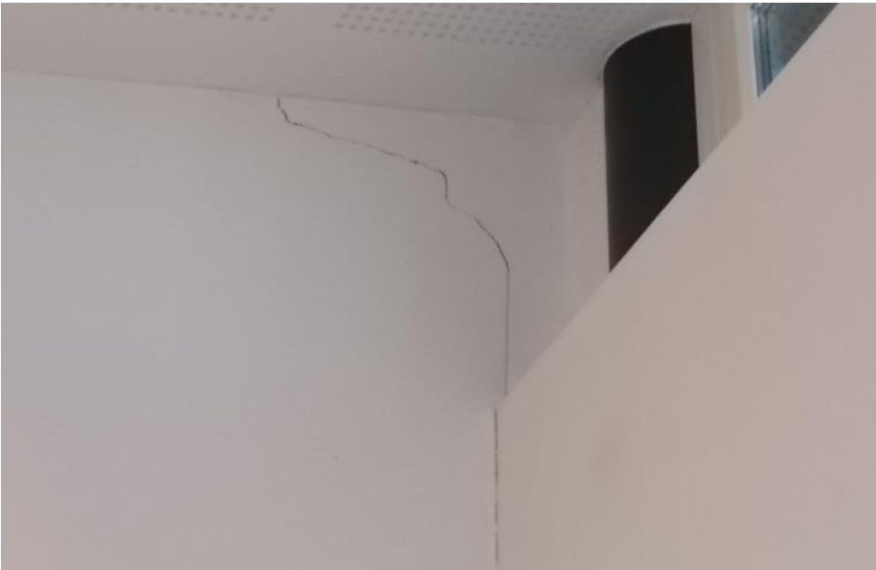
Kuva 4.9. Eteisten 104 ja 118 seinissä on halkeamia.
