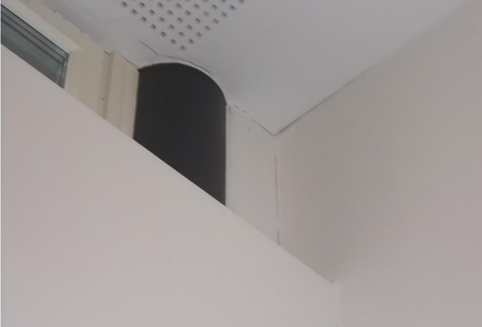
Kuva 4.10. Eteisissä 104 ja 118 on auenneita rakenneliittymiä.
