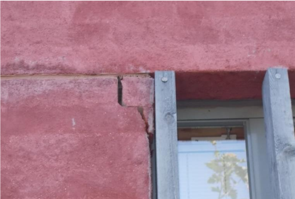
Kuva 4.2. Julkisivuverhouksessa on halkeamia.
