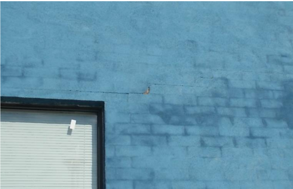
Kuva 4.3. Julkisivuverhouksessa on halkeamia.
