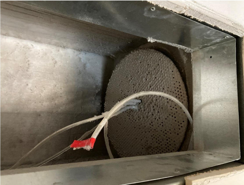
Kuva 5.2. Poistoilmaventtiilit ovat likaisia.
