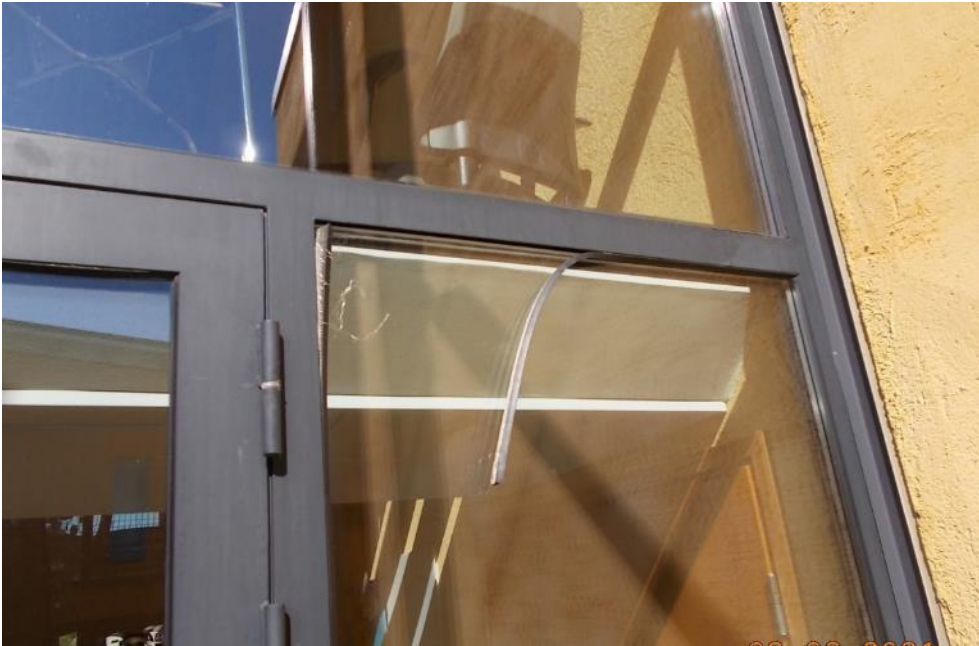
Kuva 4.2. Ulko-oven lämpölasien tiivisteet A-Porras.
