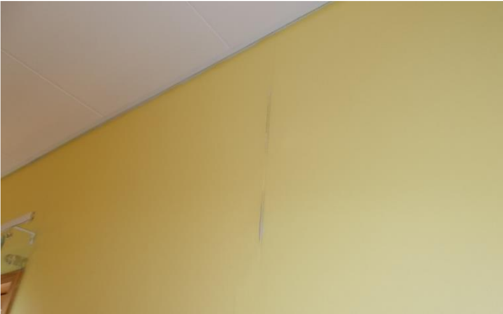
Kuva 4.4. Halkeama seinässä Leikkitala 104.
