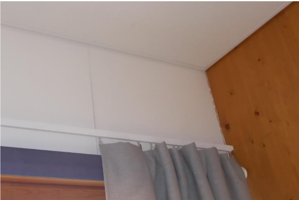
Kuva 4.5. Halkeama seinässä Ruokailutila 106.
