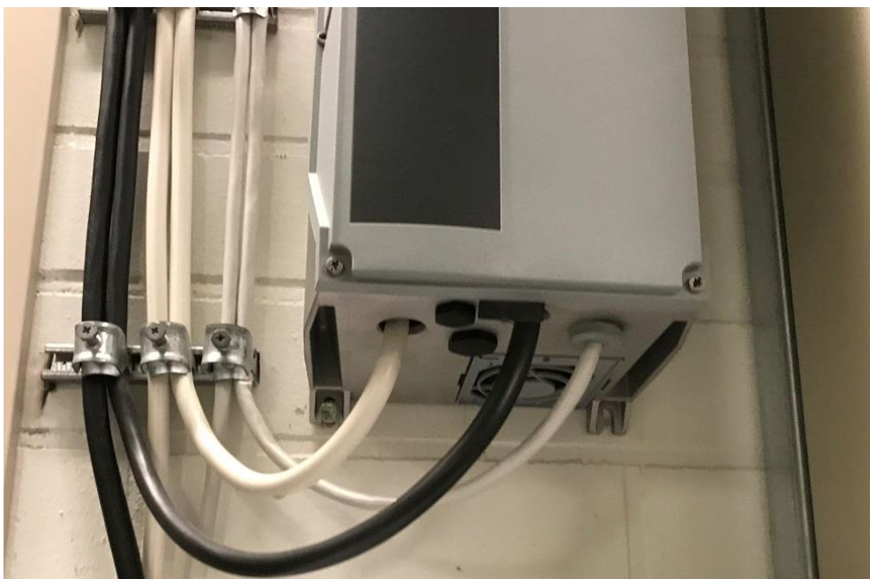
Kuva 6.2. EMC-suojaus virheellinen, holkit puuttuvat.
