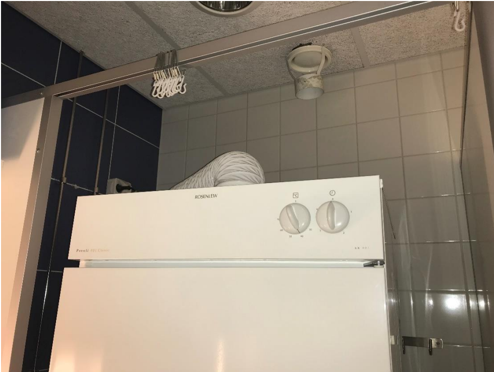
Kuva 5.4. Tilan 211 kuivauskaapin poistoilmaletku on irti.
