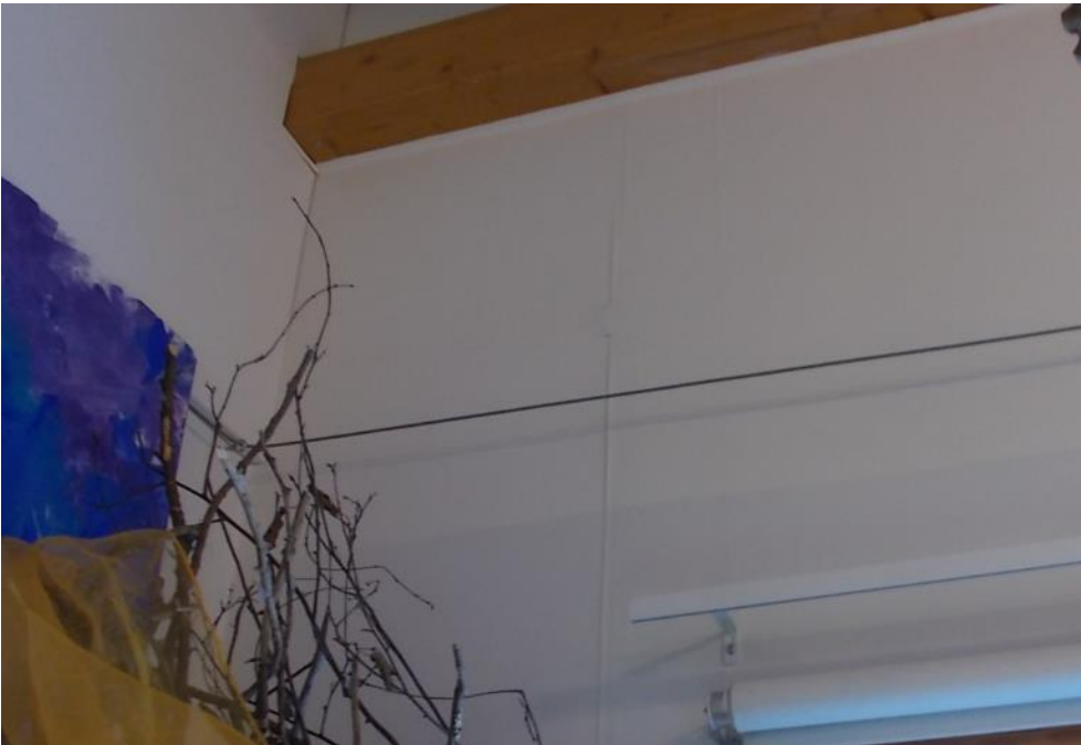
Kuva 4.7. Halkeama seinässä Leikkitala 208.
