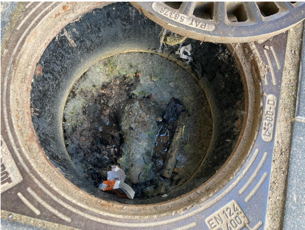
Kuva 5.9. Sadeveden ritiläkansikaivoissa hiekkaa ja muuta roskaa.
