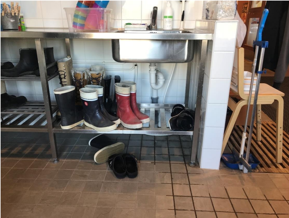
Kuva 5.8. Eteisen pesualtaan suihkun letku vuotaa lattialle.
