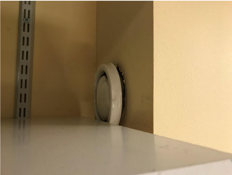
Kuva 5.3. Salin varaston venttiili on irti
