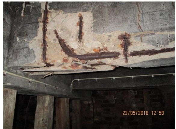
Kantavan palkin teräksen voimakkaasti ruostuneet
