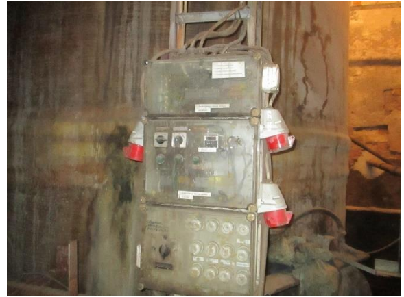
Ryhmäkeskus tuotantotiloissa, kotelon muovi on paikoin sulanut
