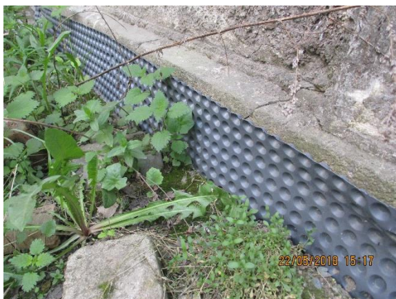
Patolevy havaittiin osalla rakennusta, levyä ei kiinnitetty
