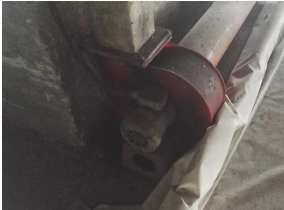
Erillispuhallin, ei ollut käynnissä kierroksen aikana
