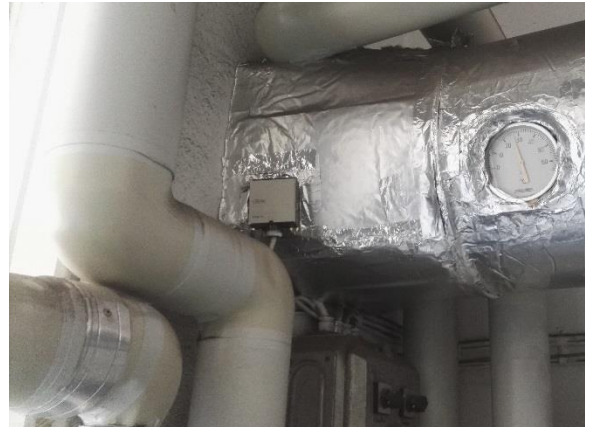
Laboratorion ilmanvaihtokoneen laitteistoa
