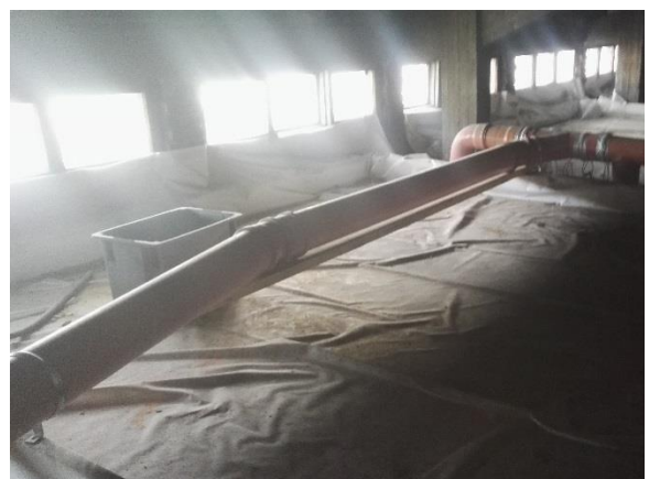
Muoviviemäristä tehtyä ilmanvaihtokanavaa ullakolla
