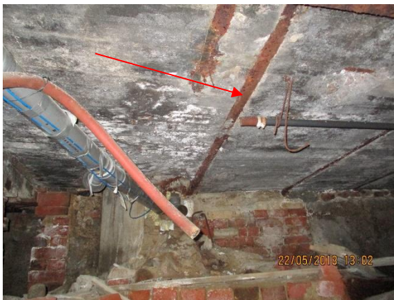
Välipohjan "ratakiskot" ovat ruostuneet ja näkyvissä
