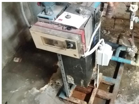
Vanha pumppujen ohjauskeskus
