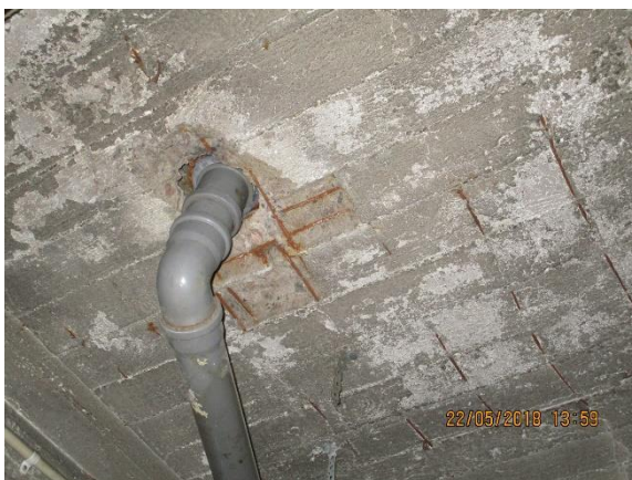
Välipohjen teräksissä runsaasti näkyviä vaurioita
