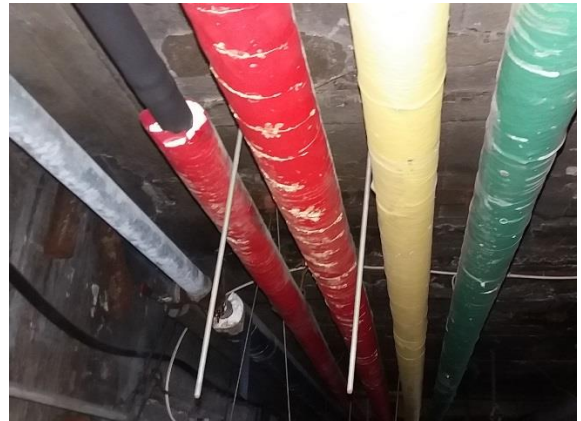
Käyttöveden ja lämmityksen runkojohtoja
