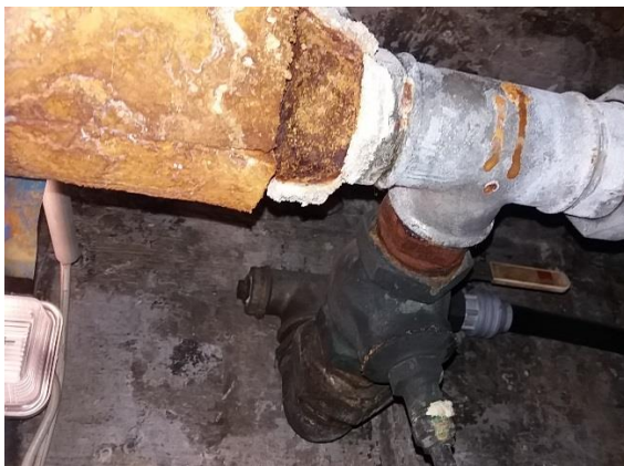
Ruostunut liitos sinkityssä teräsputkessa
