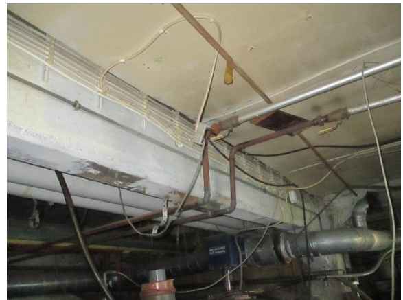
Pintakaapelointeja teknisessä tiloissa
