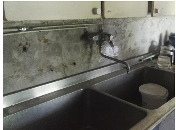
Keittiötilassa oleva yksiotehana, jossa heikon näköiset kytkentäjohtodot. Kalustesulku uusittu.
