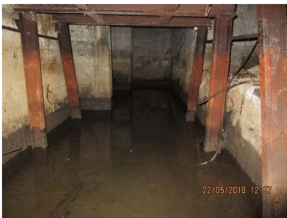
Kellarin lattialla vettä 200 – 300 mm tarkastushetkellä
