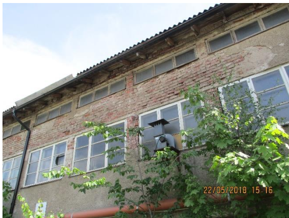
Julkisivuissa on laajoja rappausvaurioita
