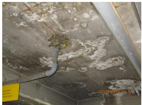
Vuotoja on esiintynyt paikkapaikoin
