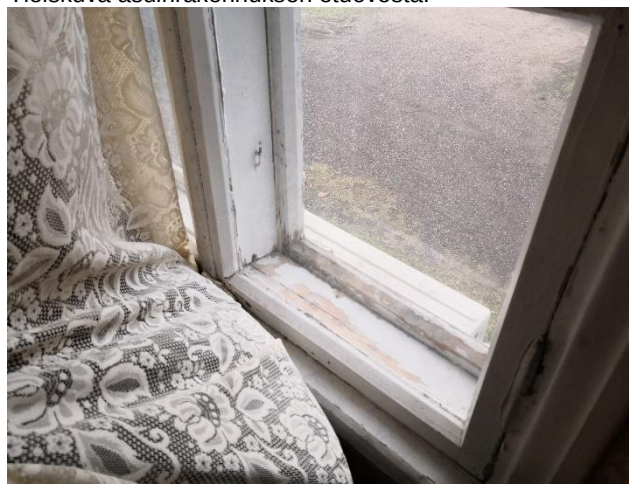
Etupuitteen ja karmin välisosan maalipinnan vaurioita.
