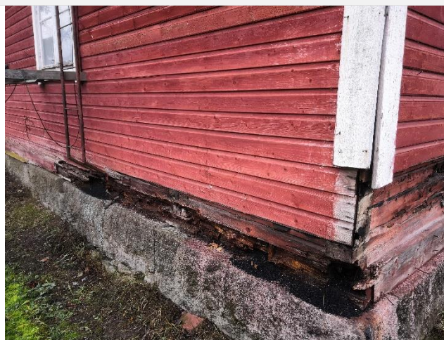
Ainakin kahdessa alimmassa hirressä on lahovaurioita.
