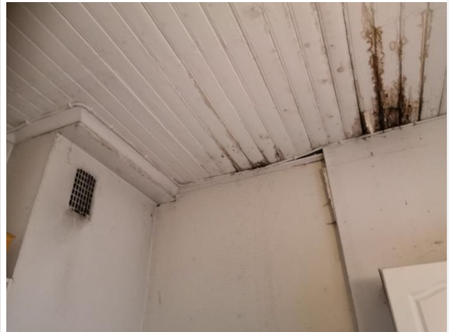
Vesikattovuodon aiheuttaman vesivaurion jälkiä kattopinnalla keittiössä.
