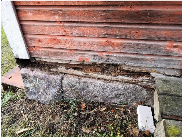
Piharakennuksen hirsirungon alimmissa hirsissä on pitkälle edennyttä lahoa.
