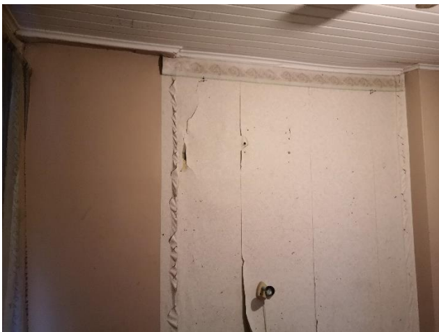
Makuuhuoneen pintamateriaalit ovat paikoitellen irti ja halkeilleet..
