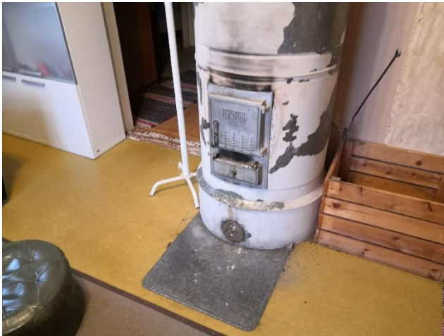
Asuinrakennuksen olohuoneen peltikuoriuuni.
