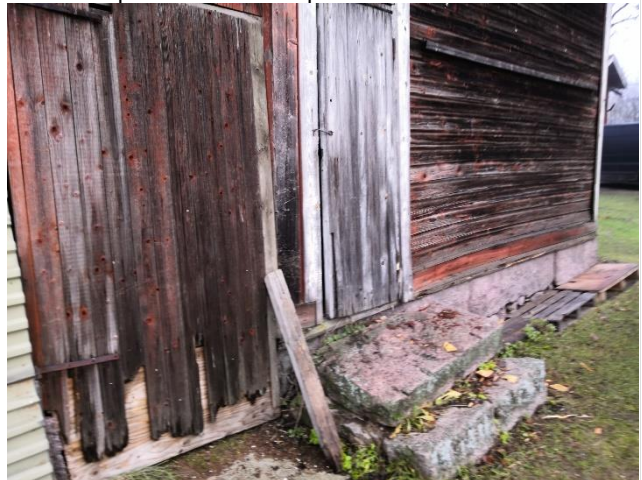
Piharakennuksen julkisivu- ja oviverhouksissa on pitkälle edenneitä lahovaurioita.
