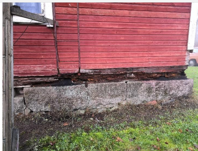
Yleiskuva rakennuksen pohjoisnurkan alimpien hirsien lahovaurioista.
