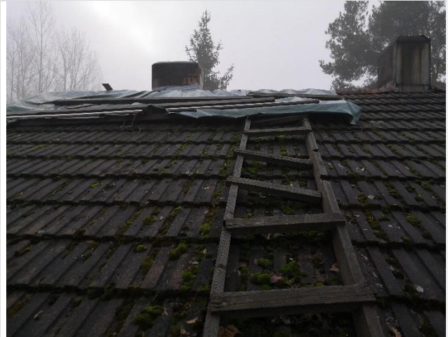
Asuinrakennuksen vesikatteen paikallinen vesivuoto on korjattu väliaikaisesti pressulla.
