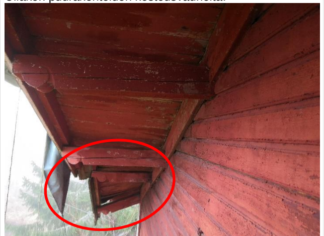
Räystäärakenteen vaurioita itänurkassa.
