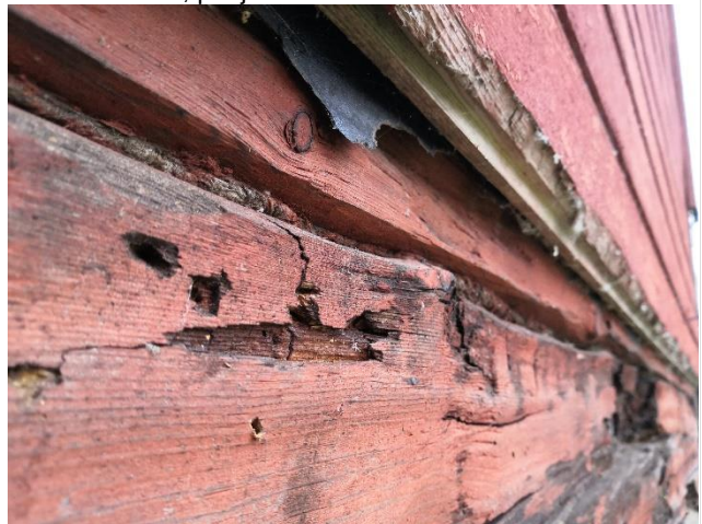
Verhouksen ja hirsirungon välissä ei ole tuuletusväliä.
