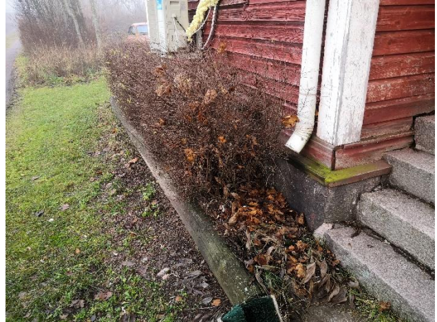
Istuksia rakennuksen sokkelin vieressä.
