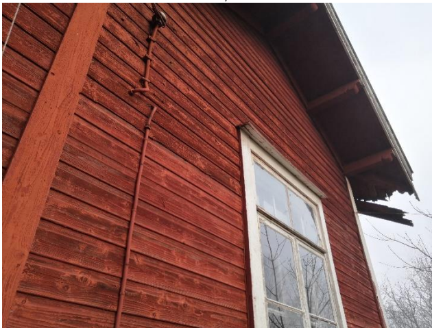
Julkisivuverhouspaneelien maalipinta on kulunutta. Taustalla räystäsrakenteen vaurioita.
