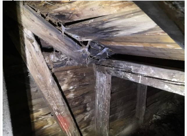
Ullakon puurakenteiden kosteusvaurioita.
