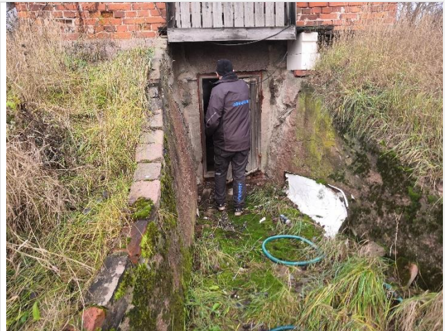
Kivirakenteisen piharakennuksen sisäänkäynnin tutkimuurit ovat huonokuntoiset.
