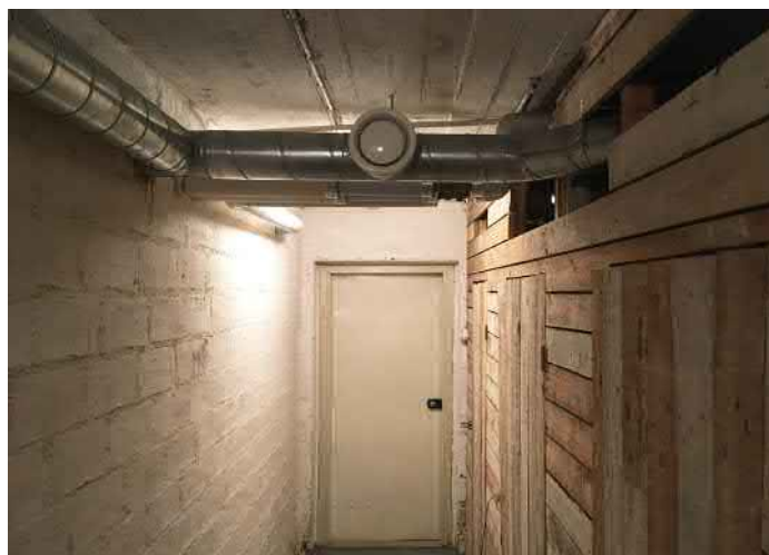
Kellaritilat ovat lähes alkuperäisessä asussaan. Uudet ilmanvaihtoputket on vedetty kellarikäytävän katossa.
