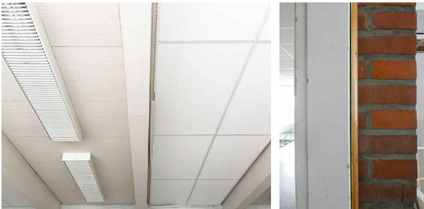
Luokkahuoneen katto. Ylälaattapalkiston väliin lisätty uusia akustiikkalevyjä alkuperäisten päälle. Luokkahuoneen oven karmi.
