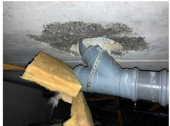
5.10. Pistokoeluonteisesti tehtyjen tarkastusten perusteella on viemäriputkien ontelolaatan läpiviennit tiivistetty betonivalulla. Valustopparina käytetyt mineraalivillalevyt olivat monin paikoin jääneet poistamatta.
