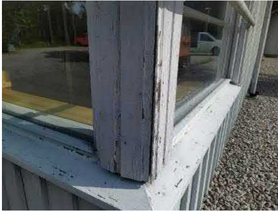
6.17. Rakennuksen kaakkoiskulmalla havaittiin ikkunoiden verhopaneeleissa käyritystä, joka voi mahdollistaa viistosateen pääsyn paneelien taakse.
