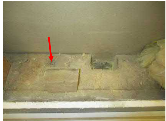
6.39. Rakenneavauksen RA.08-US kohdalla havaittiin alaohjauspuun kiinnikkeessä vähäisesti pintaruostetta (punainen nuoli). Alaohjauspuun alapinnasta ja mineraalivillakaistasta otetussa materiaalinäytteissä (MA.12- ja MA.16-US) oli molemmissa vahva viite vauriosta. Mineraalivillakaistan alapuolella oli vielä kermikaista.
