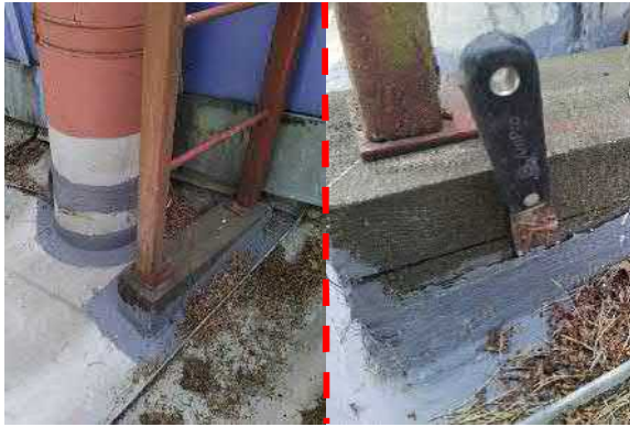
8.13. Liikuntasalin (130) takan savuhormin läpivienti ja hormien vieressä olevien talotikkaiden jalusta oli tiivistetty kangasvahvistetulla sivelävällä vedeneristysmassalla. Talotikkaiden jalustan kohdalla oli vedeneristysmassassa epätiiveyttä.
