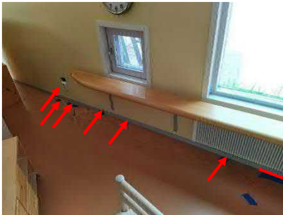
5.25. Säännöllisiä ilmavuotoreittejä alapohjan ja ulkoseinän liittymästä sekä pistorasioista sisäilmaan (punainen nuoli ja viiva).
