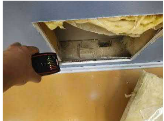
5.30. Rakenneavauksen kohdalla havaittiin ilmanvuotoa höyrynsulkumuovin ja kipsilevyn välistä.
