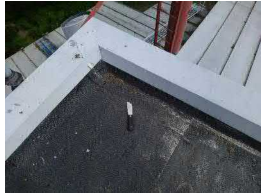
8.26. Kattolyhtyjen vesikatteen tarkastuksissa havaittiin kermien saumoissa ainoastaan yksittäisiä osin avonaisia saumauksia ja höyrypusseja.
