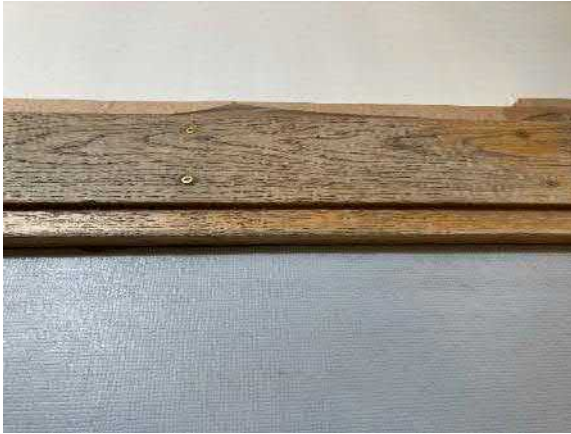
5.5. Märkätilojen muovimattoja ei ole liitetty ovikynnykseen rakennusohjeiden mukaisesti.
