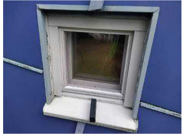
6.18. Levyverhotuilla julkisivuilla ikkunoiden (MSE/MEK) vesipellit ovat asennettu siten, että se ei mahdollista seinärakenteen tuuletusta. Mittauksen perusteella vaihtelee vesipeltien kallistus välillä 5–20°. Vesipellit ovat kiinnitetty karmeihin nauloilla.
