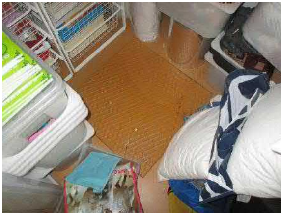
5.31. Ilmanvuotoa alapohjarakenteesta olevasta huolto-/tarkastusluukusta sisäilmaan.
