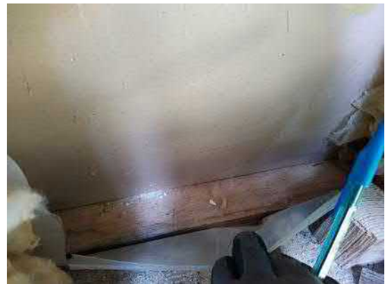
6.27 Rakenneavauksen kohdalla oli rakenteen sisäpuolella seinän alareunassa olevassa vaakakoolauksessa ja kipsilevyssä silmin havaittavia kosteusjälkiä. Koolauksen alapinnasta otetusta materiaalinäytteestä (MA.03-US) tehdyssä suoramikroskopoinnissa oli viite sienikasvustosta. Alaohjauspuun alapinna materiaalinäytteessä (MA.02-US) oli heikko viite vaurioista.
