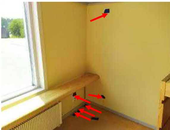
6.60. Yksittäisiä ilmavuotoreittejä ulkoseinän ja alapohjan liittymästä sekä sisäverhouslevyissä olevien kiinnikkeiden ja pistorasioiden kohdalta sisäilmaan (punainen nuoli).
