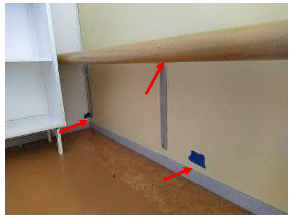
6.61. Yksittäisiä ilmavuotoreittejä ulkoseinän ja alapohjan liittymästä sekä sisäverhouslevyissä olevien kiinnikkeiden kohdalta sisäilmaan (punainen nuoli).
