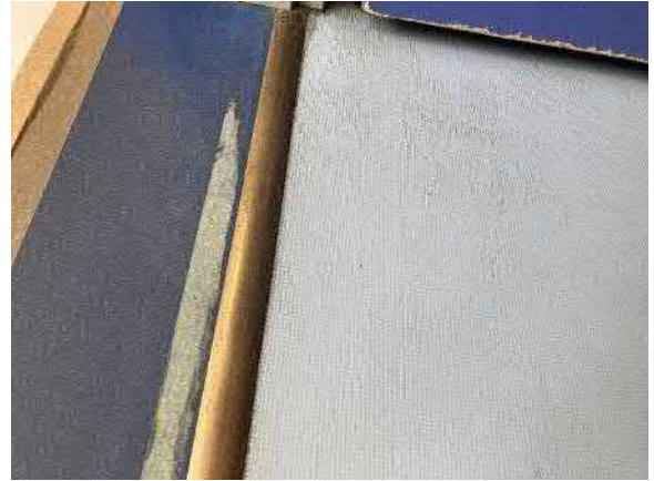
5.6. Pesuhuoneiden 154 ja 155 ovet ovat kynnyksettä. Pesuhuoneen puolella ei silmämääräisten tarkastusten perusteella havaittu rakennusohjeiden mukaista loivaa luiskaa. 1
