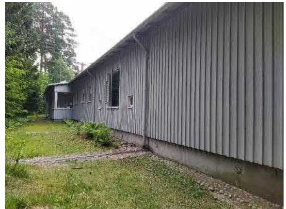
6.4. Yleiskuva pohjoiseen rajoittuvasta lautaverhoillusta julkisivusta (takapiha). Tarkastuksissa havaittiin julkisivulla selvää ikkunoiden maalipinnan (pintamaali) hilseilyä.
