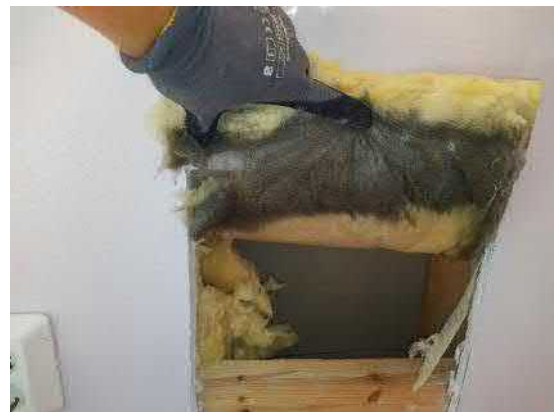
6.31. Rakenneavauksen (RA.04-US) kohdalla oli ulkoseinän mineraalivillan ulkopinnassa (alareuna) tummentumaa. Mineraalivillan alareunasta otetussa materiaalinäytteessä (MA.06-US) oli heikko viite vauriosta.
