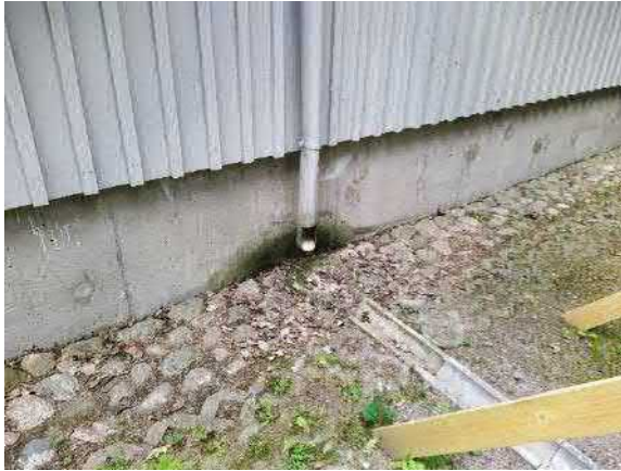
6.21. Takapihalla (pohjoissivu) on vesikatteen sadevedet ohjattu pääosin syöksytorvea pitkin avokouruihin. Paikoin syöksytorvien kohdalla sokkeleissa oli havaittavissa kosteusjälkiä ja leväkasvustoa.
