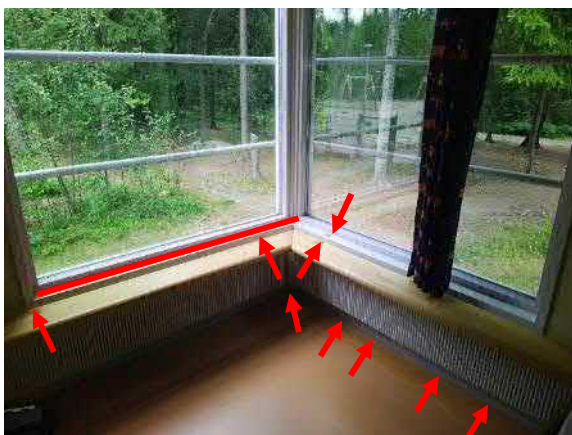
6.64. Useita yksittäisiä ilmavuotoreittejä ulkoseinän alapohjaliittymän ja sisäverhouslevyssä olevien kiinnikkeiden kohdalta sisäilmaan (punainen nuoli). Säännöllinen ilmavuotoreitti ikkunaliittymästä sisäilmaan (punainen viiva).
