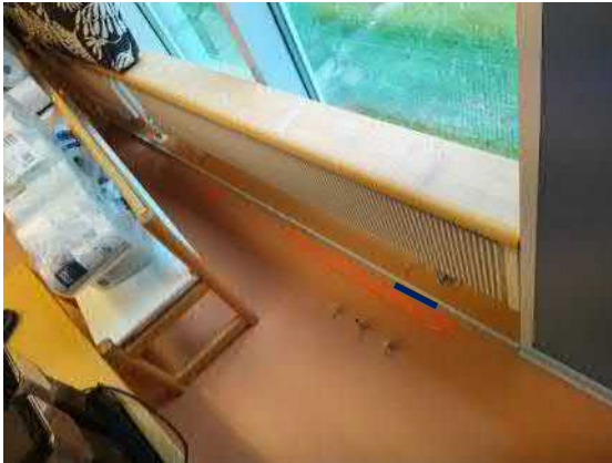
5.29. Yksittäinen ilmanvuotoreitti alapohjan ja lasijulkisivun liittymästä sisäilmaan (sininen viiva).
