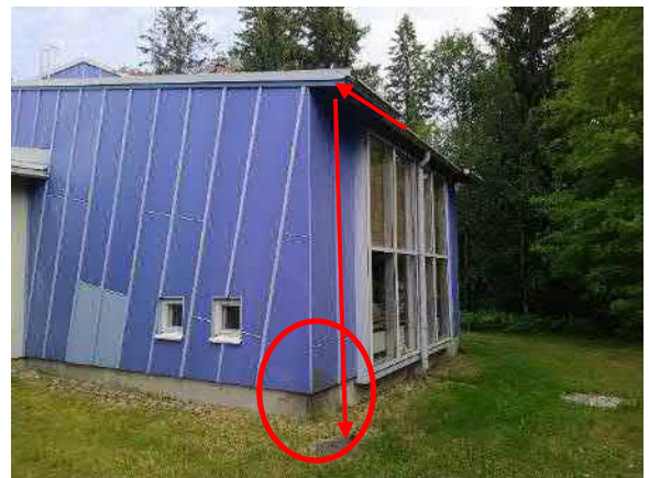
6.20. Liikuntasalin kohdalla on vesikatteen räystäskouruihin valuvat sadevedet osin ohjattu kourujen päästä rakennuksen seinustalle, missä oli julkisivun alareunan levyverhouksessa ja sokkelissa kosteusjälkiä ja leväkasvustoa.
