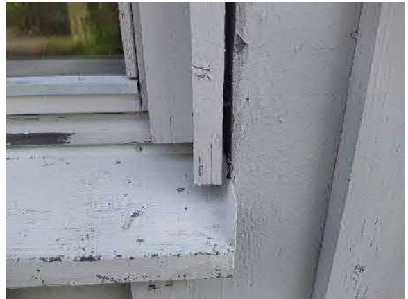
6.16. Ikkunoiden ulkopuolen peitelistoituksissa havaittiin paikoin rakoja, jotka voivat mahdollistaa viistosateen pääsyn seinärakenteeseen.
