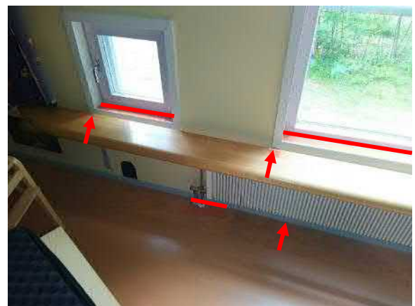
6.65. Säännöllinen ilmavuotoreitti ikkunaliittymästä sisäilmaan (punainen viiva). Yksittäisiä ilmavuotoreittejä ulkoseinän alapohjaliittymän ja sisäverhouslevyssä olevien kiinnikkeiden kohdalta sisäilmaan (punainen nuoli).
