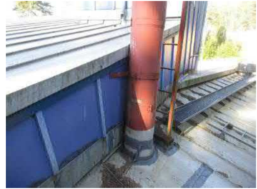
8.14. Liikuntasalin (130) takan savuhormi oli lähes kiinni viereisessä seinärakenteessa, mikä vaikeuttaa läpiviennin tiivistystä.
