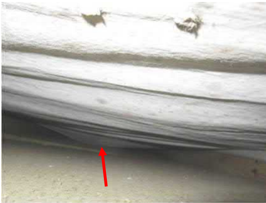
8.33. Rakenneavauksen RA.11-YP kautta yläpohjan tuuletusvälistä otetussa kuvassa havaittiin aluskatteen reunassa painuma (punainen nuoli), joka voi mahdollistaa aluskatetta pitkin valuvan kondenssi-/vuotoveden pääsyn yläpohjaan.
