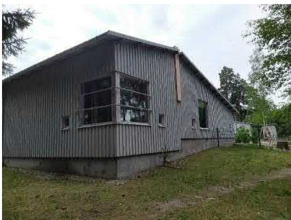
6.5. Yleiskuva länteen rajoittuvasta lautaverhoillusta julkisivusta (takapiha). Tarkastuksissa havaittiin julkisivulla selvää ikkunoiden maalipinnan (pintamaali) hilseilyä.
