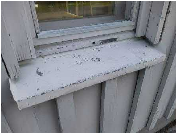
6.15. Lautaverhoiluilla julkisivuilla ikkunoiden (MSE/MEK) vesipellit ovat asennettu siten, että se ei mahdollista seinärakenteen tuuletusta. Mittauksen perusteella vaihtelee vesipeltien kallistus välillä 5–20°. Vesipellit ovat kiinnitetty karmeihin nauloilla.
