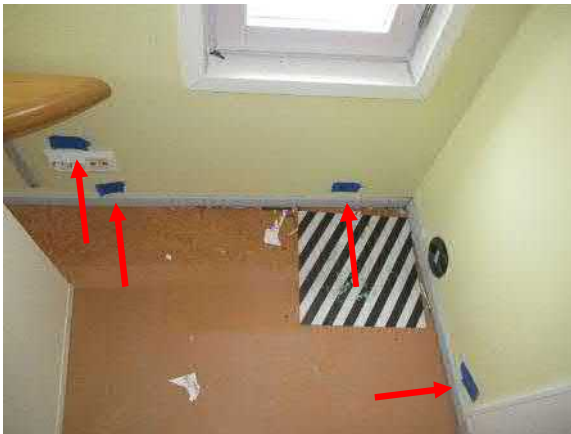
5.34. Yksittäisiä ilmanvuotoreittejä alapohjan ulkoseinä- ja väliseinäliittymistä sekä ulkoseinän pistorasiasta sisäilmaan (punainen nuoli).
