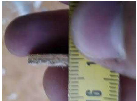
5.14. Porareiästä ja pintamateriaalista irrote- tun palan perusteella on tiivistyskorjausten yh- teydessä uusitun linoleumin alla selkeä tasoite- kerros.
