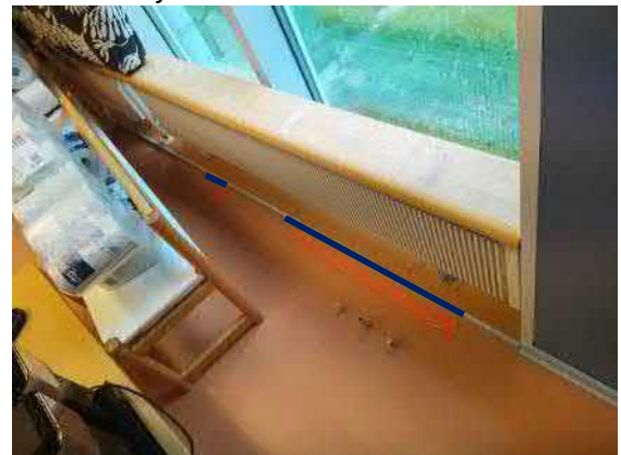
5.28. Säännöllisiä ilmavuotoreittejä alapohjan ja lasijulkisivun liittymästä sisäilmaan (sininen viiva).
