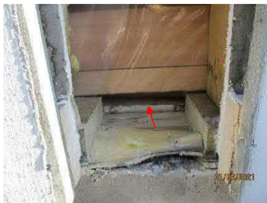
6.57. Rakenneavauksen RA.18-US kohdalta tehdyn tarkastelun perusteella on sokkeliliittymä toteutettu suunnitelma-asiakirjoissa esitettyjen periaatteiden mukaisesti. Rakenneavauksen kohdalla oli sokkelin sisäpinnassa olevan EPS-eristeen (punainen nuoli) ja ulkoseinän sisäpuolella olevan koolauksen välissä ilmarako.
