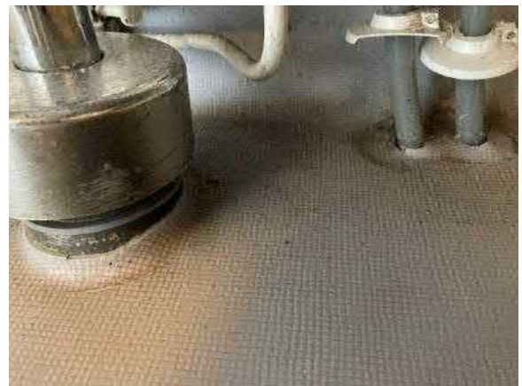
5.4. Muovimaton liitos pesualtaiden viemäriputkeen toteutettu ohjeiden mukaisella ylösnostolla. Muovimaton ja viemärin juuren tiivistys joustavalla massalla oli kuitenkin jäänyt tekemättä. Pesuhuoneissa 154 ja 155 havaittiin lattiassa epätiiviyttä vesijohtojen läpivientejä.
