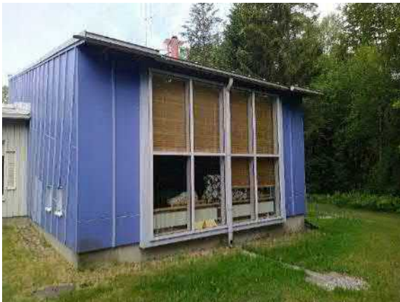
6.3. Yleiskuva liikuntasalin A130 itään rajoittuvasta levyverhoillusta julkisivusta ja siinä olevasta lasijulkisivujärjestelmästä (takapiha). Suunnitelma-asiakirjoista poiketen on lasijulkisivujärjestelmän runkorakenteet puuta.
