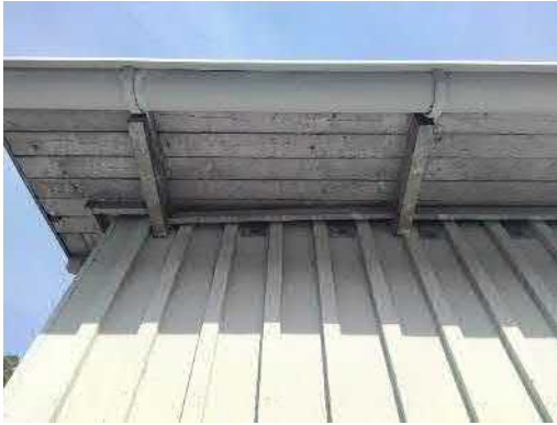
8.21. Sivuräystästä tehtyjen silmämääristen arvioiden perusteella ulottuu räystäs noin 0,6 metrin etäisyydelle julkisivun ulkopinnasta. Räystäslaudoituksessa oli laajalti silmin havaittavaa leväkasvustoa.
