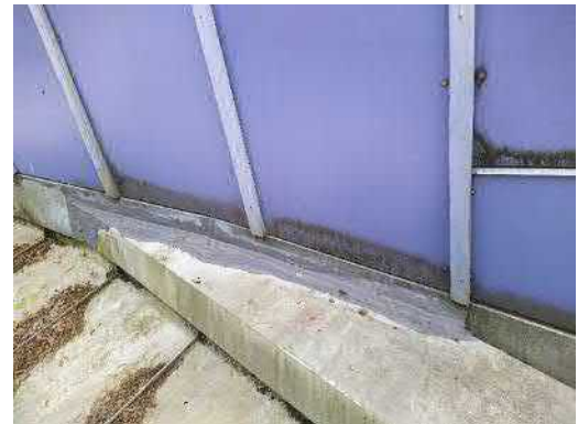
8.8. Harjakotelon päällyspellitystä oli tiivistetty siveltävällä vedeneristysmassalla aulan (129) kattolyhdyn seinäliittymän kohdalla. Lähtötietojen mukaan on liittymän alapuoliseen aulatilassa (129) tapahtunut vesikattovuoto.
