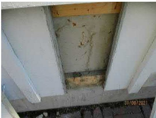
6.54. Yleiskuva ulkoseinän (US1) rakenneavauksesta RA.18-US. Rakenneavauksen kohdalla oli tuulensuojalevynä käytettyjen kipsilevyjen alareunassa kosteusjälkiä.
