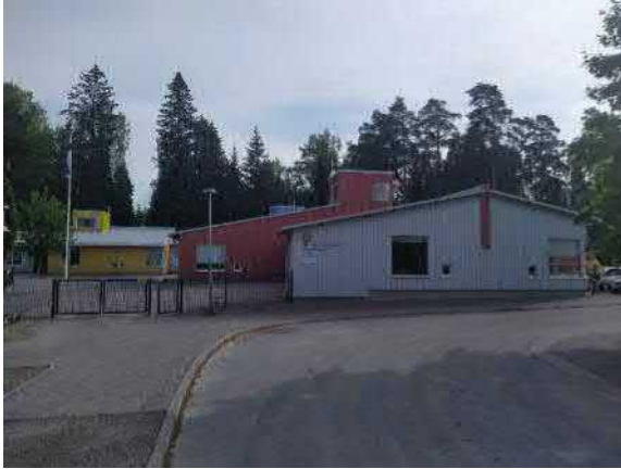
6.1. Yleiskuva etelään rajoittuvista julkisivuista (pysäköintialue). Tarkastuksissa havaittiin etelään rajoittuvalla lautaverhoilulla julkisivulla suhteellisesti eniten julkisivuverhouksen ja ikkunoiden maalipinnan hilseilyä.
