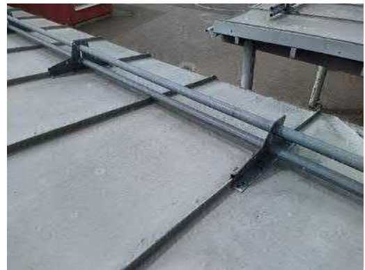
8.28. Vesikaton lumiasteiden, kattosiltojen ja lapetikkaiden kiinnitys on tehty katteen pystysaumoihin ilman katetta läpäiseviä reikiä.
