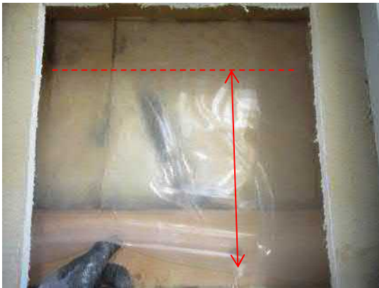
6.50. Rakenneavauksen RA.15-US kohdalla on ulkoseinän höyrynsulkumuovien vaakasauma liimitetty noin 0,3 m. Limitystä ei ole tiivistetty höyrynsulkuteipillä tms.
