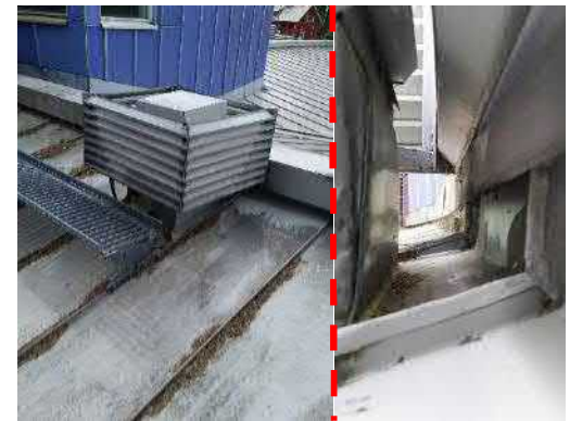
8.16. Yleiskuva wc-tilan (111) yläpuolella olevasta poistoilmakoneesta, joka on sijoitettu hyvin lähelle harjakoteloä. WC-tilassa (111) on lähtötietojen mukaan tapahtunut vesikattovuotoja. Silmämääräisissä tarkastuksissa ei hormin (400x400) pellityksissä kuitenkaan havaittu erityisiä virheitä tai puutteita.
