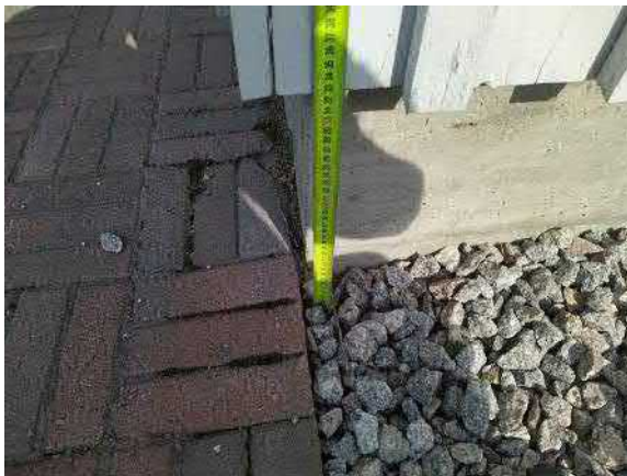
6.23. Pistokoeluonteisesti tehtyjen mittausten perusteella vaihtelee julkisivuverhouksen etäisyys ympäröivästä maanpinnasta välillä 0,05–0,75 m. Pienimmillään etäisyys on sisäpihan puolella ja suurimmillaan rakennuksen pohjoissivulla.
