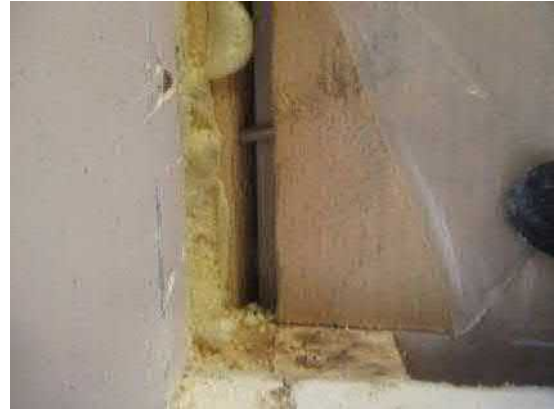
6.41. Rakenneavauksen RA.10-US kohdalla ei ulkoseinän höyrynsulkumuovia ole tiivistetty lasijulkisivun karmirakenteisiin. Karmin ja apukarmin välinen tilkerako oli tiivistetty PU-vaahdolla.
