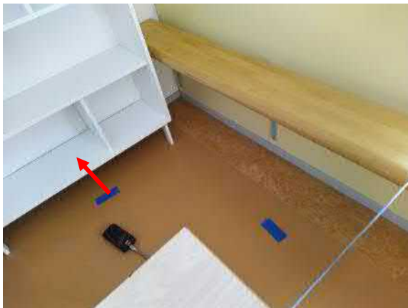
5.23. Yksittäinen ilmanvuotoreitti alapohjan ja väliseinän liittymästä sisäilmaan (punainen nuoli).
