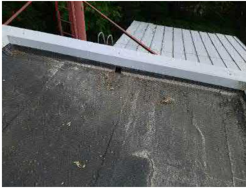
8.25. Kattolyhtyjen vesikatteen tarkastuksissa havaittiin vesikatteessa paikoin jälkiä veden lammikoitumisesta, minkä arvioidaan ensisijaisesti olevan seurausta tukkeutuneista ulosheittäjistä.
