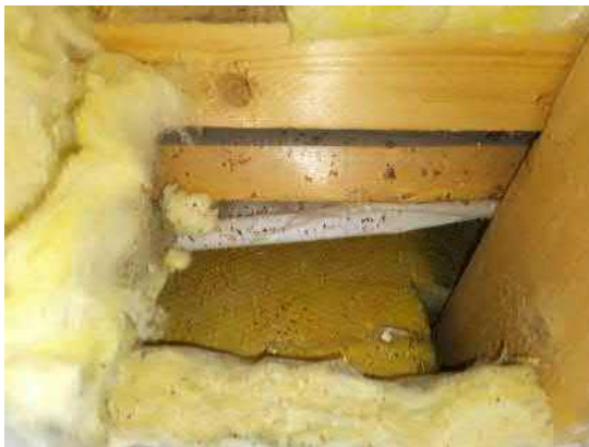
8.35. Rakenneavauksen kohdalla ei ulkoseinän ja yläpohjan liitosta ole toteutettu suunnitelma-asiakirjojen mukaisesti. Vesikaton aluskatetta ole nostettu ulkoseinälle, vaan se on tuotu ulkoseinän ulkopuolella olevan vaakakoolauksen alle, minkä seurauksena yläpohjan tuuletusväli ei ole yläreunasta avoin (kts. kuva 8.36).
