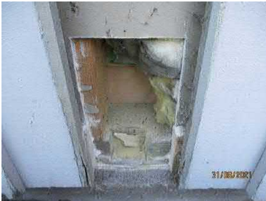
6.46. Yleiskuva ulkoseinän (US1) rakenneavauksesta RA.14-US. Rakenneavauksen kohdalla oli ulkoseinän mineraalivillan ulkopinnassa ja reunoissa tummentumaa.
