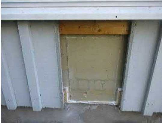
6.48. Yleiskuva ulkoseinän (US1) rakenneavauksesta RA.15-US. Rakenneavauksen kohdalla oli tuulensuojalevynä käytettyjen kipsilevyjen alareunassa kosteusjälkiä.
