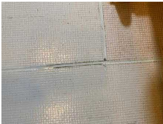
5.3. Märkätilojen muovimaton tarkastuksissa havaittiin tilojen 102, 104, 105, 124, 154 ja 155 muovimattojen saumoissa paikoin epätiiveyttä.
