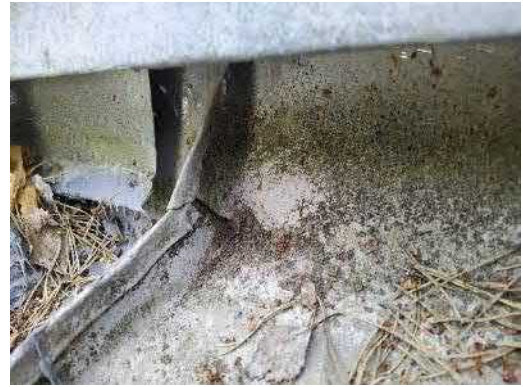
8.12. Rakenteita rikkomattoman tarkasteluiden perusteella ei poikittaisten rintataitteiden sauma ole täysin tiivis (peltiä on leikattu).
