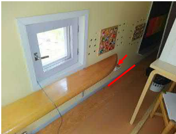
6.62. Säännöllinen ilmavuotoreitti ulkoseinän alapohjaliittymistä sisäilmaan (punainen viiva). Yksittäinen ilmanvuotoreitti pistorasian kohdalta sisäilmaan (punainen nuoli).
