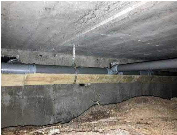
5.9. Ryömintätilassa olevat viemärit ovat olivat kannakoitu paikoin vanneteräksillä kannakoiduilla tukiarinalla ja paikoin pelkillä vanneteräksillä. Toteutettu kannakointi (mm. kannakointitapa ja -välit) ei kuitenkaan ole nykyisten rakennusohjeiden mukaisia.
