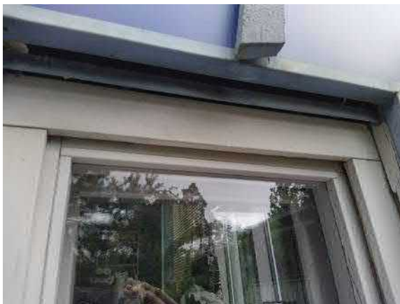
6.19. Levyverhotuilla julkisivuilla on ikkuna-aukkojen yläreunassa tuuletusaukko. Ikkunaliittymien yläreunaan oli lisäksi asennettu suojapelti.
