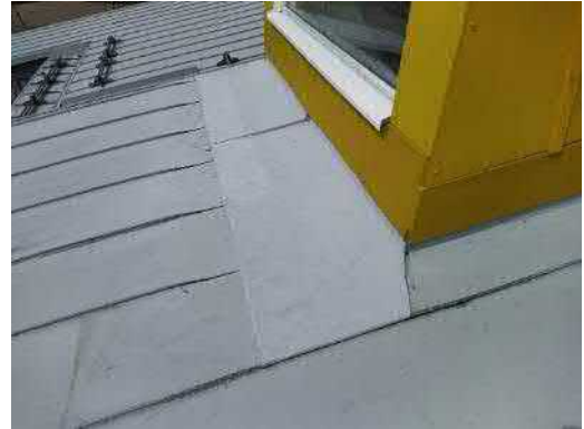
8.18. Lähtötietojen mukaan on eteisessä (114) tapahtunut vesikattovuoto keväällä 2021. Silmämääräisten havaintojen perusteella on eteisen (114) kattolyhdyn korjaustoimenpiteet sisältäneet ainakin rintataitteen taitepellitysten uusimisen.
