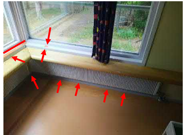
6.63. Useita yksittäisiä ilmavuotoreittejä ulkoseinän alapohjaliittymän ja sisäverhouslevyssä olevien kiinnikkeiden kohdalta sisäilmaan (punainen nuoli). Säännöllinen ilmavuotoreitti ikkunaliittymästä sisäilmaan (punainen viiva).
