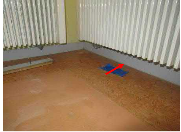
5.33. Yksittäinen ilmanvuotoreitti alapohjan ulkoseinäliittymistä sisäilmaan (punainen nuoli).
