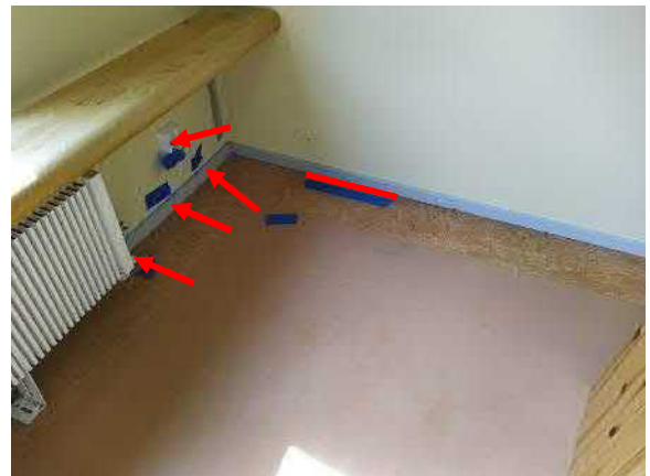
5.24. Säännöllisiä ilmavuotoreittejä alapohjan ja ulkoseinän liittymästä sekä pistorasioista sisäilmaan (punainen nuoli ja viiva).
