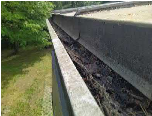
8.23. Räystäskouruissa havaittiin paikoin runsaasti havuja ym. roskaa.
