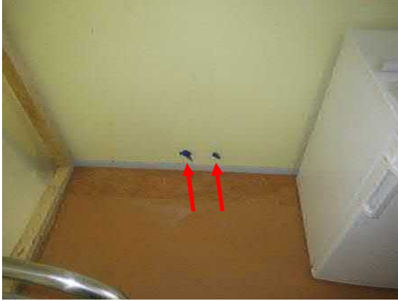
5.32. Yksittäisiä ilmanvuotoreittejä alapohjan väliseinäliittymistä sisäilmaan (punainen nuoli).
