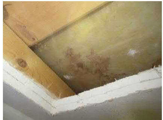
8.38. Rakenneavauksen kohdalla havaittiin yläpohjaeristeen alapinnassa värjäymää. Mahdollisen kosteus- ja mikrobivaurion tarkastamiseksi otettiin eristemateriaalista materiaalinäyte mikrobimääritystä varten (MA.14-YP).
