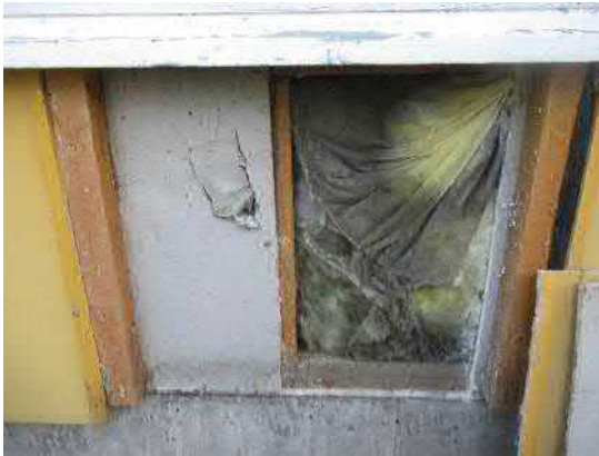
6.44. Yleiskuva levyverhotun ulkoseinän (US3) rakenneavauksesta RA.13-US. Rakenneavauksen kohdalla oli tuulensuojalevynä käytettyjen kipsilevyjen alareunassa kosteusjälkiä. Toisessa kipsilevyssä oli myös levyyn kohdistuneen iskun tmv. seurauksena syntynyt vaurio. Lisäksi mineraalivillan ulkopinnassa oli laajalti tummentumaa.
