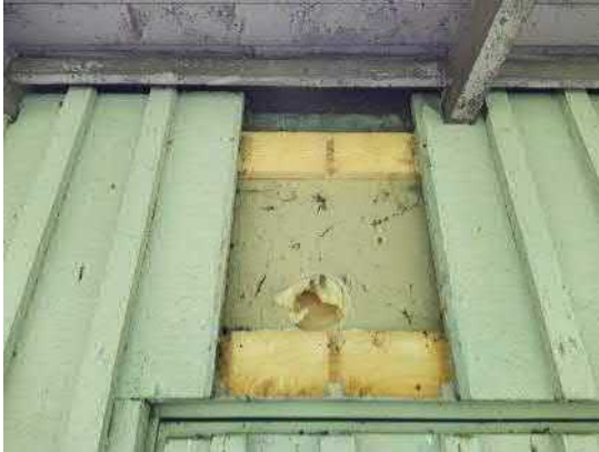
6.24. Yleiskuva ulkoseinän (US1) rakenneavauksesta RA.01-US, missä ulkoseinän räystääsraakenne on toteutettu samalla tavoin kuin rakenneavauksessa RA.03-US. Eristemateriaalin ulkopinnasta otetussa materiaalinäytteessä (MA.01-US) oli heikko viite vauriosta.
