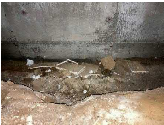
5.11. Ryömintätilassa oli huomattavasti rakennusjätettä (mm. EPS-eristettä, mineraalivillaa, kipsilevyä, pahvipakkauksia), joista osa on orgaanista tai sisältää orgaanisia materiaaleja.
