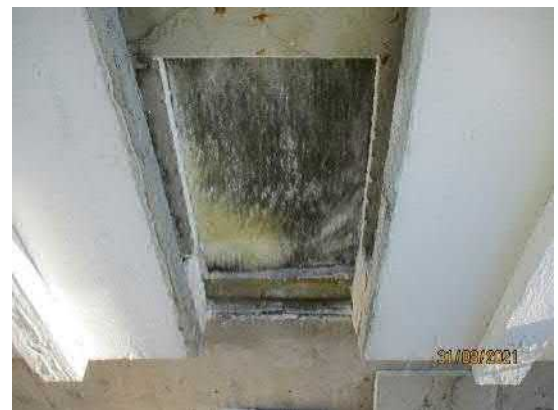
6.55. Rakenneavauksen RA.18-US kohdalla oli ulkoseinän mineraalivillan ulkopinnassa laajalti tummentumaa.
