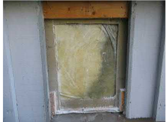
6.49. Rakenneavauksen RA.15-US kohdalla oli ulkoseinän mineraalivillan ulkopinnassa paikoin tummentumaa.
