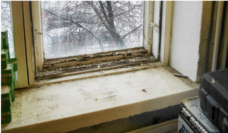
2.kerros. Rakennuksen puuikkunat ovat pääosin 1940-luvun lopulta, jotkut huonokuntoisia
