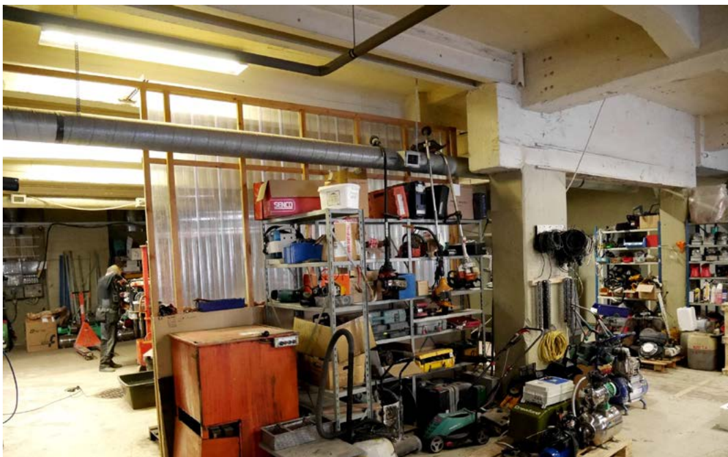
1.kerros. Tulipalojen, muutosten, laajennusten ja tuotantosuuntien vuoksi tehtyjä runkorakenteen muutoksia
