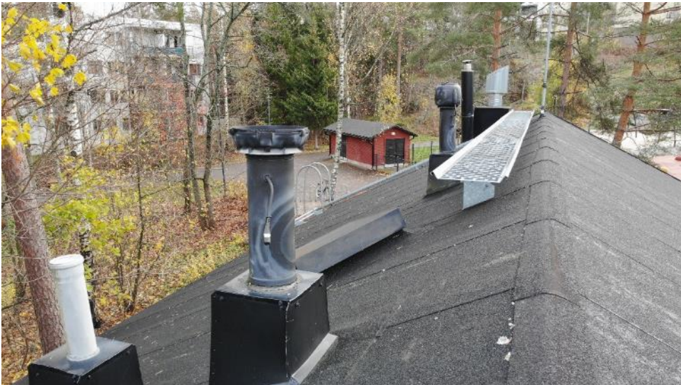
Kuva 5.4. Alapohjan tuuletuksen huippuimuri on kadonnut katolta.
