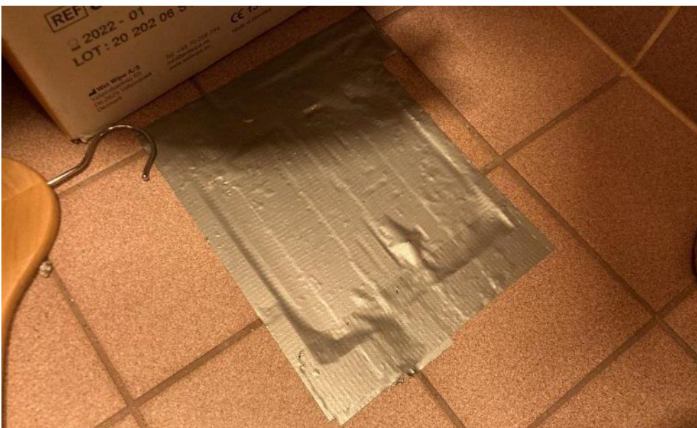
Kuva 5.2. Suihkutilan 11 lattiakaivo on teipattu umpeen.
