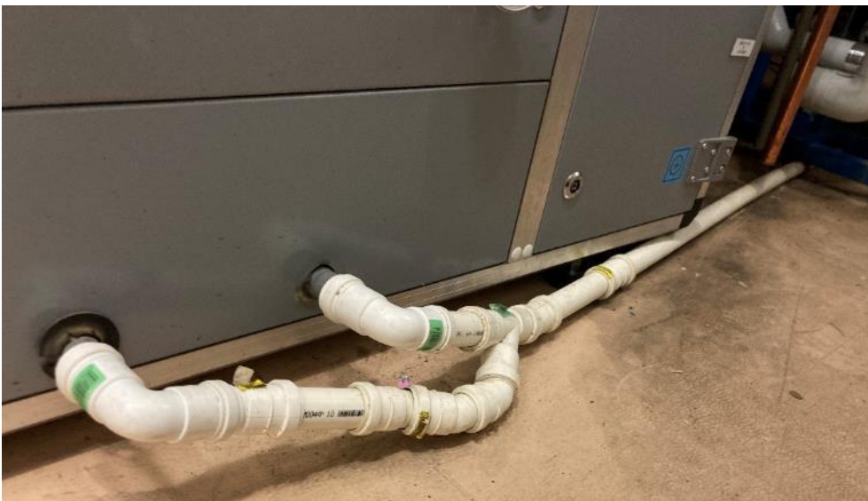
Kuva 5.1. Ilmanvaihtokoneen viemäroinnistä puuttuu takaimusuoja.
