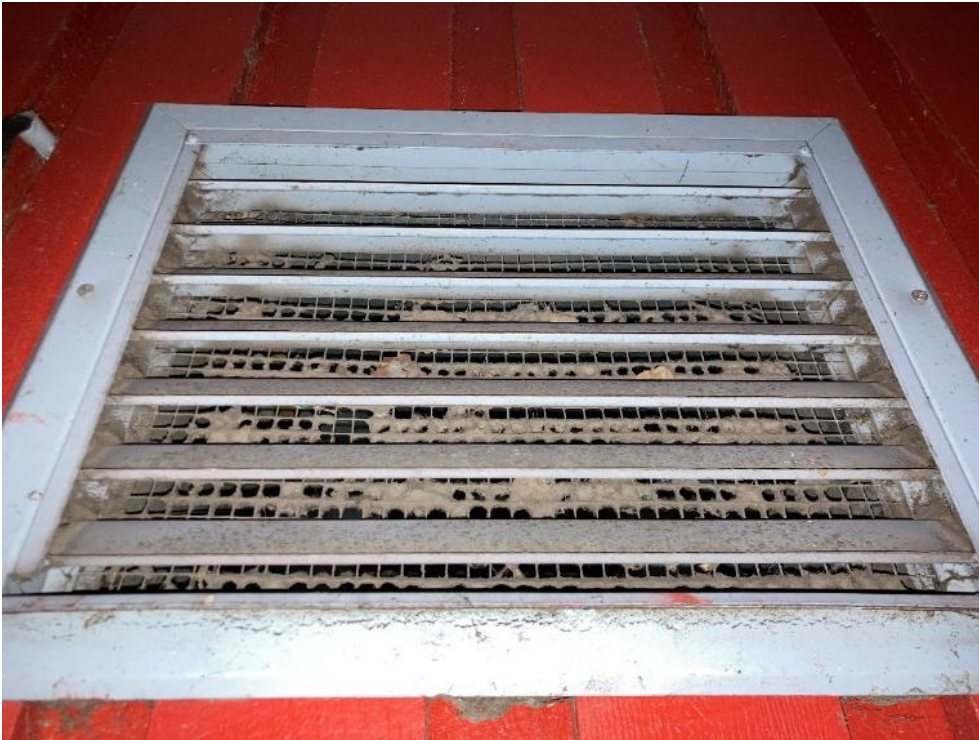
Kuva 5.3. Ilmanvaihtokoneen raitisilmasäleikkö on likainen.
