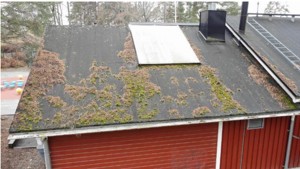
Kuva 4.3. Vesikatto on puhdistamatta.
