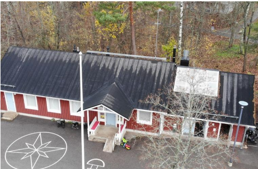
Kuva 4.1. Huopakate on osin huonossa kunnossa.
