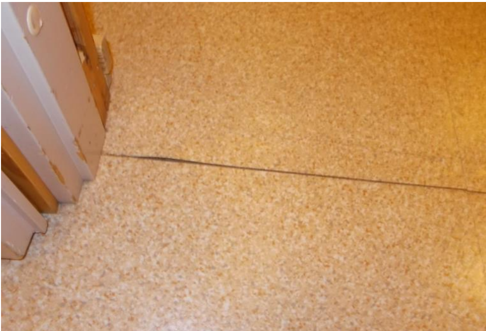
Kuva 4.5. Lattiamatto on alustastaan irti saumassa tilojen 01 Leikki-tila ja 03 Eteinen välisessä oviaukossa.
