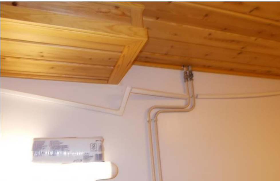
Kuva 4.9. Sähköjohto on irti seinästä 08 WC-tilassa.
