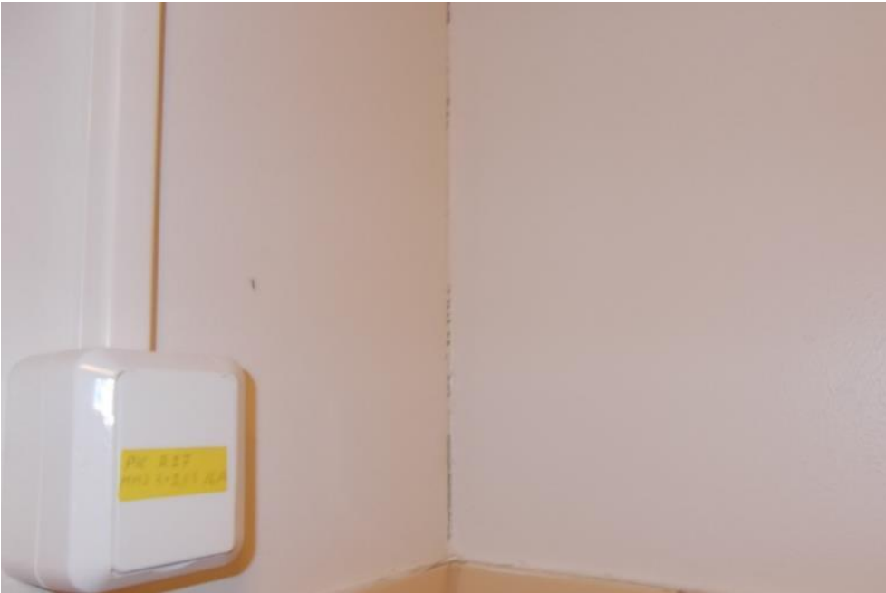
Kuva 4.8. Rakenneliittymä on auki 08 WC-tilassa.
