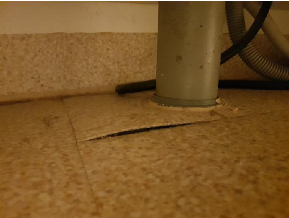
Kuva 4.7. Lattiamatto on osin irti alustastaan kaapiston alla 07 Keittiössä.
