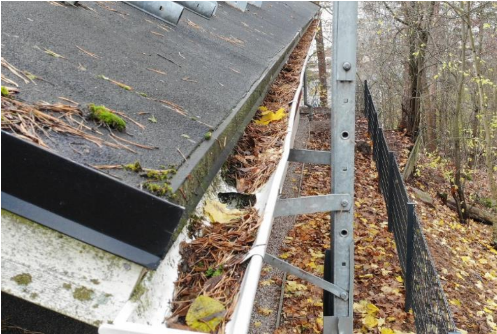
Kuva 4.4. Sadevesikourut ovat puhdistamatta.
