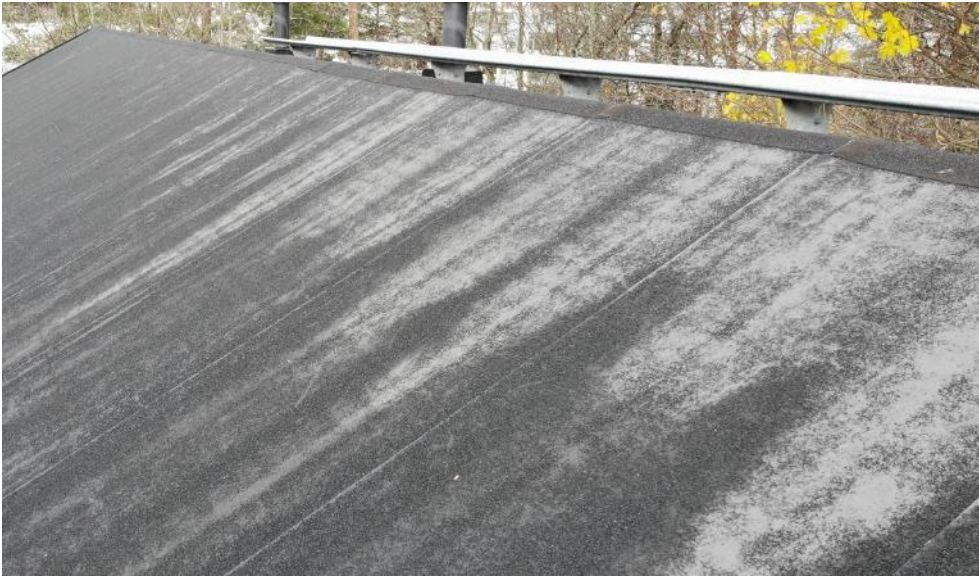
Kuva 4.2. Huopakate on osin huonossa kunnossa.
