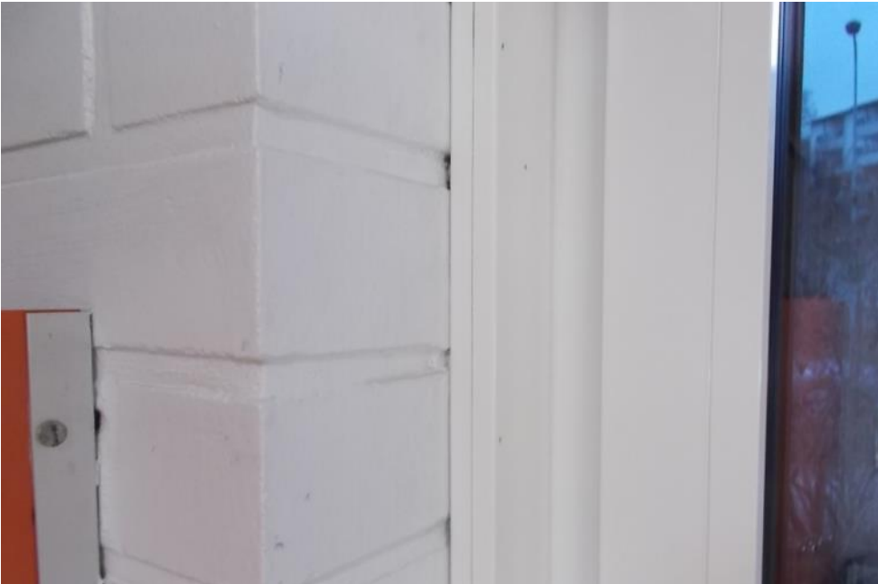
Kuva 4.10. Ikkunaliittymän tiilisaumoista on ilmavuotoa WC 205.
