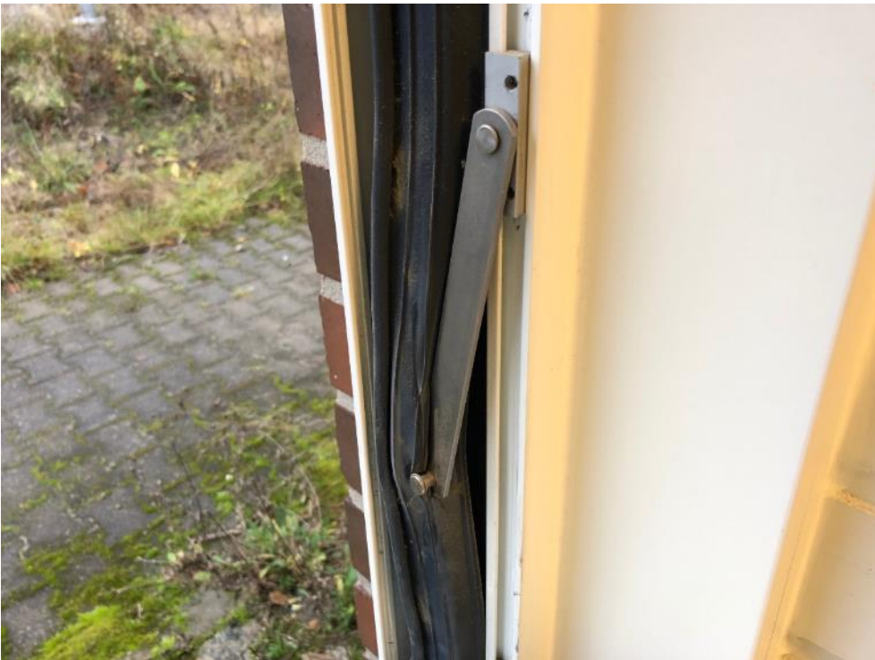
Kuva 4.6. Häätäpoistumisteiksi muutettujen ikkunoiden käytöstä poistetut aukipitorajoittimet vioittavat ikkunatiivisteitä.
