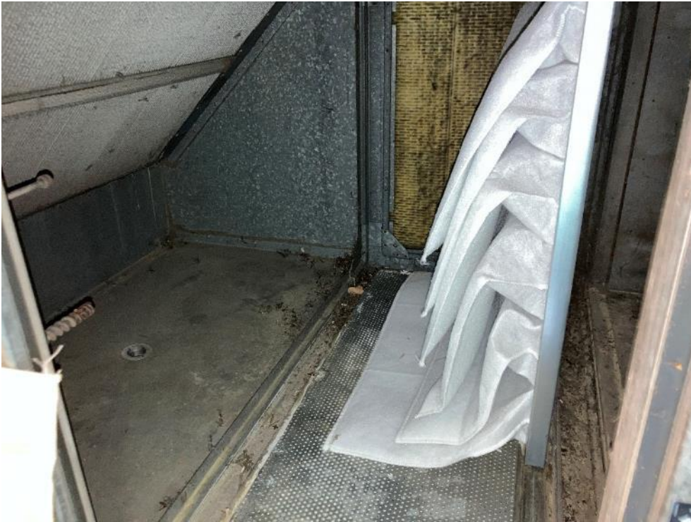
Kuva 5.2. Raitisilmakammio on likainen ja suodatin väärän mallinen ja väärin asennettu.
