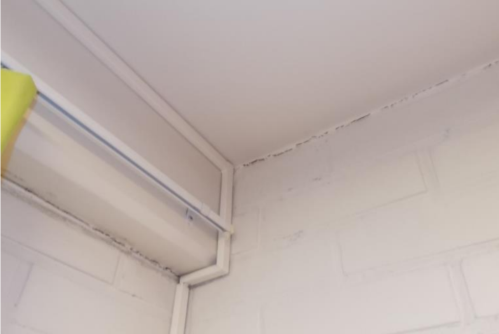
Kuva 4.9. Rakenneliittymiä on auennut Leikkitilassa 119.
