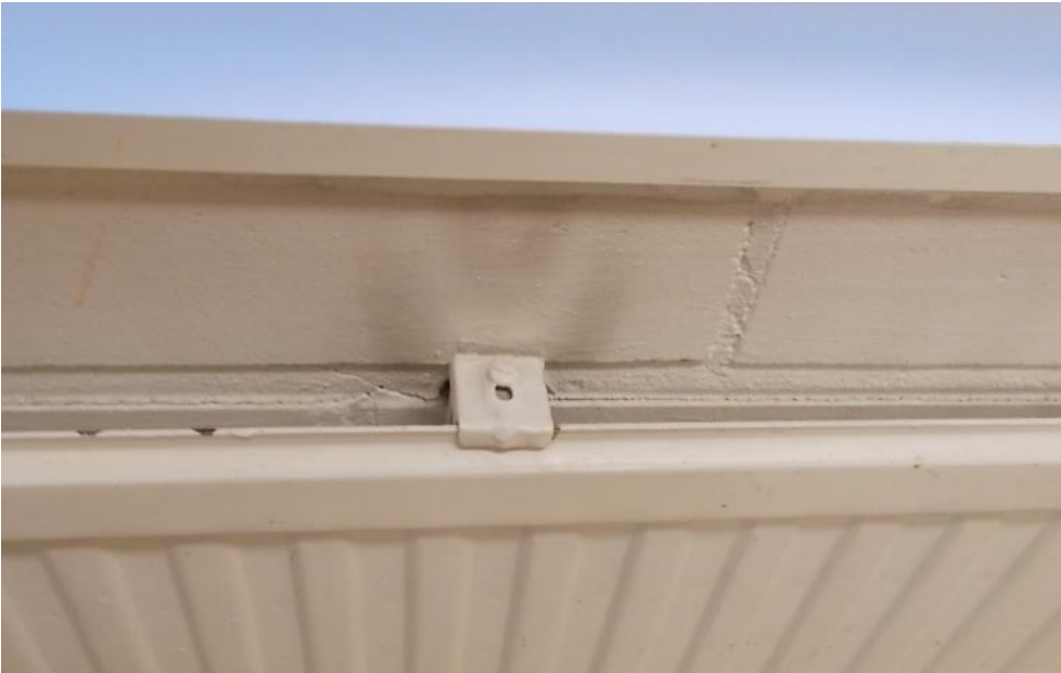
Kuva 4.11. Patterin kannakkeista on ilmavuotoa Toimistossa 219.
