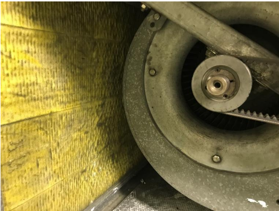
Kuva 5.1. Villalevyä tuloilmakoneen sisällä.
