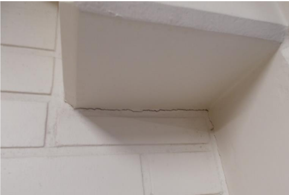
Kuva 4.12. Rakenneliittymä on auennut Toimistossa 219.
