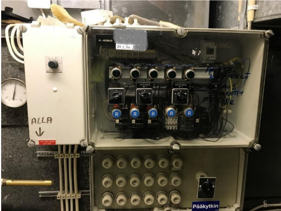
Kuva 6.1. Aikaohjelman kellokytkimet ovat sähkökotelon sisällä.
