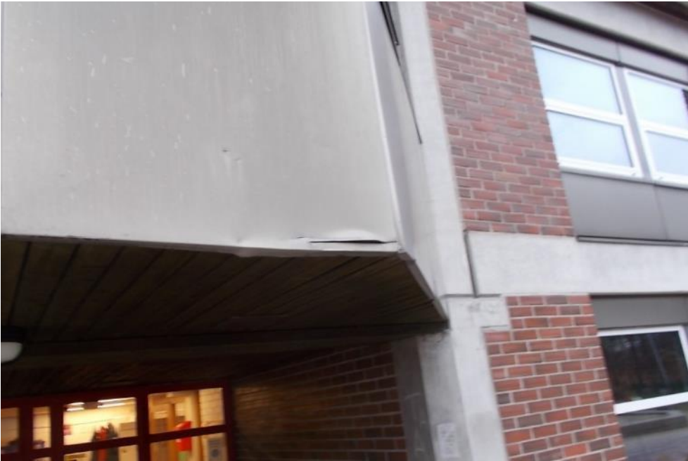
Kuva 4.5. Erkkerin verhous on vaurioitunut.
