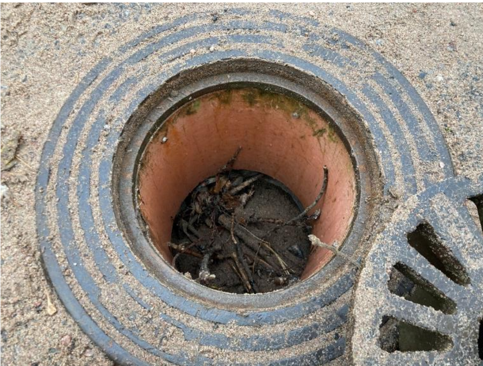
Kuva 5.7. Sadevesi kaivoissa on hiekka ja muuta tavaraa.
