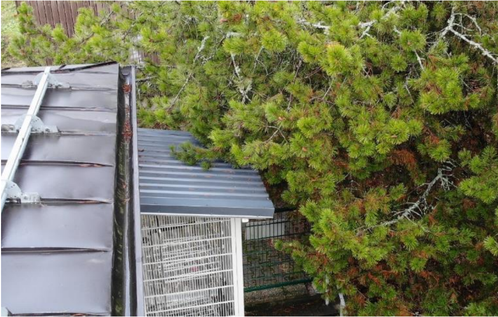
Kuva 4.1. Puun oksia ylettyä vesikatolle.
