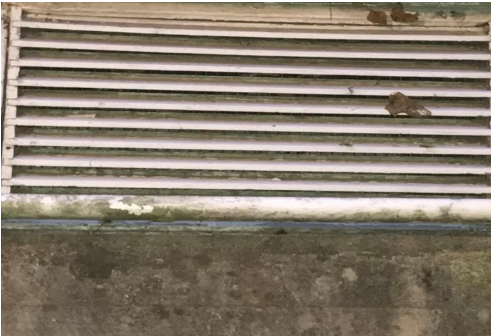
Kuva 5.5. Keittiön tuloilmakoneen raitisilmasäleikkö on likainen.
