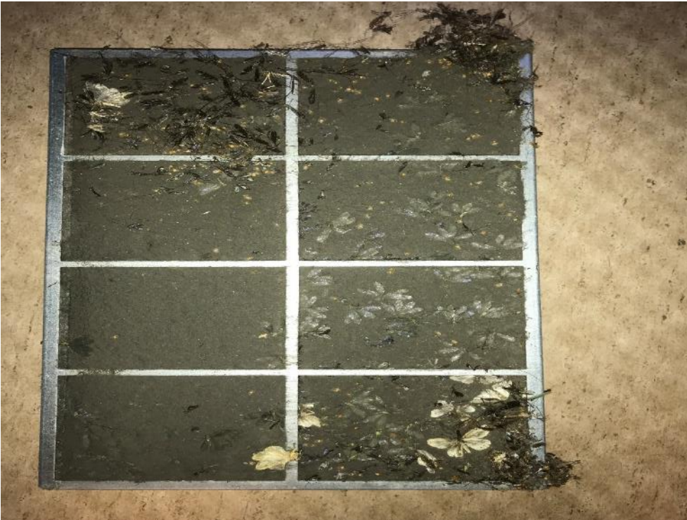
Kuva 5.4. Alakerran kokoushuoneiden tuloilmakoneen suodatin on tukossa.
