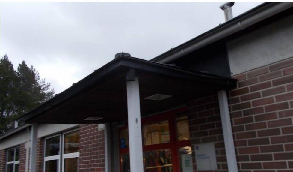
Kuva 4.4. Sisääntulon lipan sadevesien ohjaus on puutteellinen.
