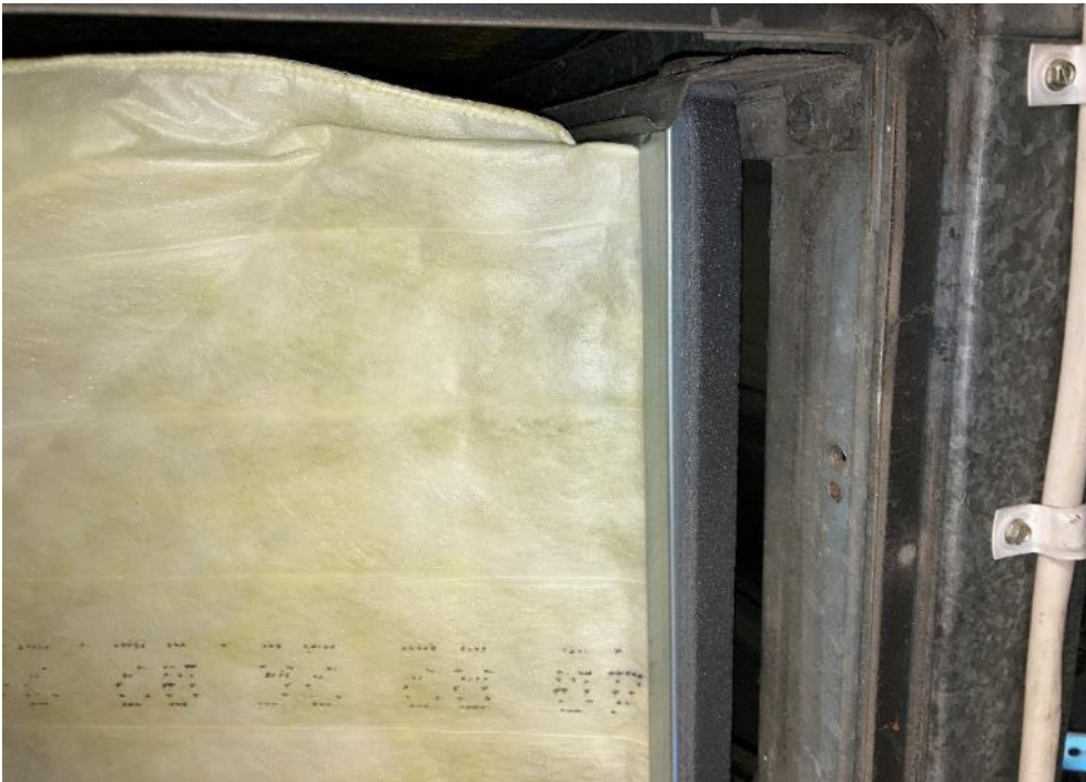
Kuva 5.3 Suodattimen reunasta tapahtuu ilman ohivirtausta.
