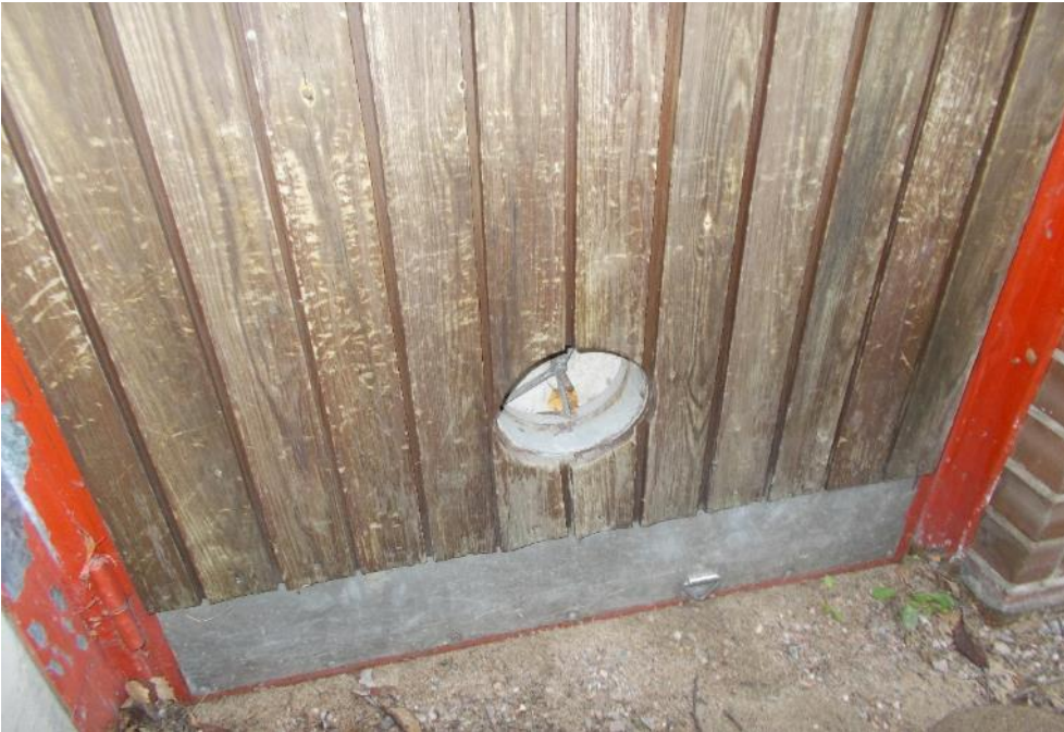
Kuva 5.6. Laitahuoneen oven ulkosäleikkö puuttuu.
