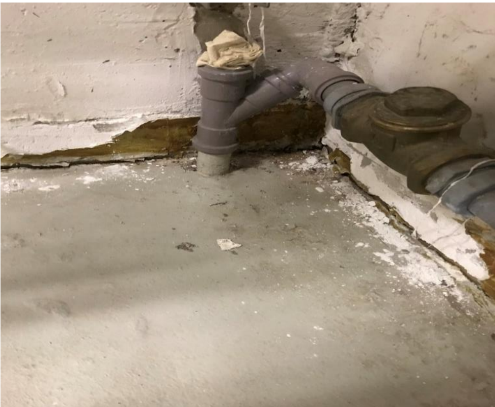
Kuva 5.7. Lämmönjakohuoneen viemäri on tulpattu paperilla.
