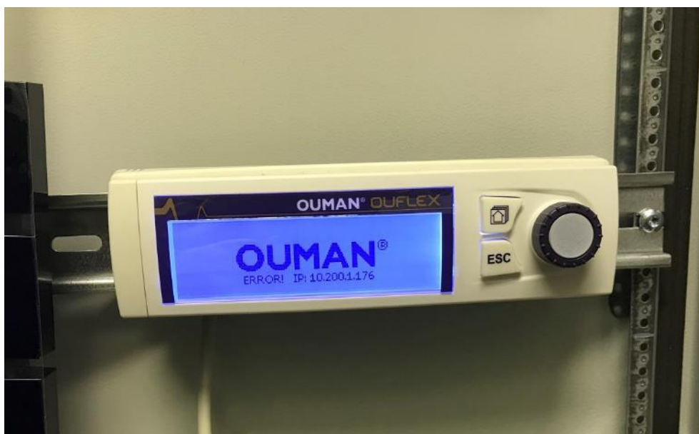
Kuva 6.2. Säädin on vikatilassa, ei tottele painikkeita (tilattu korjaus).
