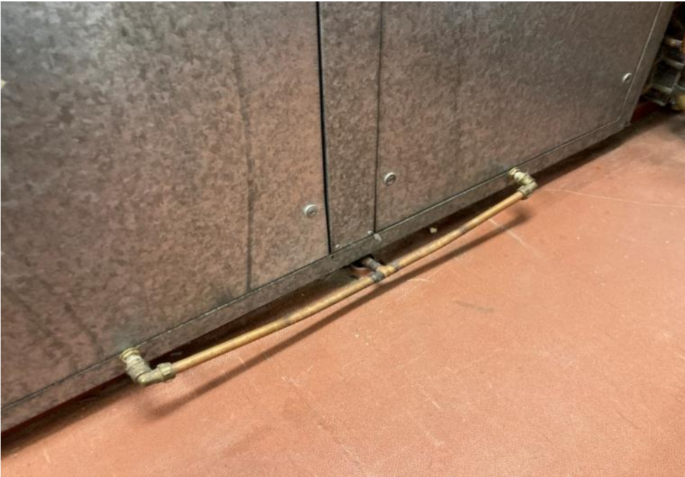
Kuva 5.2. Ilmastointikoneen viemäröinnissä ei ole takaimusuoja eikä viemäröintiliitos ole tiivis.
