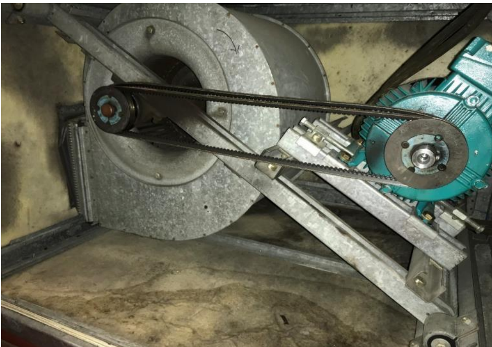
Kuva 5.1. Molempien pääilmanvaihtokoneiden kiilahihnat ovat löysällä ja kuluneet.
