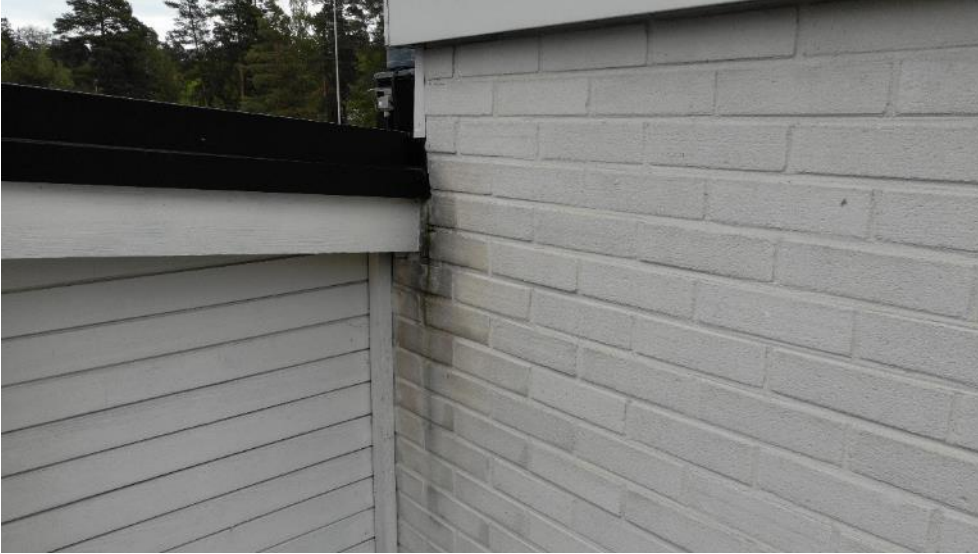
Kuva 4.3. Sadevesi ohjautuu seinälle.
