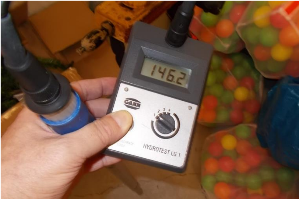
Kuva 4.13. Kosteusmittaus Kellarin lattiasta.
