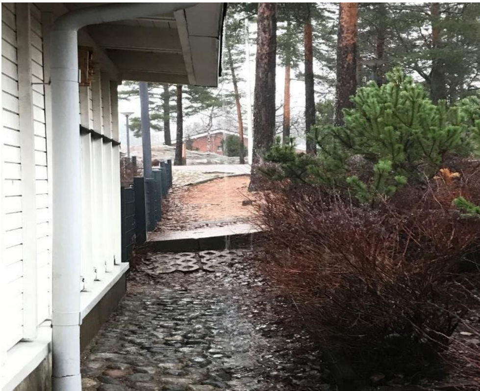
Kuva 4.2. Sadevesikourussa on roskaa ja vesi vuotaa reunan yli sokkelin juureen.
