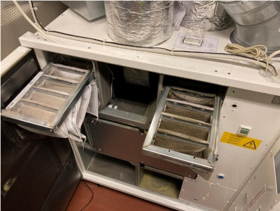
Kuva 5.4. Yläkerran ilmanvaihtokoneen sisusta ja suodattimet on likaiset.
