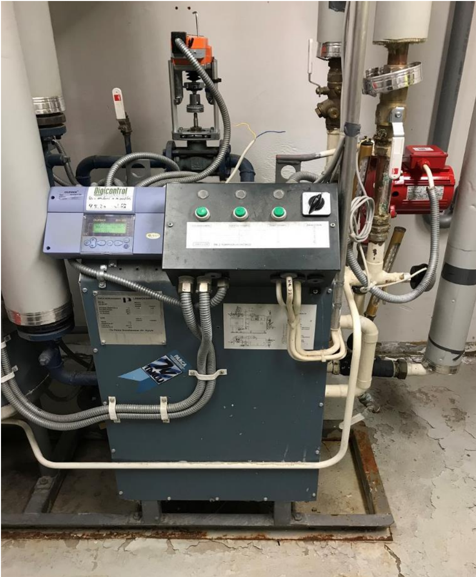
Kuva 6.3. Lämmönvaihdinpaketti on 1980 luvun puolesta välistä.
