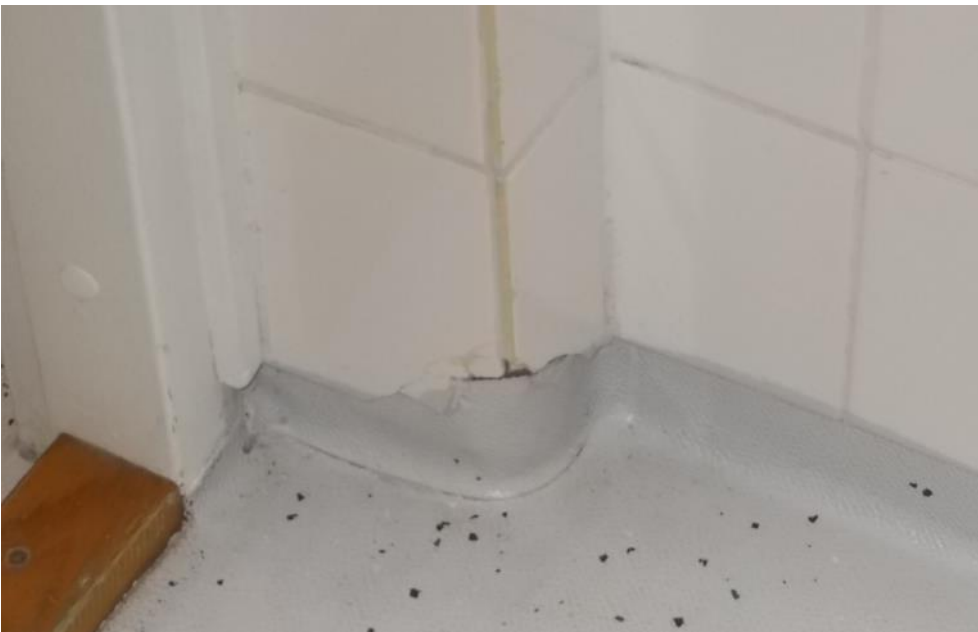
Kuva 4.8. Rikkoutuneita laattoja Pesuhuoneessa 202.
