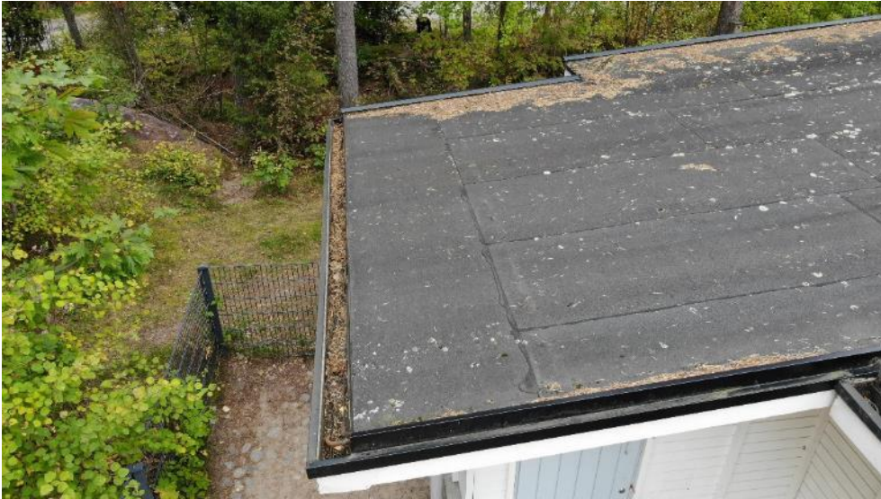
Kuva 4.1. Vesikatto ja sadevesikourut ovat puhdistamatta.
