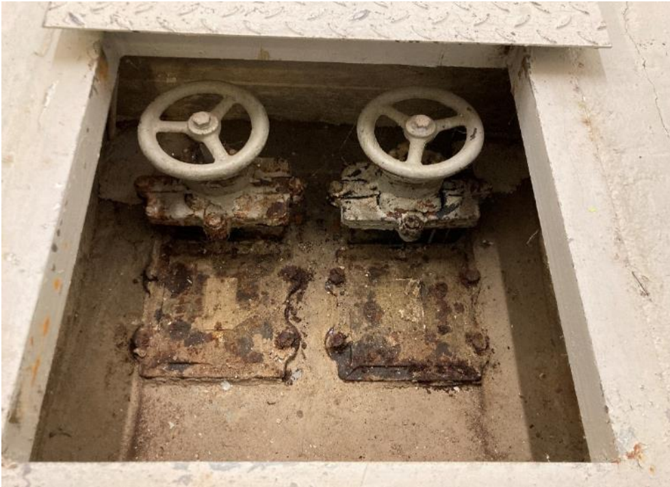
Kuva 5.8. Väestösuojan padotusventtiilit ovat pahoin ruostuneet.
