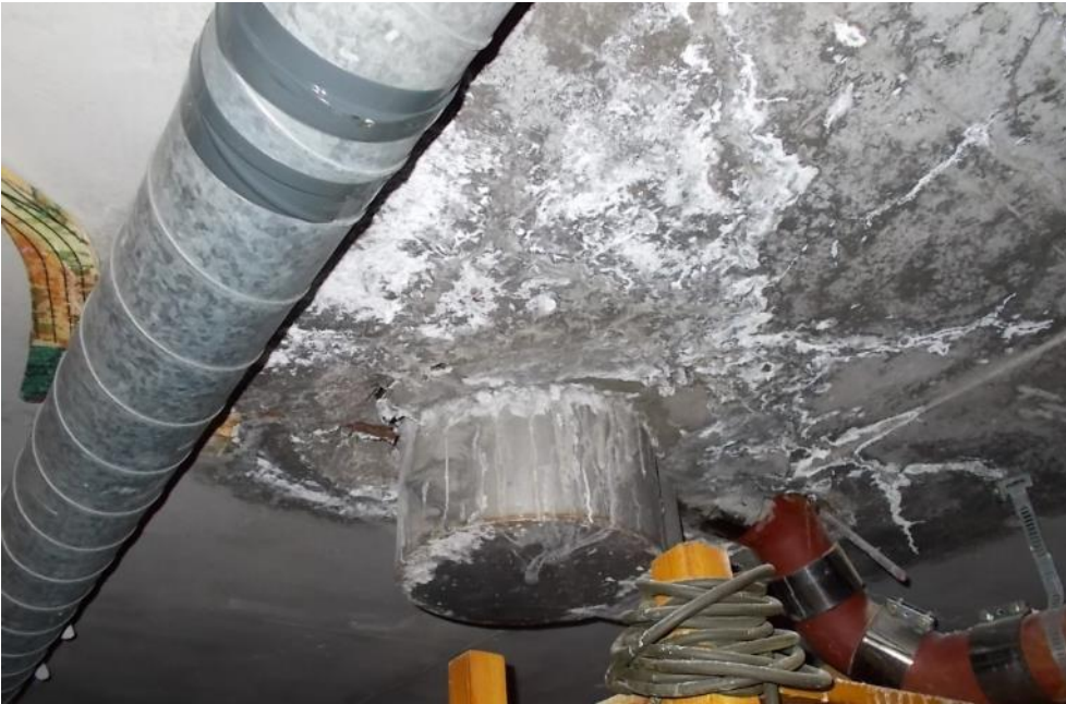
Kuva 4.9. Kosteusvaurio Varastossa 003. Kuvassa näkyy myös yläkerran Keittiön lattiakaivo ja sen viemärointi.
