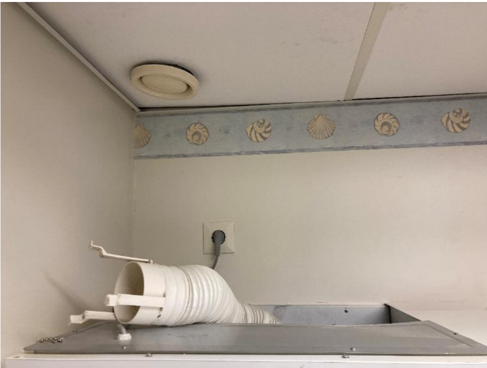
Kuva 5.3. Kuivauskaapin poistoletku on irti.
