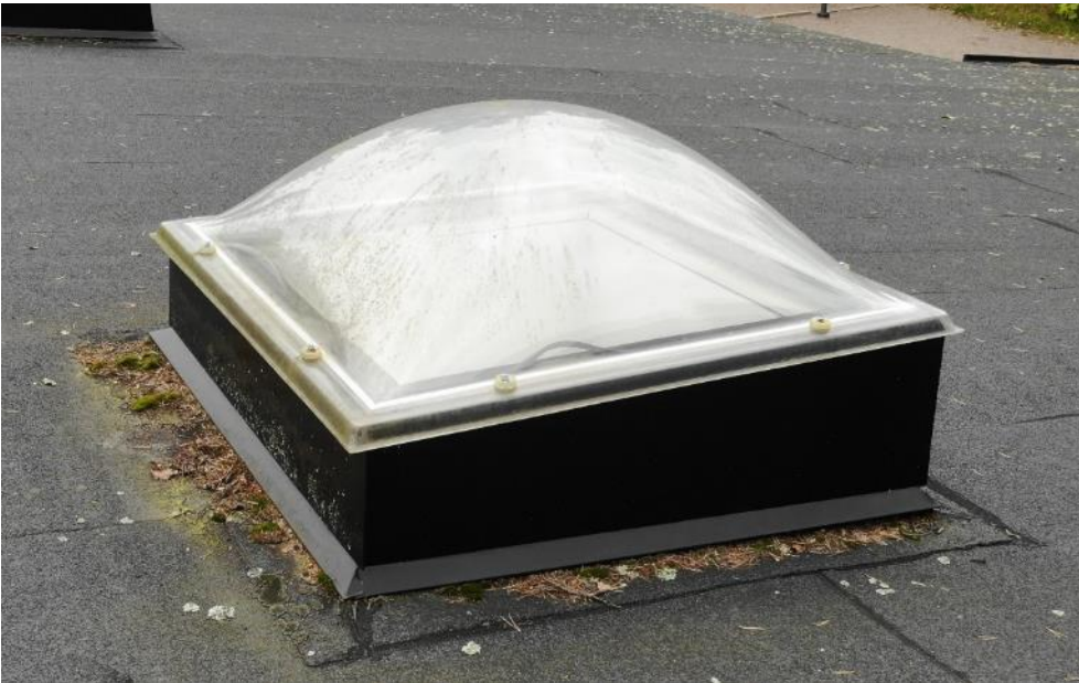
Kuva 4.4. Kattokuvun tiivisteet ovat osin pois paikoiltaan.
