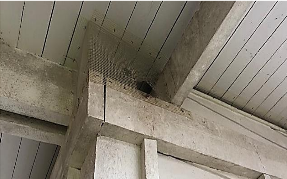
Kuva 4.5. Pieneläinverkossa on oravan tekemä kulkuaukko.
