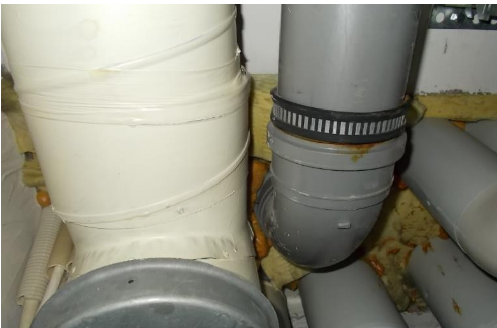
Kuva 4.10. Läpivientejä Teknisessä tilassa 008.
