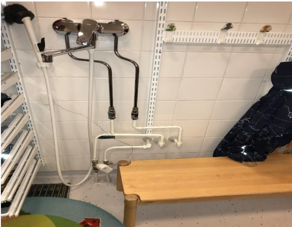
Kuva 5.5. Lattialämmitys on kytketty käyttöveteen.
