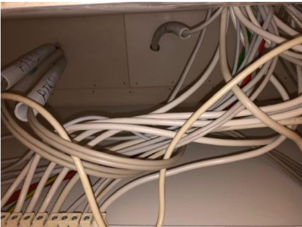
Kuva 4.9. Sähkökeskuskomeron 22a katon läpivientejä.
