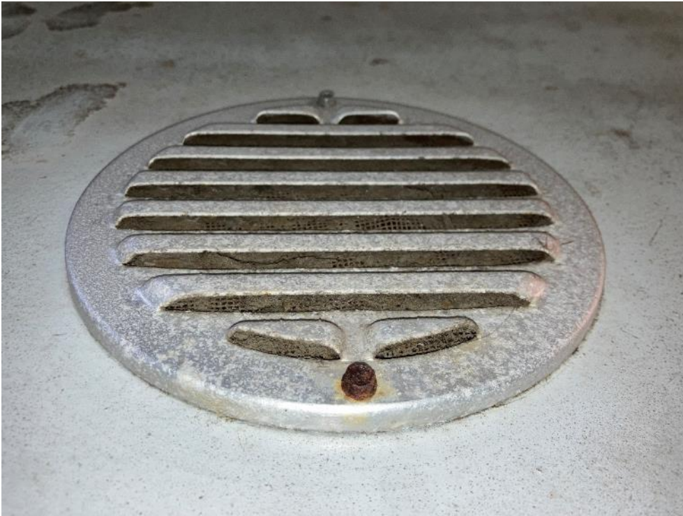
Kuva 5.4. Teknisen tilan korvausilmasäleikkö on tukossa.
