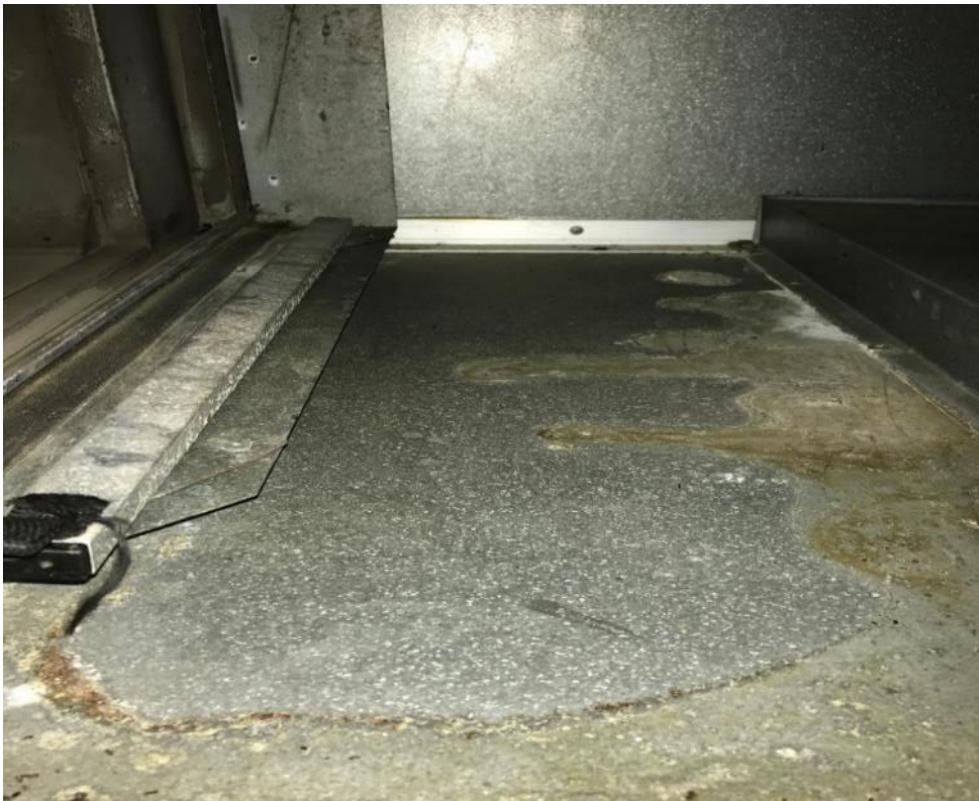
Kuva 5.3. Ilmastointikoneen sisälle pääsevä lumi sulaa vedeksi.
