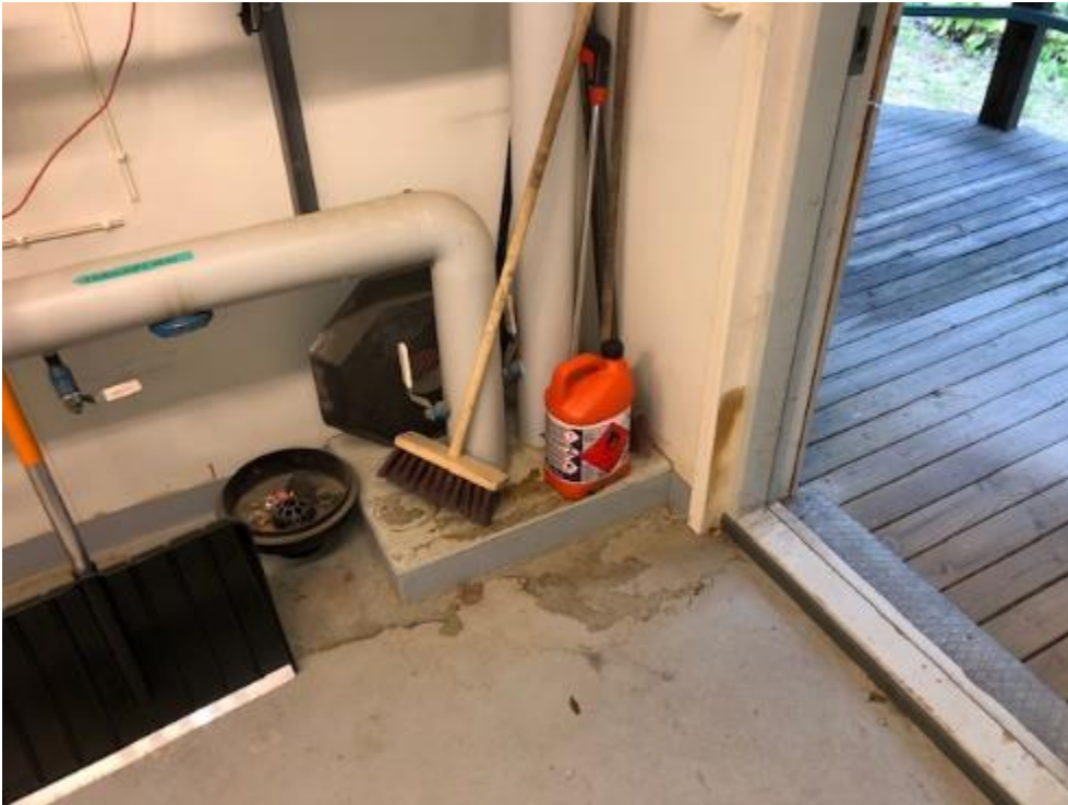
Kuva 4.8. Yhdistetyssä Sähköpääkeskus, Lämmönjakohuone ja Ilmastointikonehuone säilytetään ruoholeikkurin pienkonebensaa.
