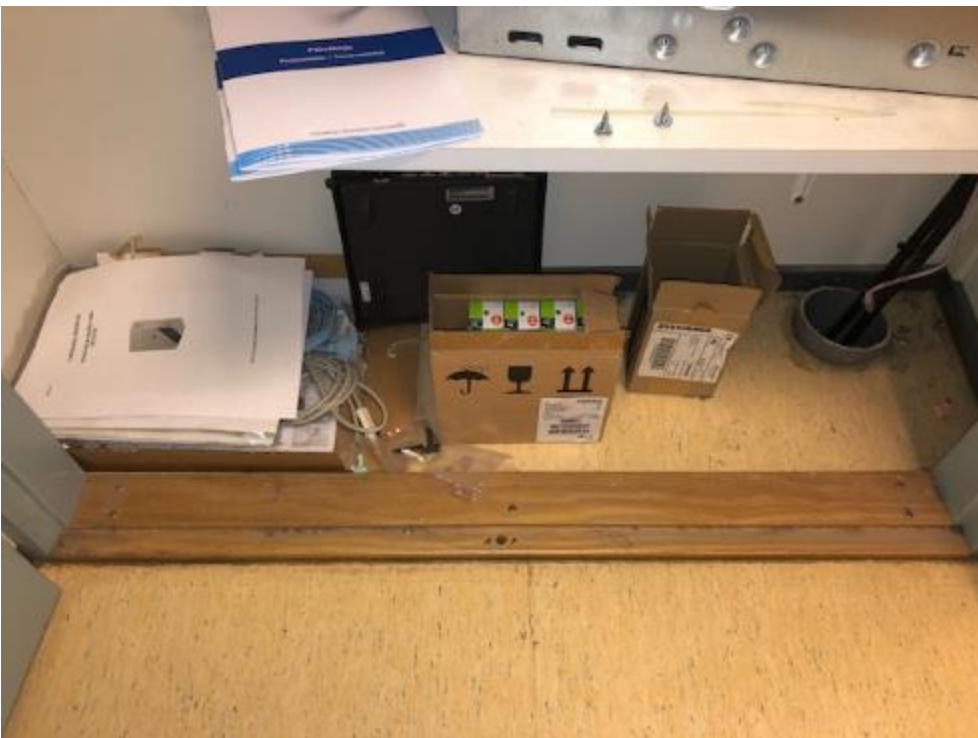
Kuva 4.11. Sähkökeskuskomeron 22a lattialla on varastoituna tavaraa.
