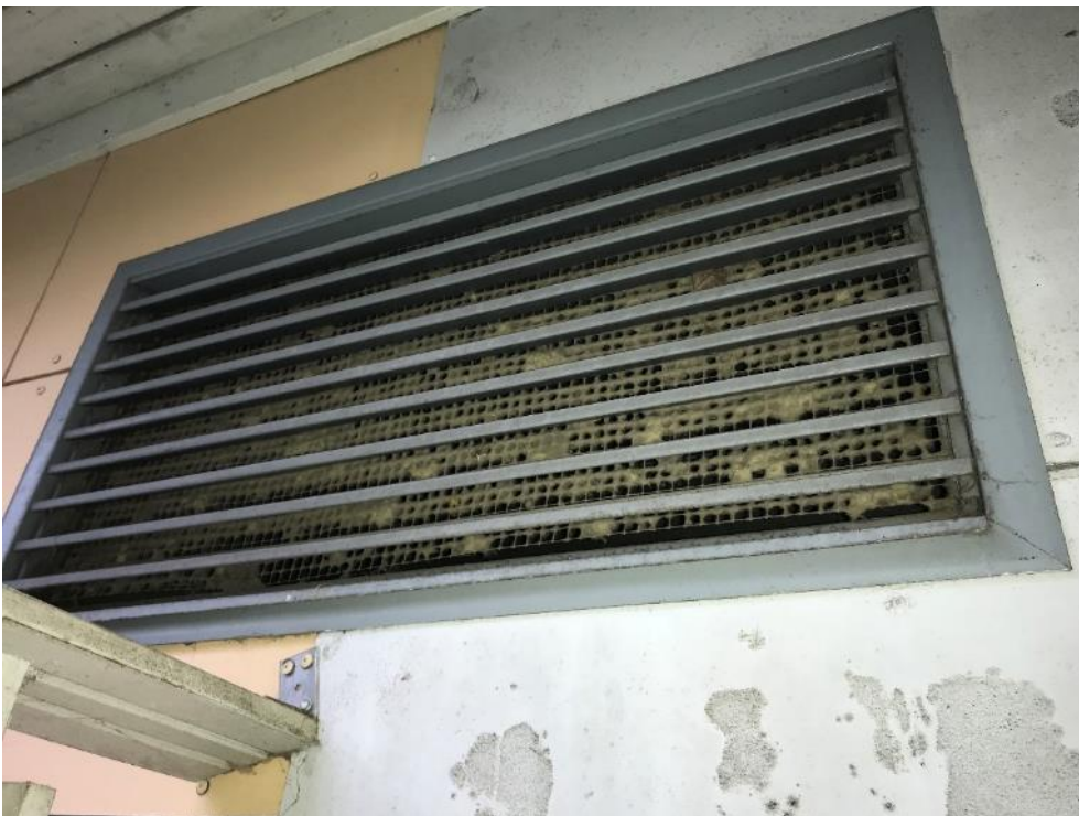
Kuva 5.1. Raitisilmasäleikössä on likaa.
