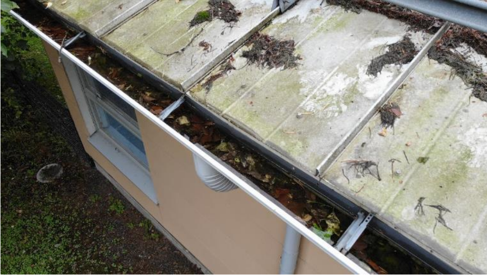
Kuva 4.4. Sadevesikourut ovat puhdistamatta.
