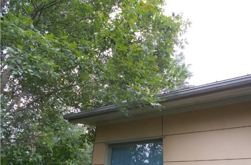
Kuva 4.2. Puiden oksat ylettyvät vesikatolle.
