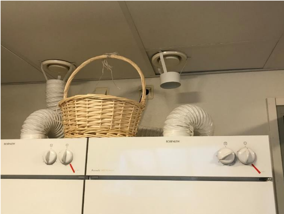
Kuva 5.6. Eteisen kuivauskaapin poistoilmaletku on irti.
