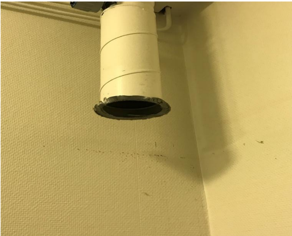
Kuva 5.7. Työtilan 019 poistoilmaventtiili puuttuu.
