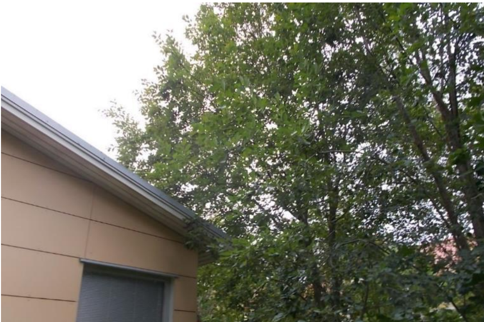
Kuva 4.1. Puiden oksat ylettyvät vesikatolle.
