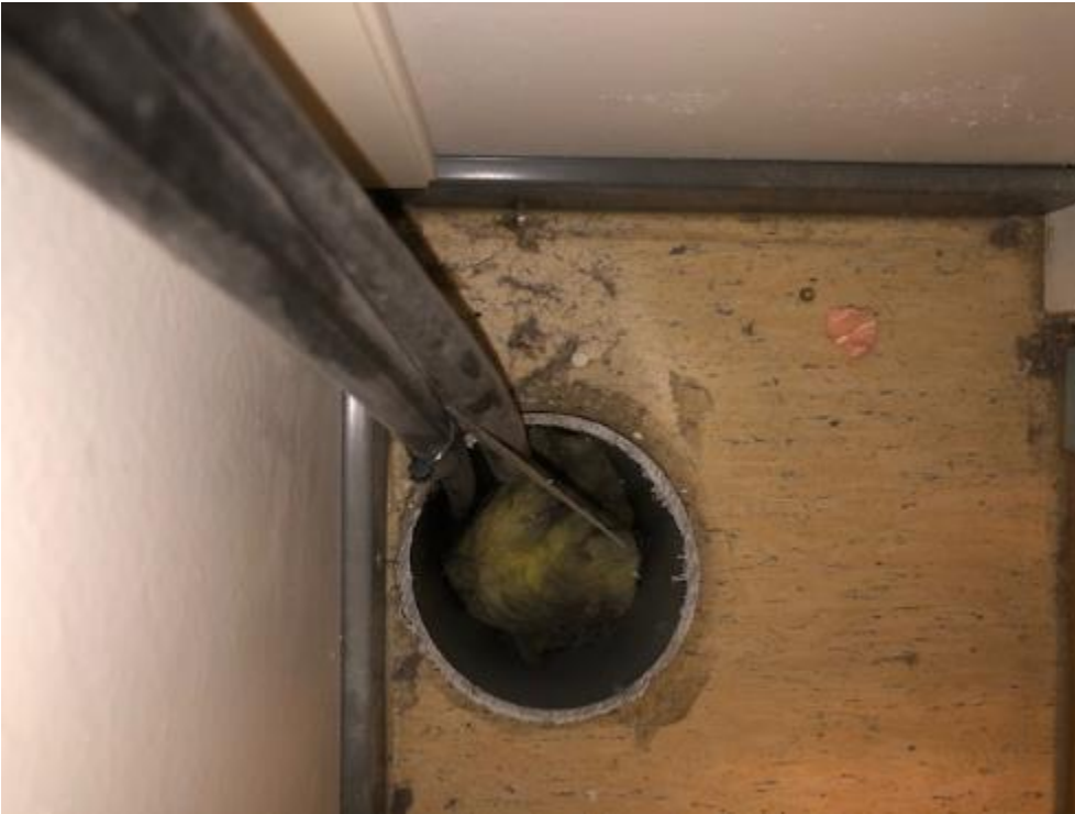
Kuva 4.10. Sähkökeskuskomeron 22a kaapelien nousuputki on lattiassa tiivistetty eristevillalla.
