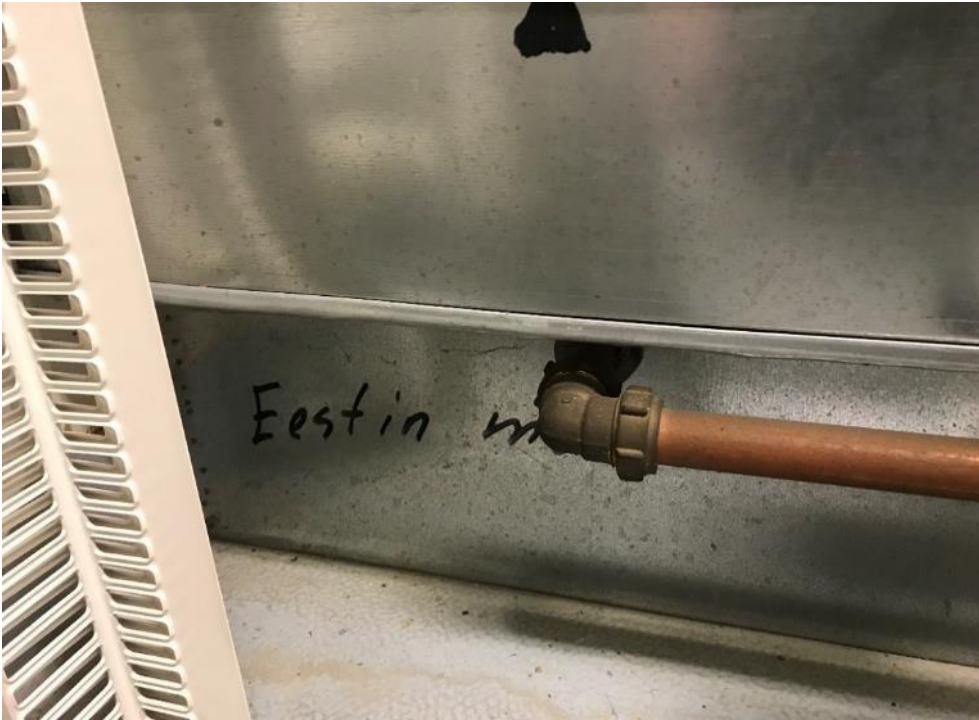
Kuva 5.2. Raitisilmakammion ja ilmanvaihtokoneen viemäröinnin takaimusuojat puuttuvat.
