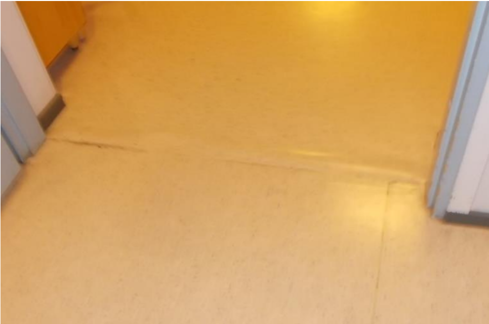
Kuva 4.6. Lattiamatto on osin irti alustastaan.
