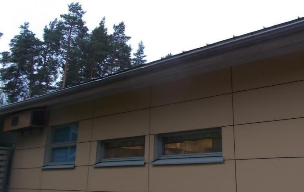
Kuva 4.3. Sadevesikouru on notkolla.
