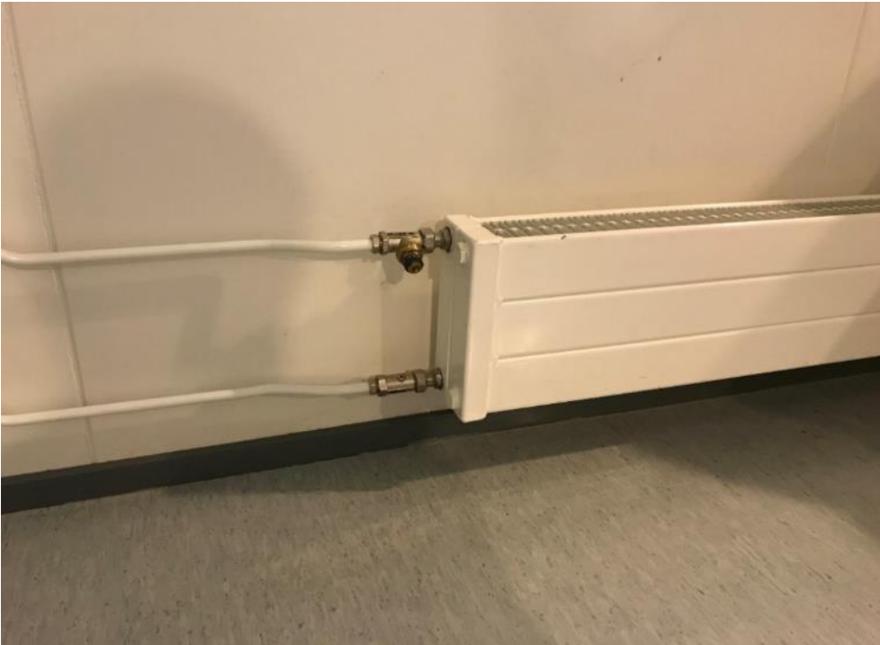
Kuva 5.10. Patteritermostaatin säätöosa puuttuu.
