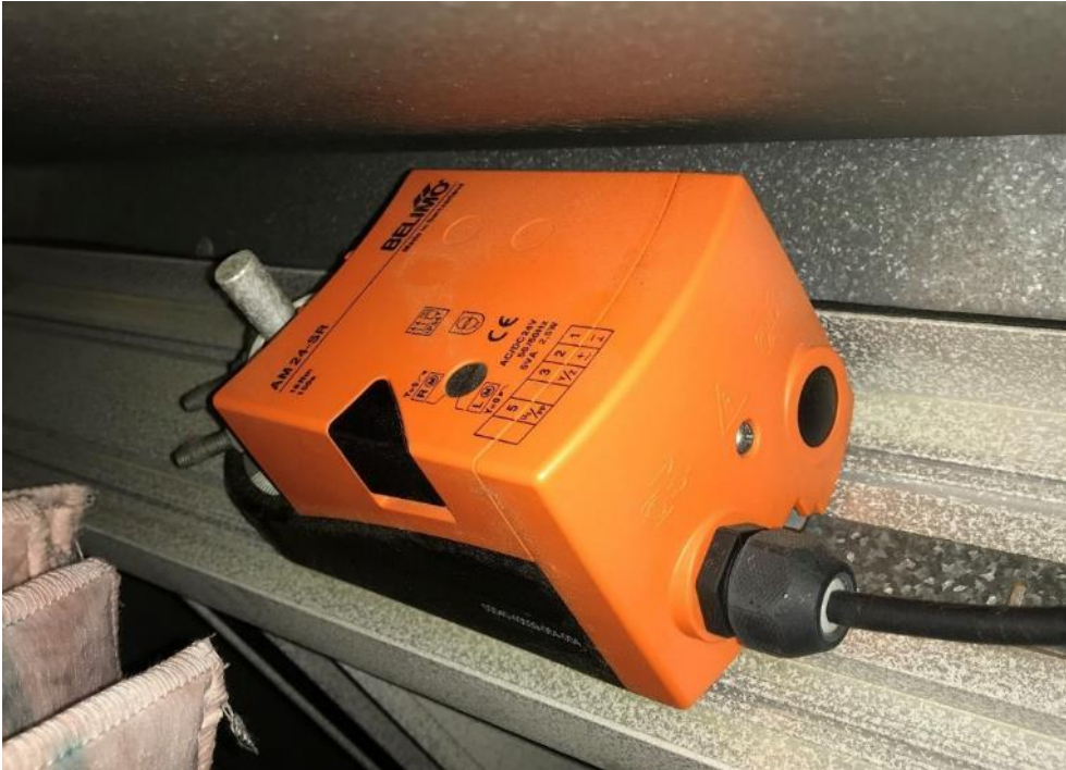
Kuva 6.1. Lämmöntalteenoton LTO-peltimoottori surisee paikallaan ja pelti on jumissa (tilattu korjaus).
