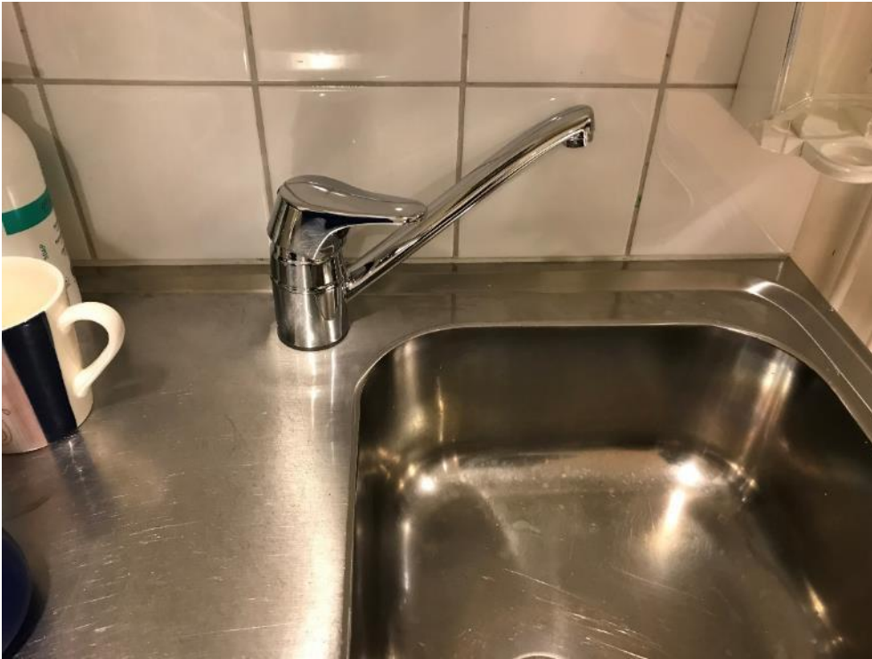
Kuva 5.8. Pesualtaan sivuliikerajoitin puuttuu.
