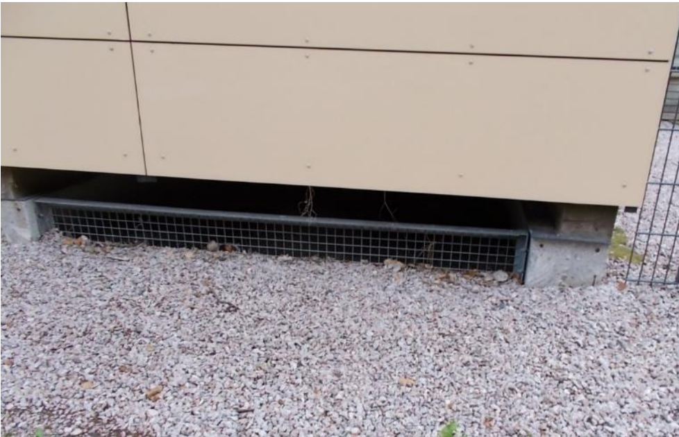
Kuva 4.5. Alapohjan pieneläinverkot ovat liian pienet.
