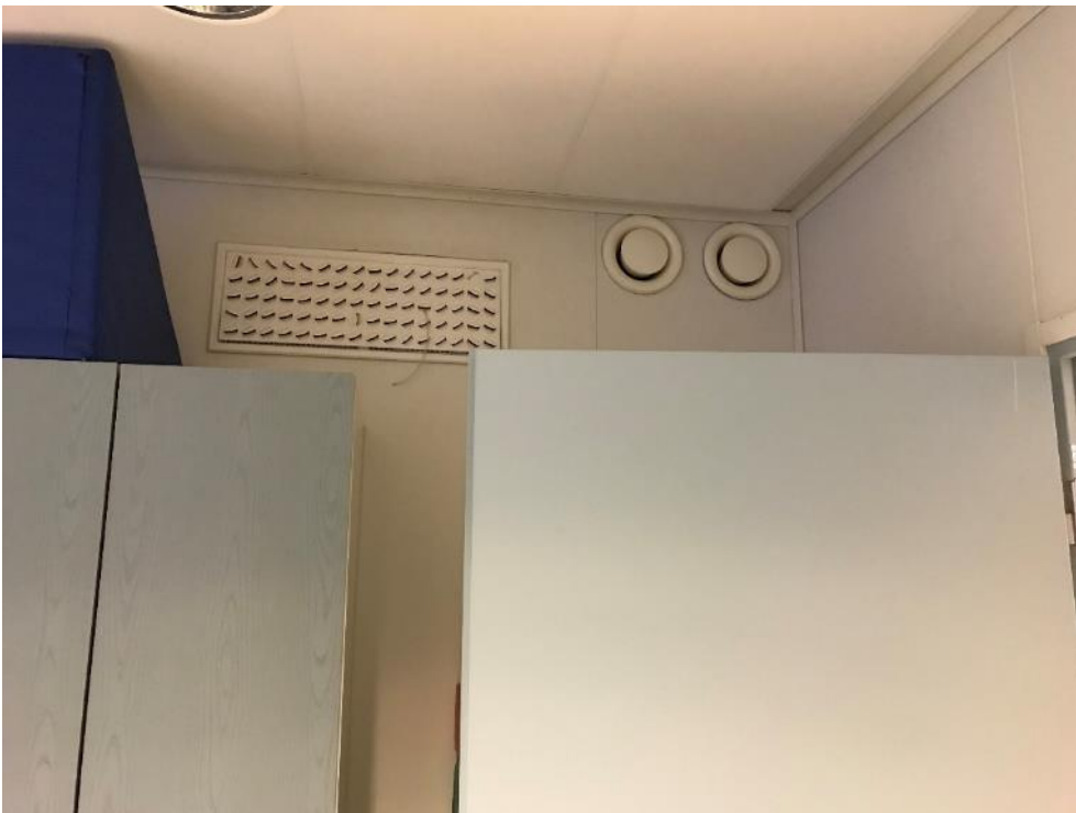
Kuva 5.5. Tuloilmaelimen ilmavirran heittokuviota ei ole suunnattu oikein.
