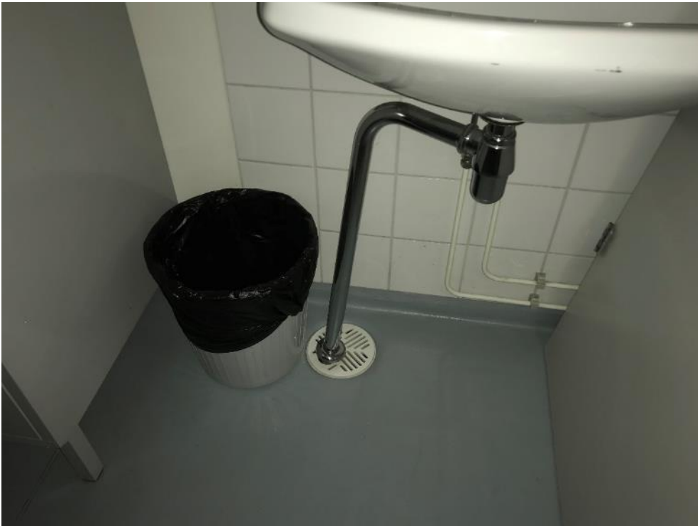
Kuva 5.9. Pesualtaiden viemäröinnin pystykannakointi puuttuu.
