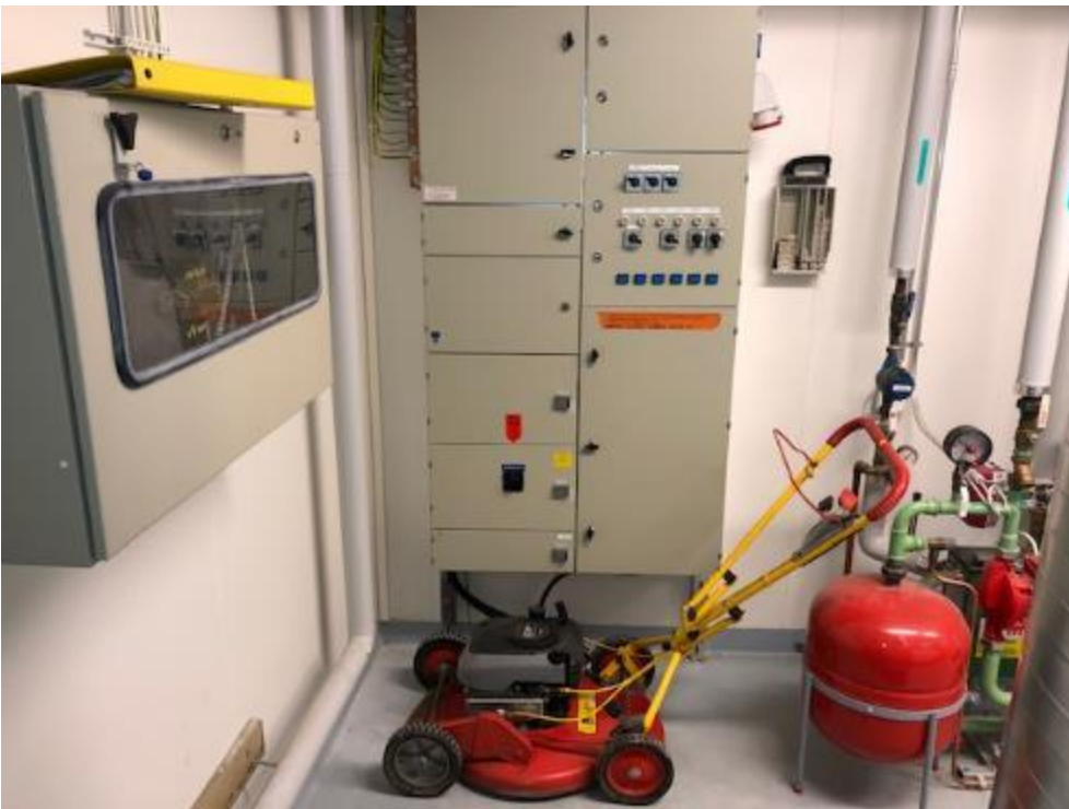
Kuva 4.7. Yhdistetyssä Sähköpääkeskus, Lämmönjakohuone ja Ilmastointikonehuone säilytetään ruoholeikkuria Sähköpääkeskuksen edessä.
