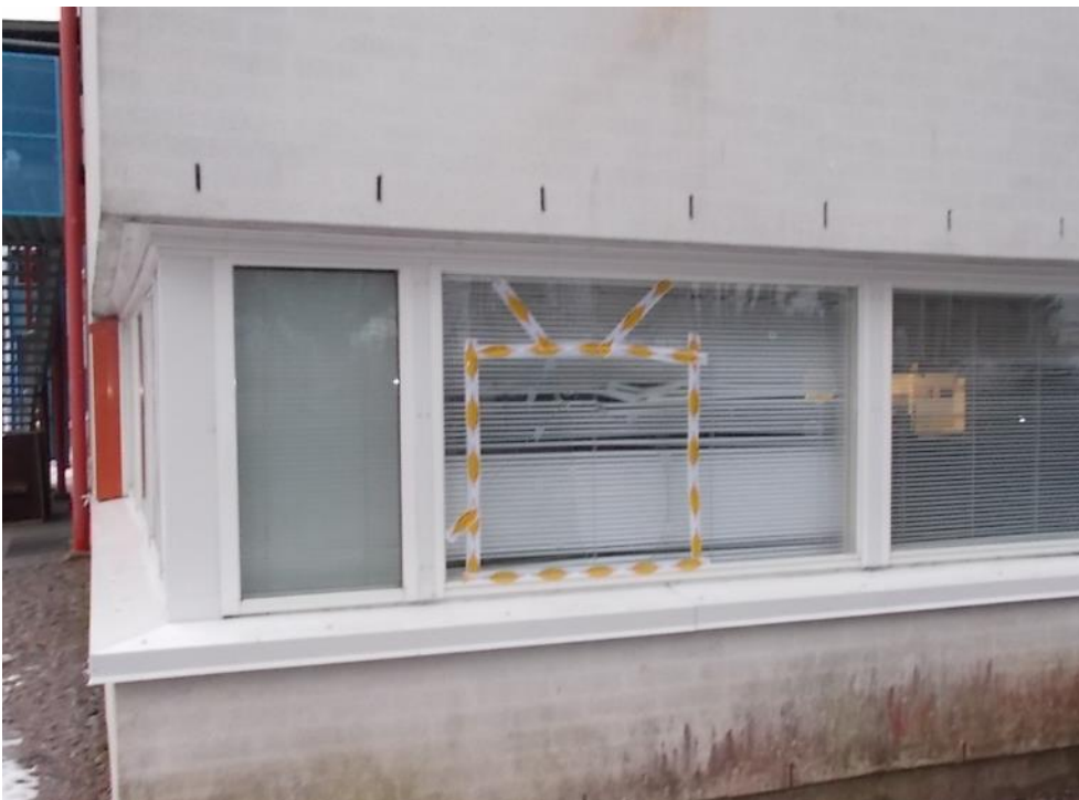
Kuva 4.4. Rikkinäinen ikkuna Luokassa 1038.
