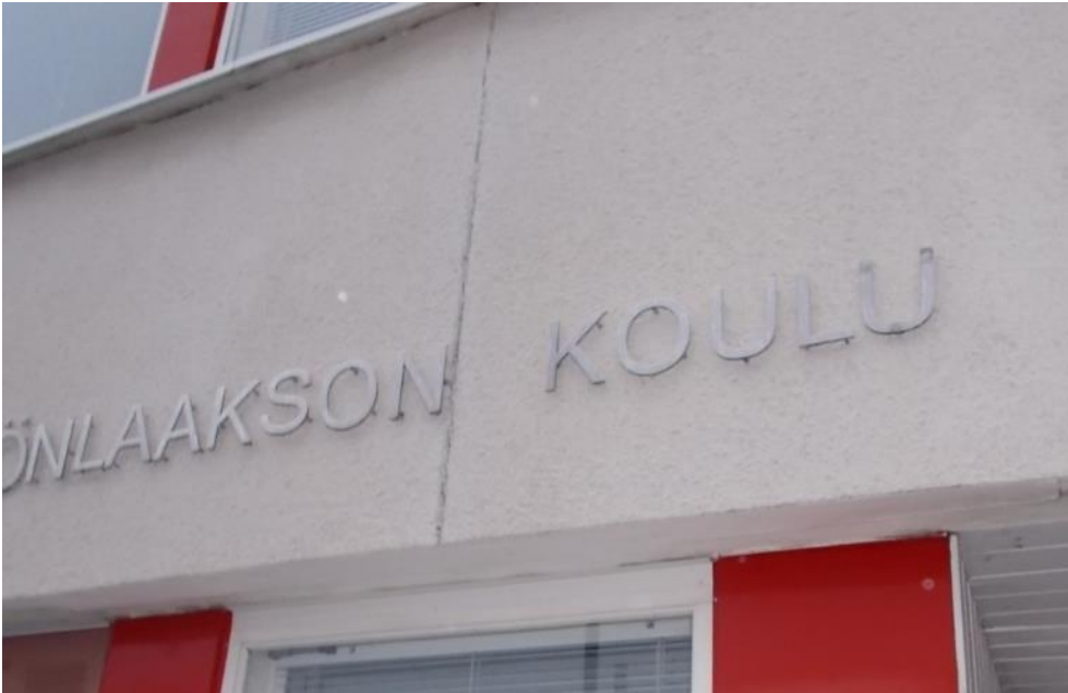
Kuva 4.1. Julkisivurappauksessa on halkeama.
