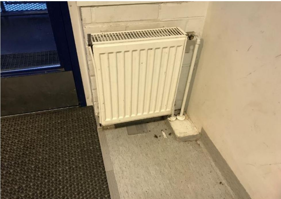
Kuva 5.11. Lämmityspatterin termostaattiosa puuttuu.
