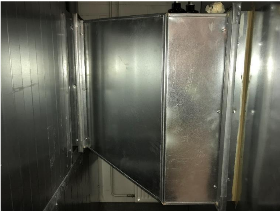
Kuva 5.5. Raitisilmakanavan osa on ilman lämpöeristettä.
