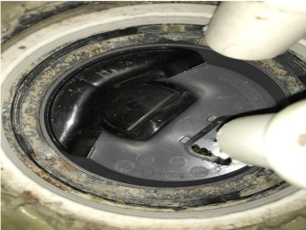
Kuva 5.6. Lattiakaivoja on ilman vettä.
