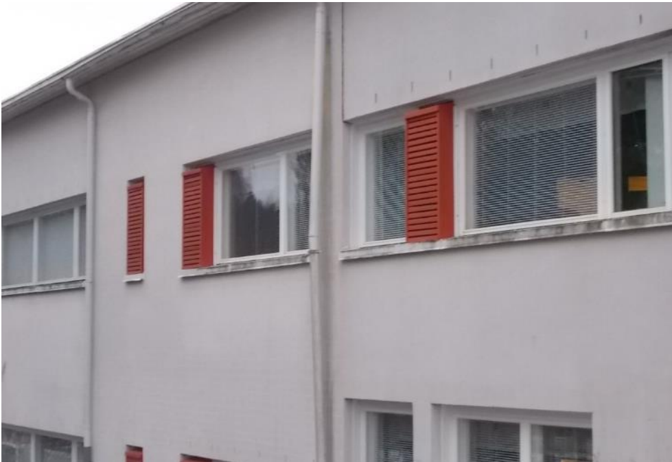
Kuva 4.5. Sadevesisyöky on irti seinästä.
