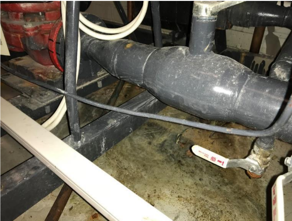
Kuva 5.9. Lämpimän käyttöveden lämmönsiirrin vuotaa.
