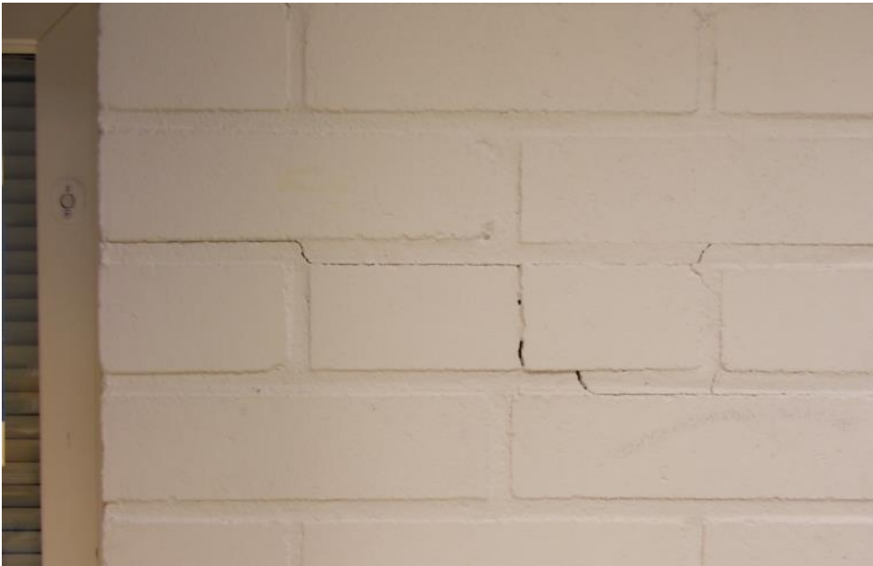
Kuva 4.15. Halkeama Luokan 2011 seinässä.
