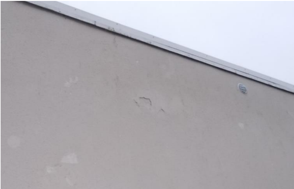
Kuva 4.3. Julkisivurappaus on paikoitellen irti.
