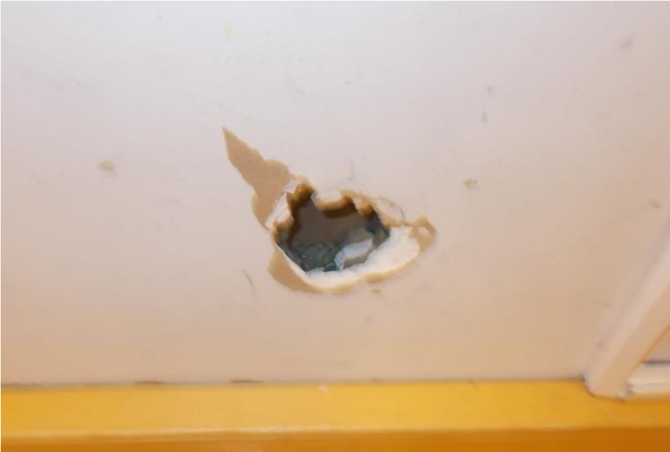
Kuva 4.13. Paikkaamaton reikä Liikuntasalin seinässä.
