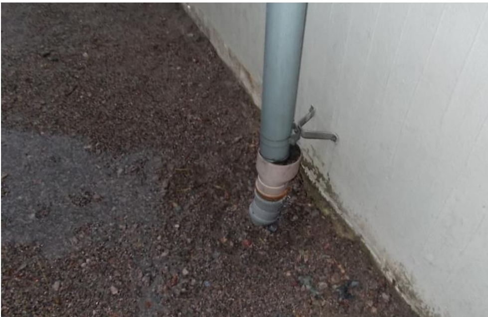
Kuva 5.13. Sadevesiviemäröinti on tukossa.
