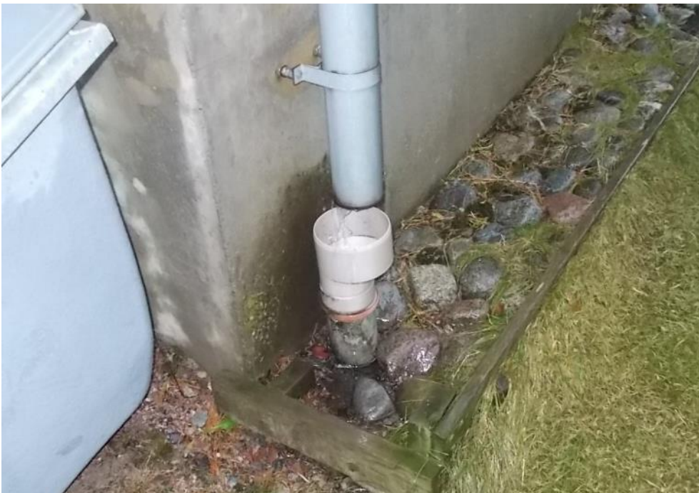
Kuva 4.8. Sadevesisyöksyputki ei ole kohdallaan.
