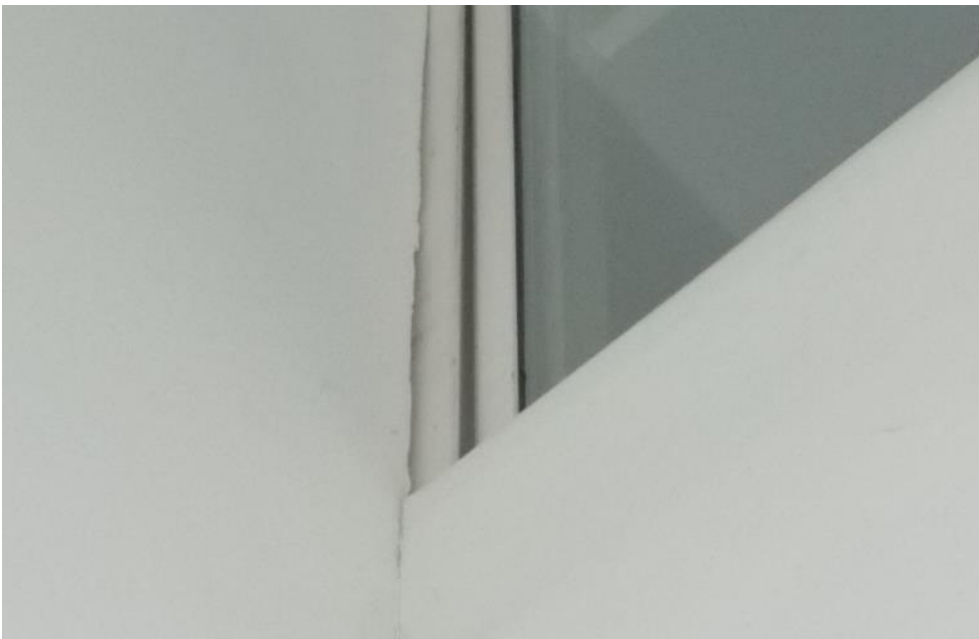
Kuva 4.10. Kattoikkuna on osin auki Aulassa 2026.
