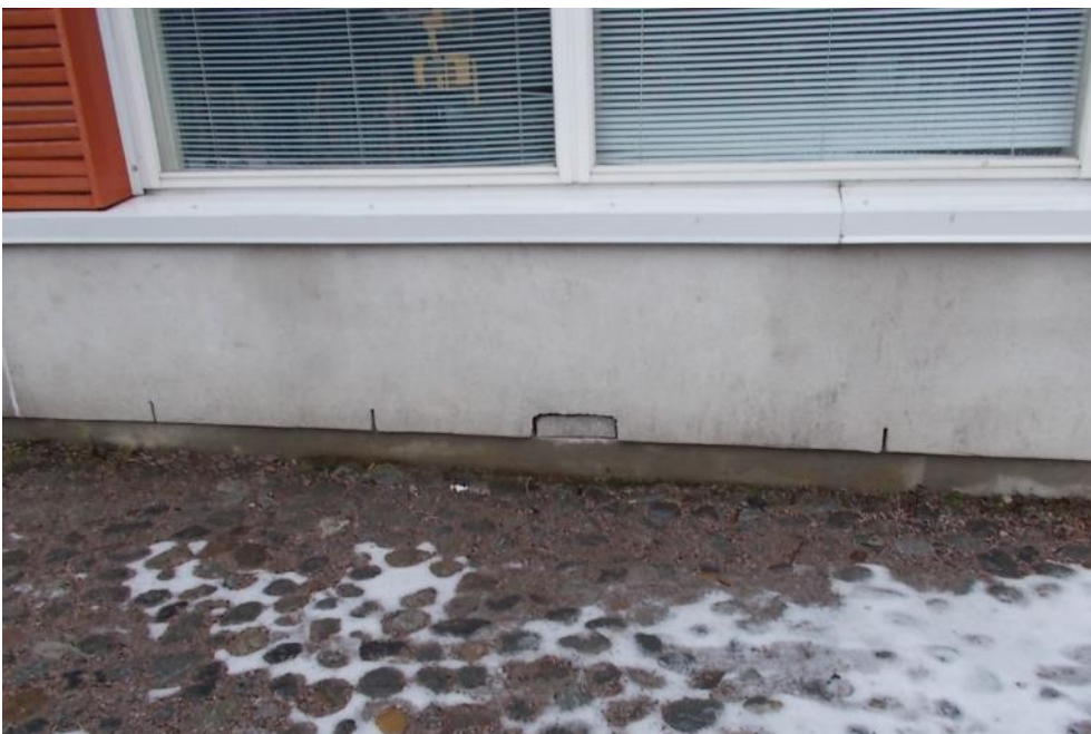
Kuva 4.6. Julkisivussa on irtonainen tiili.
