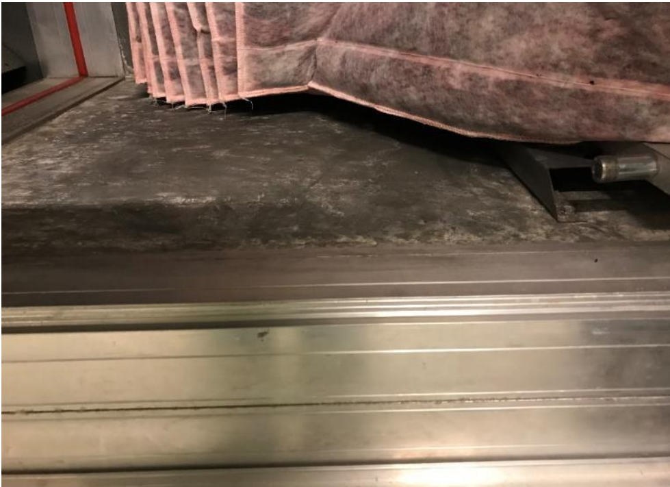
Kuva 5.2. Ilmanvaihtokanavistossa ja koneissa on likaa ja epäpuhtauksia.
