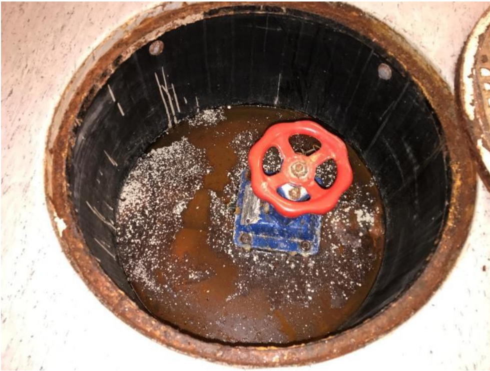
Kuva 5.14 Padotusventtiilikaivossa on vettä.
