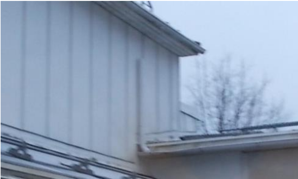
Kuva 4.7. Sadevesisyöksyputkesta puuttuu osa.
