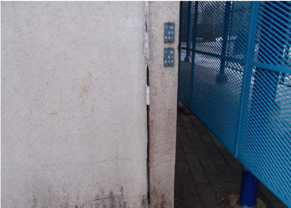
Kuva 4.9. Liikuntasaumaus on puutteellinen.
