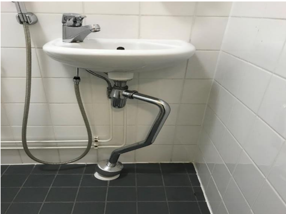
Kuva 5.7. Eteisen WC:n lavuaarin viemäriputki on ilman kannaketta.
