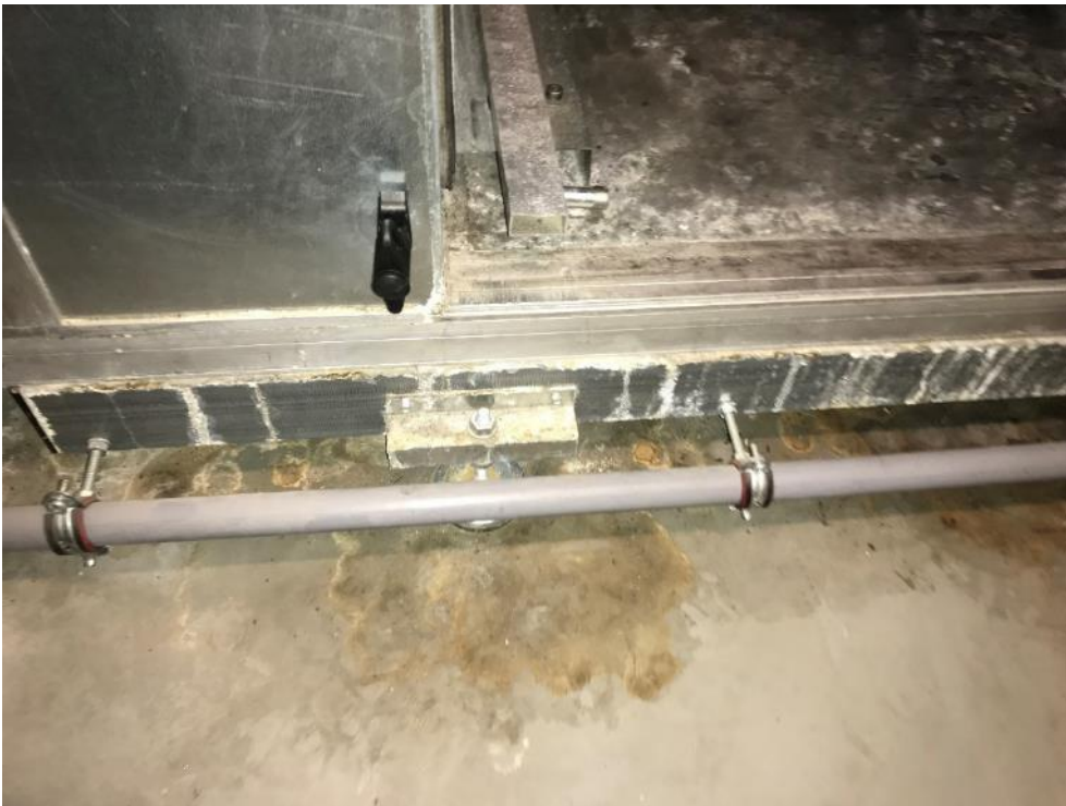
Kuva 5.1. Ilmanvaihtokone TK1 suodatinkammioon pääsee lumen sulamisvesi.
