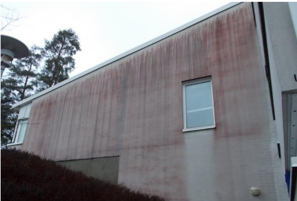
Kuva 4.2. Julkisivussa on punajäkälää.
