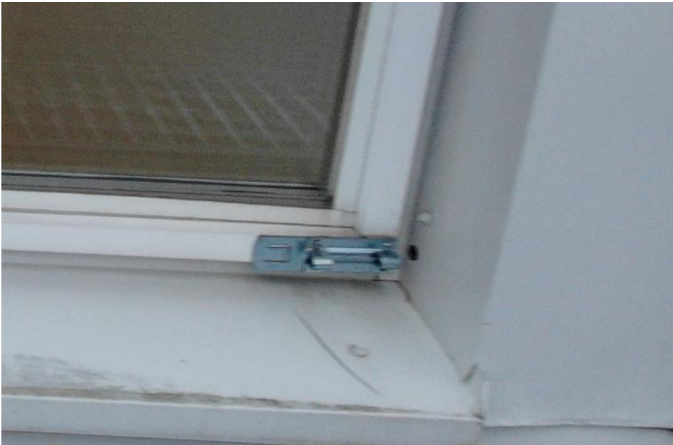
Kuva 4.11. Työntösälpa on rikki Aulan 2026 ikkunassa ulkopuolella.
