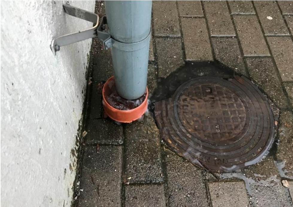
Kuva 5.12 Rännikaivo on tukossa.
