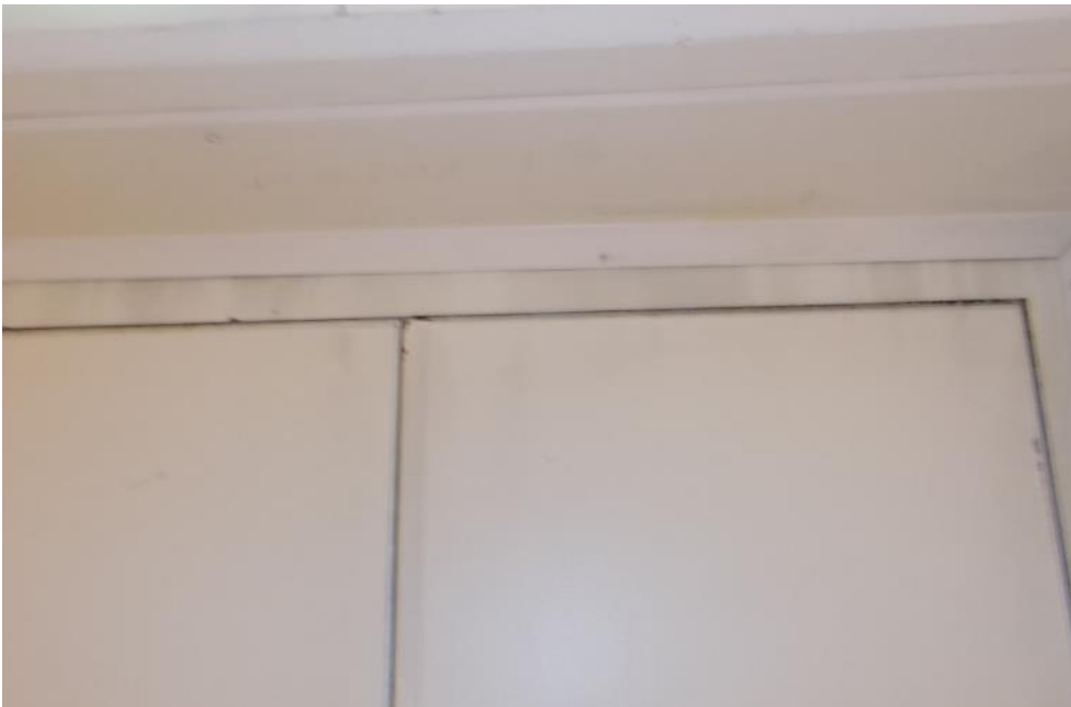
Kuva 4.12. Ilmavuotoa Liikuntasalin ulko-ovesta.
