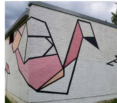
Muuntamon seinät teipataan tai maalataan alueen identiteettiin sopivilla kuvilla, kuten kasvillisuudella tai linnuilla.
