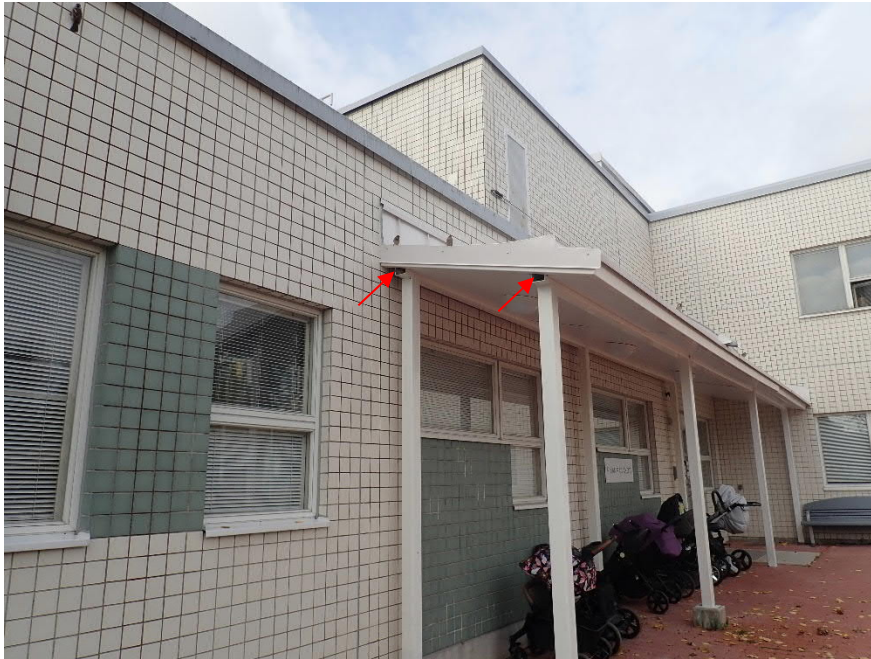
Kuva 6. Linnut pesivät sisäänkäynnin katoksen rakenteissa. Niiden havaittiin kulkevan rakenteeseen teräsrunkojen raoista.
