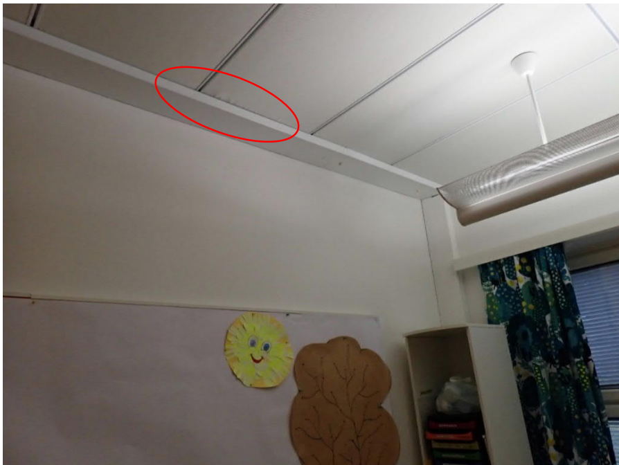
Kuva 3. Akustiikkalevyn pinnassa havaittiin pullistumia, ensimmäisen kerroksen tila 126.
