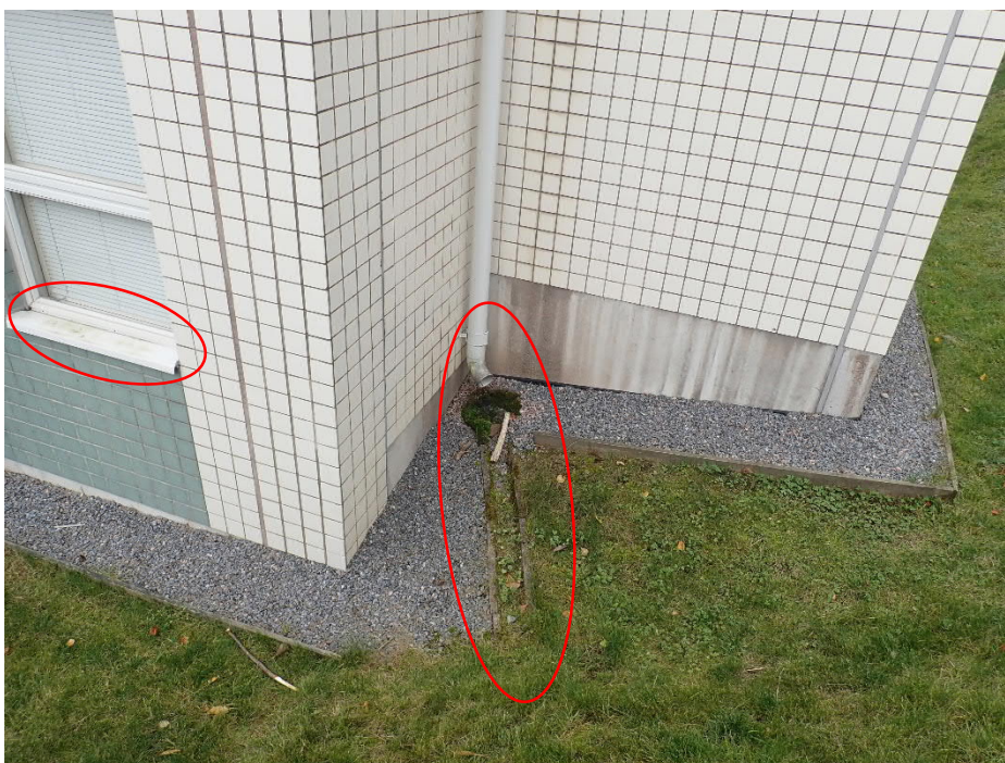
Kuva 4. Ikkunapellitys kallistaa väärään suuntaan. Sadevesijärjestelmä on sammaloitunut.
