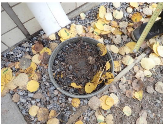
Kuva 5. Leikkiuhan puoleinen sadevesikaivo on tukossa.
