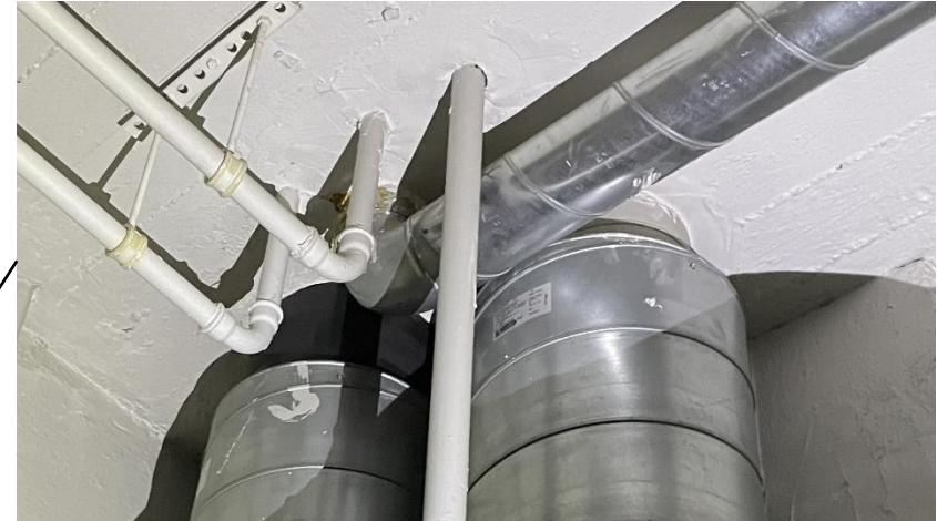
Läpiviennit tiivistetty, pieniä rakoja
