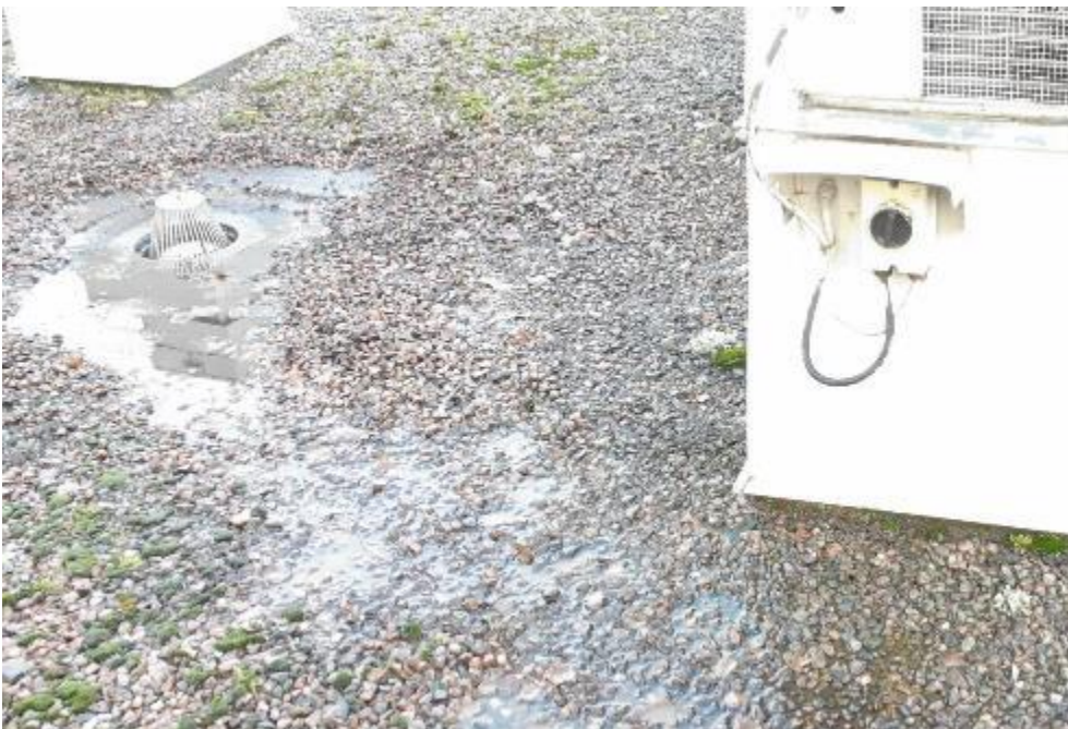
Kuva 4.2. Vesikatolla seisoo vettä.
