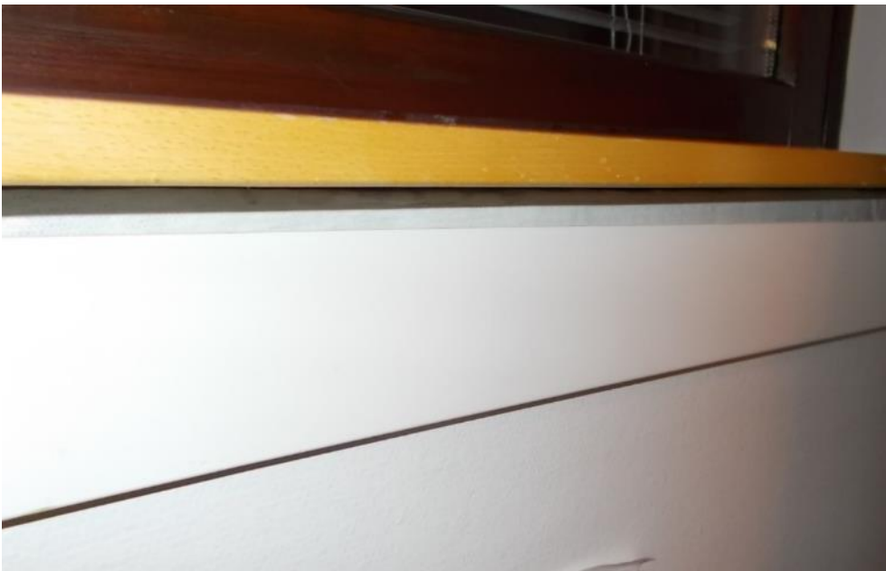
Kuva 4.4. Huonetiloissa ikkunalautojen liittymä ei ole tiivis.
