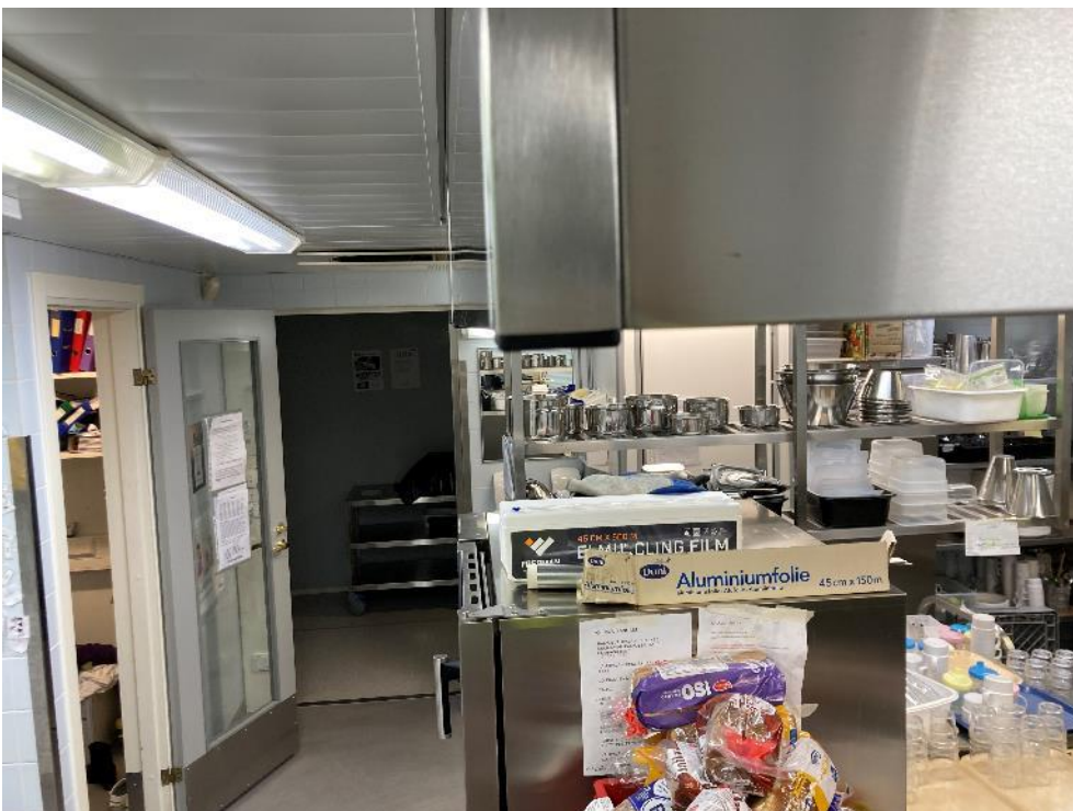
Kuva 5.2. Uuni on liian lähellä huuvin reunaa ja uunin lämpö sekä höyryt menevät poistoilman huuvin ohi keittiötilaan.
