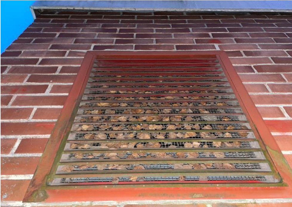
Kuva 5.1. Ulkosäleiköissä on lehtiä.
