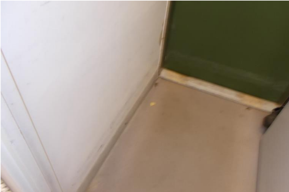
Kuva 4.5. Keittiön ulko-oven vieressä on kosteusvaurio.
