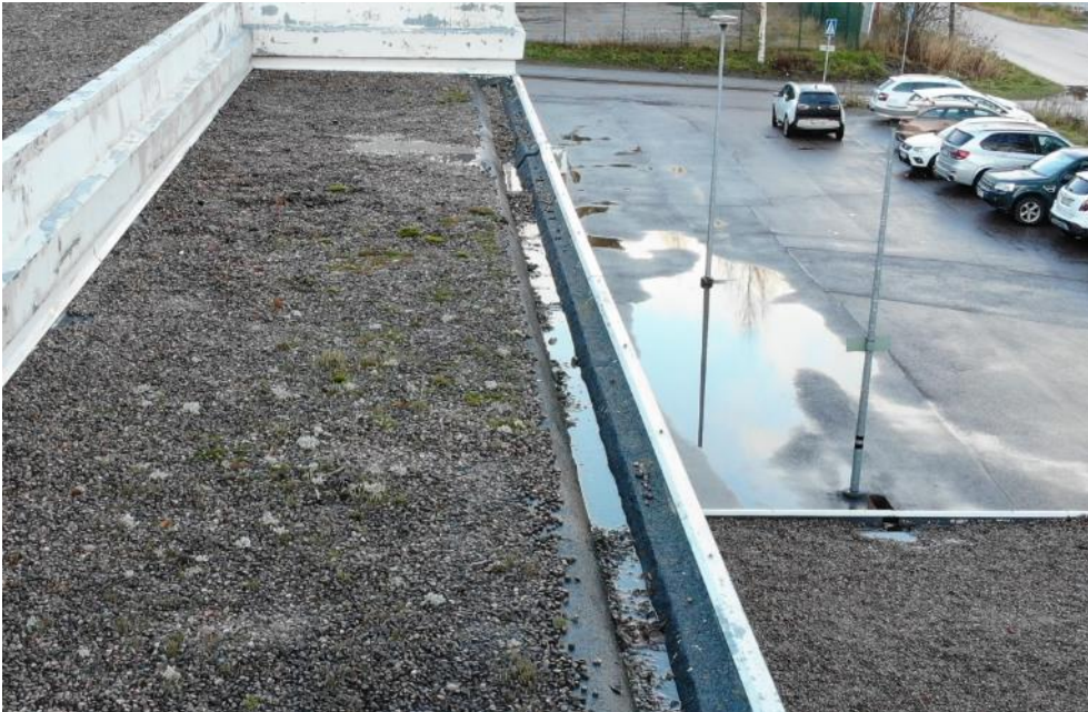
Kuva 4.3. Sadevesikourut ovat puhdistamatta ja vesikertymä on parkkipaikalla.
