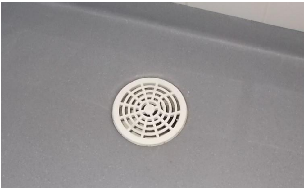
Kuva 4.2. Lattiamatto on alustastaan irti lattiakaivon vieressä Suihkuhuoneessa 121.
