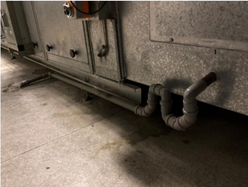
Kuva 5.1. Raitisilmakammion takaimusuoja puuttuu.
