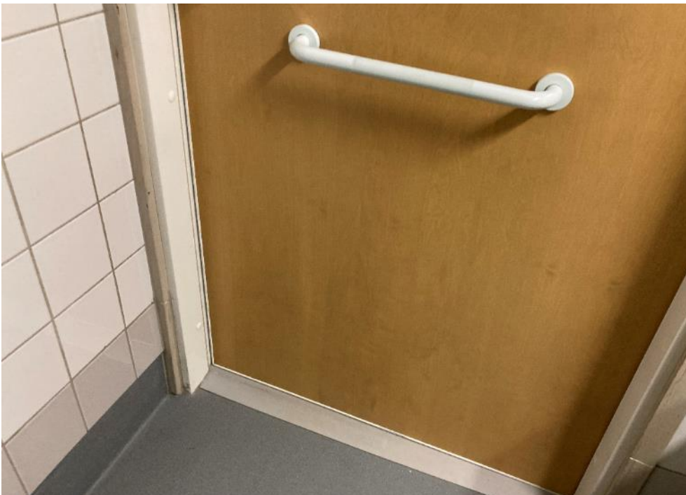
Kuva 5.3. Useiden tilojen oviraot puuttuvat tai ne ovat liian pienet.
