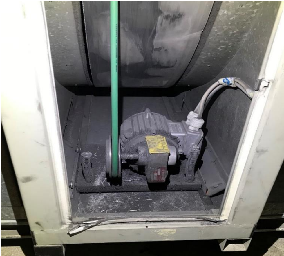
Kuva 6.2. Ilmanvaihtokoneen TK05 LTO-kiekko on kulunut merkittävästi.
