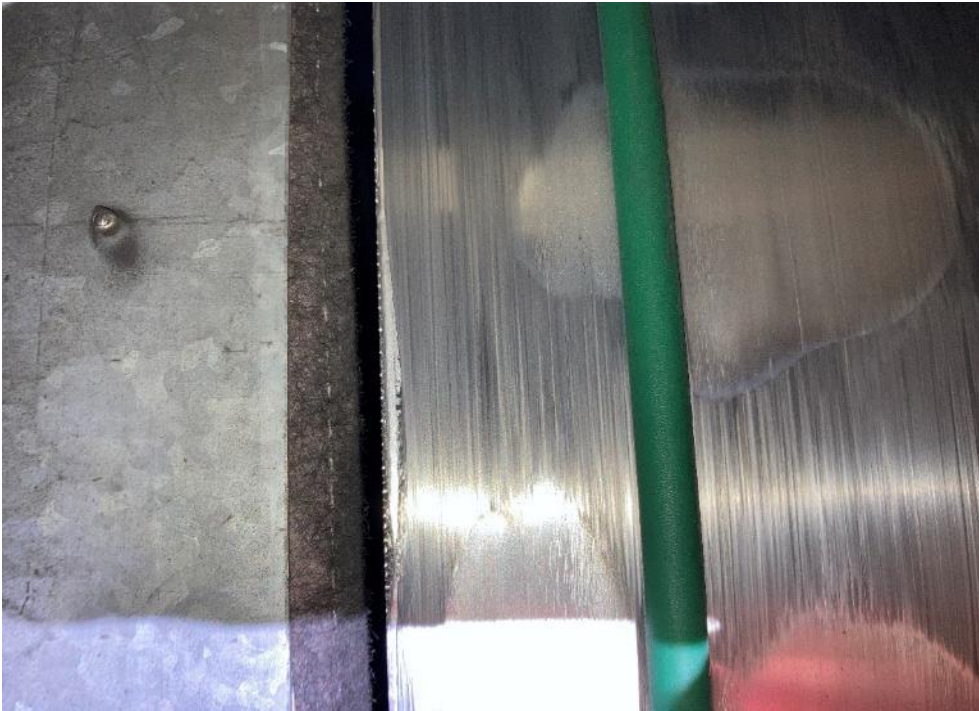
Kuva 5.2. Ilmanvaihtokoneen lämmöntalteenotossa tapahtuu ohivirtausta.
