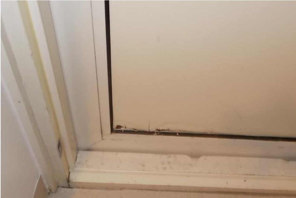
Kuva 4.1. Ulko-ovi on vaurioitunut Käytävällä 220.
