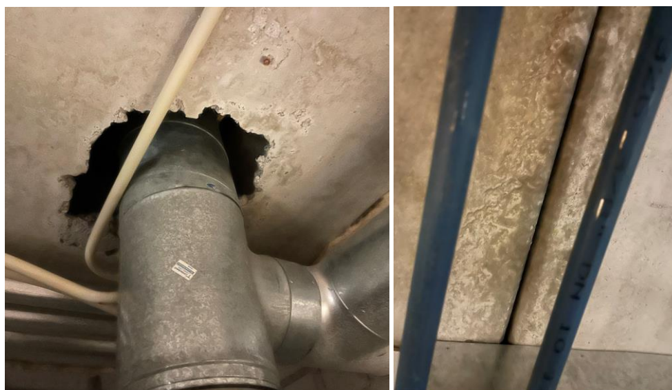
Kuvat 9-10. Eteisessä 227 on henkilökunnan mukaan tullut vettä katosta useaan kertaan. Ontelolaatan saumakohdilla näkyi mahdollisesti vanhoja vesivuotojälkiä. Pintasivelynäytteessä ei havaittu poikkeavaa mikrobikasvustoa (näyte MP7). Yläpohjan läpiviennit ja ontelolaatan saumat olivat täysin tiivistämättömiä.
