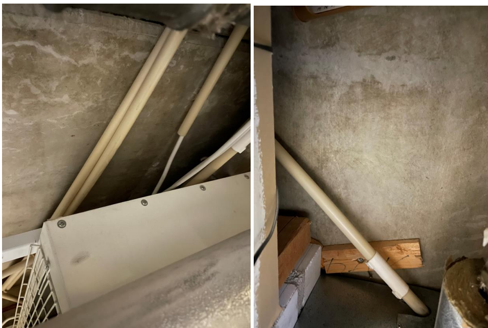
Kuvat 7-8. Tuulikaapissa 226 oli henkilökunnan mukaan tullut aiemmin vettä katosta. Ontelolaatan pinnassa näkyi mahdollisesti vanhoja vesivuotojälkiä. Ontelolaatan alapinnassa ei havaittu kosteutta. Pintasivelynäytteessä ei havaittu poikkeavaa mikrobikasvustoa (näyte MP6). Alakaton yläpuolella havaittiin avoimia mineraalivillakuitupintoja.
