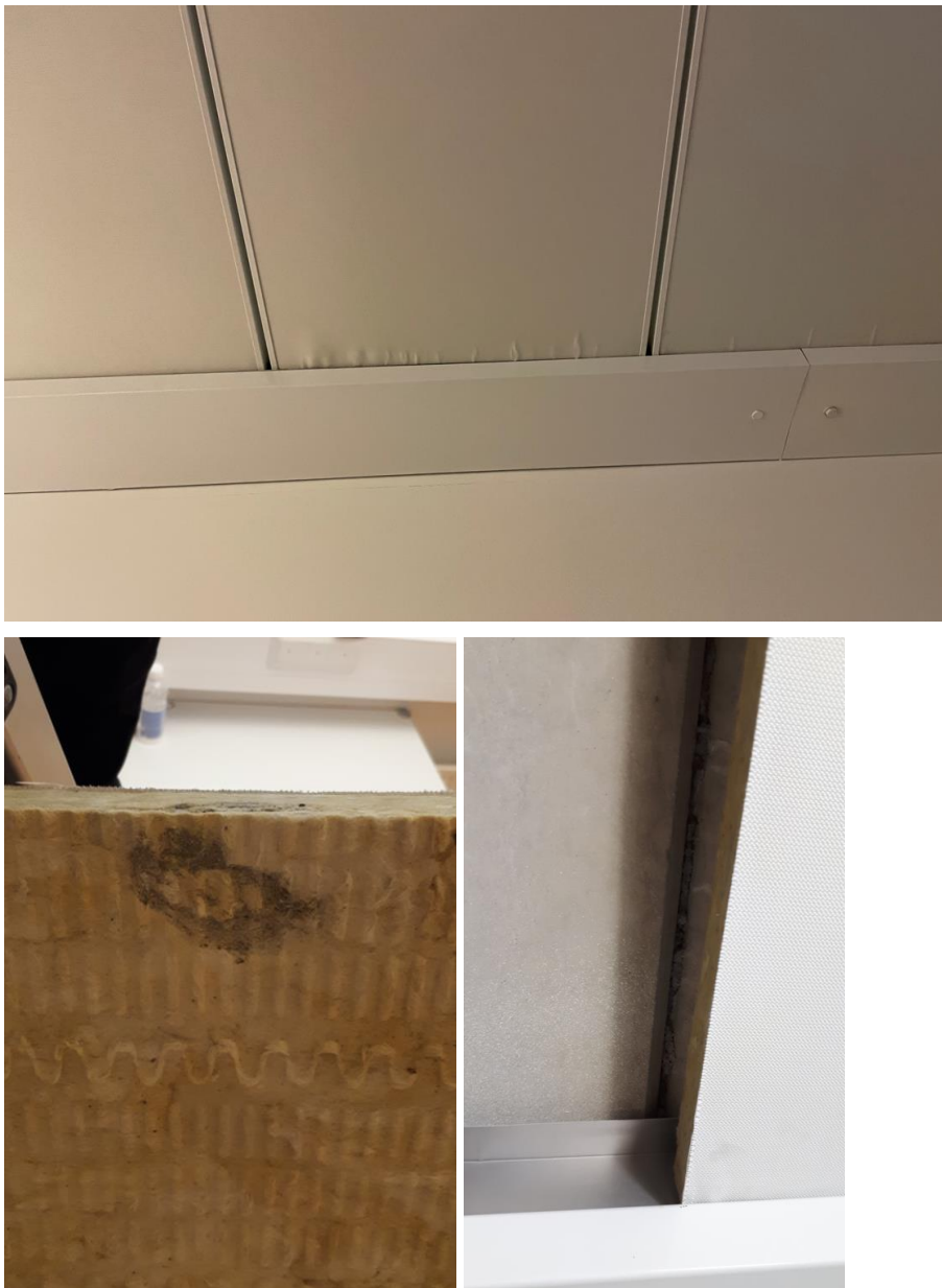
Kuva 11-12. Pienryhmätilassa 126 oli väliseinän viereisissä kahdessa akustolevyssä levyn alapinnassa kupruilua. Tilan yläpuolella on lepotila 224, joten ko. kohta on välipohja, eikä yläpuolisissa tiloissa ole märkätiloja. Akustolevy on vain muutaman sentin irti ontelolaatasta, eikä akustolevyn päällä ole putkia, joista kosteus voisi olla peräisin. Akustolevyn alapinnalla ei havaittu poikkeavaa mikrobikasvustoa (näyte 2). Levyn yläpinnalla havaittiin pienellä alueella tummumaa. Ontelolaatan alapinnalla tai johtokourussa ei havaittu kosteusjälkiä eikä kosteutta.
