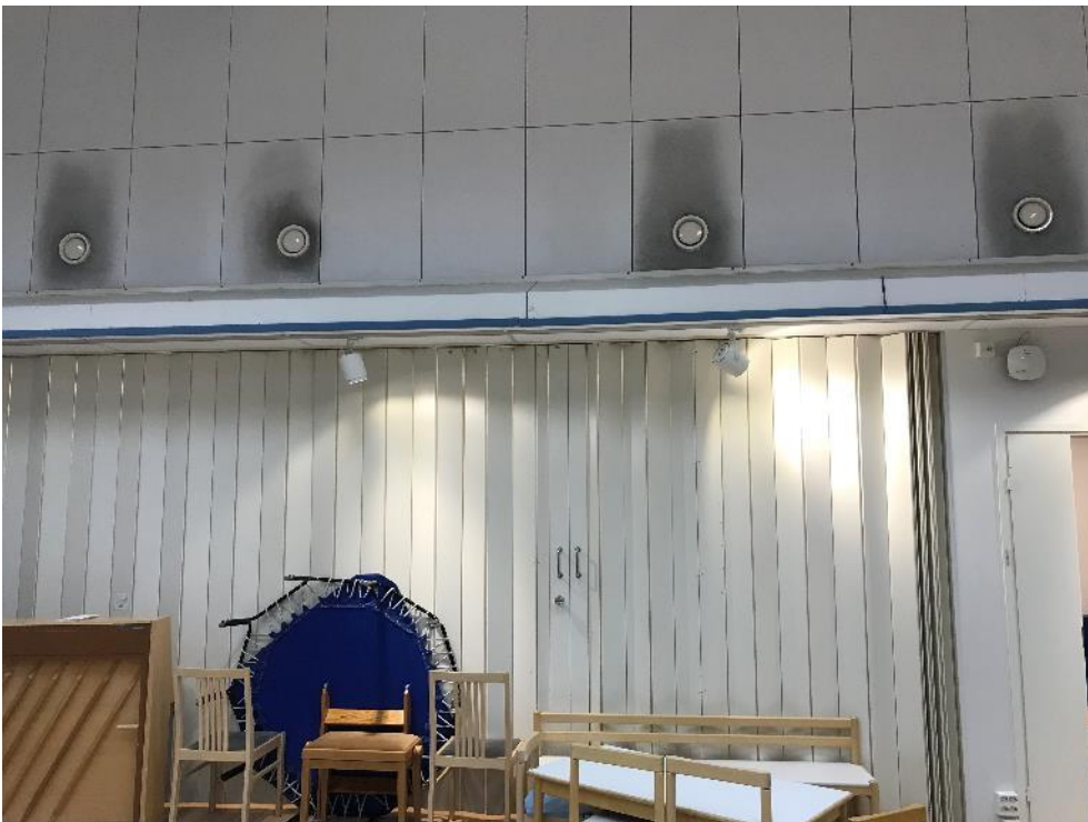
Kuva 5.4. Poistoilmaventtiileissä ja niiden ympärillä on likaa.
