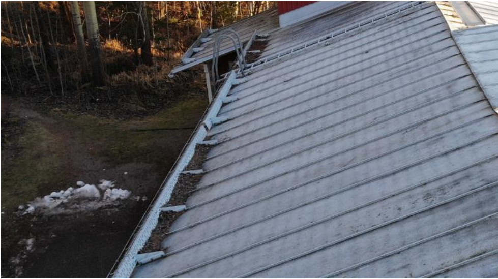
Kuva 4.2. Vesikatto on puhdistamatta.
