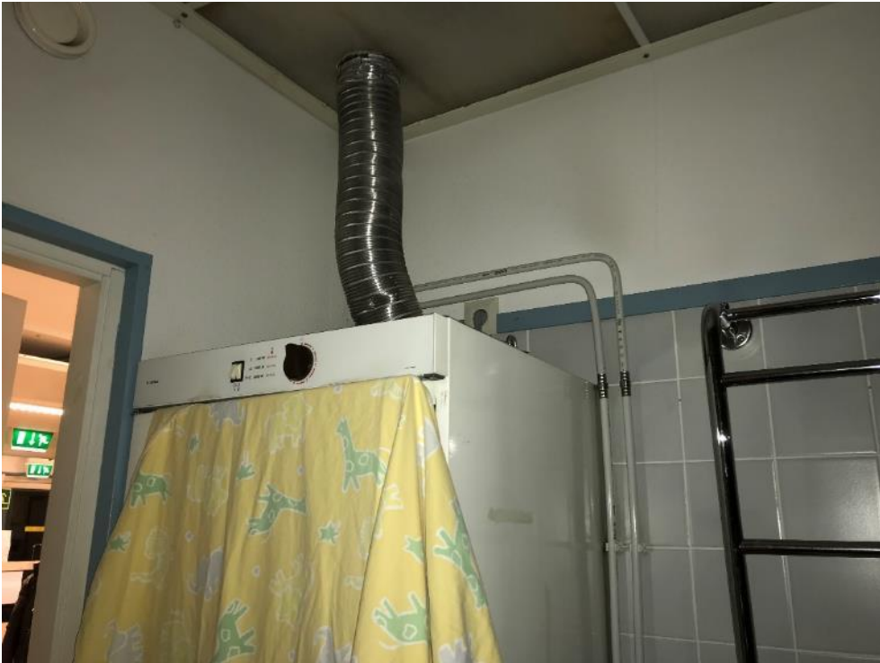
Kuva 5.3. Kuivauskaapin kytkennästä puuttuu ilmamäärän säätömahdollisuus.
