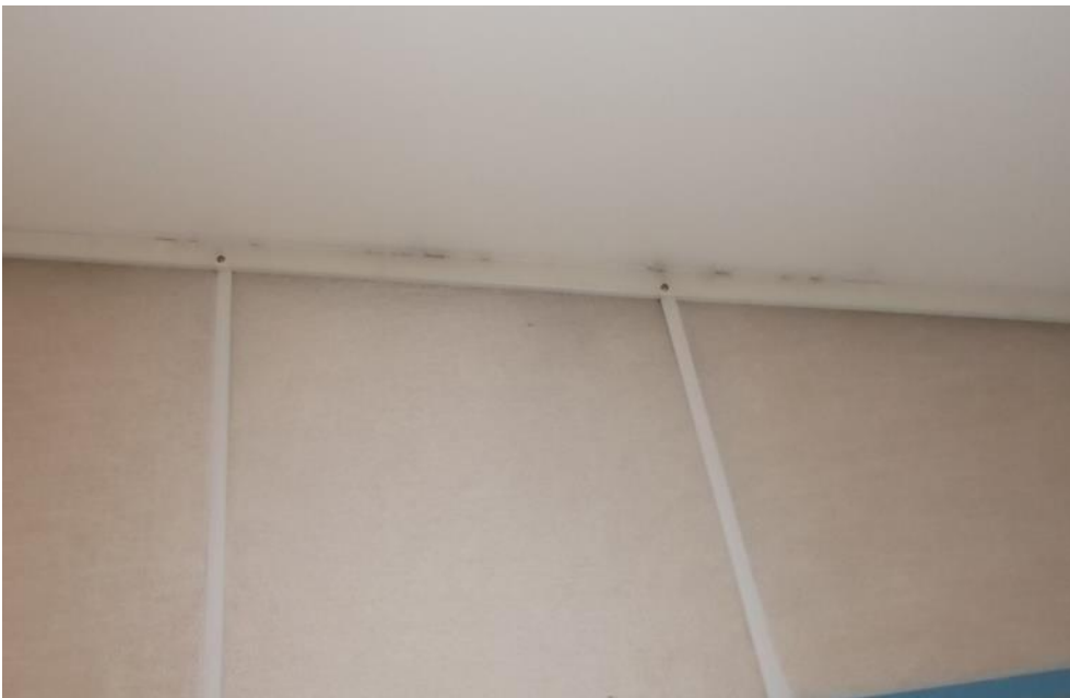
Kuva 4.3. Rakenneliittymästä on ilmavuotoa Leikkitilassa 138.
