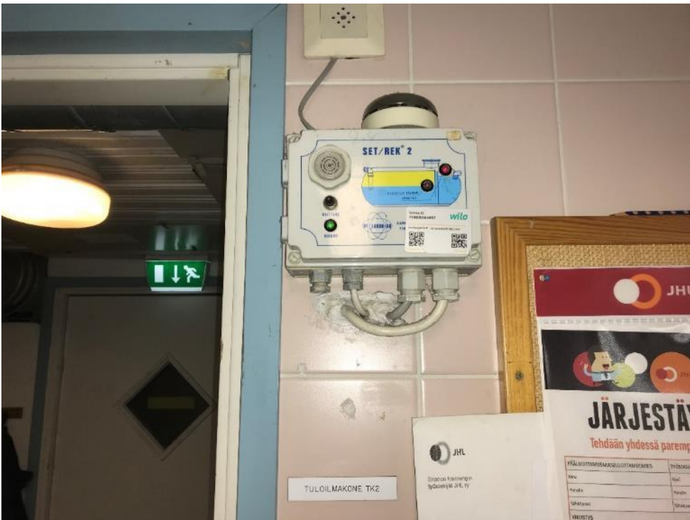
Kuva 5.6. Rasvanerotuskaivossa on padotushälytys päällä.
