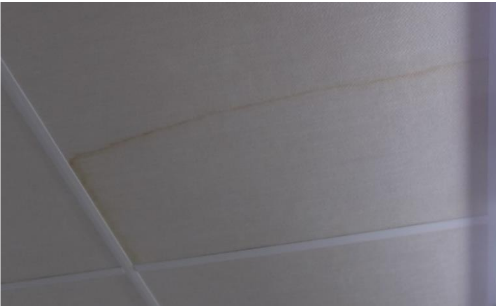
Kuva 4.5. Alakattolevyssä on vesivuotojälkiä Työtilassa 146.
