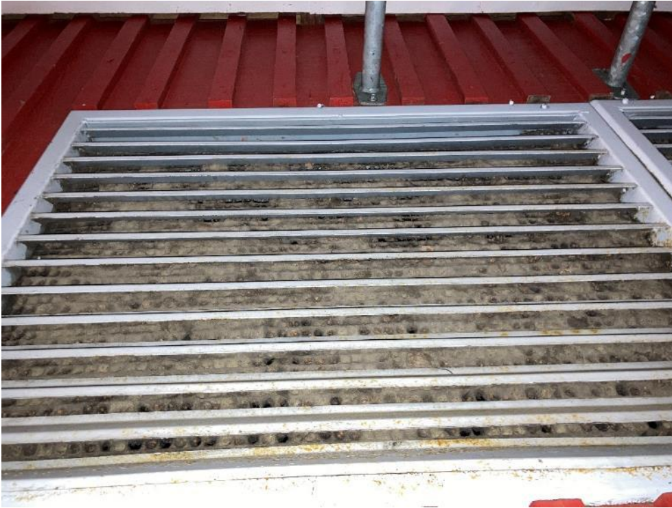
Kuva 5.1. Ilmanvaihtokoneen raitisilmasäleikkö on lähes tukossa.
