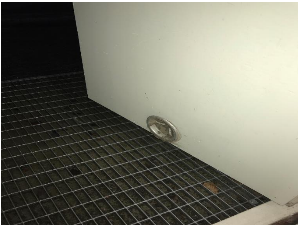
Kuva 5.2. Sähköpäähuoneen korvausilmaventtiili puuttuu.
