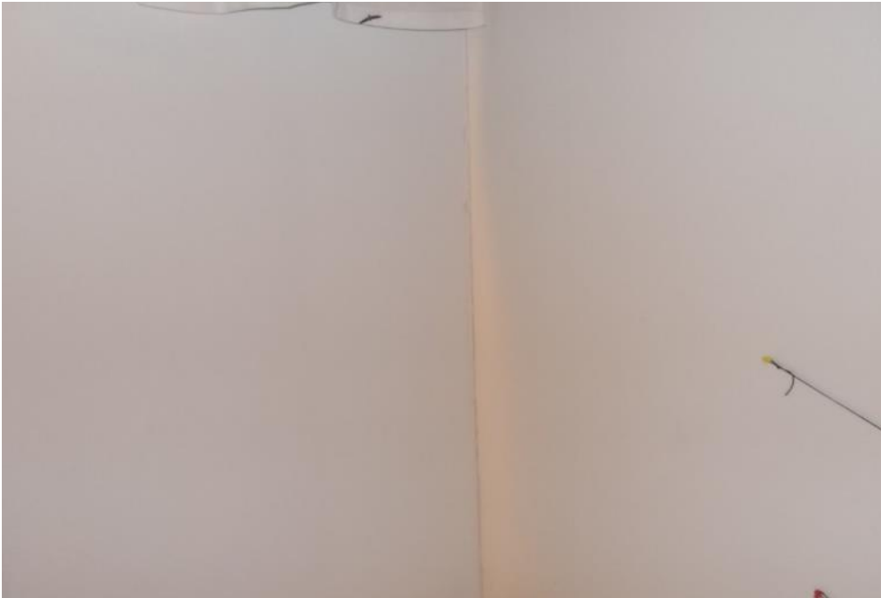
Kuva 4.6. Rakenneliittymä on auennut Lepohuoneessa 154.
