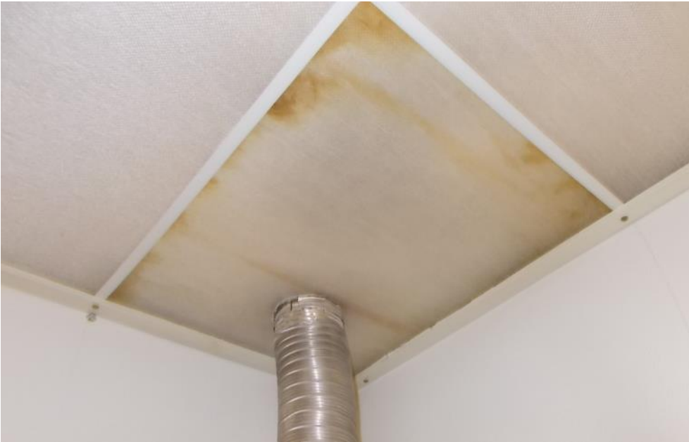
Kuva 4.4. Alakattolevyssä on vesivuotojälkiä Työtilassa 146.
