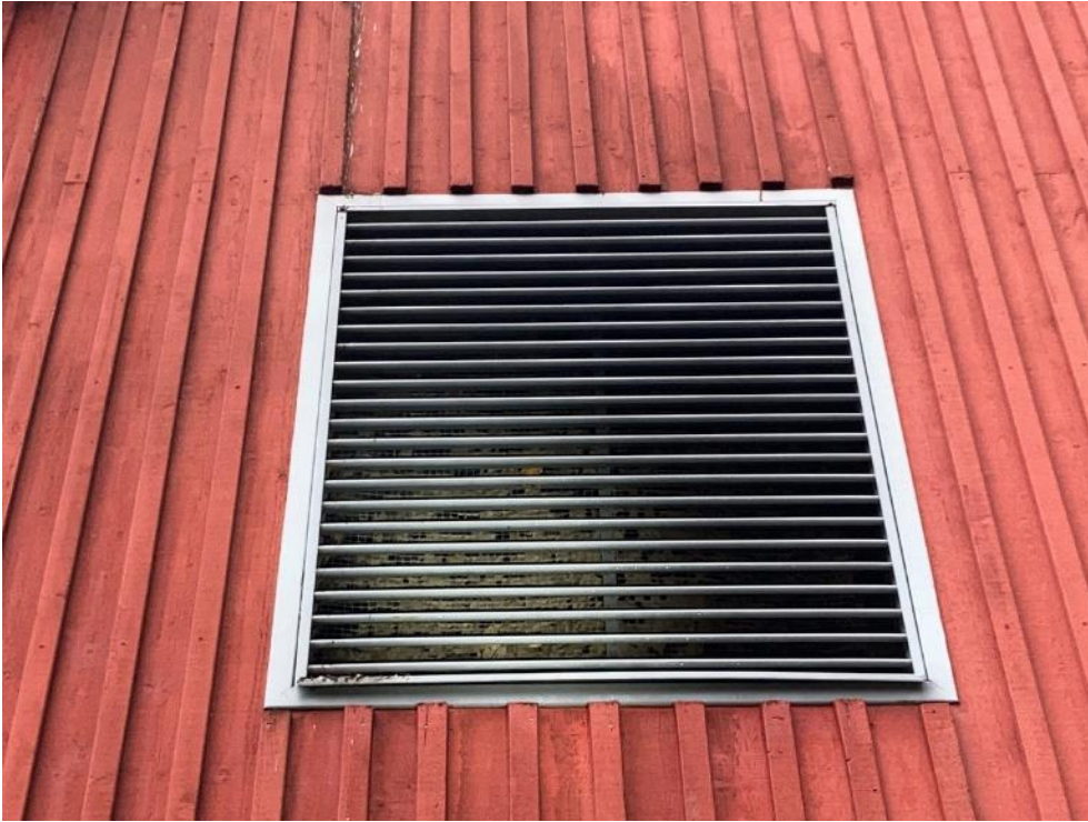
Kuva 5.1. Raitisilmasäleikössä on lehtiä.
