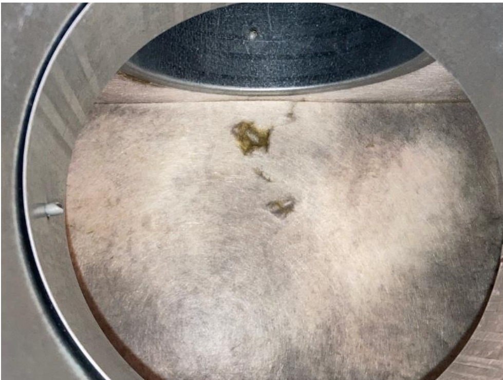
Kuva 5.4. Tuloilman paineentasauslaatikossa on pinnoitettua villaa.
