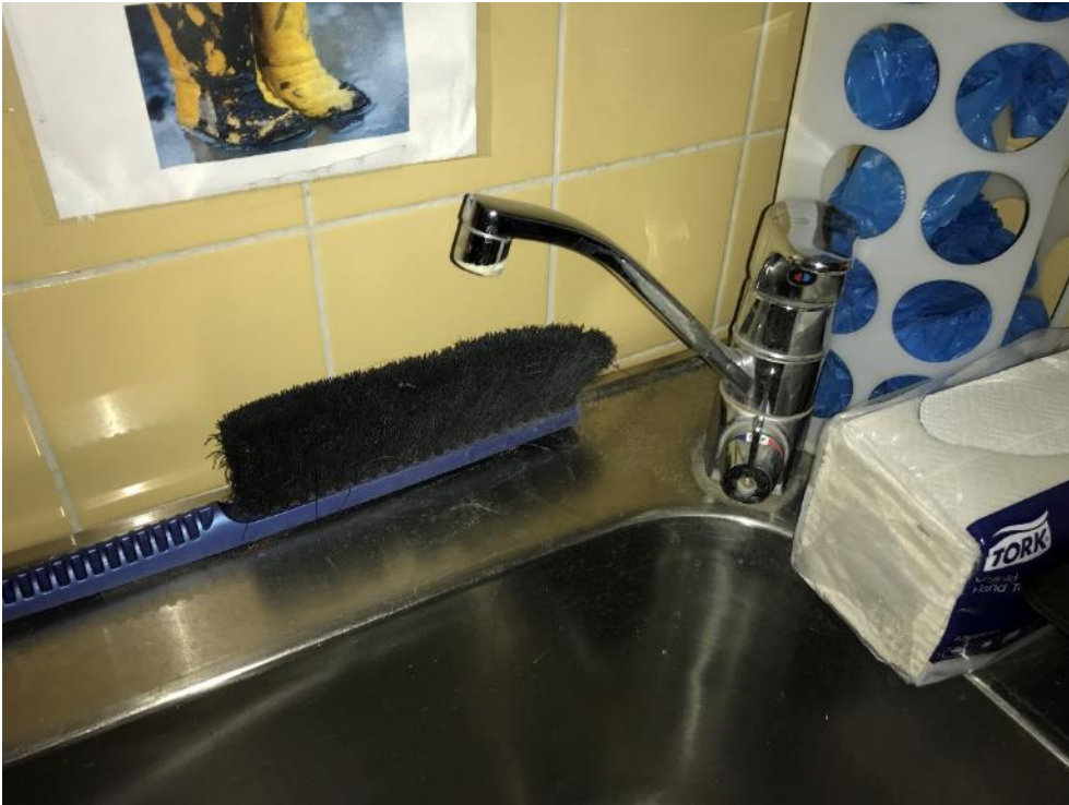
Kuva 5.5. Useiden allashanojen sivuliikerajoittimet puuttuvat ja vesi pääsee pöydille.
