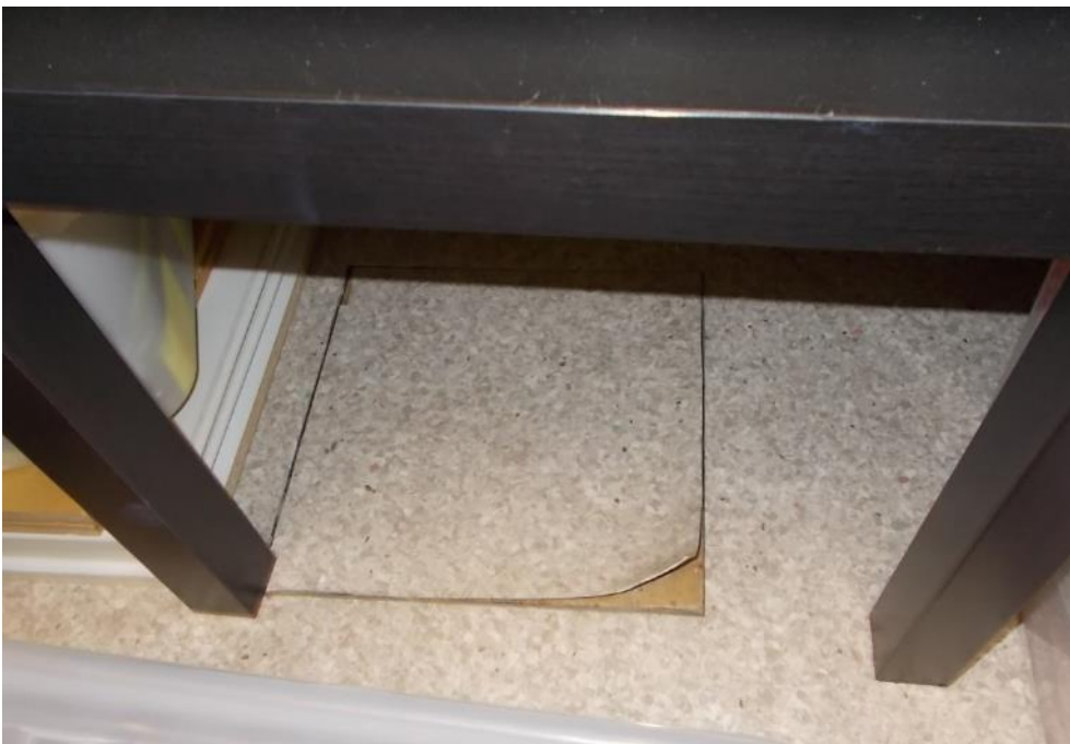
Kuva 4.3. Lattialuukun matto on irti Varastossa 123.
