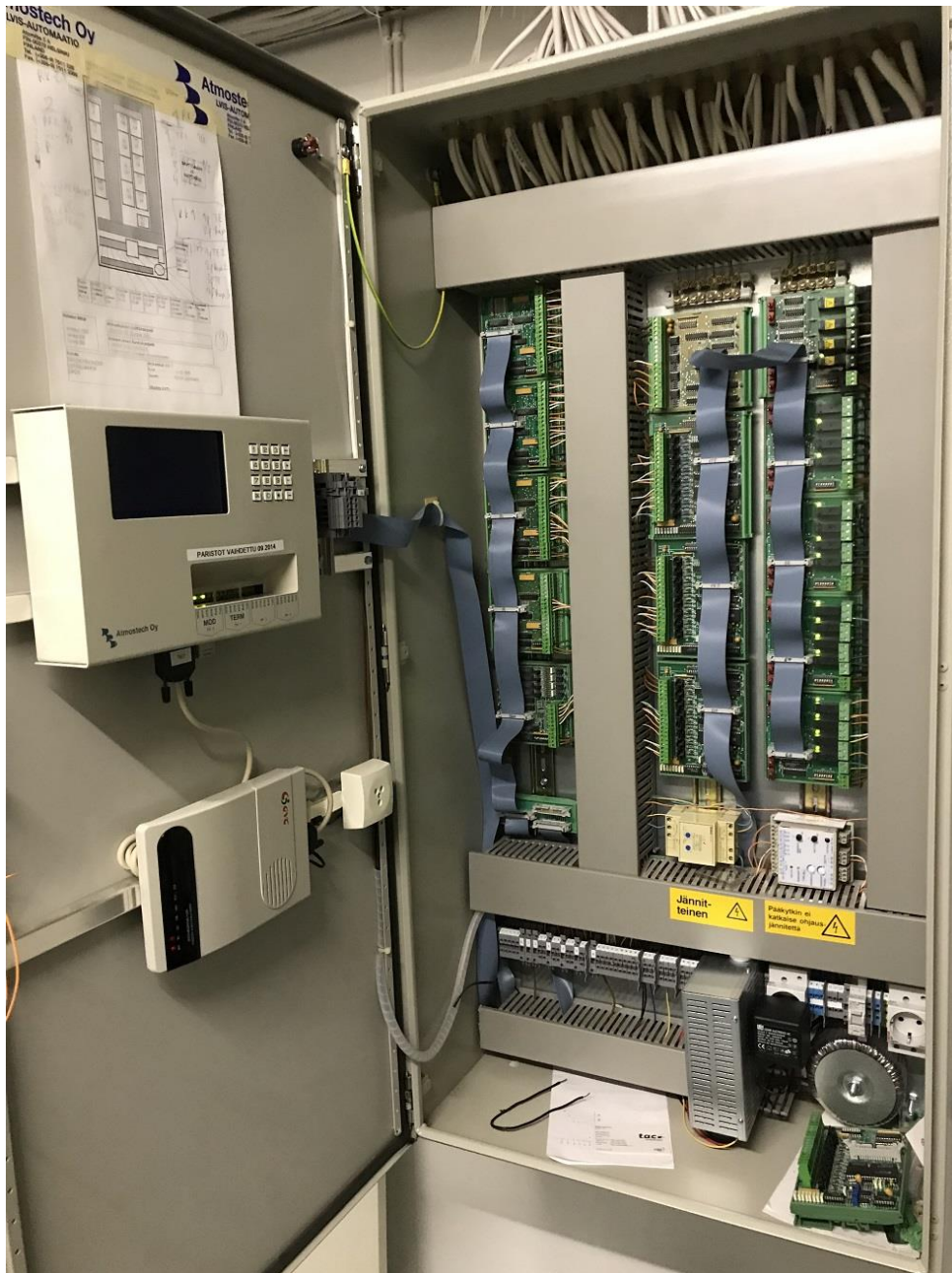
Kuva 6.1. Atmostech-rakennusautomaatiojärjestelmän valmistus ja valmistajan tuki lopetettu, varaosien saanti heikkoa.
