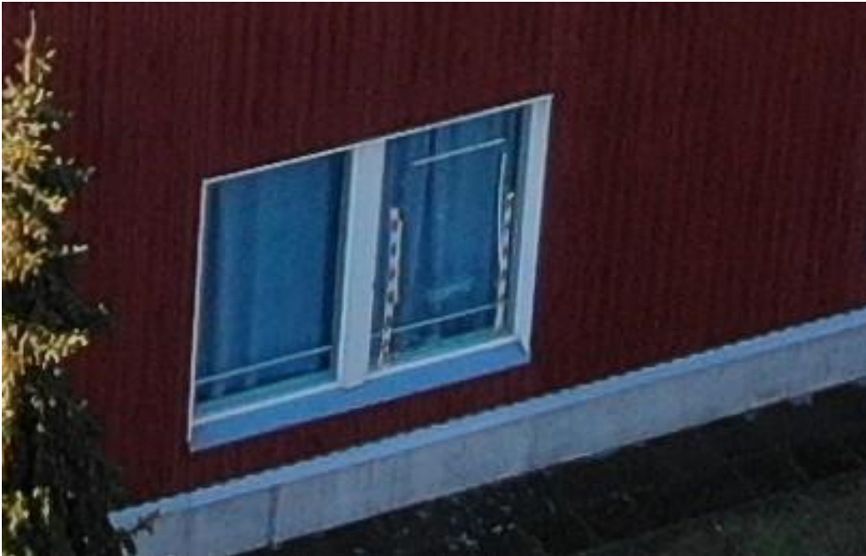
Kuva 4.6. Ikkunan lasi on rikki Lepohuoneessa 128.
