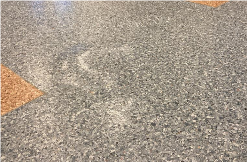
Kuva 4.2. Lattiamatto on irti alustastaan Lepohuoneessa 105.
