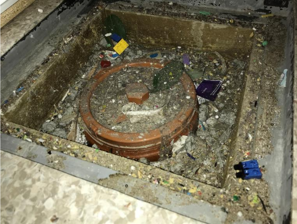
Kuva 4.4. Lattialuukku ei ole tiivis Varastossa 123.
