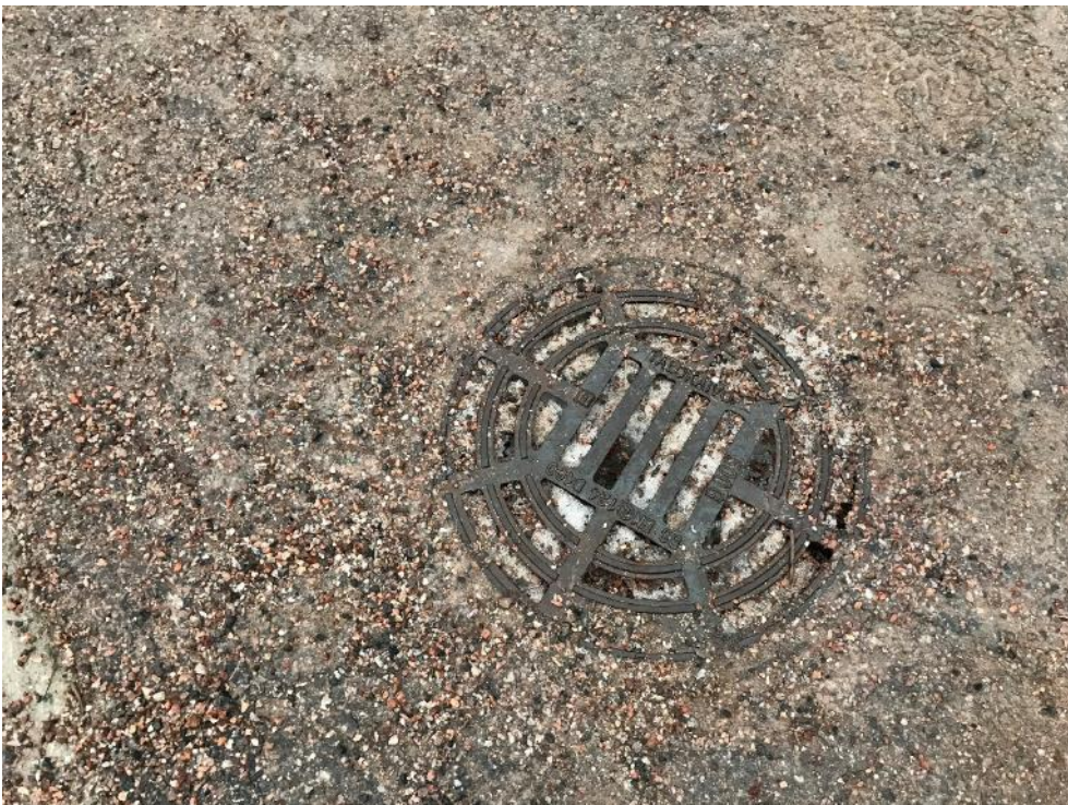
Kuva 5.6. Sadevesikaivossa on hiekkaa.
