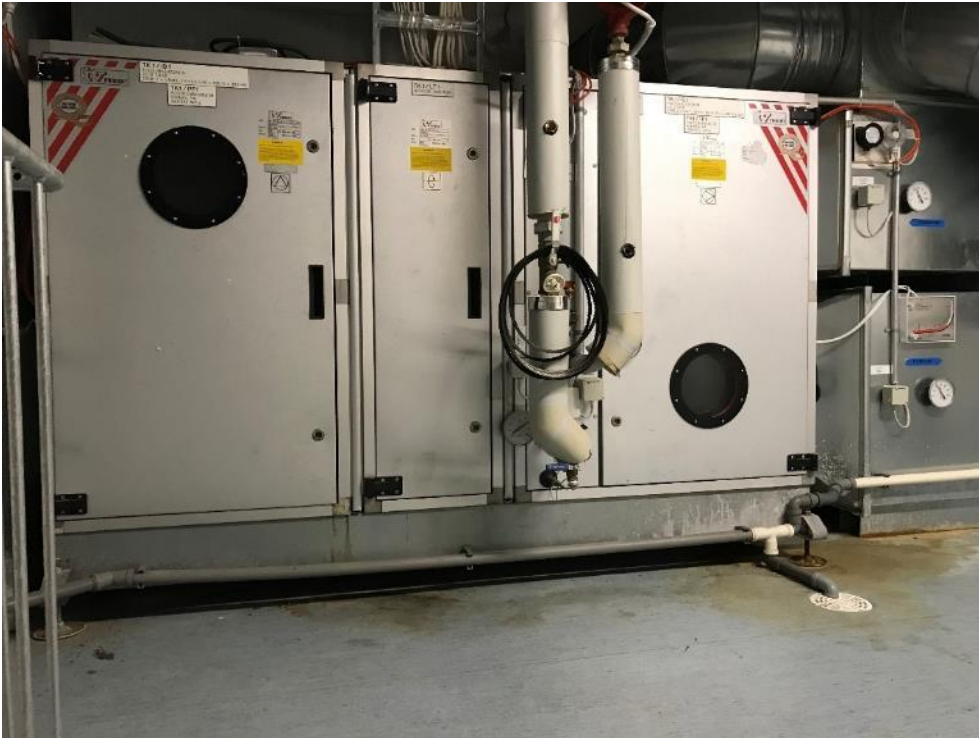
Kuva 5.3. Ilmanvaihtokoneen viemäröinnin takaimusuoja puuttuu.
