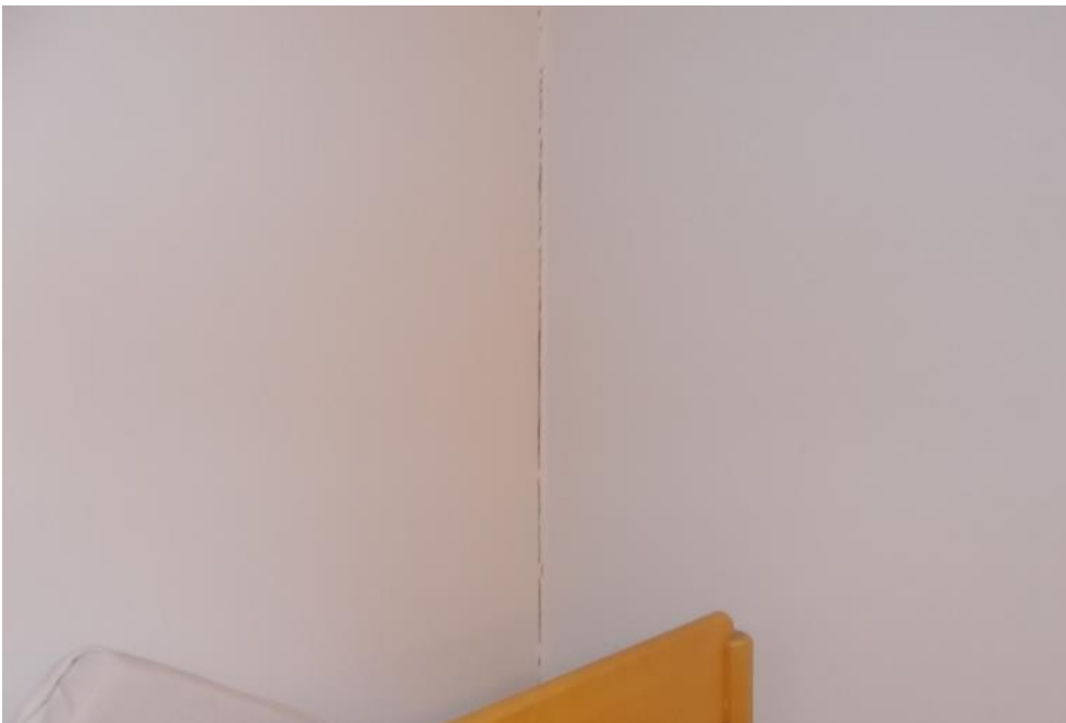
Kuva 4.1. Rakenneliittymä on auki Lepohuoneessa 105.
