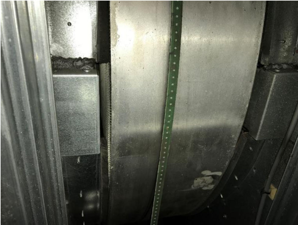
Kuva 5.2. Ilmanvaihtokoneen TK1 lämmöntalteenoton tiivisteharjaksista puuttuu osat.
