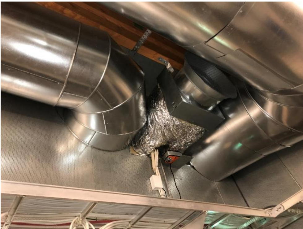
Kuva 5.3. Ilmanvaihtokonehuoneessa on pellittämättömiä mineraalivillaeristeitä.
