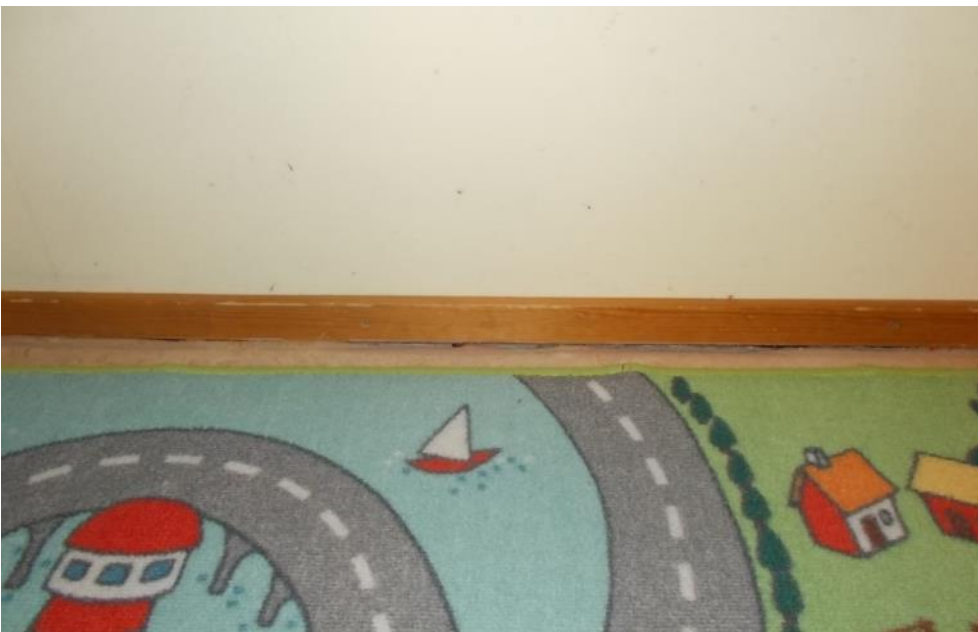
Kuva 4.11. Lattia on vajonnut Leikkihuoneessa 025.
