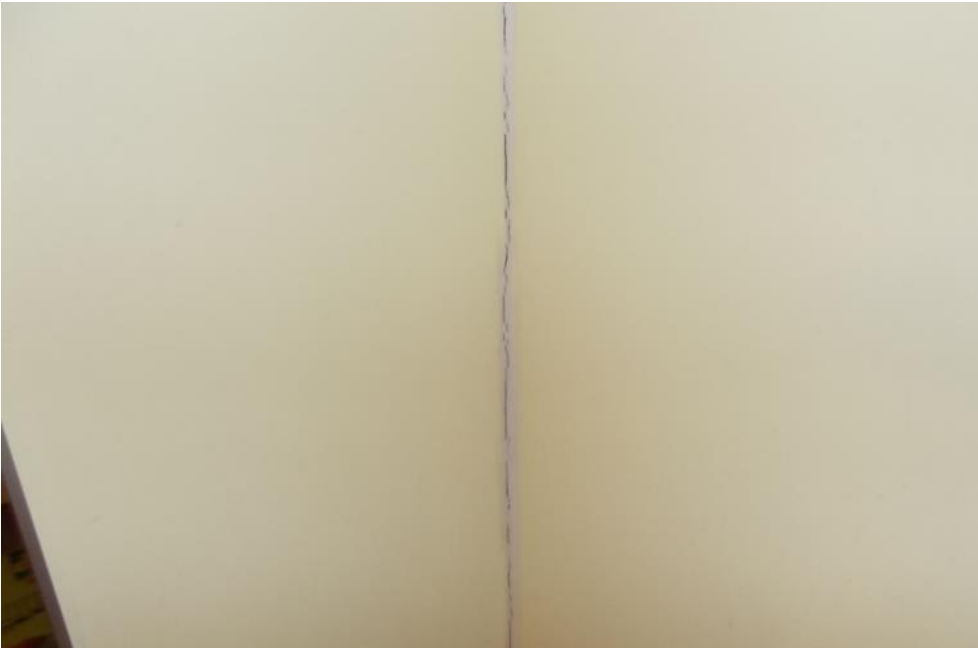
Kuva 4.10. Rakenneliittymä on auennut Lepohuoneessa 025.
