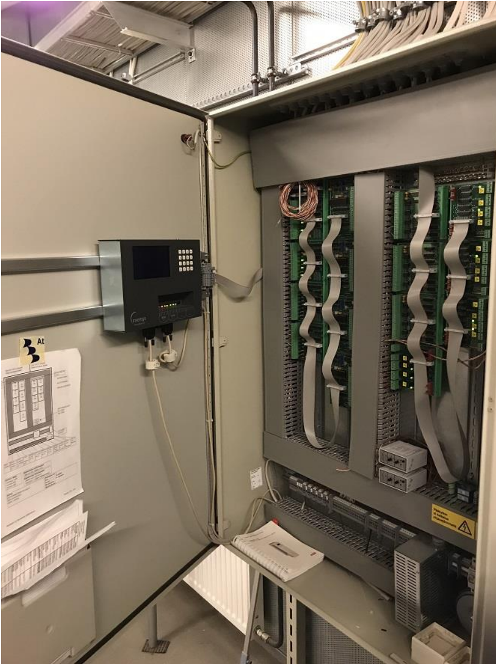
Kuva 6.3. Rakennusautomaatio, jonka valmistus ja tuki on lopetettu.
