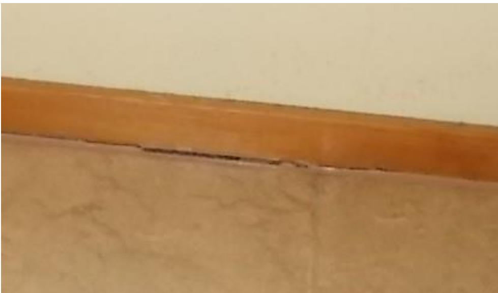
Kuva 4.9. Lattia on vajonnut Leikkitilassa 011.
