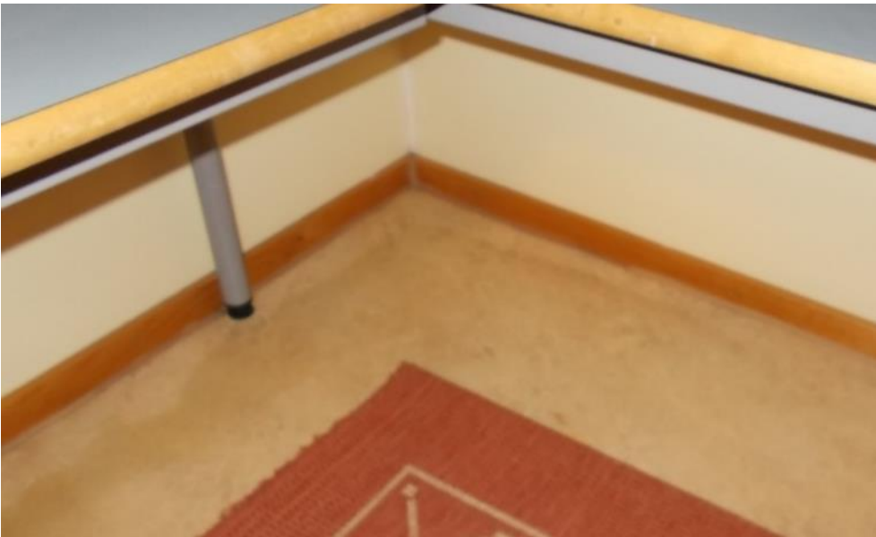
Kuva 4.7. Lattiamatto on irti alustastaan Lepohuoneessa 003.
