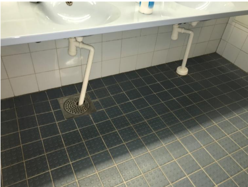
Kuva 5.5. Pesualtaiden viemäroinneistä puuttuu kannakointi.
