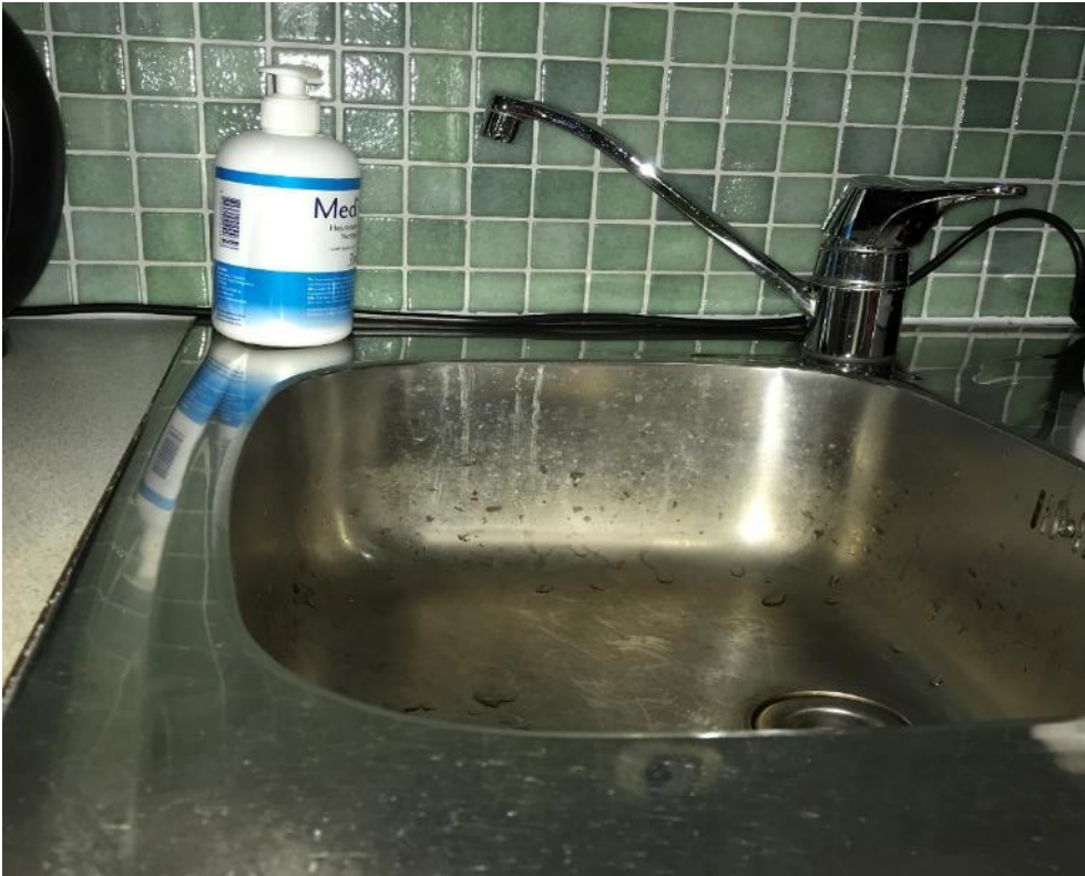
Kuva 5.4. Pesualtaiden hanoista puuttuu sivuliikerojoitin.
