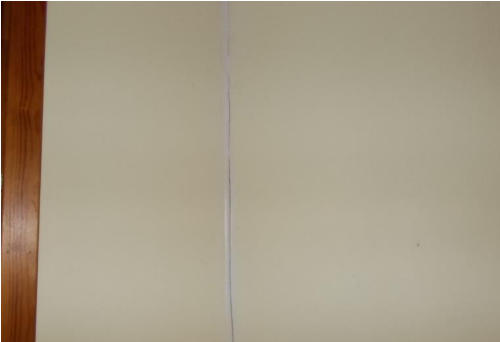
Kuva 4.8. Rakenneliittymä on auennut Leikkitilassa 011.
