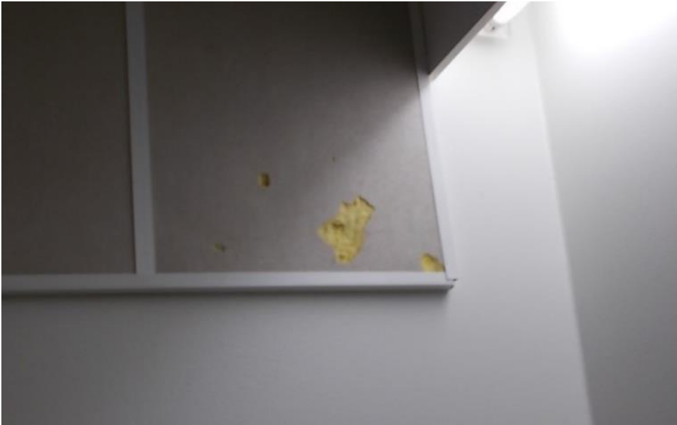
Kuva 4.6. Rikkinäisiä akustolevyjä on Lepotilassa 212.
