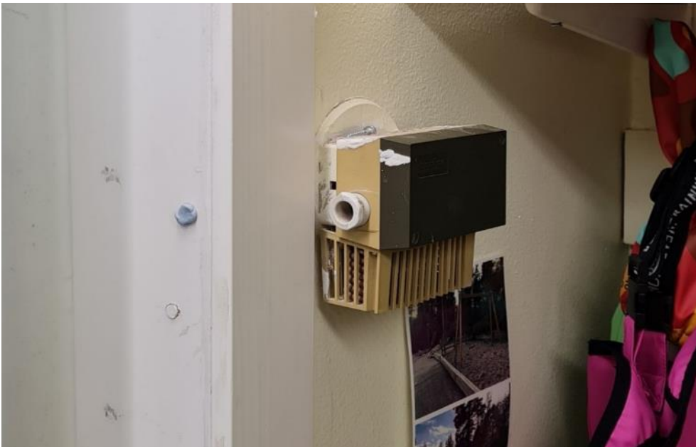
Kuva 6.1. KSK-Puhaltimen Termostaattiyksikkö. Rele napsahtaa, mutta puhallin ei käynnistynyt.
