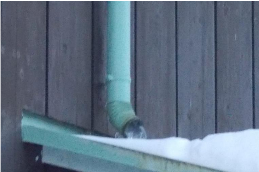
Kuva 4.1. Sadevesisyöksy on jäässä.
