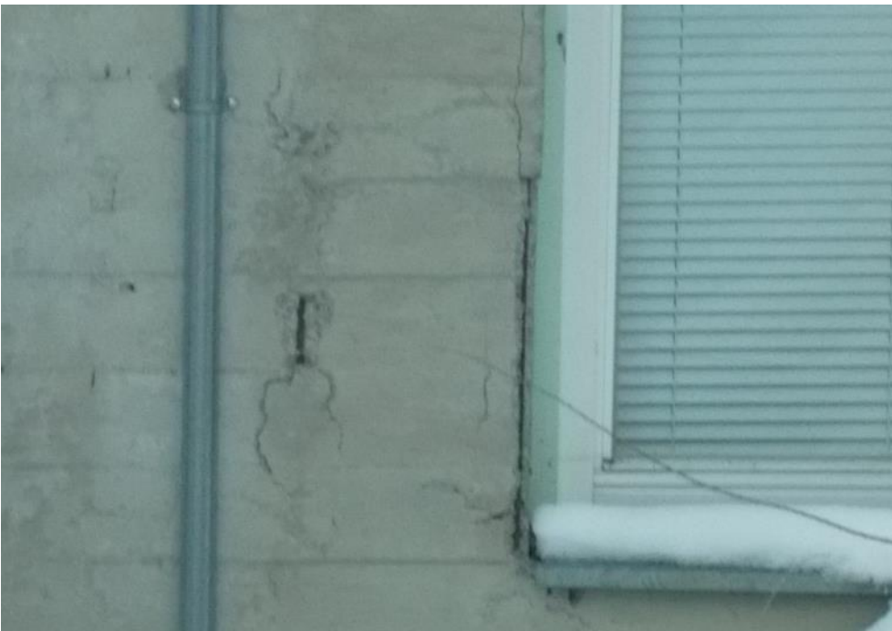
Kuva 4.3. Sokkelissa on raudoitusta esillä.
