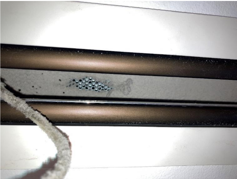
Kuva 5.3. Poistoilmapäätelaitteissa olevat reikäpellit ovat tukossa.
