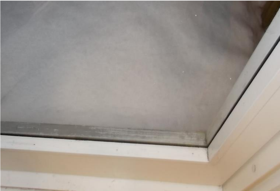
Kuva 4.2. Hätäpoistumistien edestä lumet ovat poistamatta.
