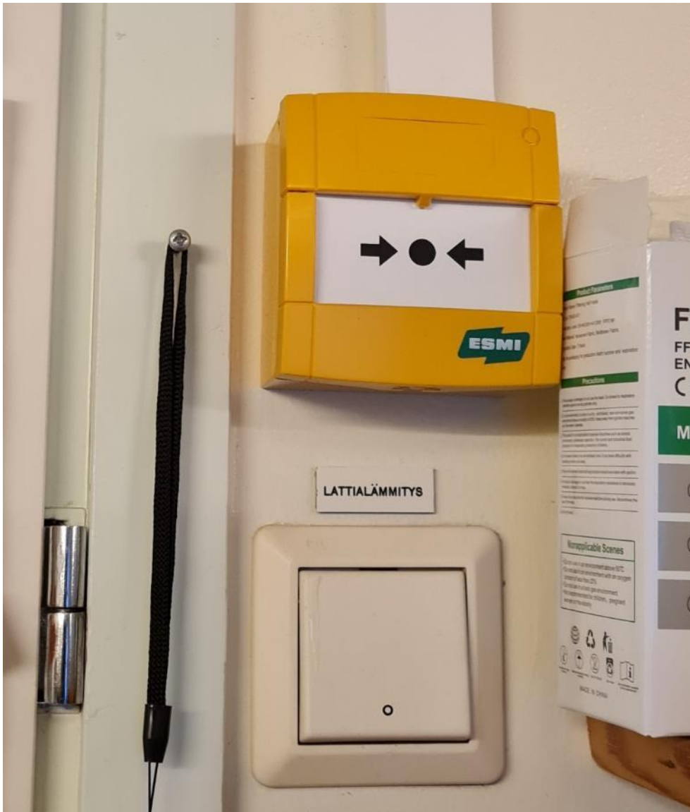
Kuva 6.2. IV-Hätäseis-kytkimestä puuttuu tunnistekyltti.
