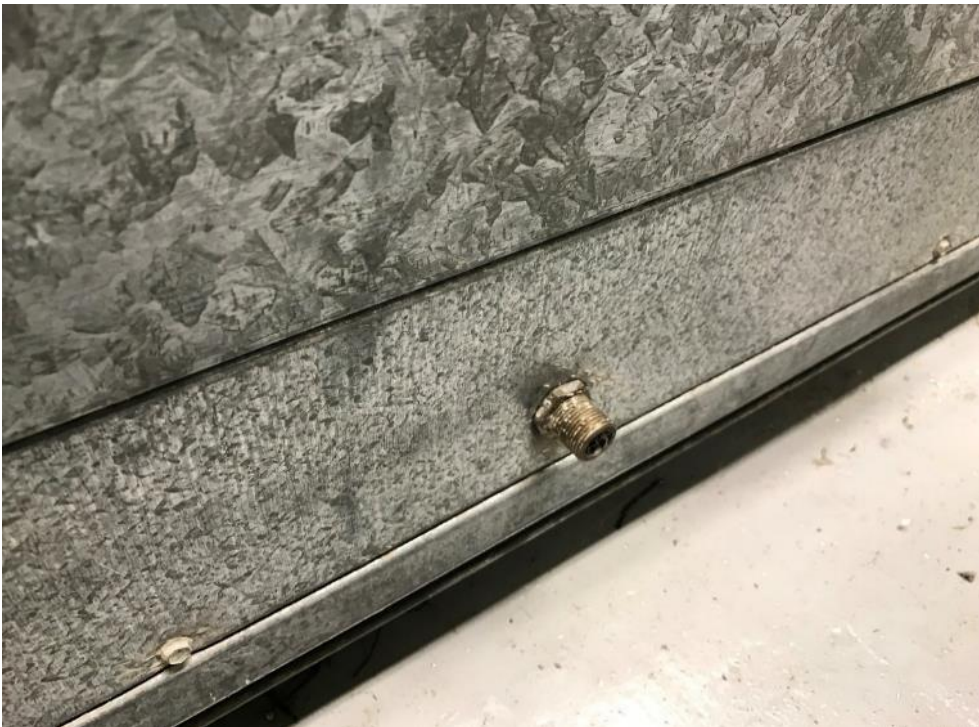
Kuva 5.1. Ilmanvaihtokoneiden viemärointi on jäänyt tekemättä.
