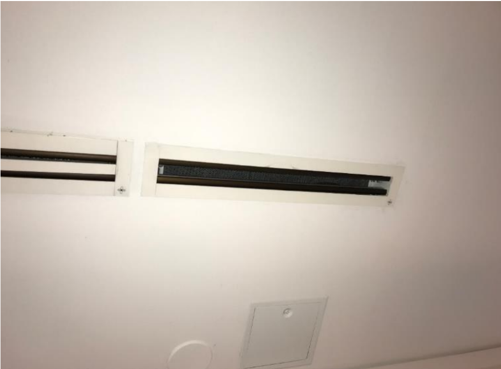
Kuva 5.2. Huoneen 104 tuloilmaelimestä puuttuu säätöosa.
