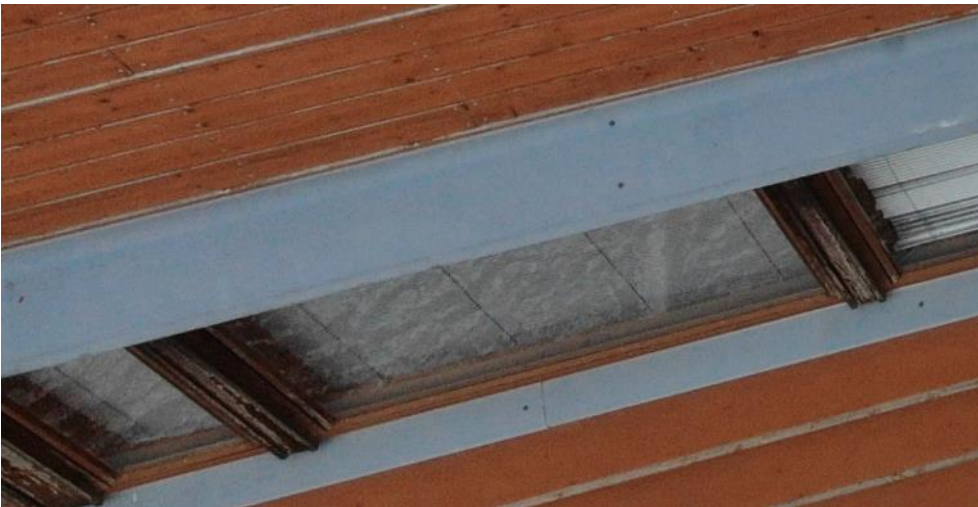
Kuva 4.3. Ikkunoissa huollon tarpeita.
