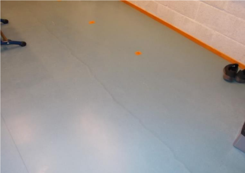
Kuva 4.8. Halkeama lattiassa Luokassa C 211.
