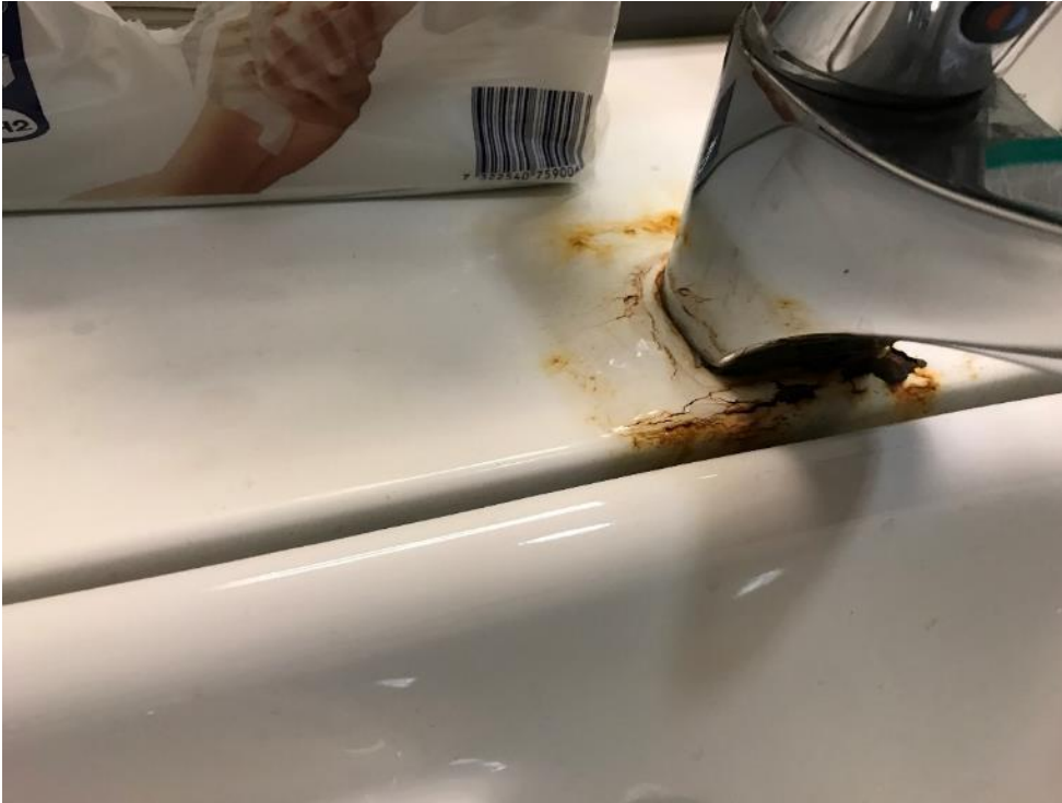
Kuva 5.11. Pesuallas on ruostunut.
