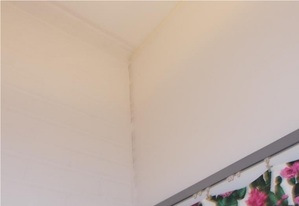
Kuva 4.12. Ilmavuotoa Kuraattori D 239.
