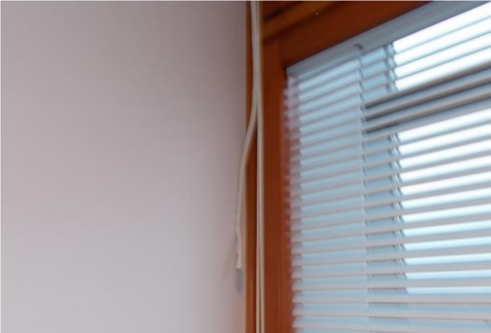
Kuva 4.16. Ikkunan tiiviste Musiikkiluokassa D 334.
