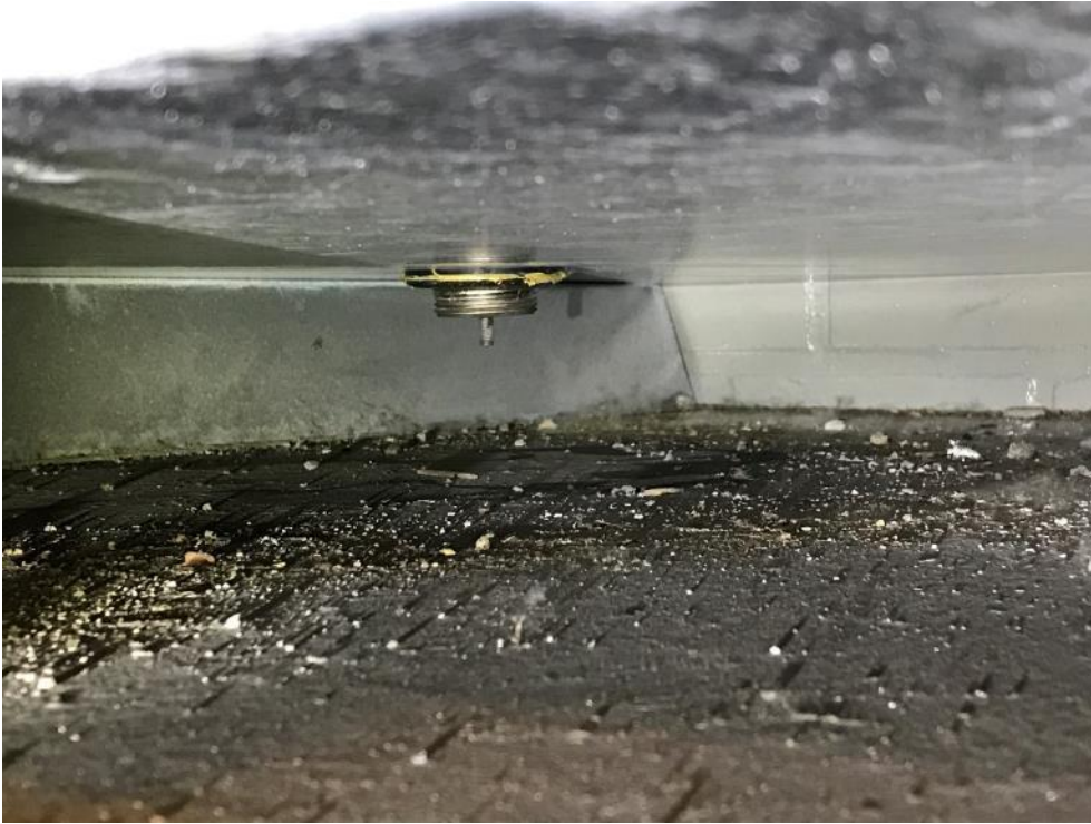
Kuva 5.1. Raitisilmakammion viemäröinti puuttuu. Kammioon pääsevä vesi valuu lattialle.
