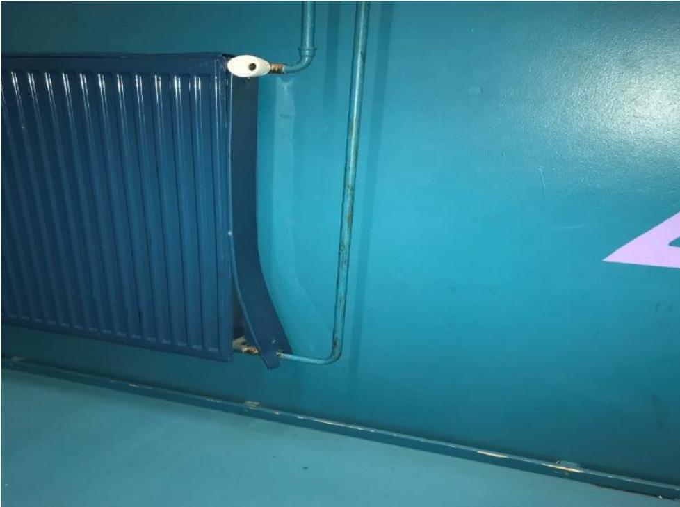
Kuva 5.9. Liikuntasalin patteritermostaattiosa on rikki ja suojapelti vääntynyt.
