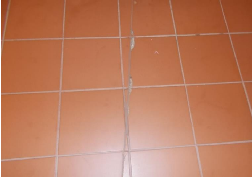
Kuva 4.4. Haljenneita lattialaattoja Ruokailutila D 113.1.
