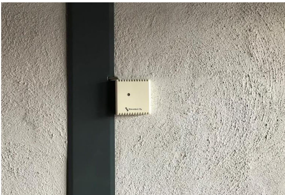
Kuva 6.2. Tuulikaapin lämpötila-anturi on kylmässä betoniseinässä.
