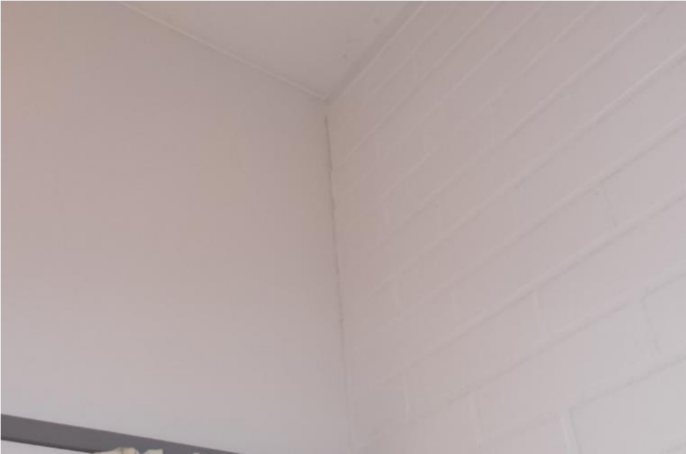
Kuva 4.10. Auennut rakenneliittymä Lepohuone D 237.
