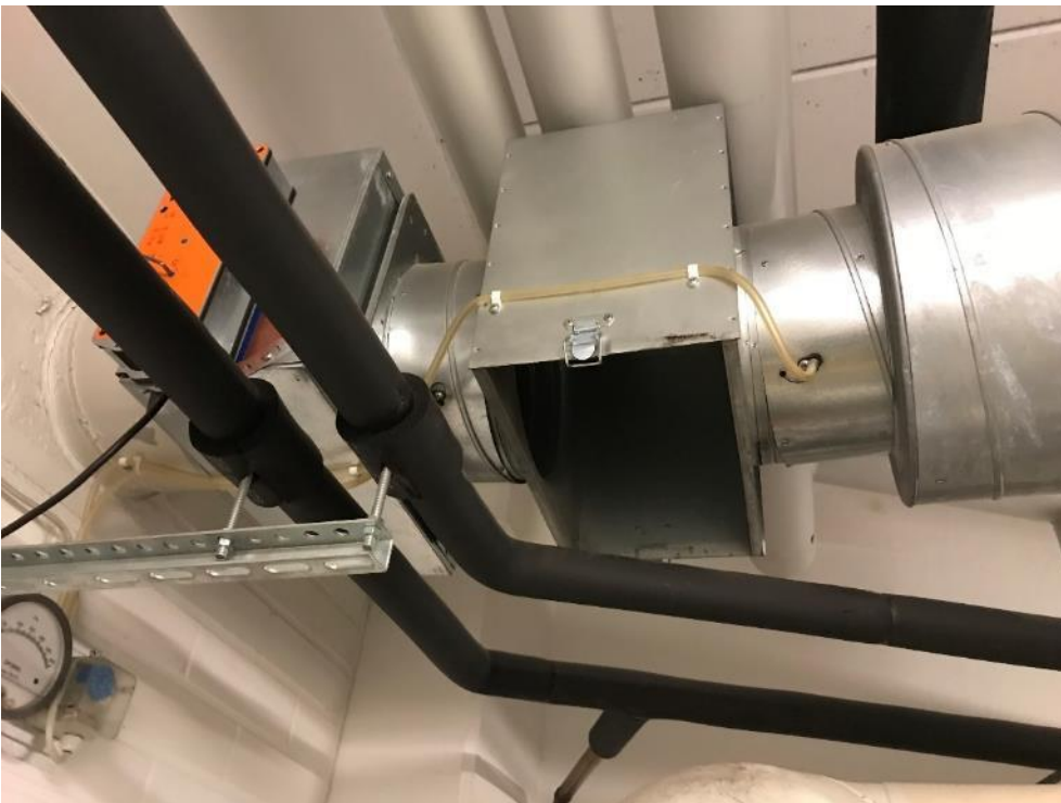
Kuva 5.6. Lämmönjakohuoneen tuloilmakoneen suodatin puuttuu.
