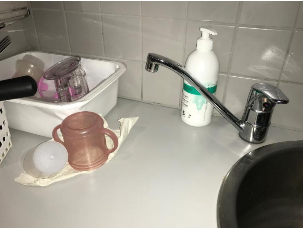
Kuva 5.10. Laskuhanan sivuttaisliikerajoitin puuttuu.
