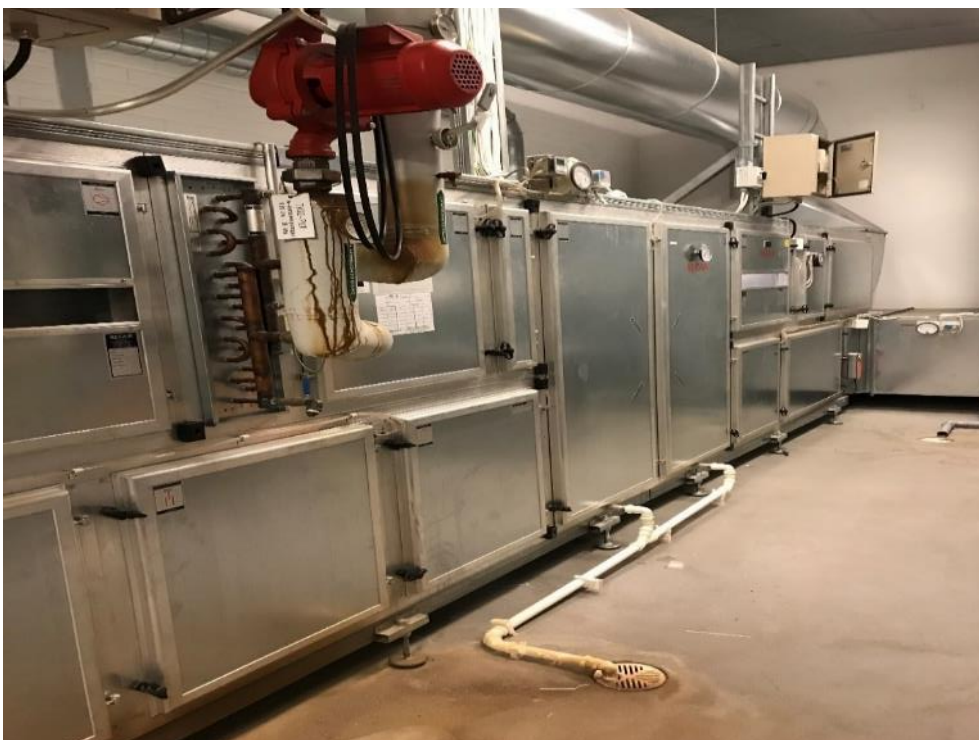
Kuva 5.2. Ilmastointikoneiden vedenpoistojen takaimusuojat puuttuvat.
