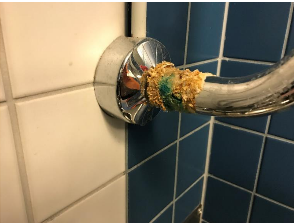
Kuva 5.8. Siivouskomeron D209 räätipatteri syöpynyt puhki.
