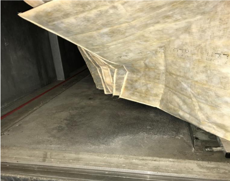
Kuva 5.3. Lumi sulaa ilmastointikoneen suodatinkammioon.
