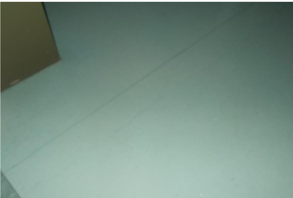
Kuva 4.9. Halkeama lattiassa Luokassa C 212.
