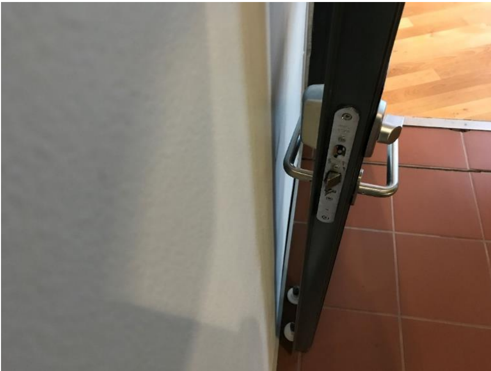
Kuva 5.12. Ovi ottaa kiinni lattianrajassa oleviin lämpöputkiin käytävällä D214.
