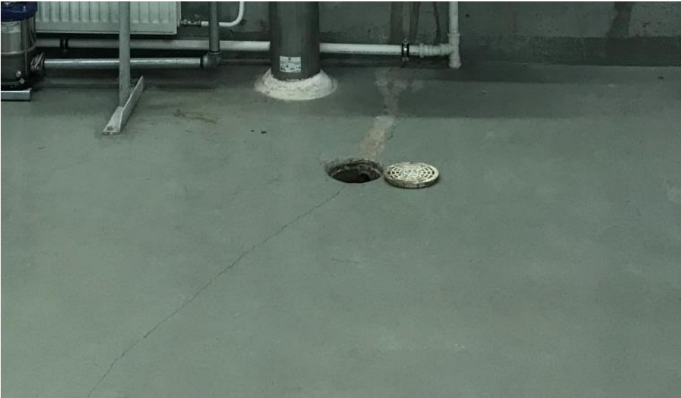
Kuva 4.8. Lattiassa on halkeama Teknisessä tilassa 0019.
