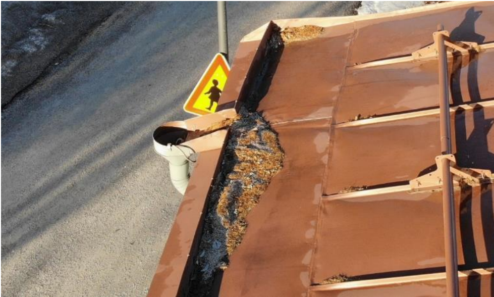
Kuva 4.2. Vesikatto on puhdistamatta.
