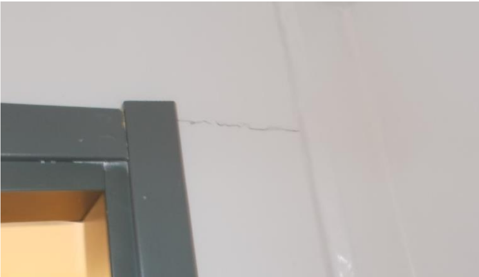
Kuva 4.5. Seinässä on halkeama Luokassa 1001.
