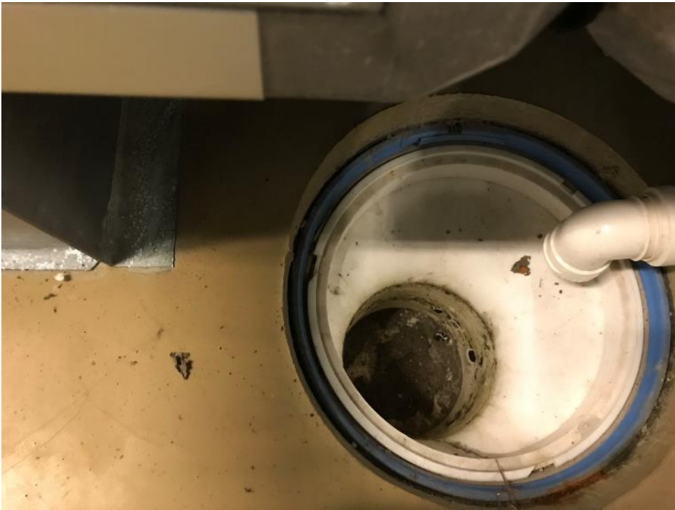
Kuva 5.1. Ilmanvaihtokonehuoneen lattiakaivo on ilman vettä.
