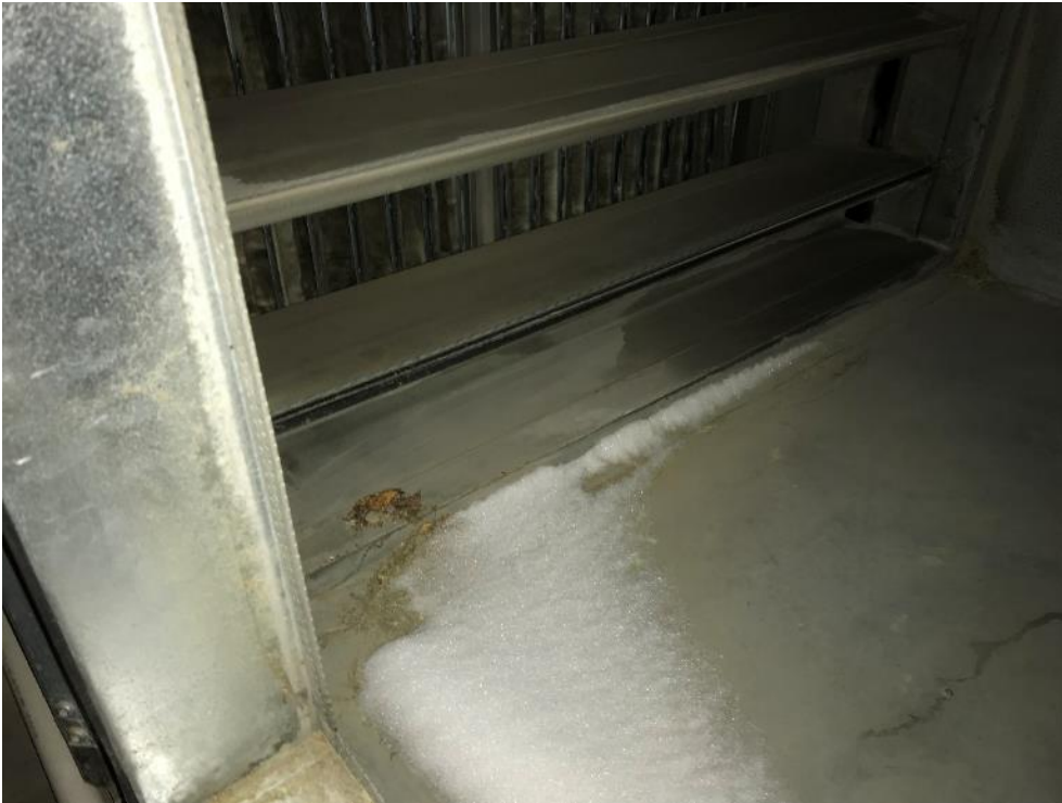
Kuva 5.2. Ilmanvaihtokoneen sisälle pääsee lunta.
