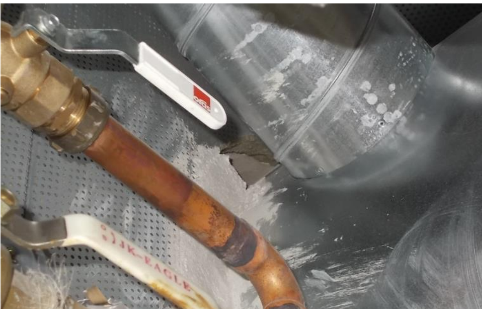
Kuva 4.9. Lämpöviennestä puuttuu palokatkot IV-konehuoneessa 0009.
