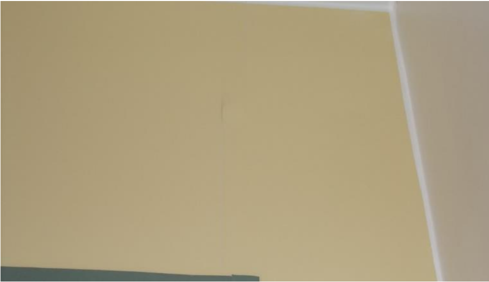
Kuva 4.6. Kipsilevyjen saumanauha on osin irti Luokassa 1001.
