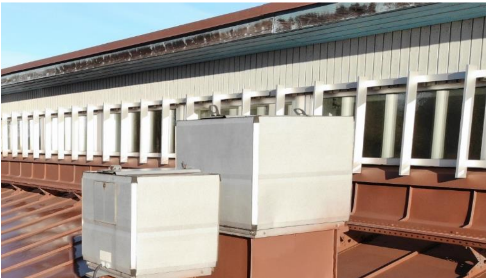
Kuva 4.3. Vesikaton otsalaudoista maali on lähtenyt pois.
