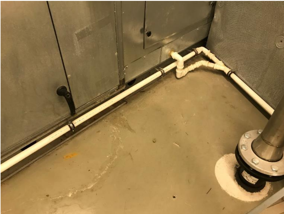
Kuva 5.3. Ilmanvaihtokoneen TK42.1 viemäröinnistä puuttuu takaimusuoja.
