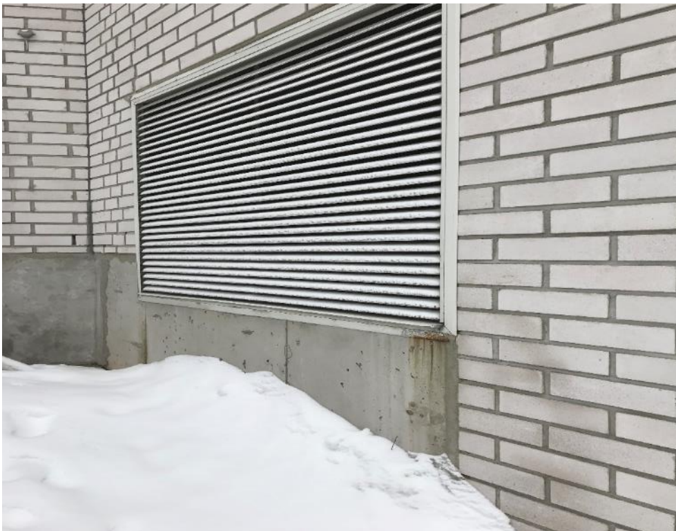
Kuva 5.5. Ilmanvaihtokoneen raitisilmasäleikkö on liian alhaalla ja se kerää lunta.
