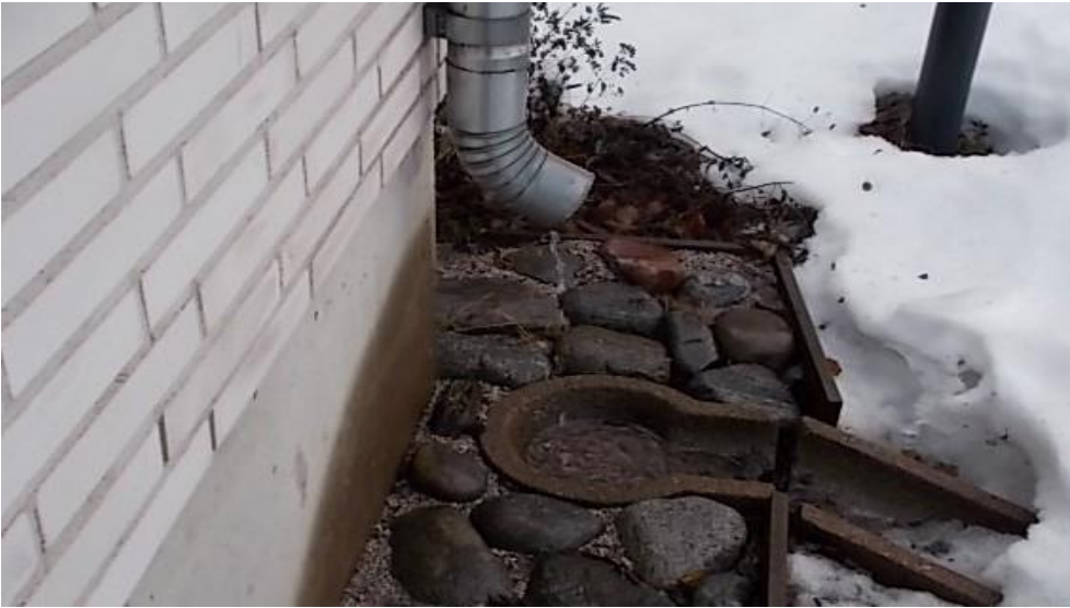
Kuva 4.4. Sadevesisyöksy on liian lyhyt.
