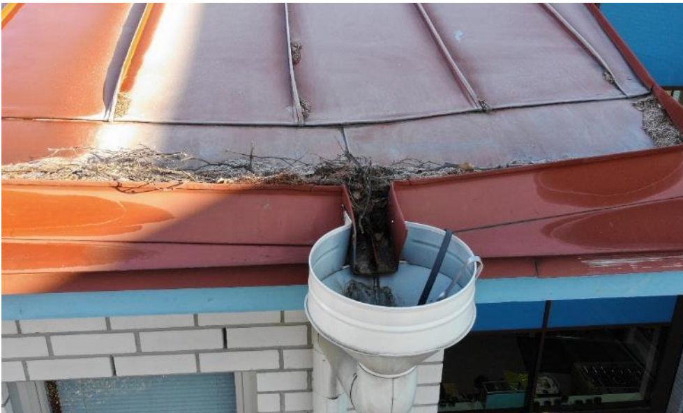
Kuva 4.1. Vesikatto on puhdistamatta.
