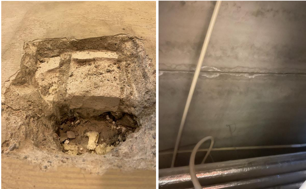
Kuva 1. Välipohjarakenteessa VP4 rakenne poikkesi paikallisesti tilassa 212 kosteusmittapisteen K1 kohdalla (vas).
