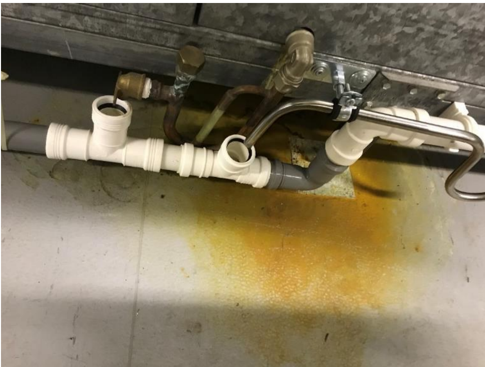
Kuva 5.1 Ilmanvaihtokoneen viemäröinneistä puuttuu takaimusuojat.
