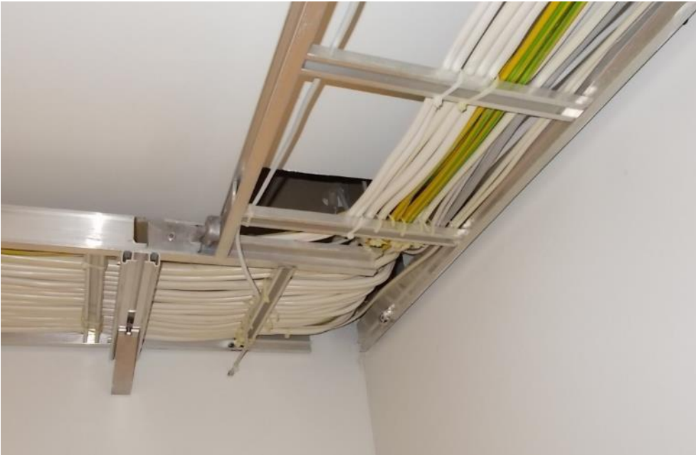
Kuva 4.9. Läpivienti teknisessä tilassa.
