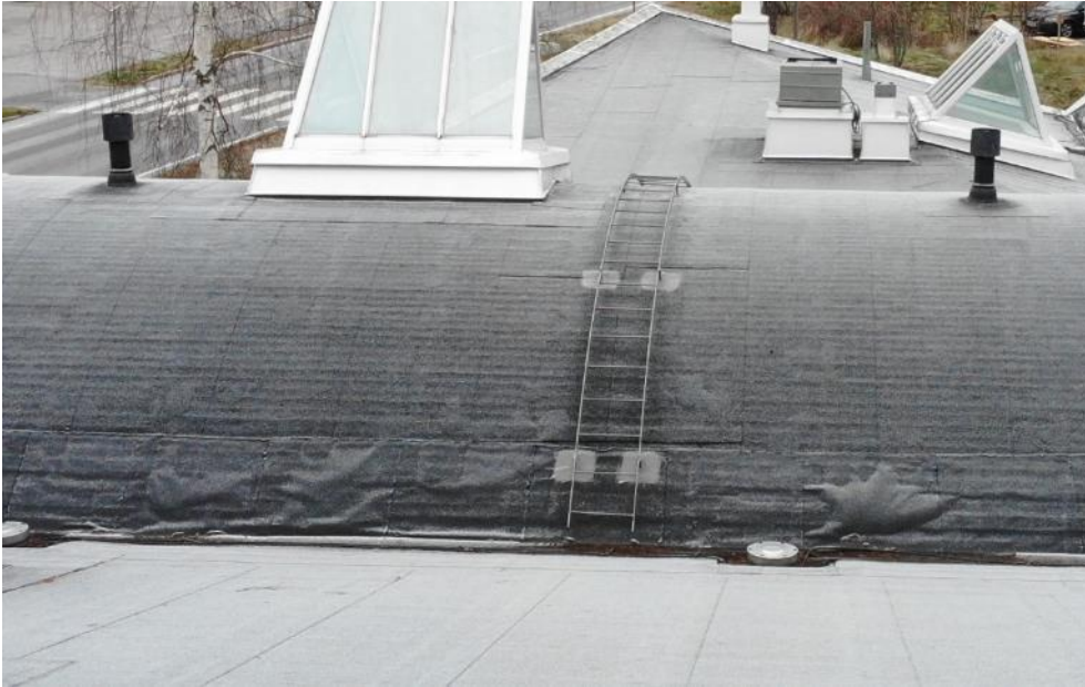
Kuva 4.1. Huopakatteessa on vaurioita.
