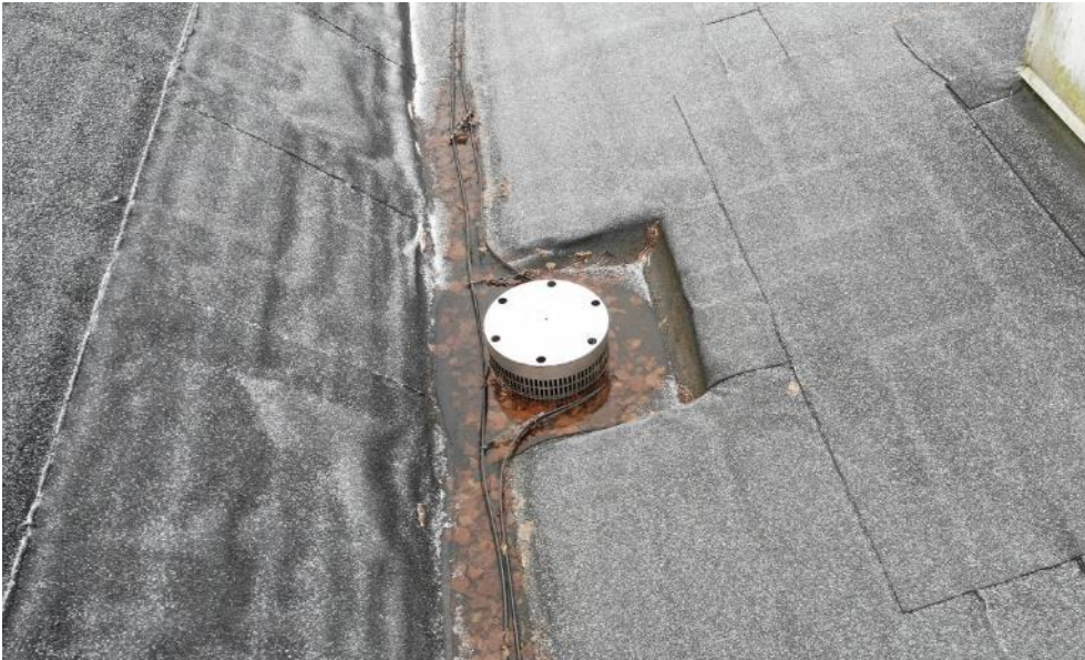
Kuva 4.2. Kattokaivo on tukossa.
