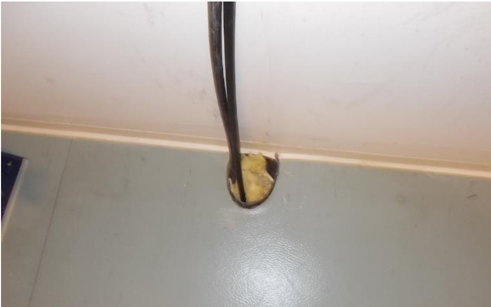
Kuva 4.8. Läpivienti teknisessä tilassa.
