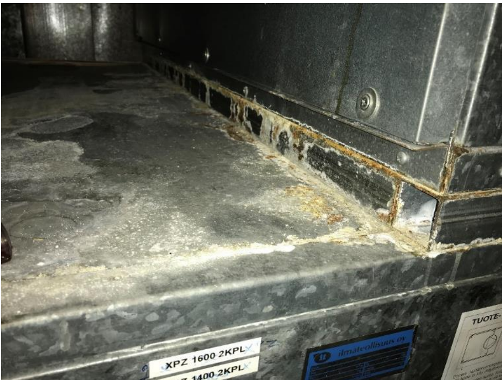
Kuva 5.3. Lumi pääsee ilmanvaihtokoneen sisälle ja sulaa vedeksi.
