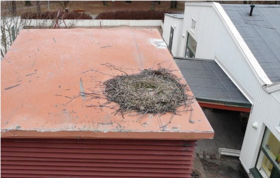
Kuva 4.3. Vesikatolla on linnun pesä.
