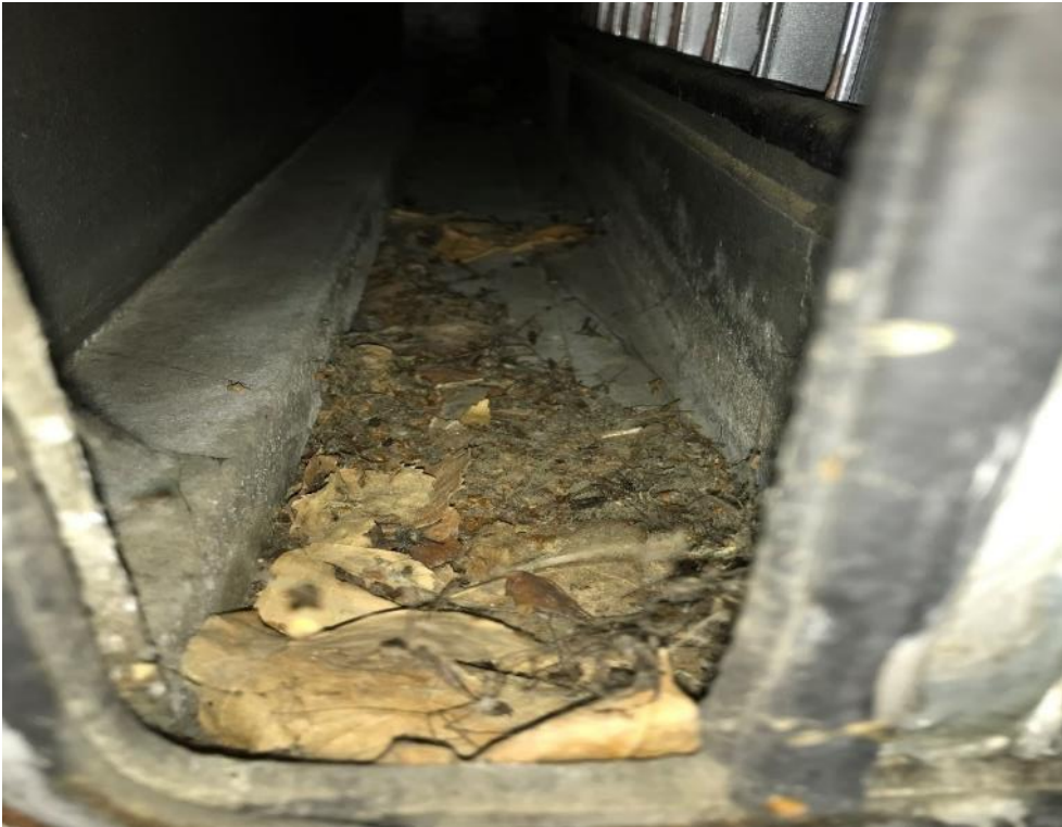
Kuva 5.2. Raitisilmakammiossa on lehtiä ja muuta roskaa.
