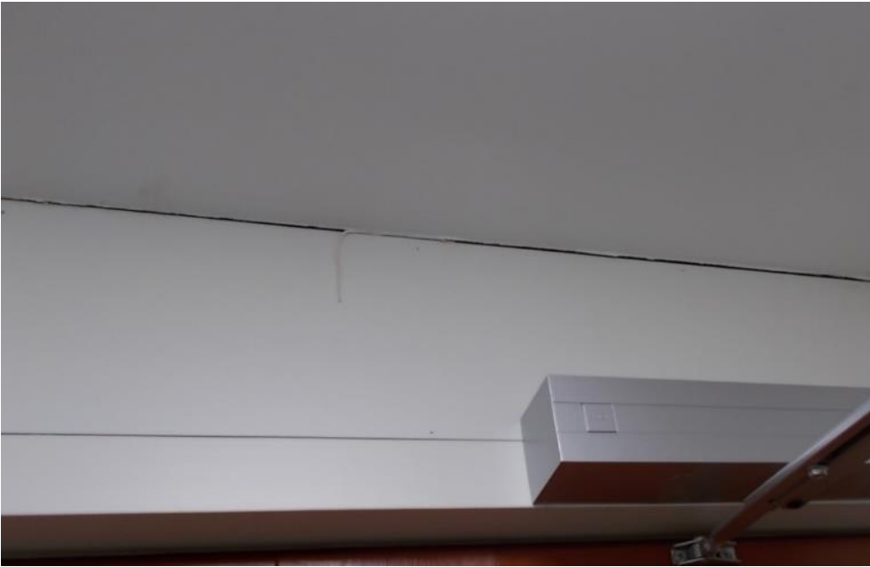
Kuva 4.5. Auennut rakenneliittymä eteisessä 157.
