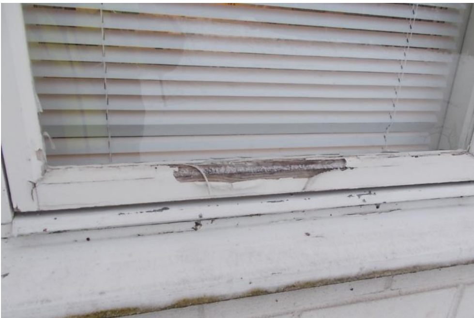
Kuva 4.4. Ikkunan puitteissa on vaurioita.
