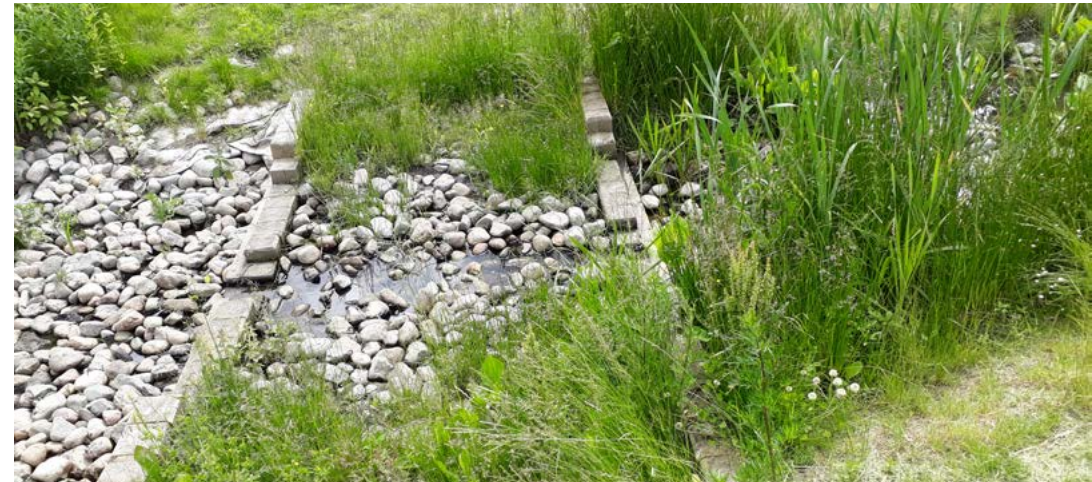
Kuva 2: Puiset vedensäätelyrakenteet toimivat osana hulevesiverkostoa.
