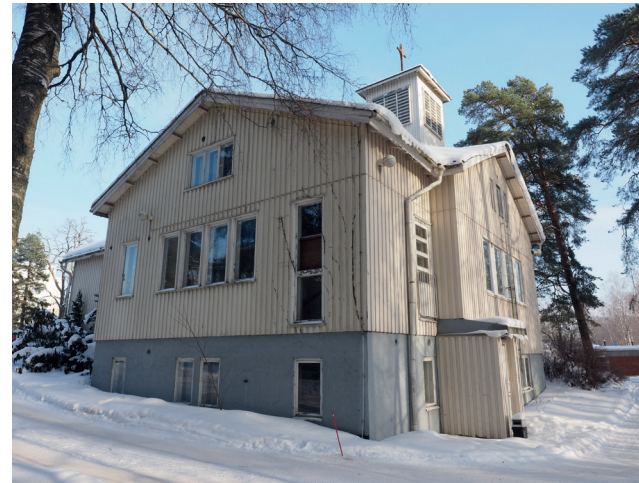
Alkuperäinen parveke on korvattu ranskalaisella parvekkeella. Lounaiskulmassa näkyy vuonna 1985 istutetun köynnöshortensian jättämiä jälkiä. Vuoden 2005 kuntoarvioraportissa on kuva komeasta köynnöksestä, jonka poistamista raportissa suositellaan.
