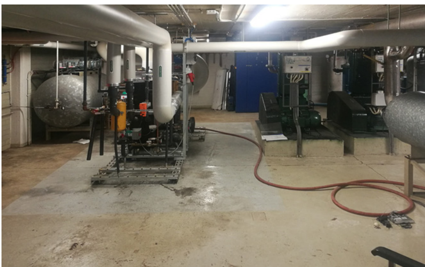
Vedensuodatus- ja lämmönjakokeskus.
