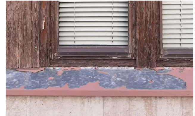
Toimistoikkunarivin karmit on pystypaneeloitu. Pinnat ovat huonossa kunnossa.
