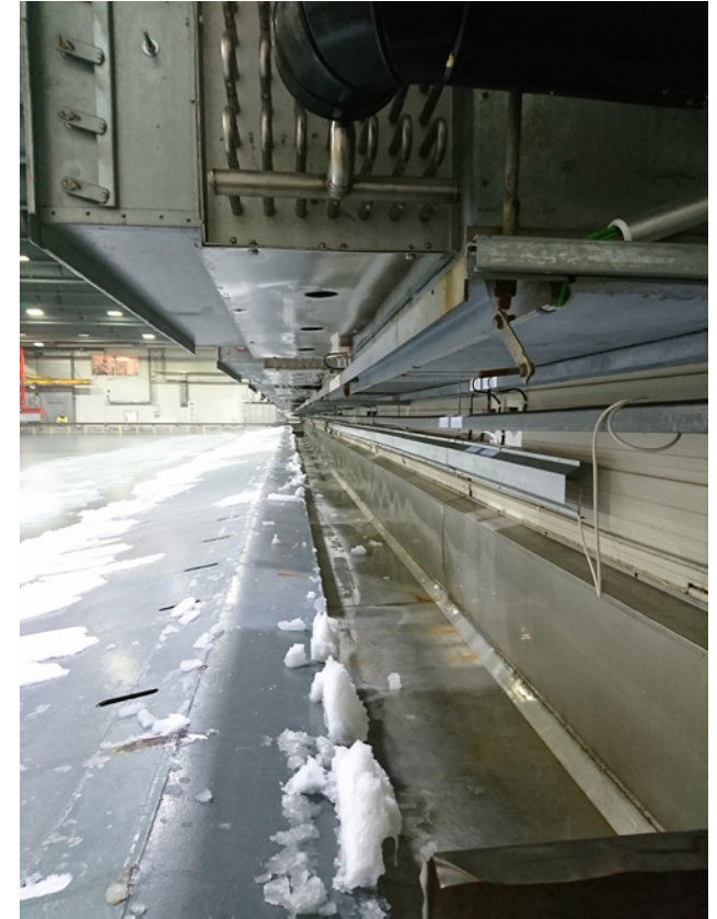
Hallin länsirennalla on noin metrin levyinen kouru, jonka kautta jää kuljetetaan jäänsulatusaltaaseen.
