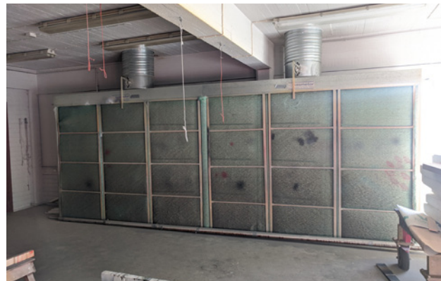
Maalaamossa on isot imurit, jotka ovat sijoitettu ikkunoiden eteen.
