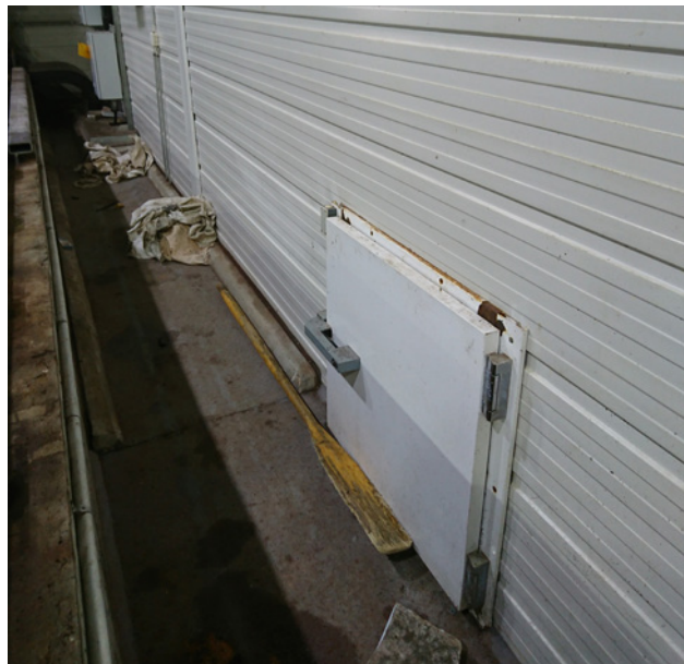
Hallin pohjoisseinällä on hätäpoistumislukku.
