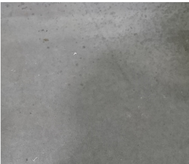
Lattaipinta on biettä betonipinta.
