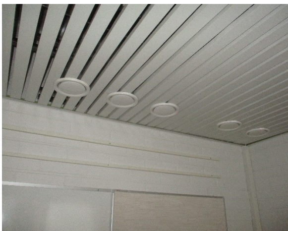
Kuva 5.18 Poistoilmaventtiilit luokka-tiloissa usean venttiilin ryhminä
