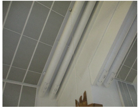
Kuva 5.15: Koulun keskiosalla on korkealla sijaitsevia ilmanvaihdon runkokanavia.
