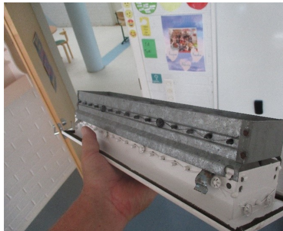
Kuva 5.17 Tuloilmasäleiköt ovat alkuperäiset, joissa rakenne ja säädettävyys on nykymittapuulla vanhentunutta tekniikkaa.
