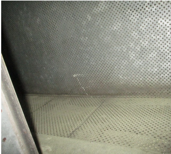
Kuva 5.13 Raitisilmakammion pintana reikäpelti, jonka alla äänenvaimennusvillaa. Kammio pölyinen.
