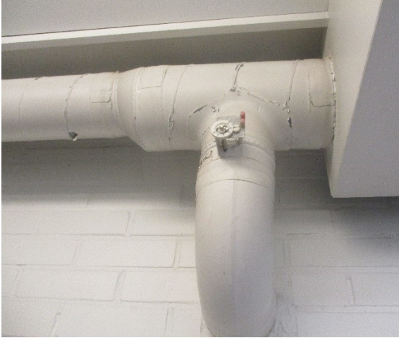
Kuva 5.12 Kanava-asennuksia ja säätöpelti. Runkokanavissa olevat vanhat ilmamääräsäätöpellit tulisi uusia, jos kanavia jää käyttöön peruskorjauksessa.
