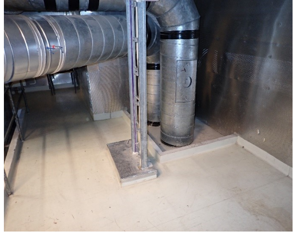
Kuva 5.13 Puhdistusluukkuja kanavistossa on runsaasti. Ainakin iv-konehuoneissa ovat helposti saavutettavissa
