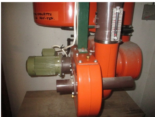
Kuva 5.19 Alkuperäiset VSS-puhaltimet 2 kpl. Teknisesti kunnossa.
