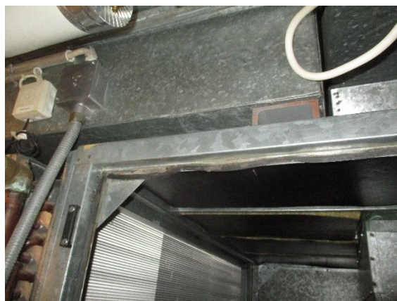
Kuva 5.8: Puhallinkammioon vaihdettujen vaimennuslevyjen kiinnitys irtoamassa. Luukun tiivisteet ovat heikkokuntoiset.
