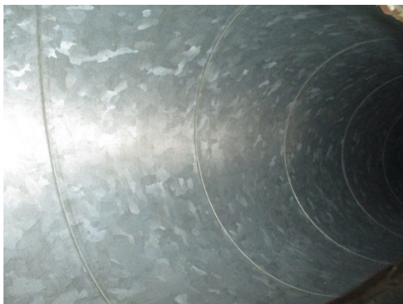
Kuva 5.20 Tuloilmakanavassa on vain hie- man pölyä, ei merkittävää likaantumista
