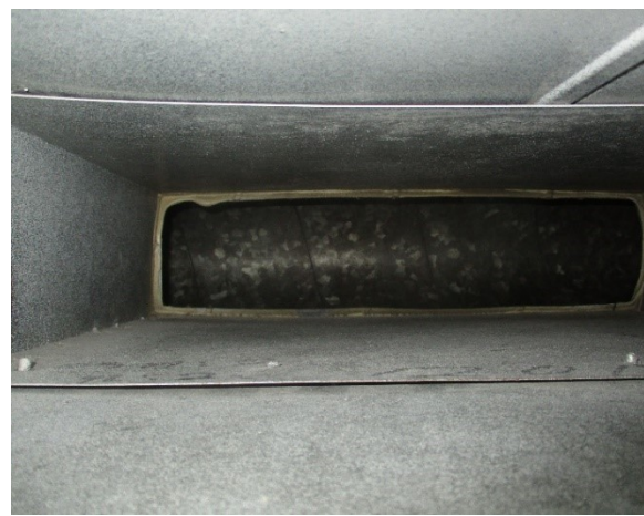
Kuva 5.19 Tuloilman päätelaitteen kanavassa on hieman pölyä, ei kuitenkaan merkittävää likaantumista
