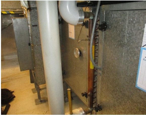
Kuva 5.1: Ilmanvaihtokone TK/PK1 on rakennuksen keskiosan ullakolla iv-konehuoneessa.
