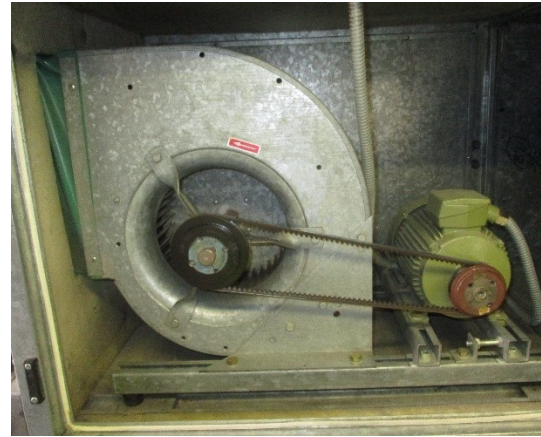
Kuva 5.12 Poistoilmapuhallin PF2.1, puhallinkammiossa on alkuperäiset vaimennusvillalevyt
