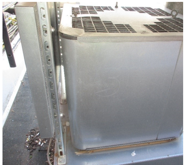
Kuva 5.16 Keittiön rasvahuuvan poistoilmapuhallin PF4.2 (Koja Hifek) on uusittu vuonna 2010
