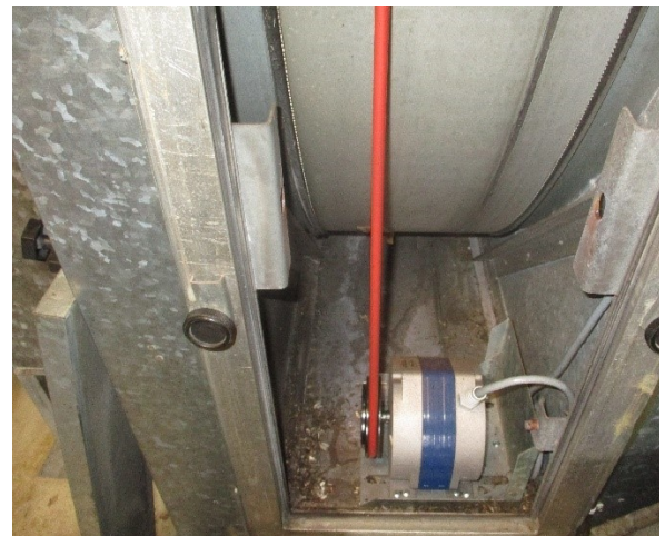
Kuva 5.4: Tuloilmakoneen LTO-kieken käyttömoottori on uusittu joitakin vuosia sitten (myös hihnan paikka vaihdettu)
