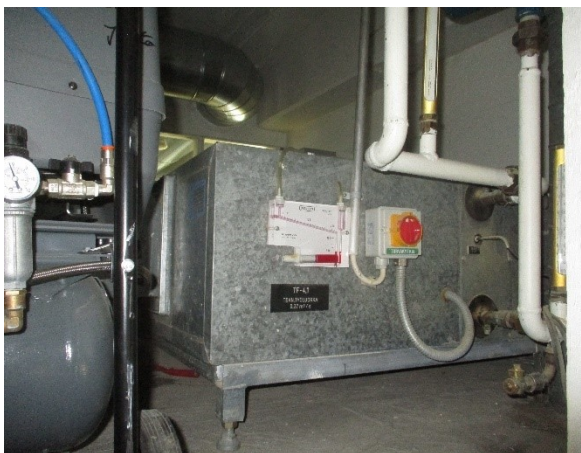
Kuva 5.17 Teknisen työn luokan tuulilmaukone on ahtaasti asennettu "koveroon".
