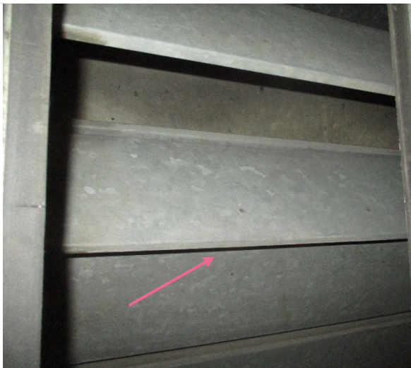
Kuva 5.9 Raitisilmapelti ei täysin tii- viisti sulkeutuva.
