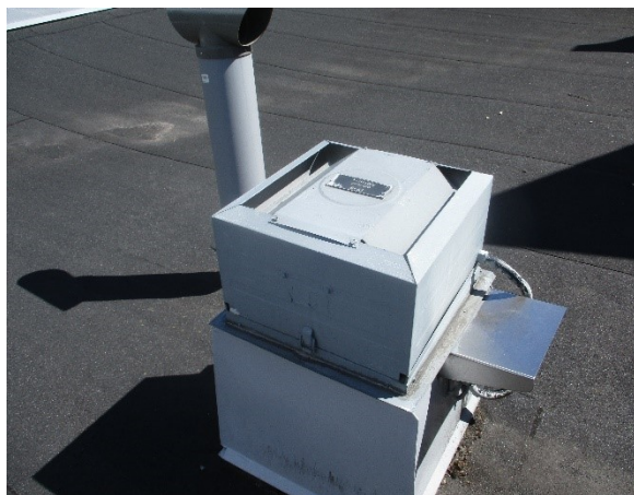
Kuva 5.18 Erillisiä wc-tilojen poistoilmaukoneita on vesikatolla 4 kpl
