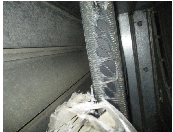
Kuva 5.2 Raitisilman esisuodatuksena toimiva kennosuodatin ennen LTO-roottoria oli käytännössä kokonaan rikkoutunut / romahtanut
