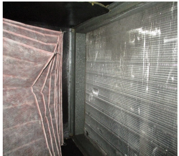
Kuva 5.10 Tuloilman lämmityspatteri on huomattavan likainen. Patterila- melleissa myös runsaasti painumia.
