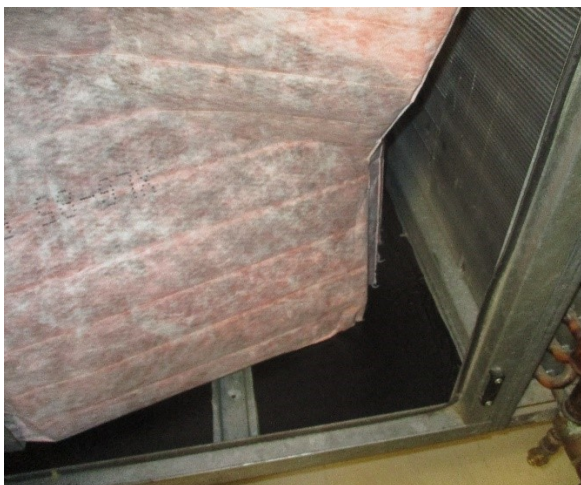
Kuva 5.5: Tuloilmakoneen LTO-kiekon jälkeen ennen lämmityspatteria on raitisilmasuodatuksen pussisuodattimet. Kammioon vaihdettu kuiduttomat vaimennuspinnat.
