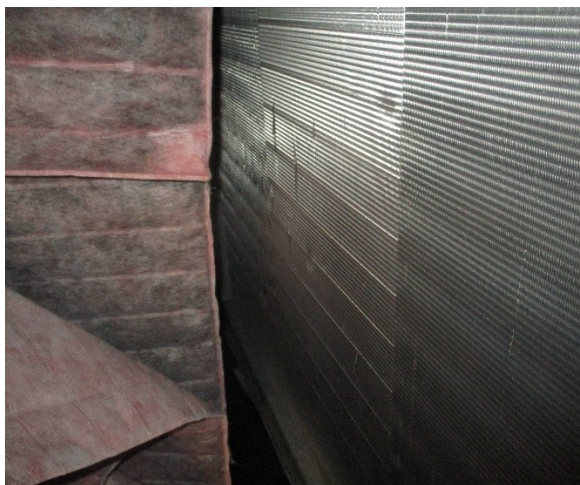
Kuva 5.6: Lämmityspatterissa on molemmin puolin runsaasti painumia.
