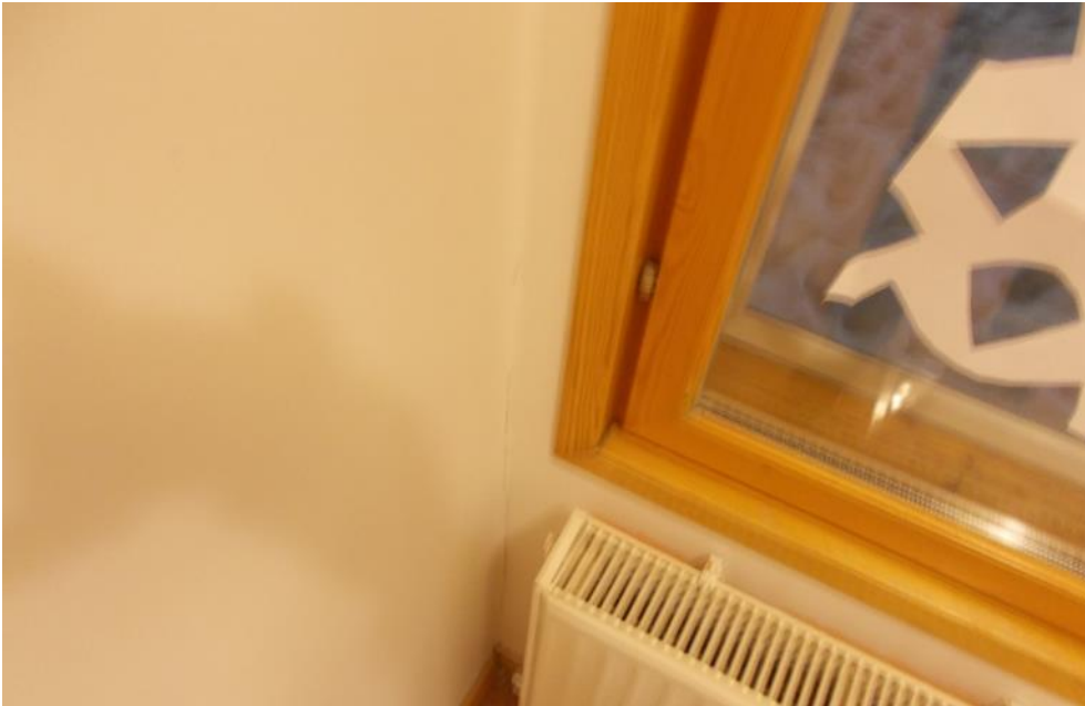
Kuva 4.13. B-rakennus 3434 / Leikkitilan 119 seinänurkassa on auennut rakenneliittymä.
