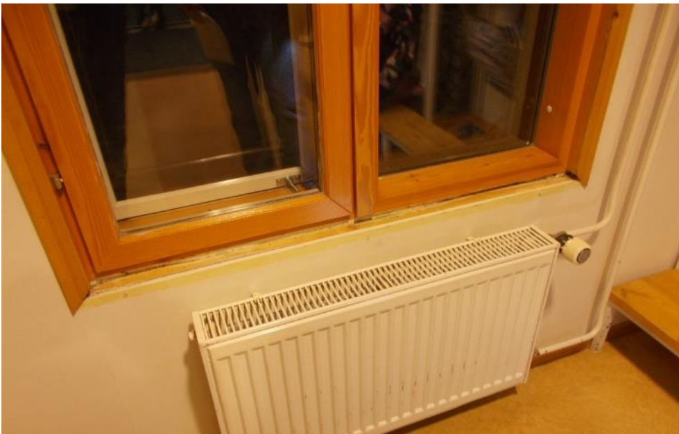
Kuva 4.8. B-rakennus 3434 / Aulassa 105 ikkunalista puuttuu.
