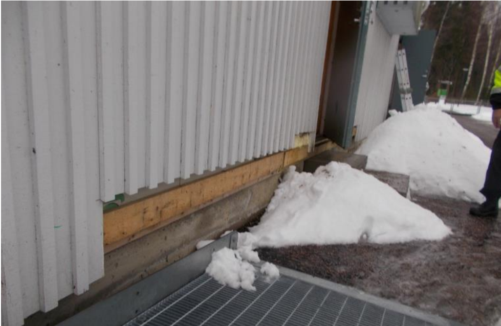
Kuva 4.1. A-rakennus 3104 / Koolausta ja ulkoverhouspanelointia puuttuu.
