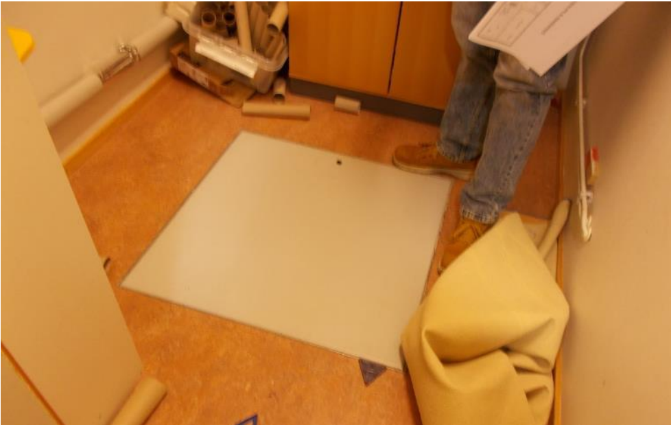
Kuva 4.11. B-rakennus 3434 / Leikkitilan Varastossa 118 oleva lattialuukku.
