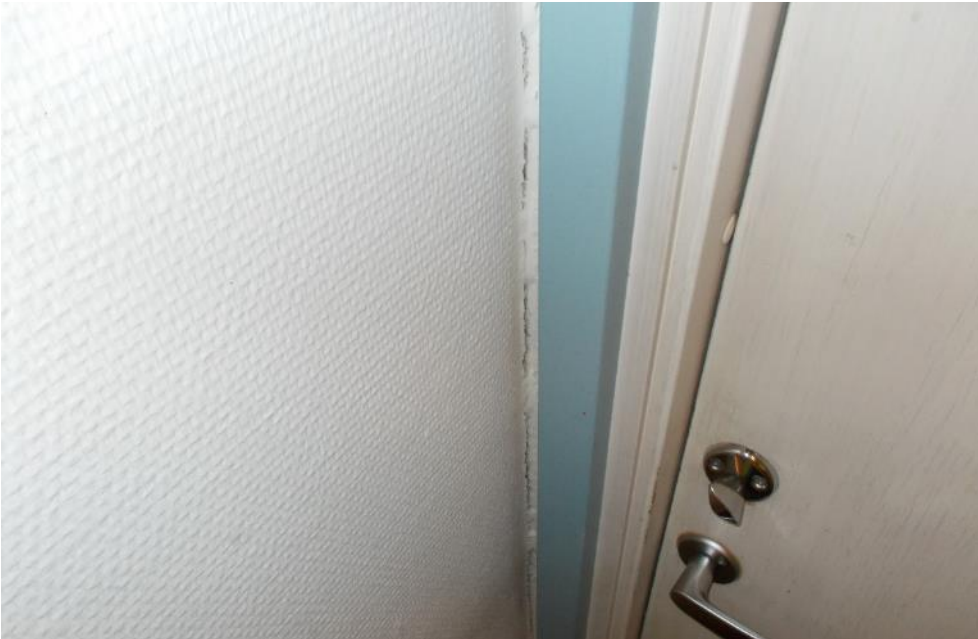
Kuva 4.5. A-rakennus 3104 / Tuulikaapissa 134 on auenneita rakenneliittymiä.
