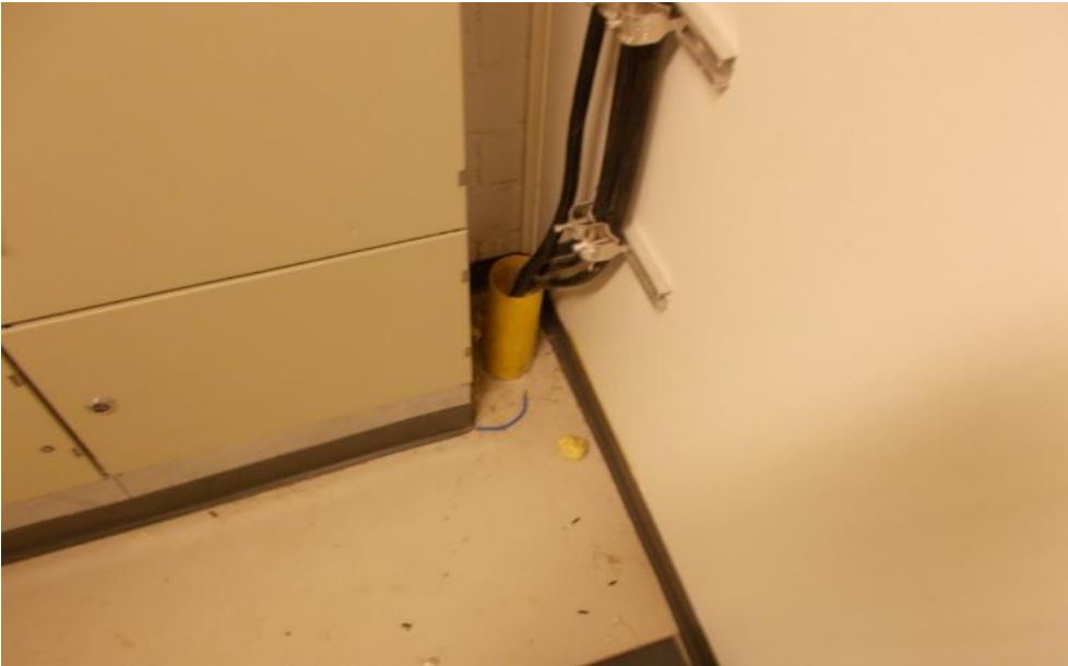
Kuva 4.9. B-rakennus 3434 / Sähköpääkeskuksessa on tiivistämätön kaapeliläpivienti.
