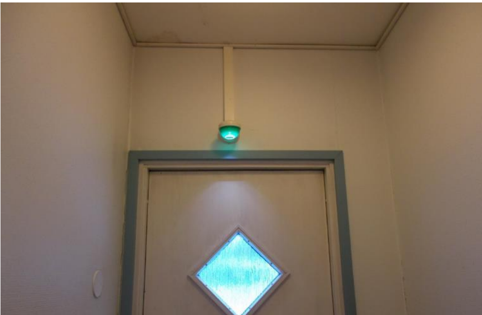
Kuva 4.4. A-rakennus 3104 / Tuulikaapissa 134 on vesivuotojälki katossa.
