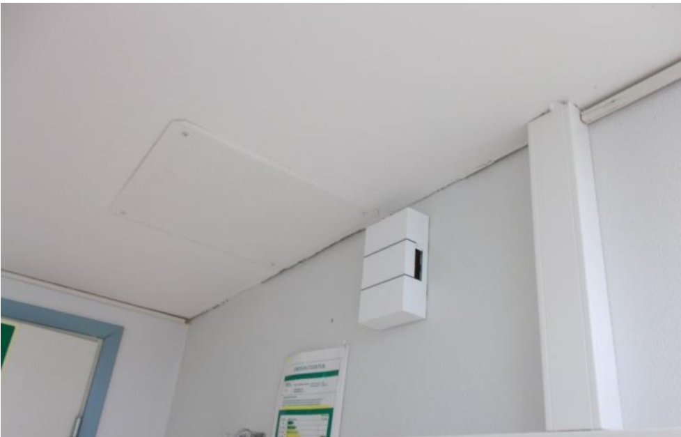
Kuva 4.6. A-rakennus 3104 / Tuulikaapin 134 edessä puuttuu kattolista.
