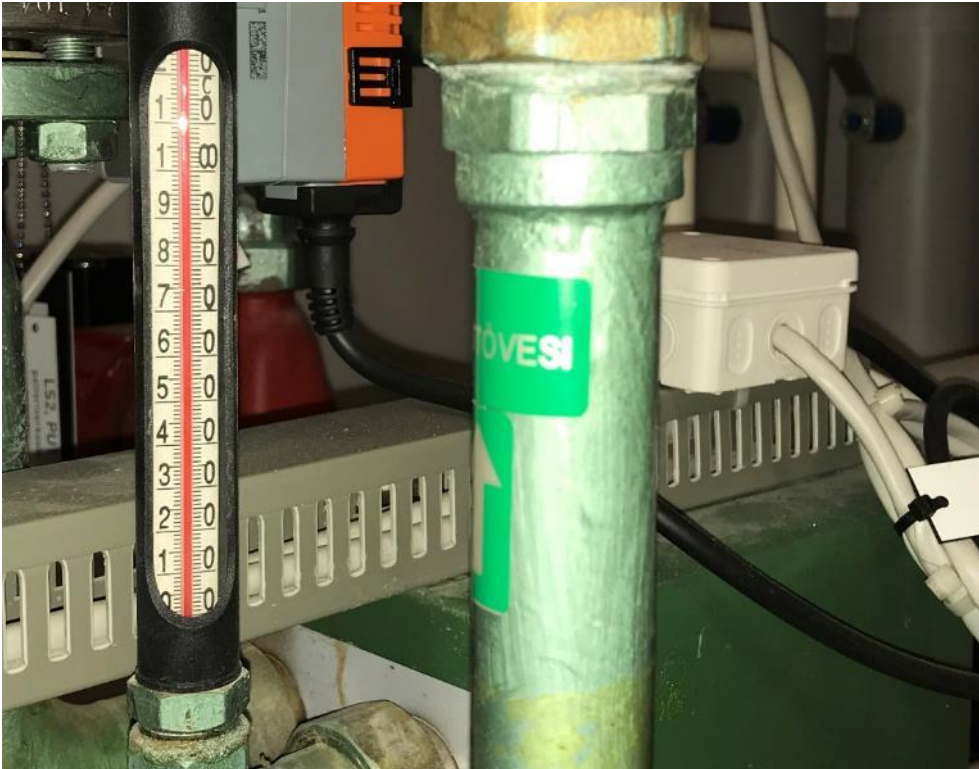
Kuva 5.3. 3434 B-talon lämmönjakokeskuksen käyttöveden lämpömittari on rikki.
