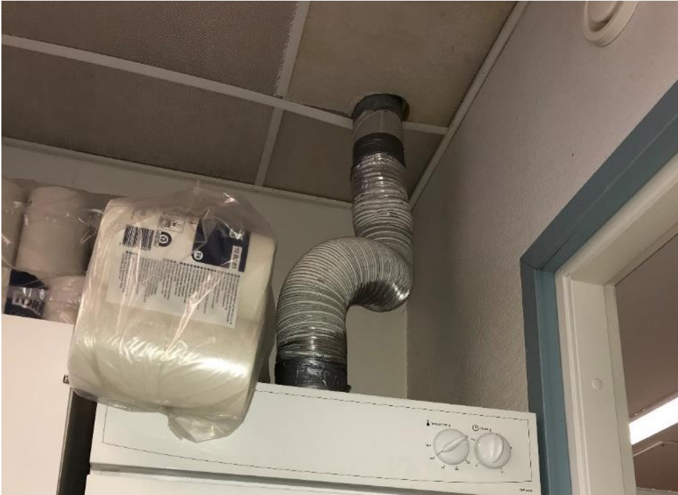
Kuva 5.1. 3401 A-talon eteisen kuivauskaapin poistoilmaletku on liitetty suoraan poistokanavaan.
