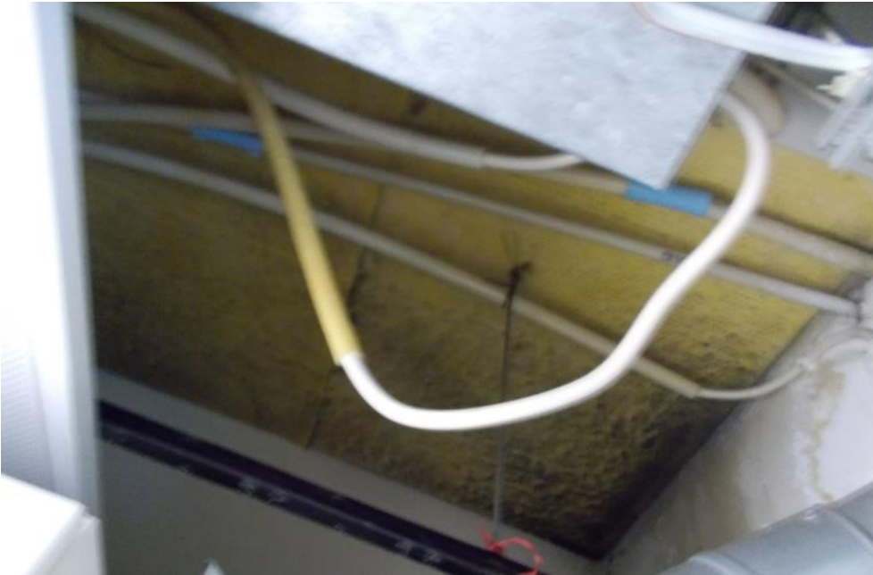
Kuva 4.3. A-rakennus 3104 / Tuulikaapin 121 alakatosta puuttuu panelointia ja villat ovat näkyvissä.
