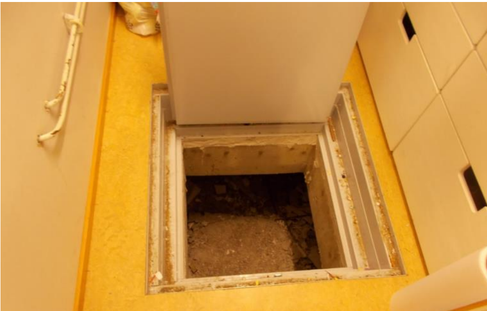
Kuva 4.10. B-rakennus 3434 / Leikkitilan Varastossa 103 oleva lattialuukku.
