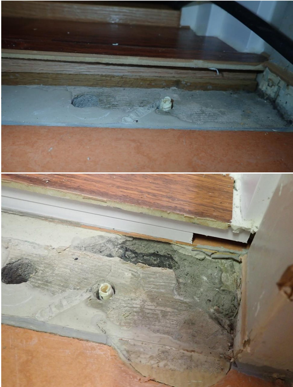
Kuvat 7, 8. Tilojen 2.13 ja 2.12 välioiven kynnys irrotettiin ja tehtiin välipohjarakenteeseen tarkastusporaus (RA4). Tilan 2.12 puolella tasoitteen ja betonilaatan välissä havaittiin musta pikikerros.
