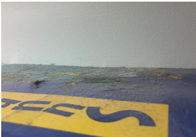
Kuva 14. Lepohuoneen 2.13 yläkaapin päällä havaittiin runsaasti pölyä.
