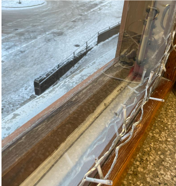
Kuva 10. Lepohuoneen 2.13 ikkunan alakarmin alta tuli sisäänpäin voimakas, kylmä ilmavirtaus.
