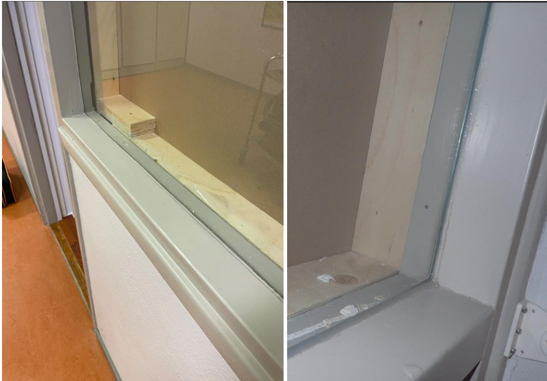
Kuvat 4, 5. Tilojen 2.12 ja 2.13 välille on rakennettu vuonna 2022 vanhan väliseinän/ikkunan päälle uusi levyrakenteinen väliseinärakenne, minkä jälkeen tilojen sisäilmassa alkoi esiintyä poikkeavaa hajua.
