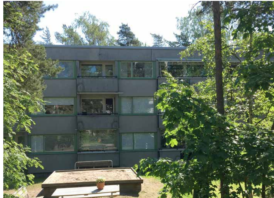
Rakennukset I13 ja I15 ovat pääseet parvekejulkisivuiltaan huonoon kuntoon.
