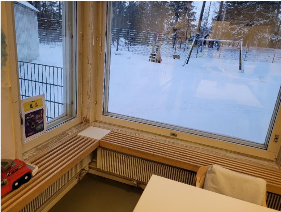
Kuva 4.1. Ikkunasmyygit ovat korjausmaalauksen tarpeessa (Kuvassa Hippiäisten Leikkitila 126.).
