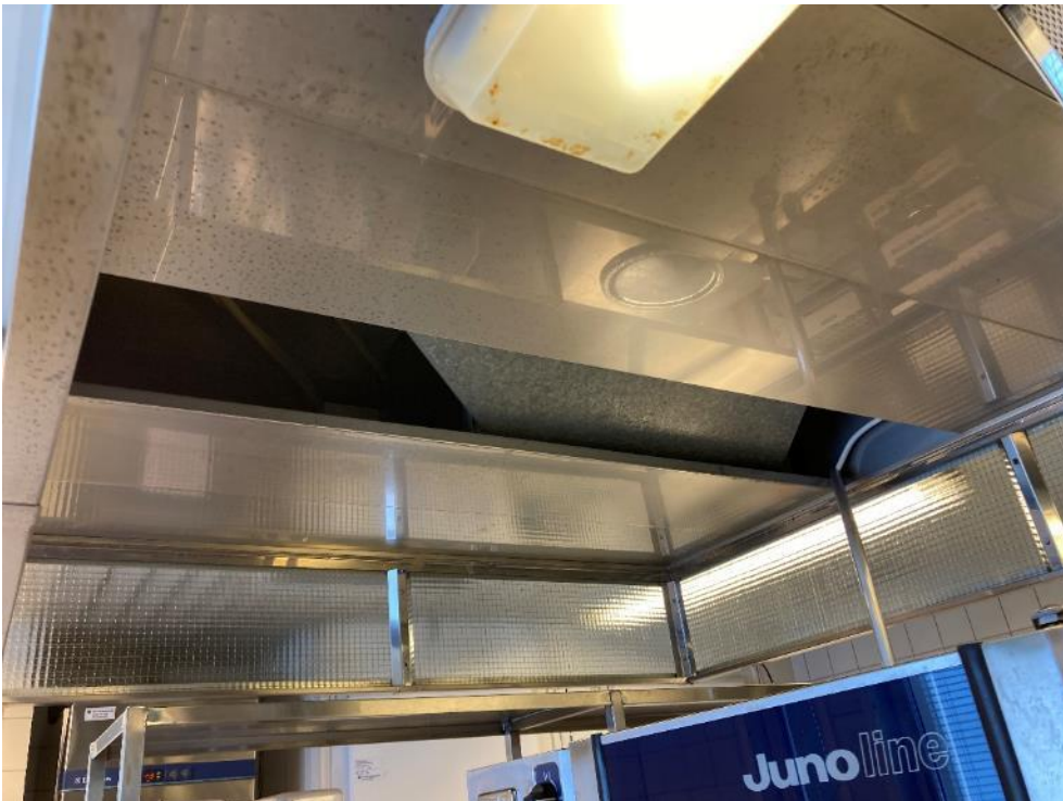
Kuva 5.5. Keittiön huuvin katosta puuttuu pala.
