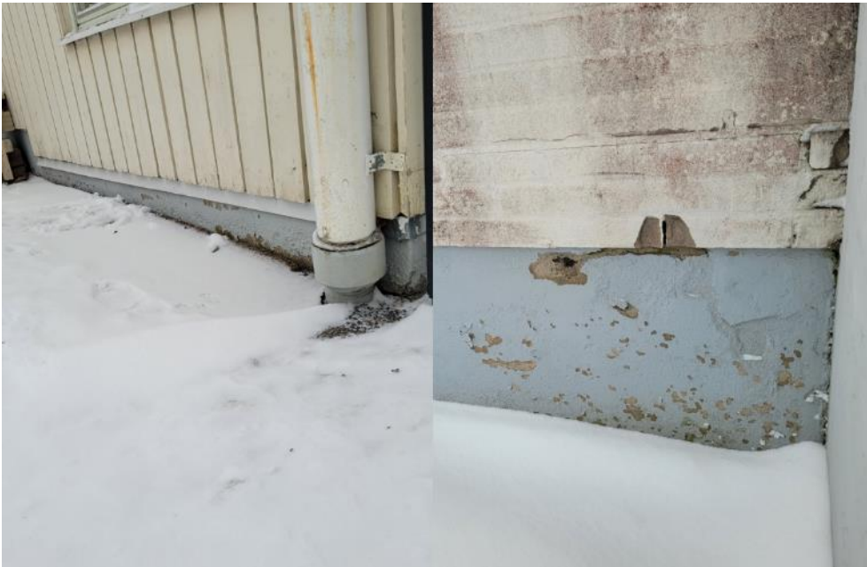
Kuva 4.15. Vaurioita sokkelissa ja julkisivussa.
