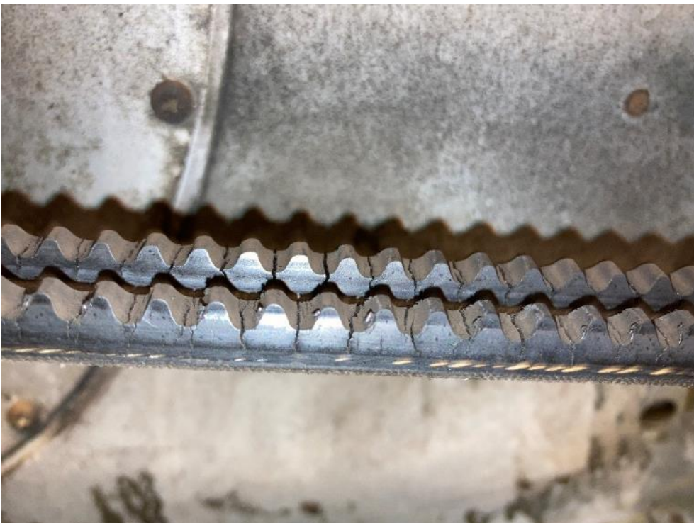
Kuva 5.3. Ilmanvaihtokoneen hihnat ovat kuluneet.
