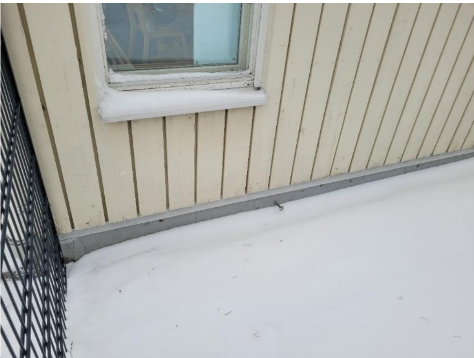
Kuva 4.13. Naula vaarallisesti sokkelissa.
