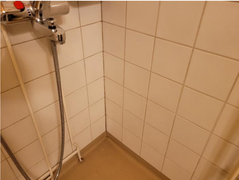
Kuva 4.7. WC:n 214 suihkunurkan silikonisauma on tummunut.
