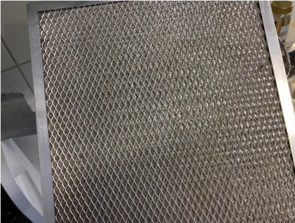
Kuva 5.2. Entisen talonmiehenasunnon Keittiön 216 liesituulettimen rasvasuodatin on pölystä tukossa.
