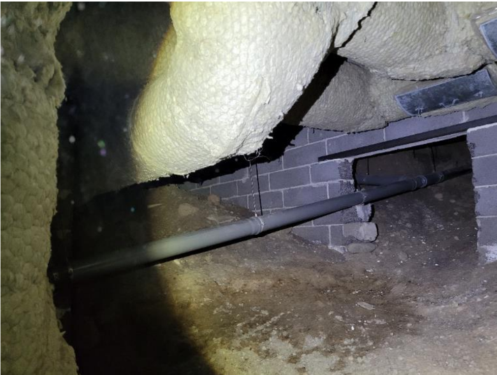
Kuva 4.11. Alustatilassa on kostuneen näköistä soratäytettä.
