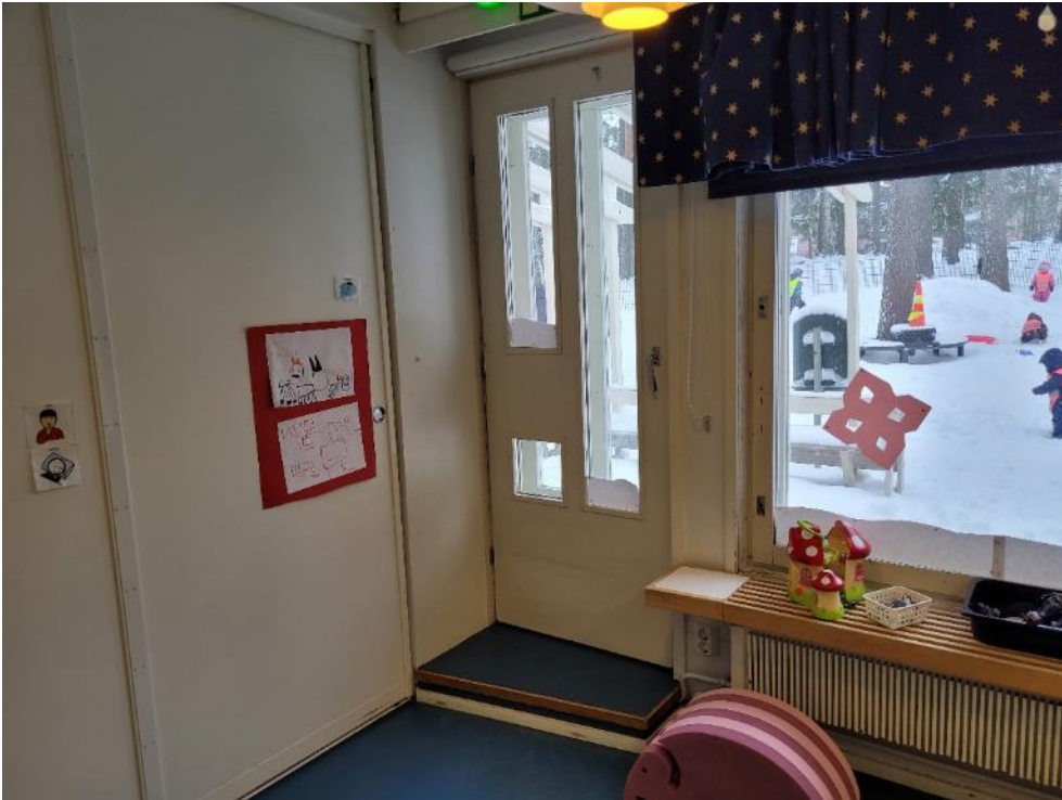
Kuva 4.2. Tuuletusovet 1. kerroksessa eivät ole tiiviitä (kuvassa Leikkitila 131).
