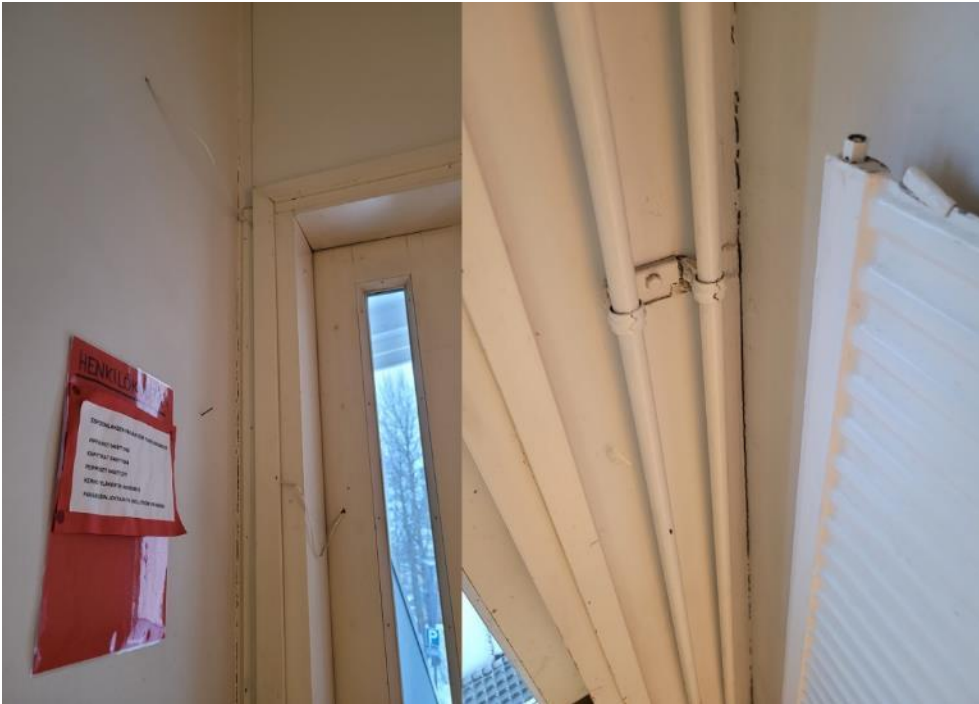
Kuva 4.8. Tuulikaapin 209 ulkoseinäkulmien rakenneliittymät ovat auenneet.
