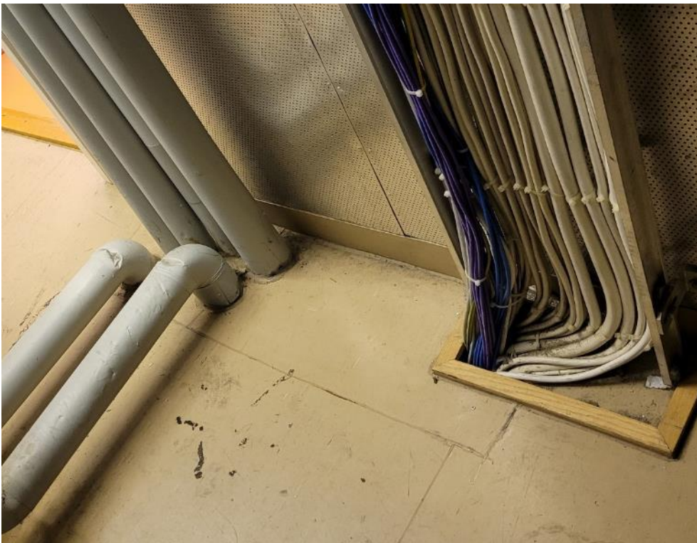
Kuva 4.9. Ilmanvaihtokonehuoneen 201 läpivientien tiiveys on epäselvä.
