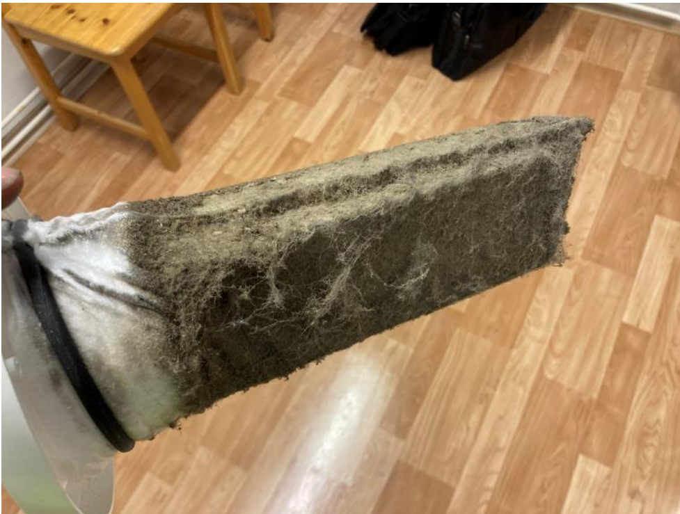
Kuva 5.1. Entisen talonmiehenasunnon korvausilmaventtiilien suodatinkankaat ovat likaiset.
