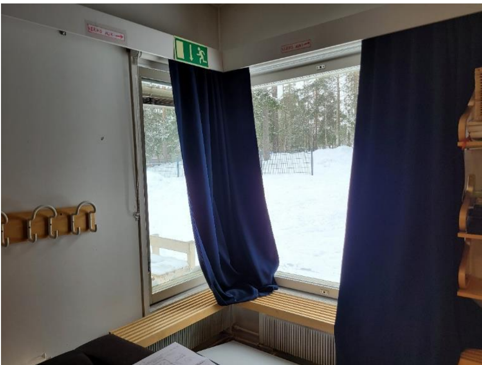
Kuva 4.5. Lepuhuoneen 139 hätäpoistumistieikkuna ei toimi.
