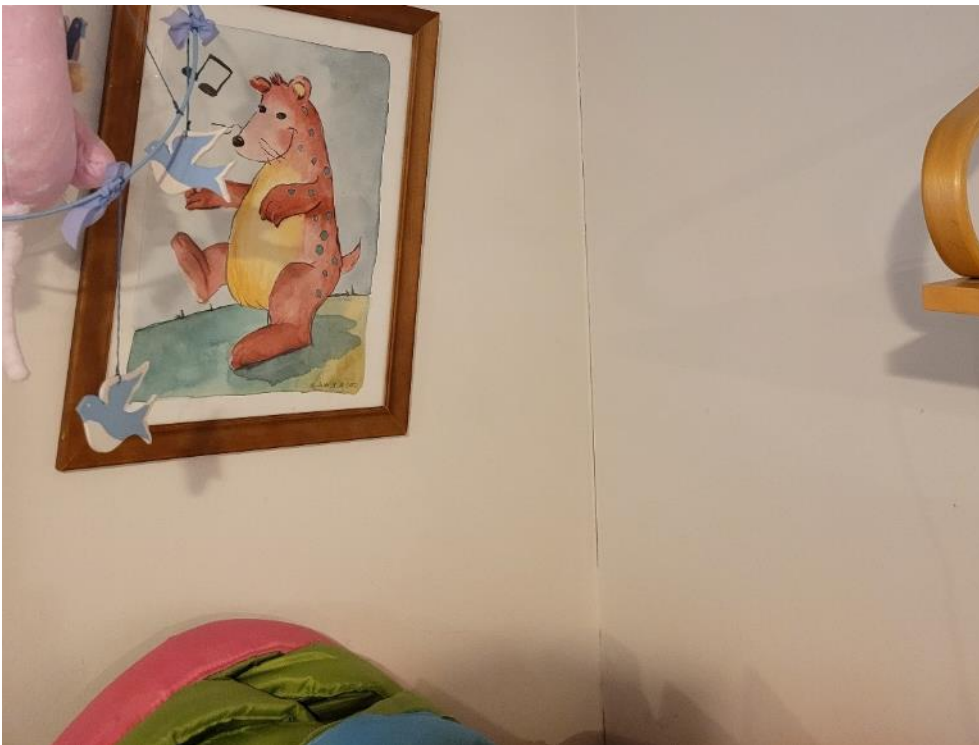
Kuva 4.3. Tilassa 127 on kylmä ulkoseinäkulma.
