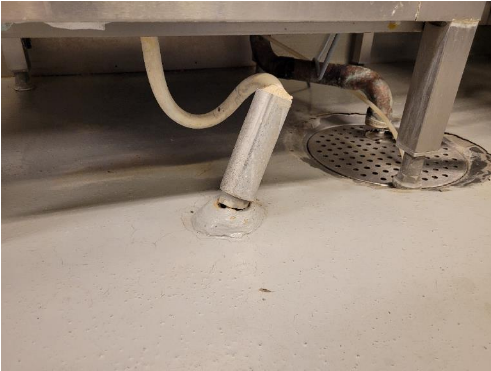
Kuva 4.6. Keittiön 116 lattialäpivienti ei ole tiivis.
