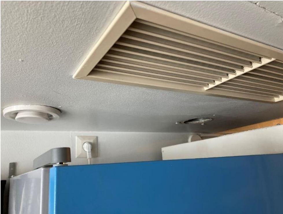
Kuva 5.4. Eteisen 128 katosta puuttuu poistoilmaventtiili.
