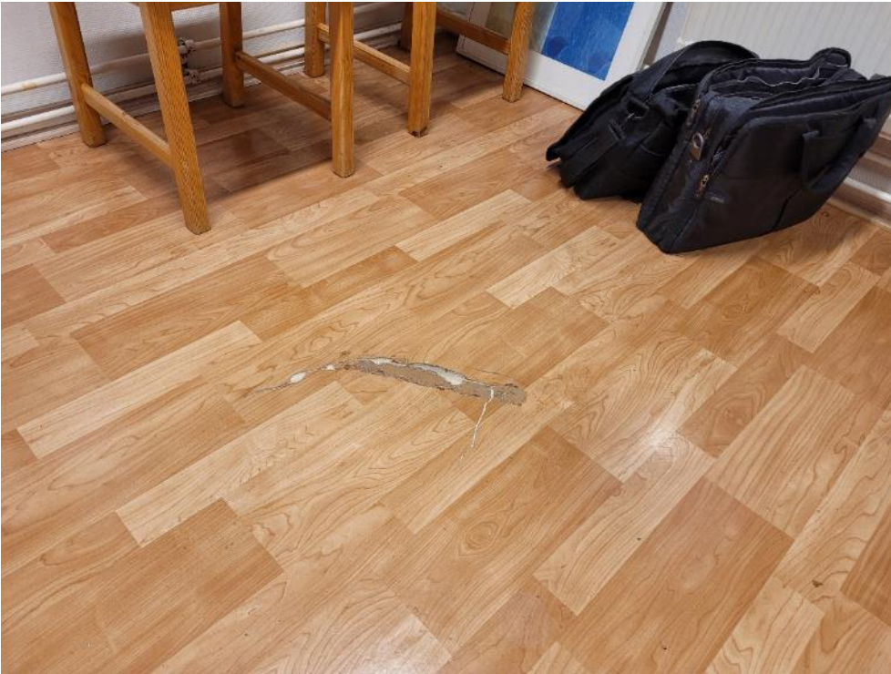
Kuva 4.10. Työtilassa 218 on lattiamattovaurio.
