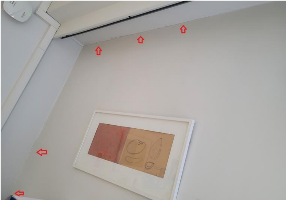
Kuva 4.4. Leikkitilan 110 ulkokulmassa seinä- ja kattorajassa on rakenneshalkeamat.
