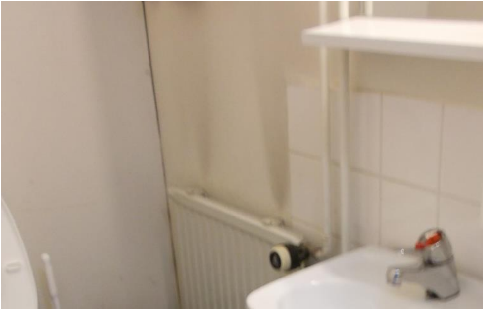
Kuva 4.9. Patterin kannakkeista on ilmavuotoa WC:ssä C210.
