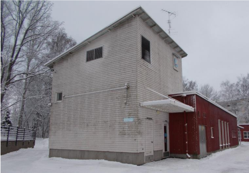
Kuva 4.1. Ulkoverhous on huollon tarpeessa.
