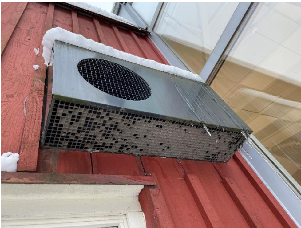
Kuva 5.8. Luokan B183 siirrettävän ilmanvaihtokoneen raitisilmasäleikkö on likainen.
