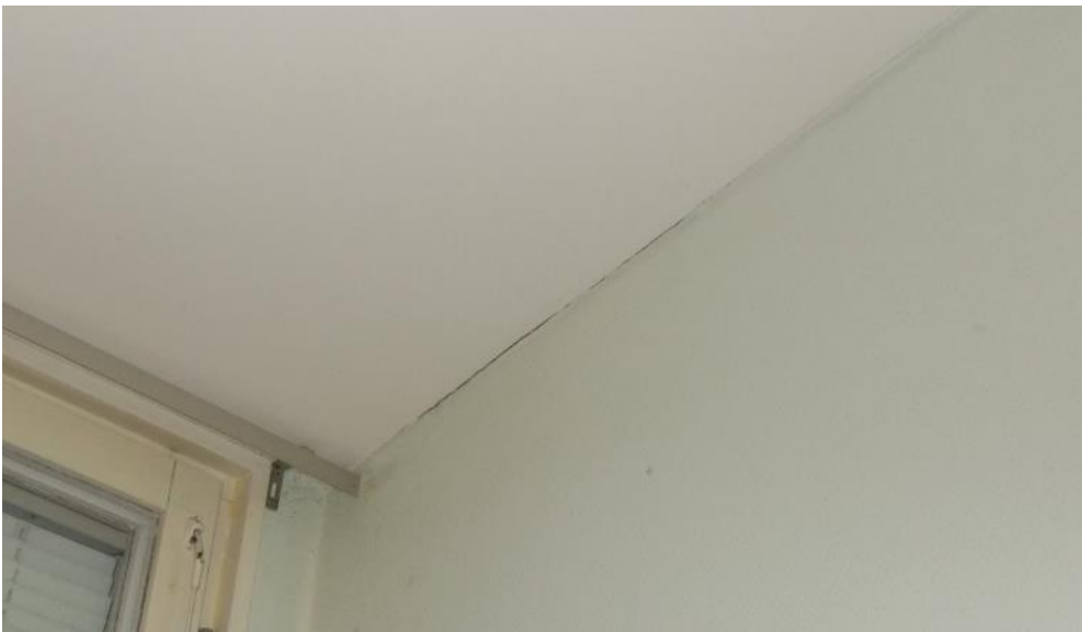
Kuva 4.8. Seinän ja katon liittymä on auennut luokassa C194.
