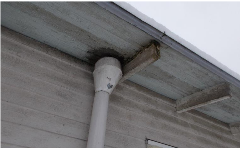
Kuva 4.2. Kattovasat ja räystäään aluslaudoitus ovat osin vaurioituneita.
