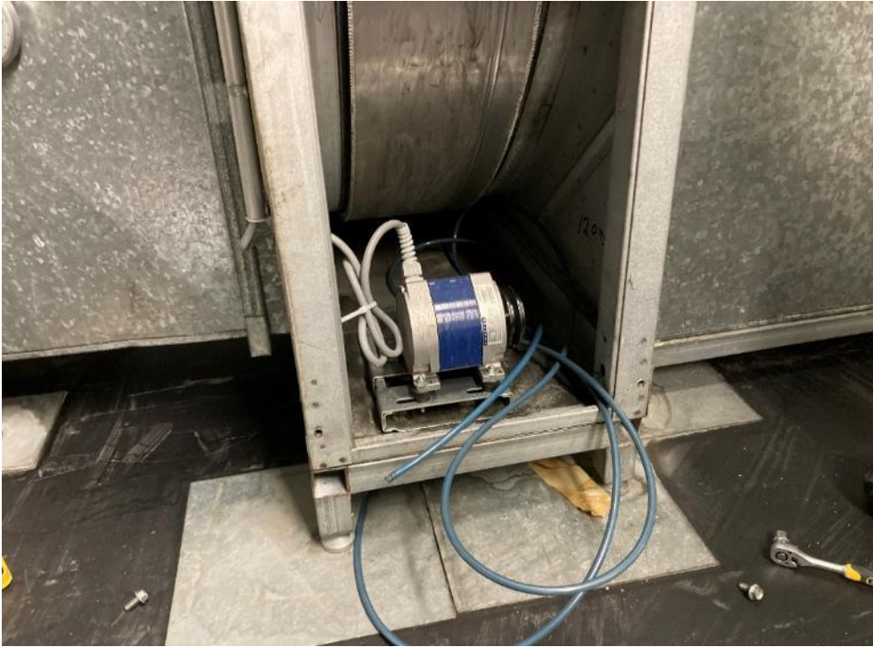
Kuva 5.1. Ilmanvaihtokoneen TK2 lämmöntalteenoton hihna on poikki.
