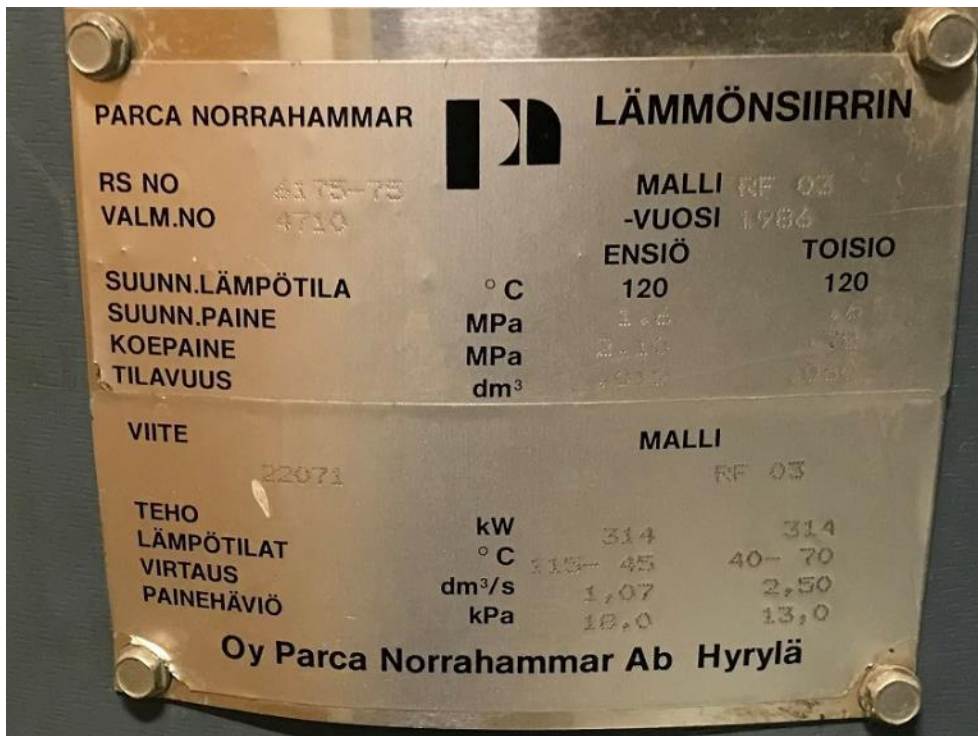
Kuva 6.3. Lämmönvahdin on vuodelta 1986.
