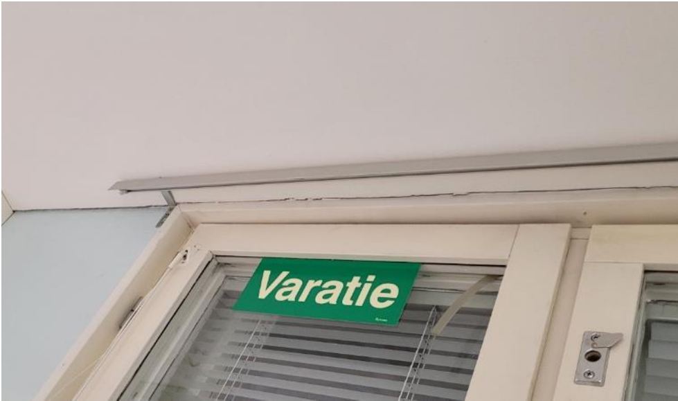
Kuva 4.7. Seinän ja katon liittymä on auennut luokassa B188.
