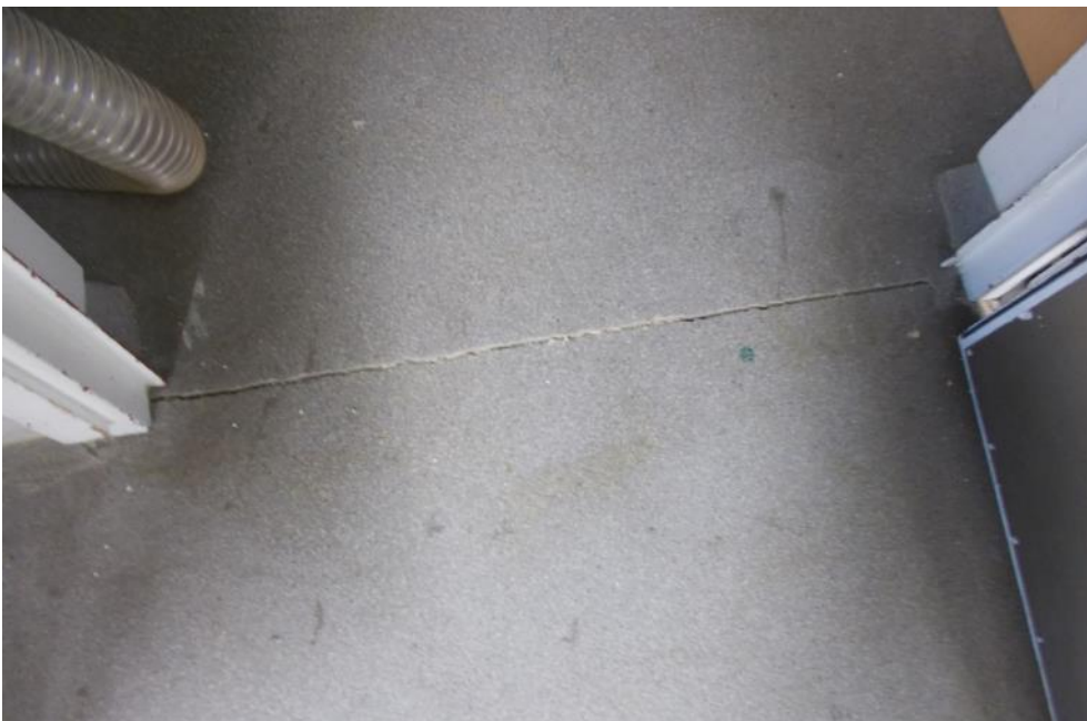
Kuva 4.10. Lattiassa on halkeama luokassa C216 / työtilassa C217.
