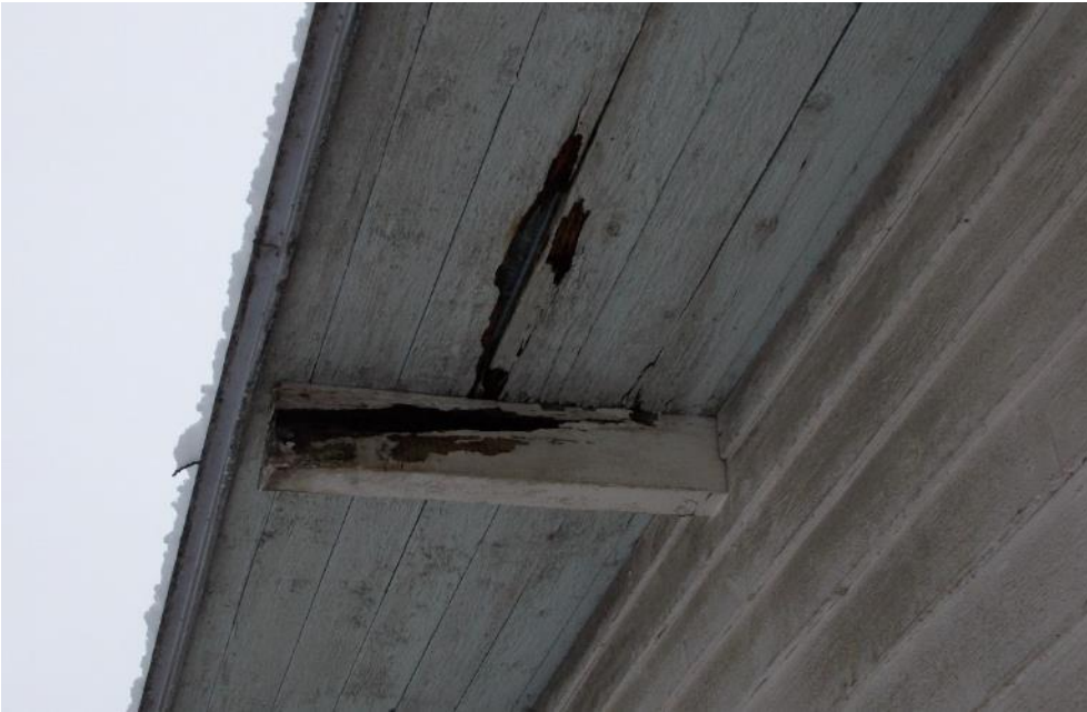
Kuva 4.3. Kattovasat ja räystäään aluslaudoitus ovat osin vaurioituneita.
