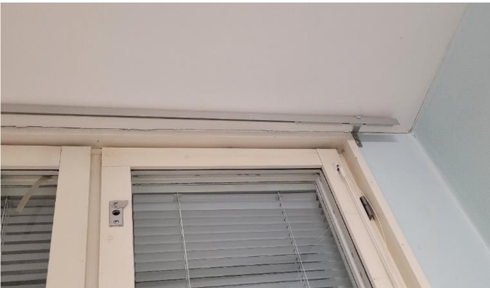
Kuva 4.6. Seinän ja katon liittymä on auennut luokassa B188.
