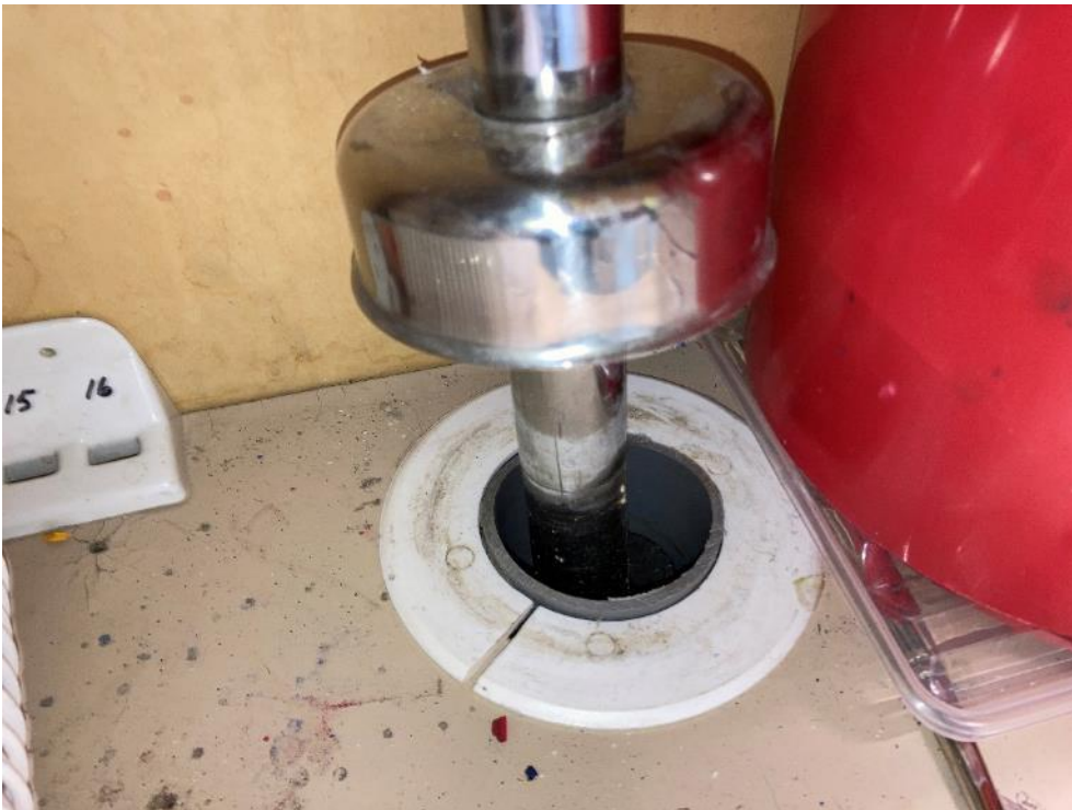
Kuva 5.6. Viemäriiitoksen tiivistekumi puuttuu luokassa B186.
