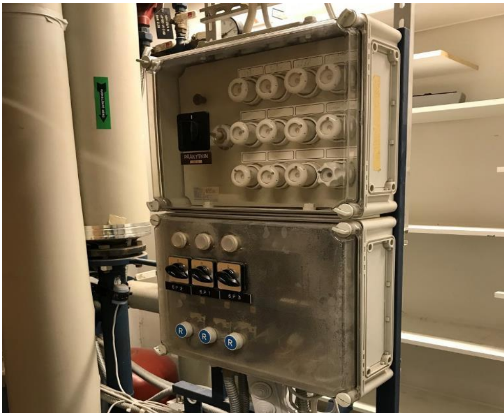
Kuva 6.4. Palovaarallinen sähkökeskus Lämmönjakohuoneessa.
