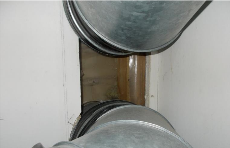
Kuva 4.11. Läpivienti Ilmanvaihtokonehuoneessa C2109 ei ole tiivis.
